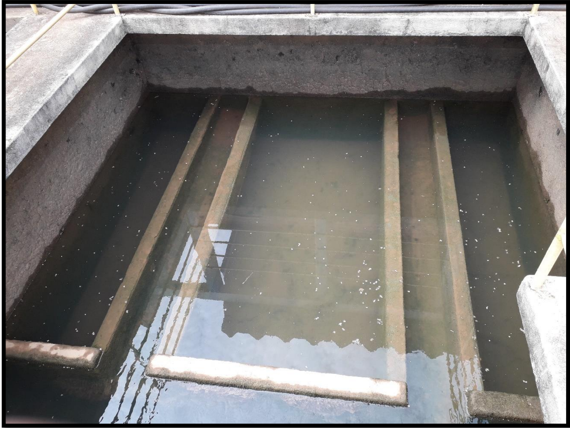
Imagem 15: Câmara de filtração da ETA
