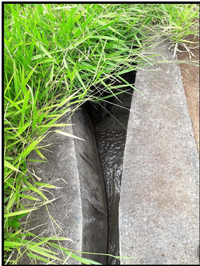
Imagem 34: ETE das Antas – Calha Parshall
