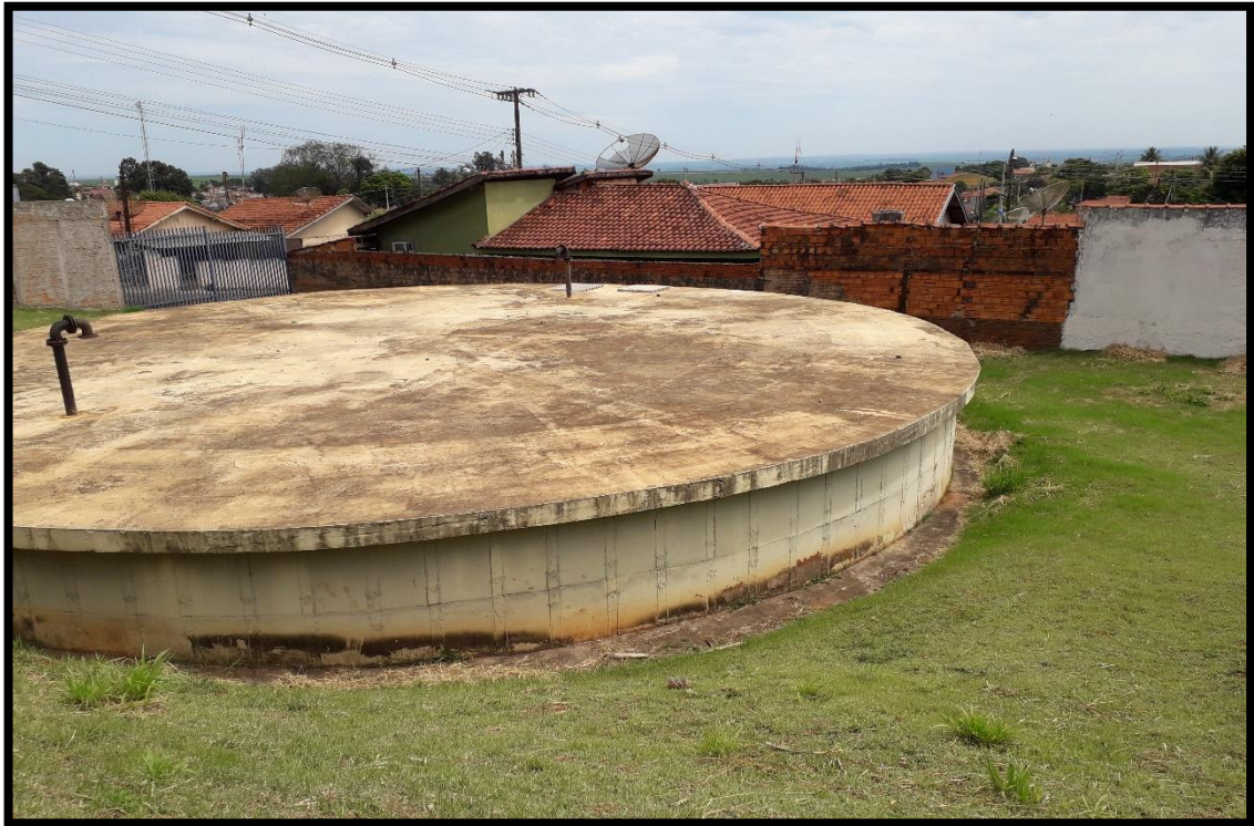
Imagem 23: Reservatório enterrado do sistema Sede
