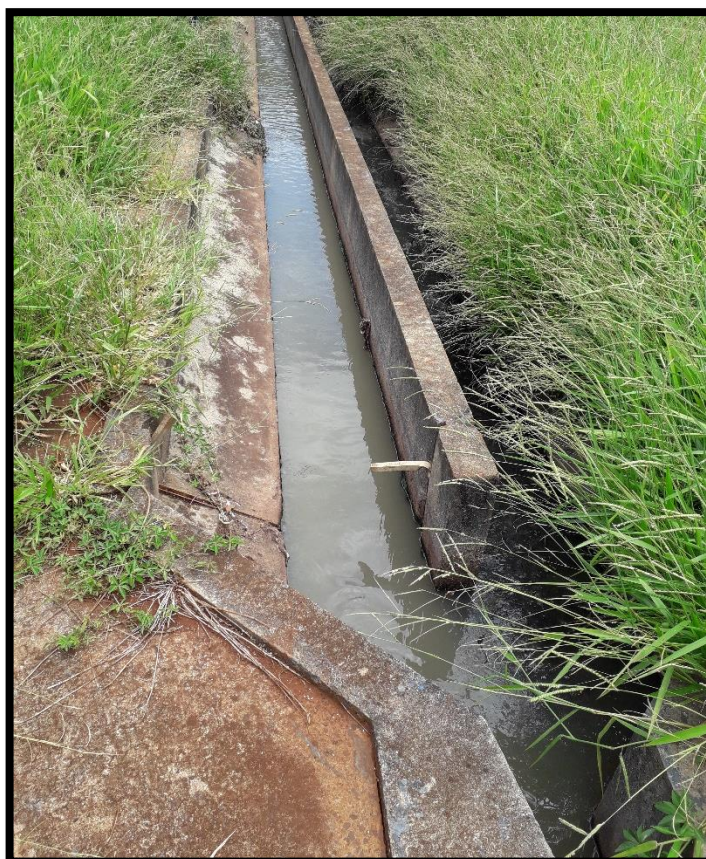
Imagem 35: ETE das Antas– Caixa de Areia
