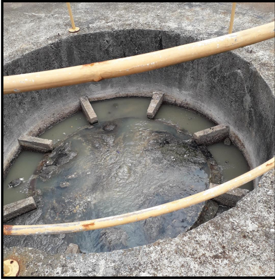
Imagem 36: ETE das Antas– Reator Anaeróbio
