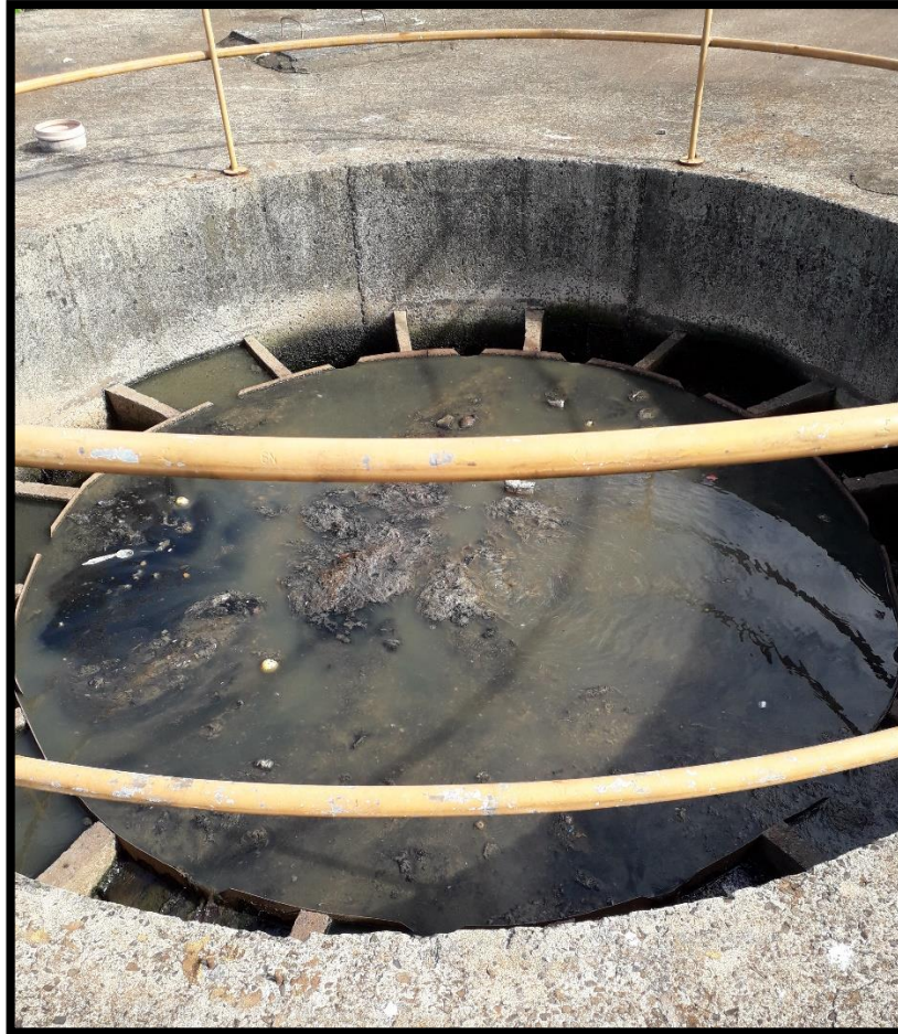
Imagem 32: ETE Barreiro – Reator Anaeróbio
