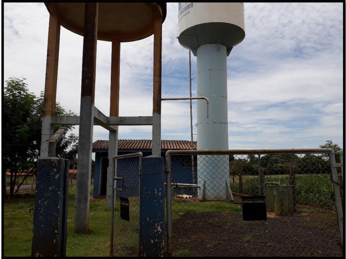
Imagem 25: Captação, reservatório e casa de tratamento do distrito Nossa Senhora Aparecida
