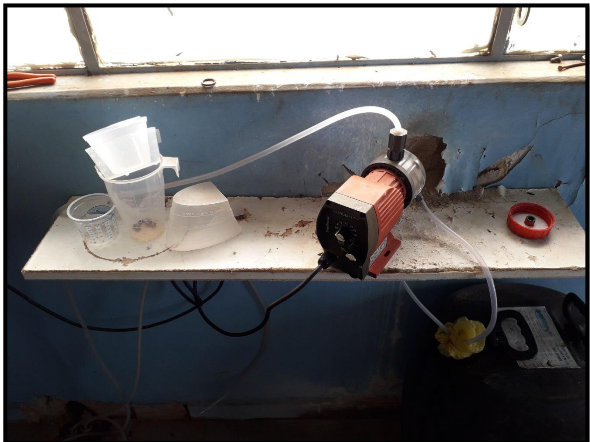
Imagem 26: Dosadora de cloro sobre bancada deteriorada; revestimento de parede deteriorado
