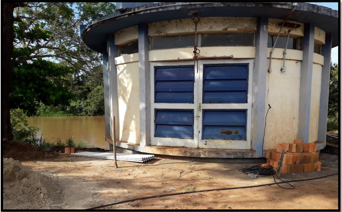
Imagem 4: Casa de bombas de captação superficial no Rio das Cinzas
