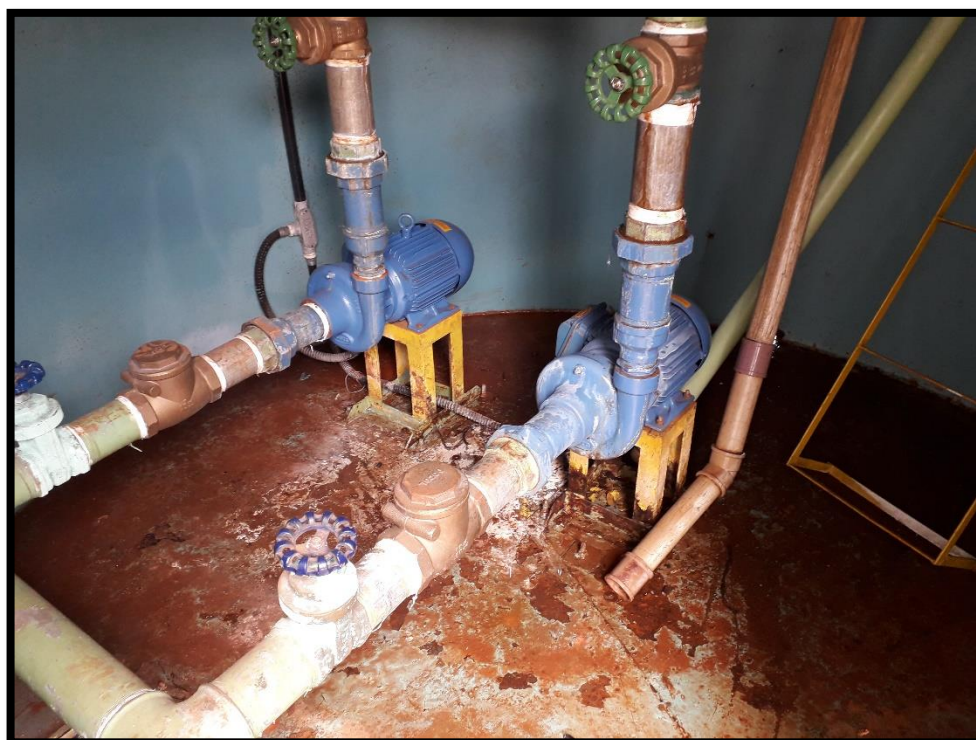
Imagem 22: Conjunto moto bombas do Sistema Americana
