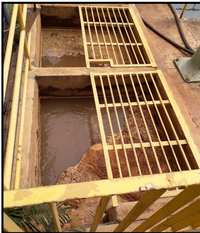
Imagem 13: Câmara de floculação da ETA
