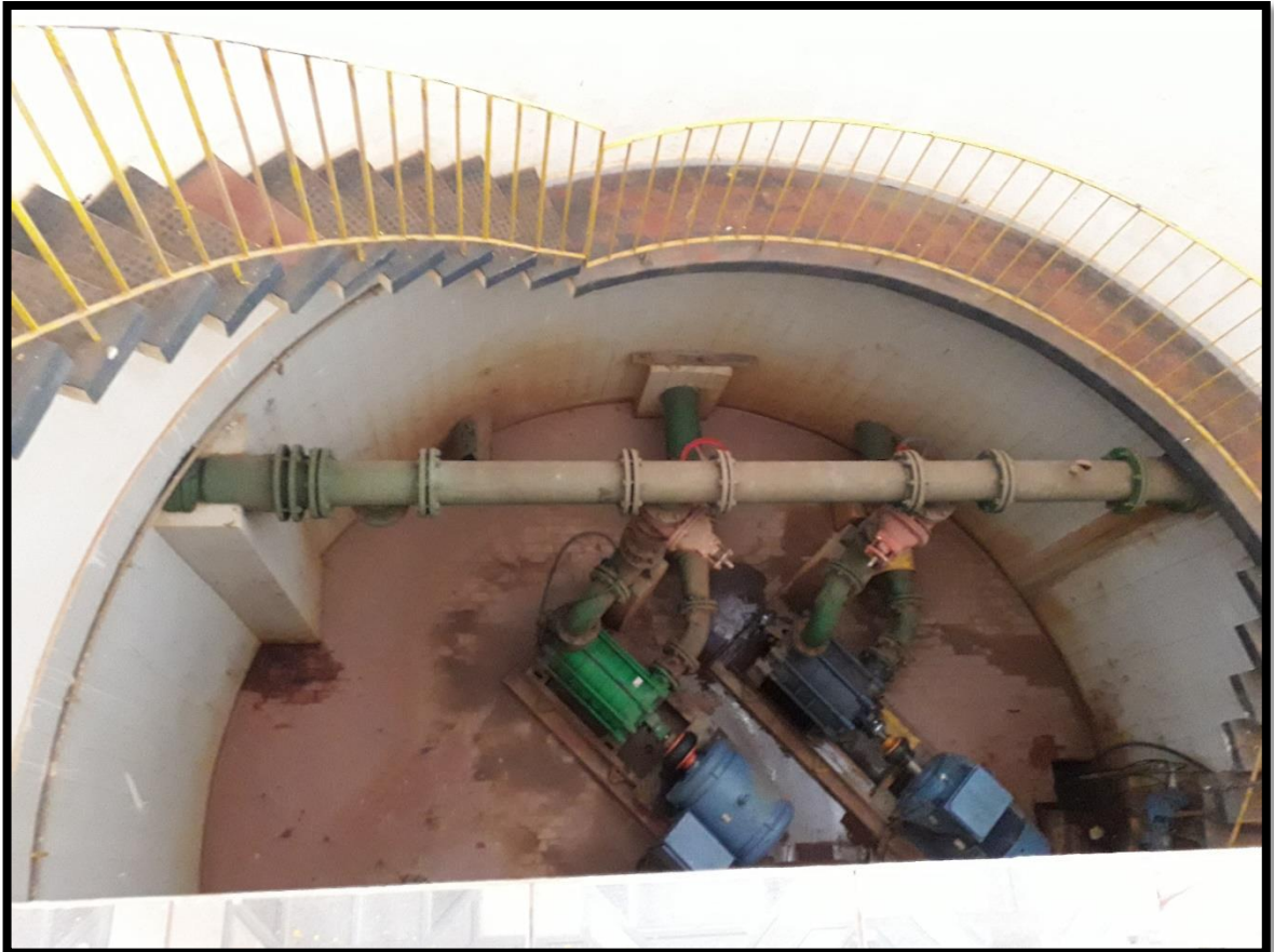
Imagem 5: Casa de bombas de captação superficial no Rio das Cinzas 2
