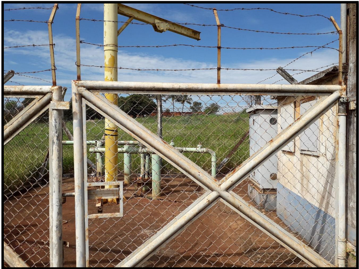
Imagem 11: Estação Elevatória de água tratada que recalca para o Jardim Tiburi
