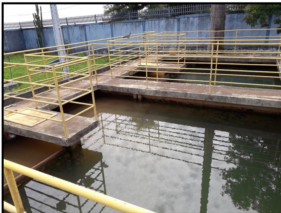
Imagem 14: Câmara de decantação da ETA
