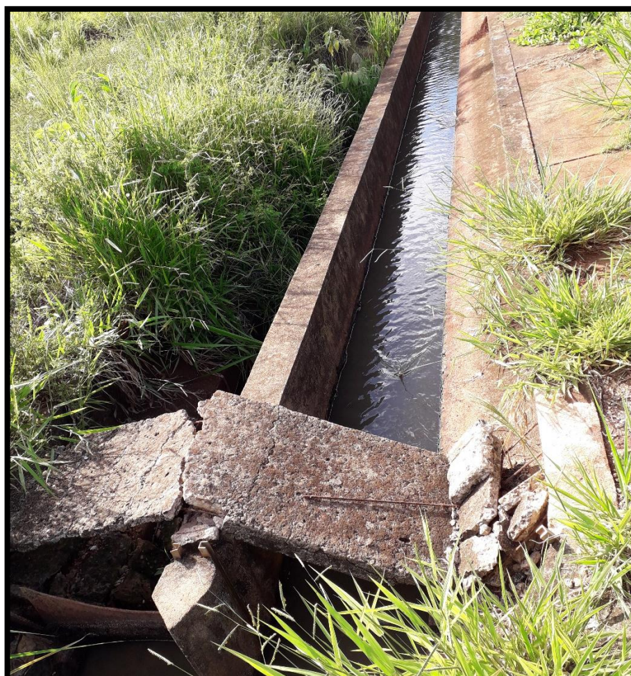
Imagem 31: ETE Barreiro - Caixa de areia
