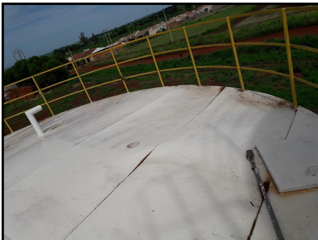
Imagem 20: Abertura de inspeção e respiro do reservatório apoiado do Jardim Tiburi
