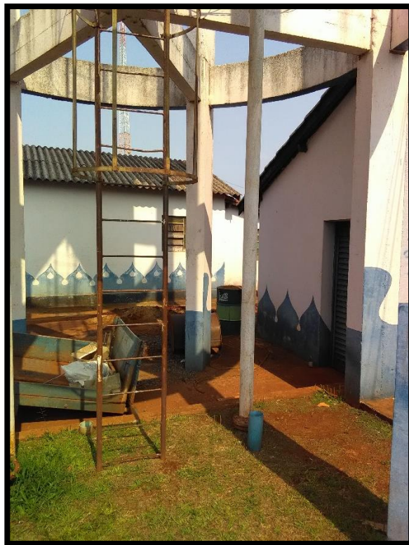
Imagem 18: Reservatório elevado – instalação e escada fixa
