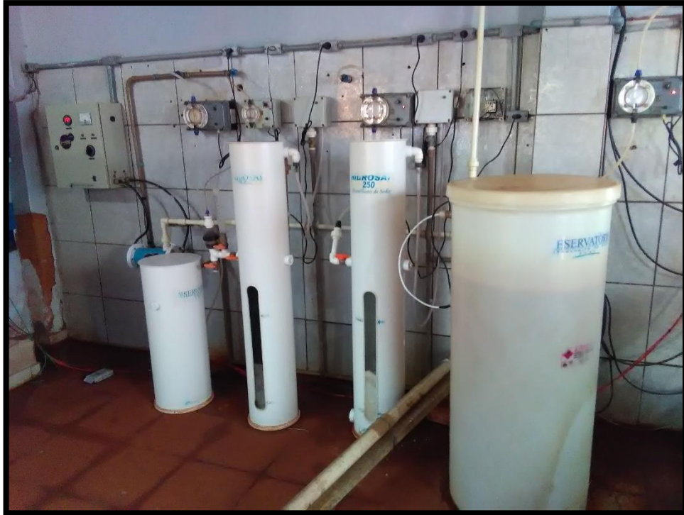
Imagem 14: Unidade de tratamento de água – Dosadoras e reservatórios
