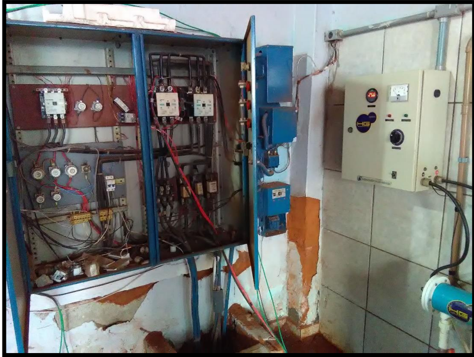
Imagem 12: Quadros de comando
