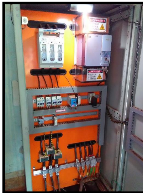
Imagem 5: 1° Poço – Quadro de Comando
