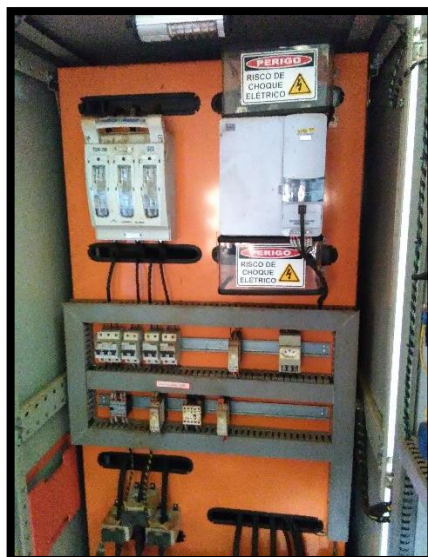
Imagem 7: 2° Poço – Quadro de Comando
