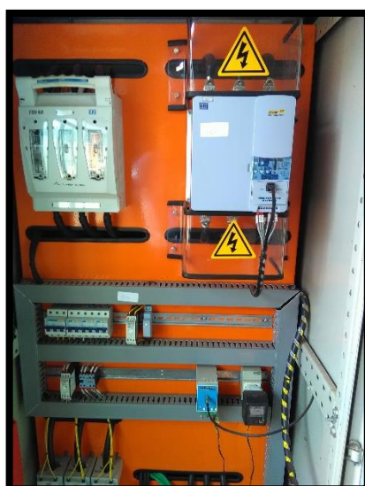
Imagem 9: Poço da Rua José Reno de Andrade – Quadro de Comando
