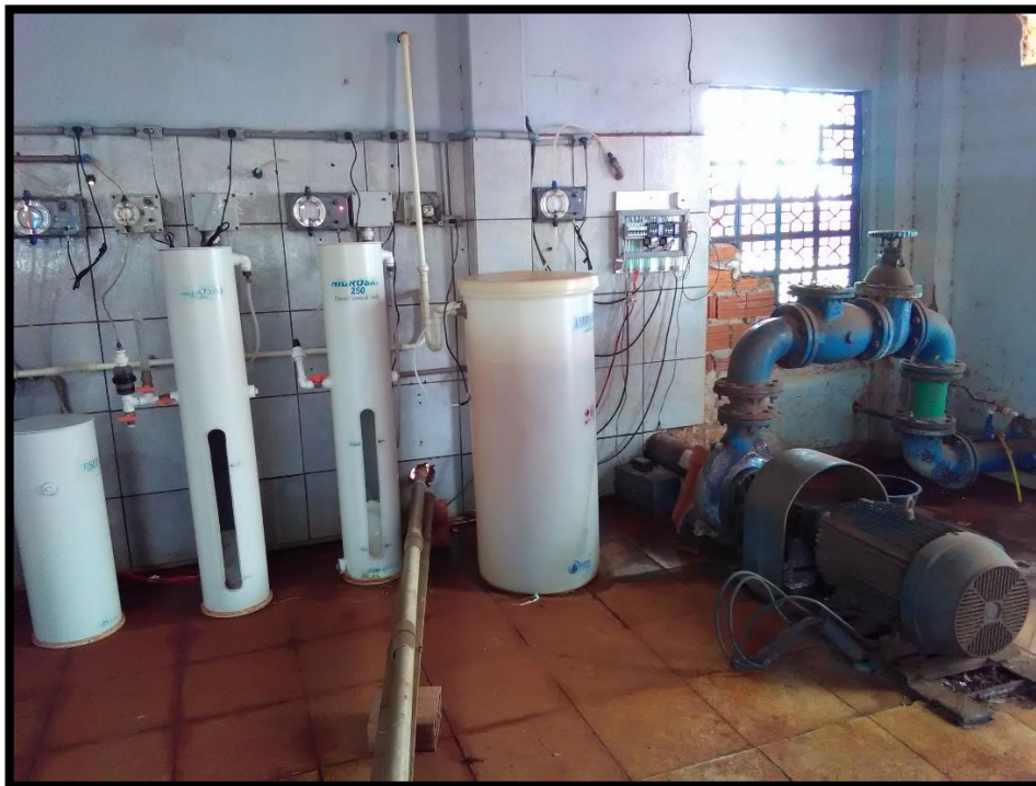
Imagem 15: Unidade de tratamento de água – Dosadoras e reservatórios junto a estação elevatória
