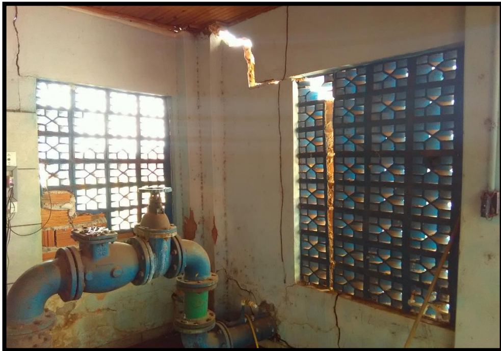
Imagem 13: Rachadura excessiva na parede
