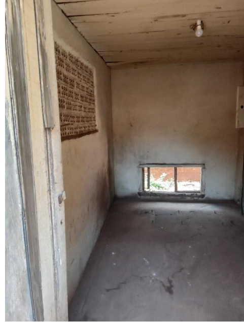
Foto 28 – Interior da casa de comando
