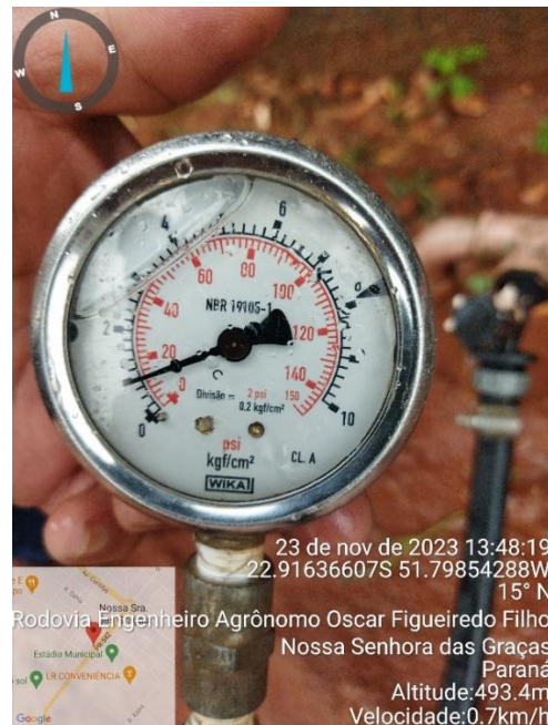
Foto 71 - Medição de pressão do ponto 03
