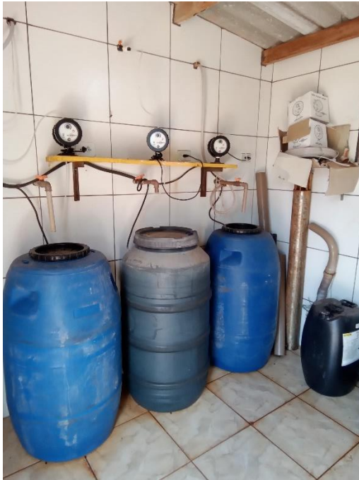
Foto 59 – Dosadoras e tanques de diluição
