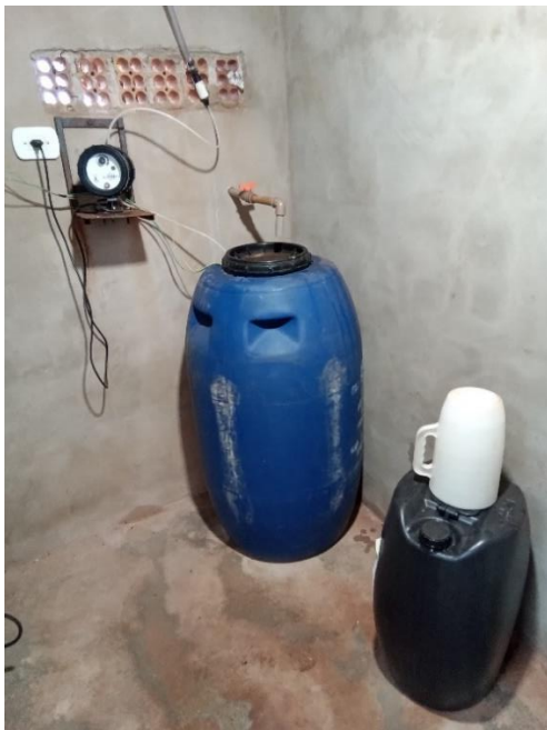
Foto 62 – Dosadoras e tanques de diluição
