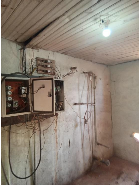
Foto 27 – Interior da casa de comando
