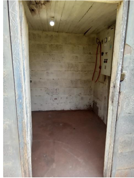
Foto 21 – Interior da casa de comando
