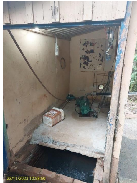
Foto 44 – Interior da casa de comando
