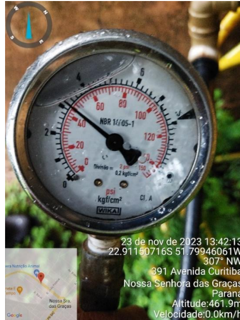
Foto 69 - Medição de pressão do ponto 02
