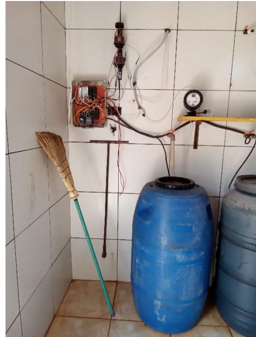
Foto 60 – Quadro de comando
