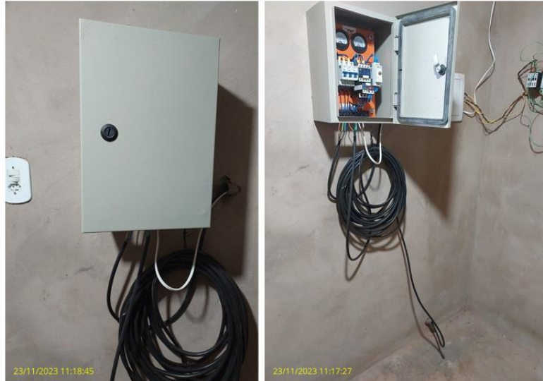
Foto 39 – Quadro de comando (fechado/aberto)
