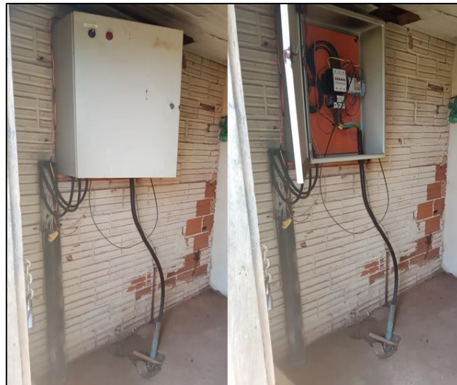
Foto 15 – Quadro de comando (fechado/aberto)
