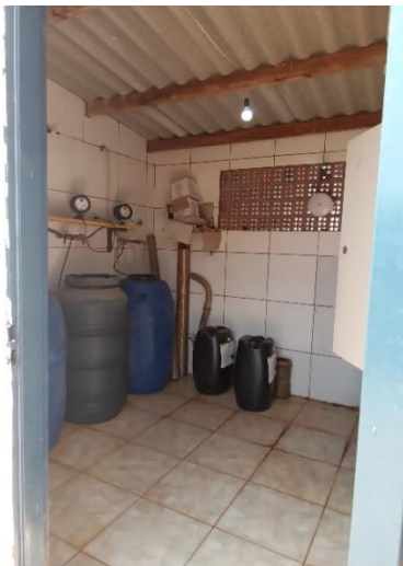
Foto 33 – Interior da casa de comando
