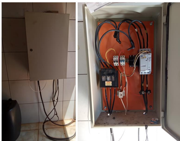
Foto 34 – Quadro de comando (fechado/aberto)
