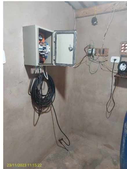
Foto 38 – Interior da casa de comando
