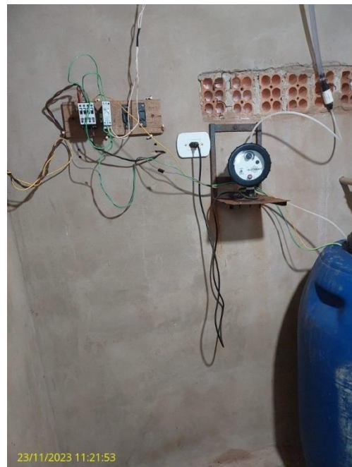
Foto 63 – Quadro de comando
