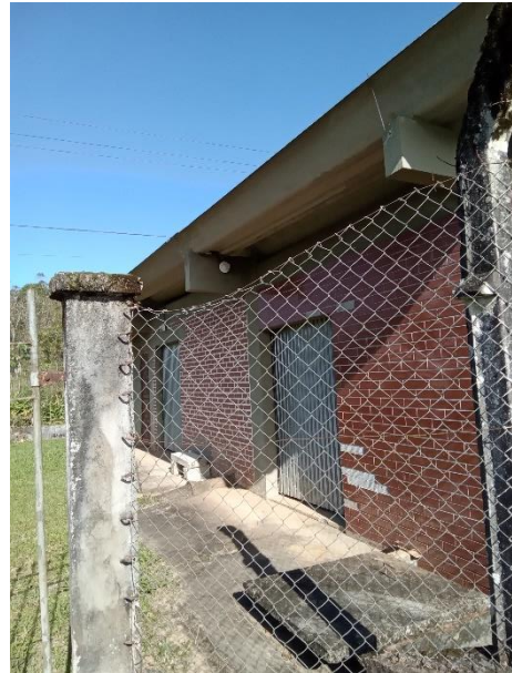
Foto 76 – Falta de identificação das unidades (casa de comando/elevatória) – EEA Rios
