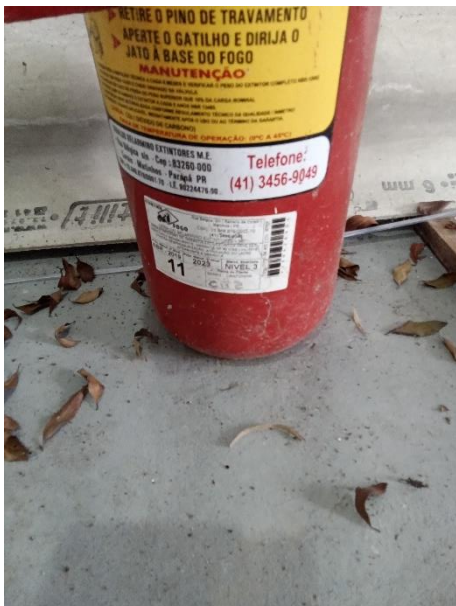
Foto 113 – Extintor EEA 02 vencido (abril/2023)
