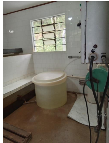
Foto 36 – Tanque De cloro UTA Itapema
