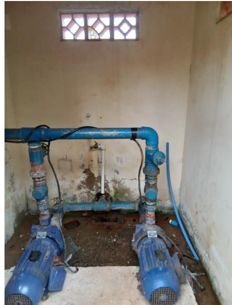
Foto 104 – Espaço interno inadequado para operador EEA 05
