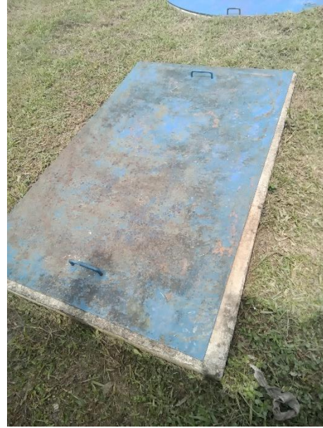
Foto 132– Tampa elevatória ETE
