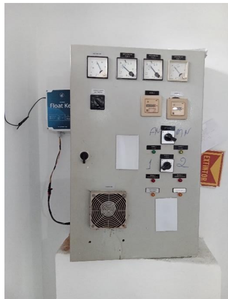
Foto 114 – Frente do quadro de comando EEA 02
