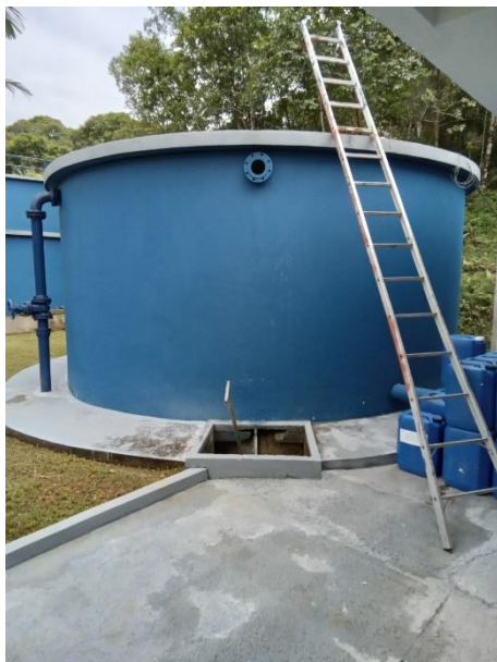
Foto 61- RAP1 ETA Itapema (extravasador sem tela)
