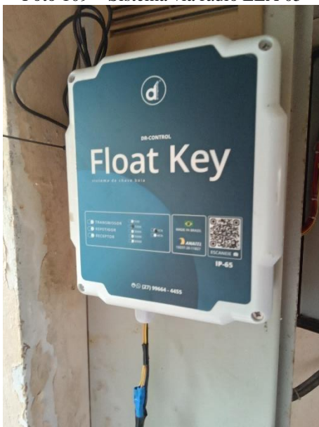
Foto 109 – Sistema via rádio EEA 05
