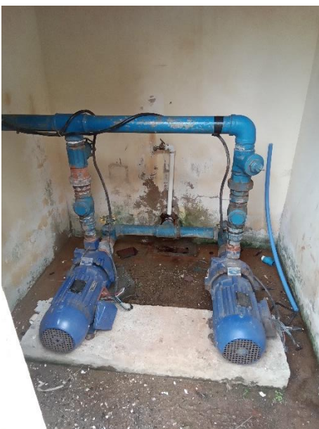
Foto 105 – Conjunto moto bomba EEA 05
