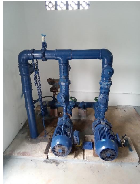
Foto 112 – Conjunto moto bomba EEA 02
