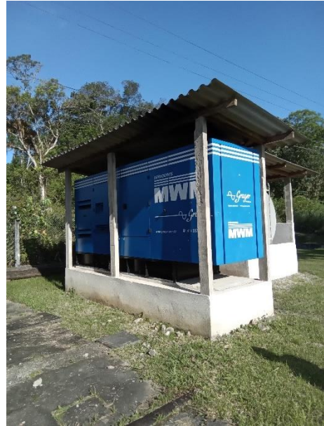
Foto 84 – Gerador EEA Rios
