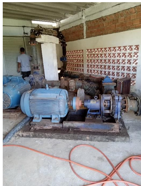
Foto 78 – Conjunto Moto Bomba – EEA Rios
