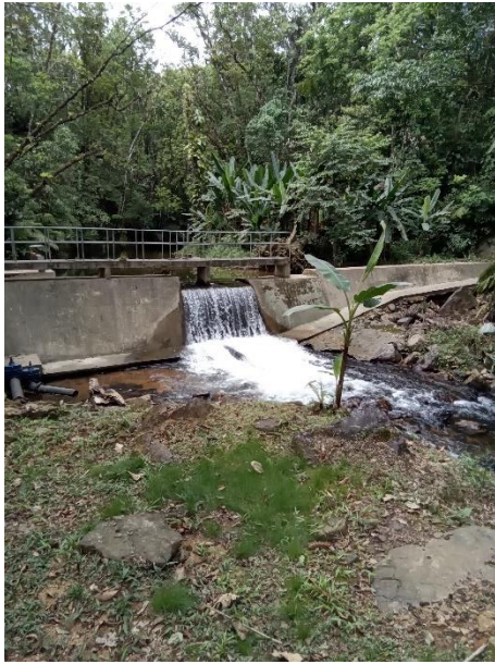
Foto 17 – Barragem de nível captação rio Xaxim
