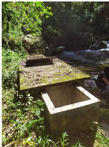
Foto 30 – Captação rio Cotia
