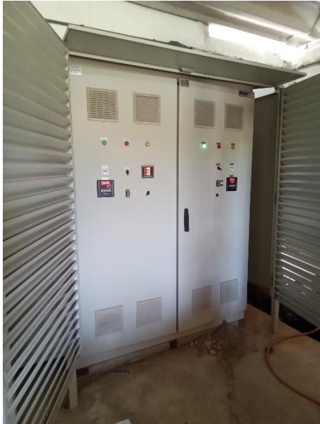
Foto 79 – Frente do quadro de comando – EEA Rios
