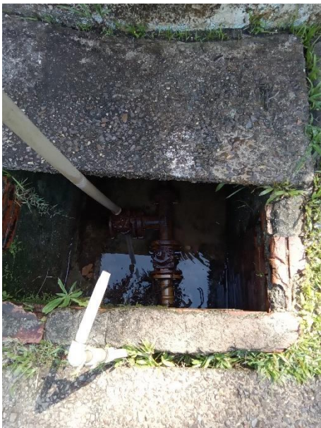
Foto 57 – Registros RAP Bairro Alto com vazamentos
