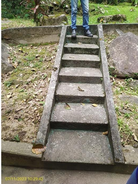
Foto 21 – Falta de corrimões e guarda corpos captação rio Jantador
