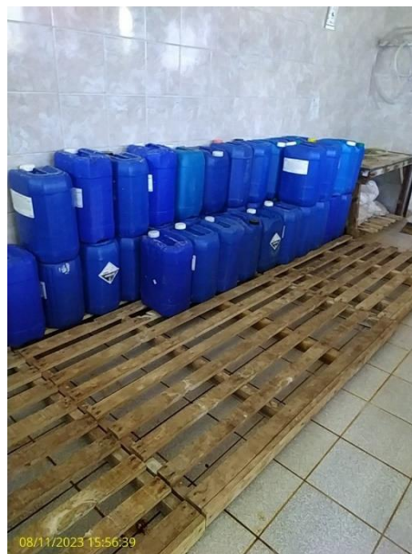
Foto 46 – Depósito produtos químicos (cloro) UTA Central
