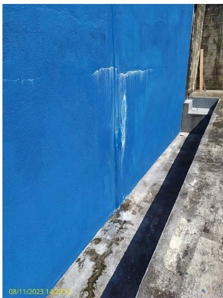
Foto 69 – Problemas de impermeabilização em vários pontos RESENT Itapema
