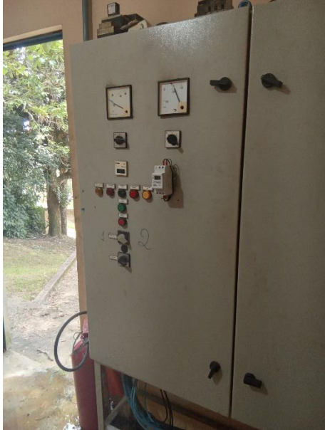
Foto 119 – Frente do quadro de comando EEA 06 -lado esquerdo
