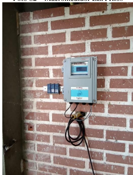
Foto 82 – Macromedidor EEA Rios
