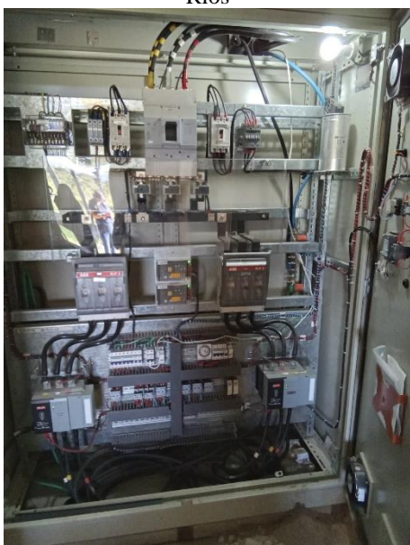
Foto 81 – Lado direito quadro de comando EEA Rios
