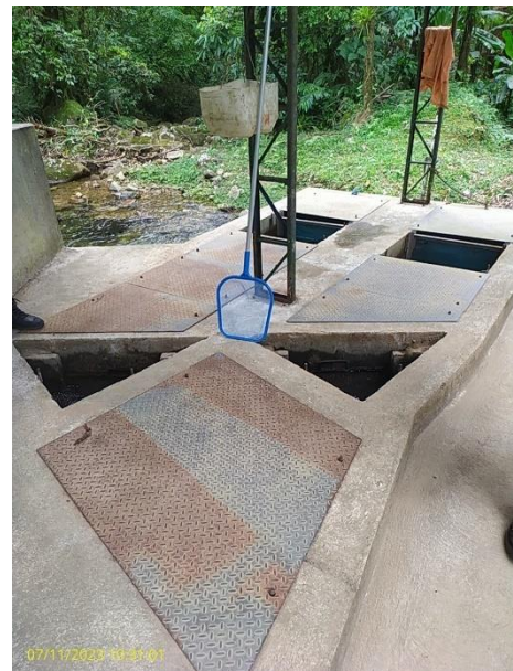
Foto 20 – Captação rio Jantador
