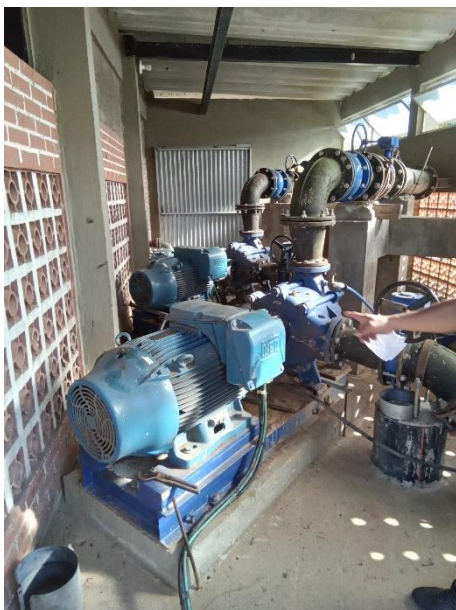
Foto 77 – Elevatória (casa de bombas) – EEA Rios
