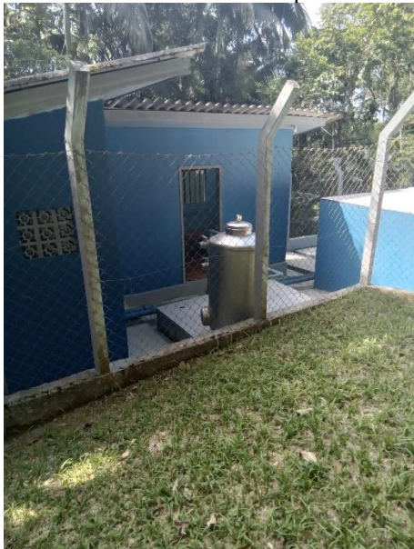
Foto 51 – Filtro ETA Itapema 2
