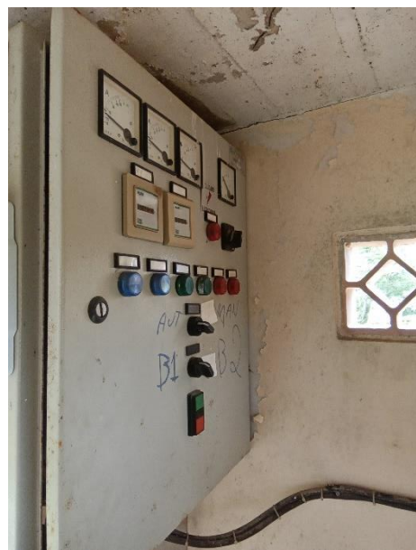
Foto 106 – Frente do quadro de comando EEA 05
