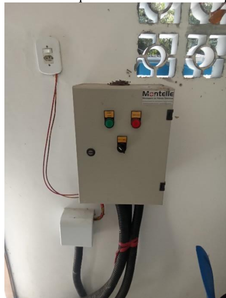
Foto 86 – Frente do quadro de comando EEA Itapema 2
