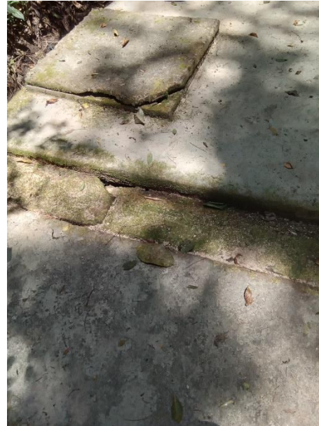
Foto 64 – Tampa reservatório captação Matarazzo
