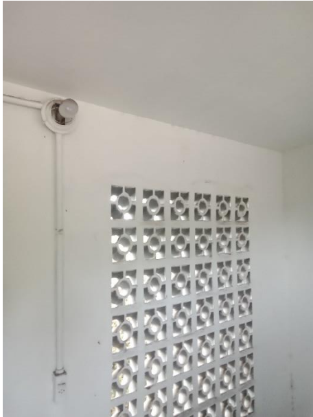
Foto 95 – Iluminação EEA 03 – sem tela mosquiteira
