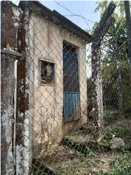
Foto 103 – Falta de manutenção EEA 05
