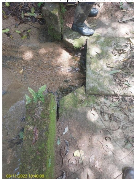
Foto 27 – Desarenador Captação Matarazzo (sem tela)
