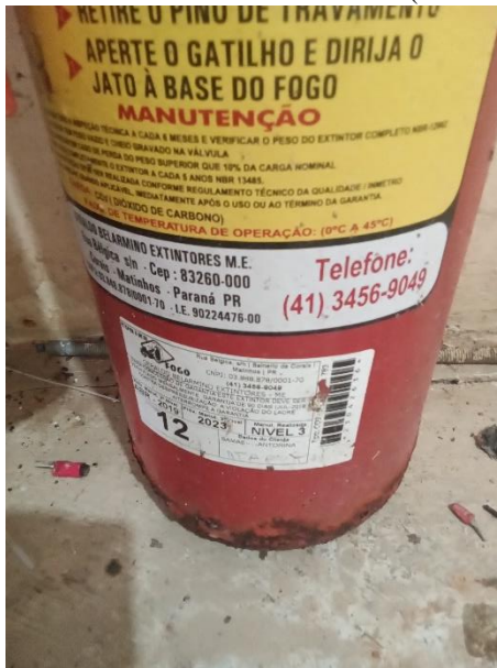
Foto 123 – Extintor vencido EEA 06 (abril/2023)
