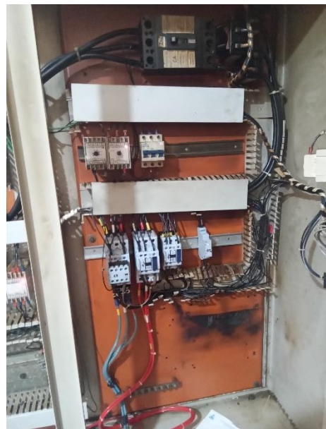
Foto 122 – Quadro de comando lado direito EEA 06
