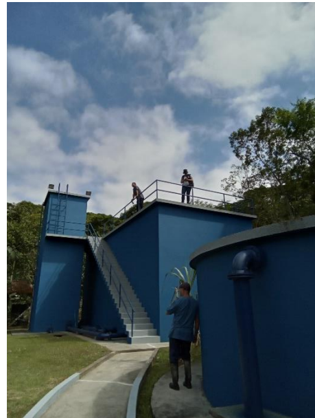
Foto 50 – Escada de acesso filtros e estrutura (filtros). Local inadequado escada acesso a caixa elevada – ETA Itapema
