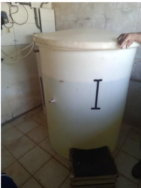
Foto 45 – Tanque de cloro UTA Central
