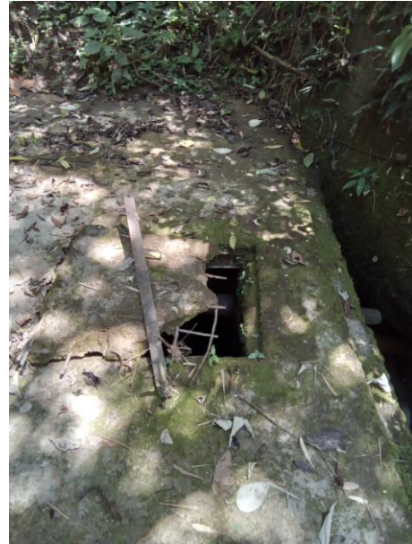
Foto 29 – Tampas da caixa captação Maurício
