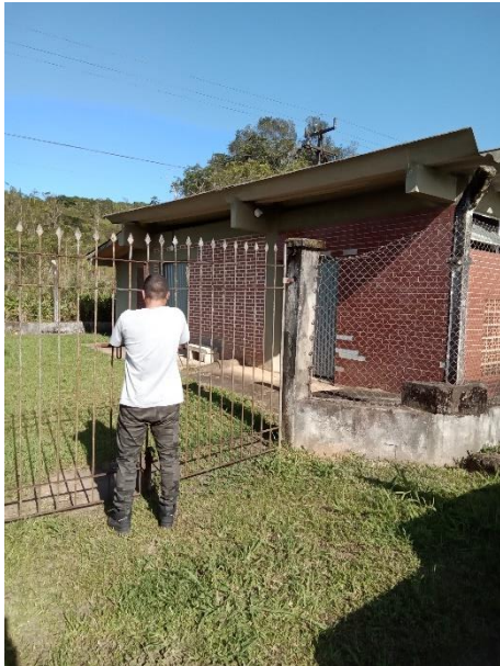
Foto 75 – Falta de identificação EEA Rios (acesso restrito/SAMAE)
