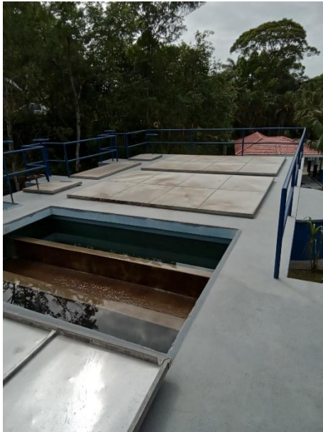
Foto 49 – Filtros de fluxo ascendente (ETA Itapema)
