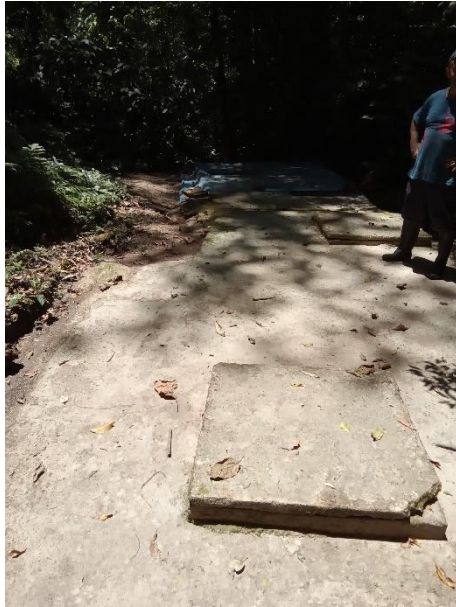
Foto 63 – Reservatório Captação Matarazzo
