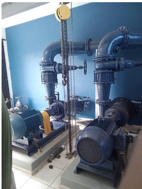
Foto 89 – Conjunto moto bomba ETA Central (para lavagem dos filtros)
