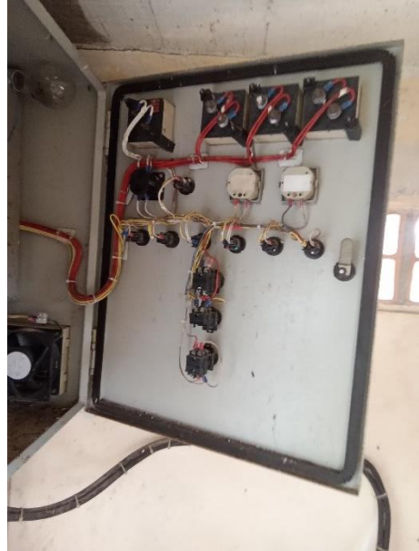
Foto 108 – Quadro de comando EEA 05 – foto 02
