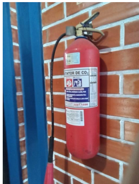
Foto 90 – Extintor ETA Central – próximo quadro conjunto moto bomba ETA Central
