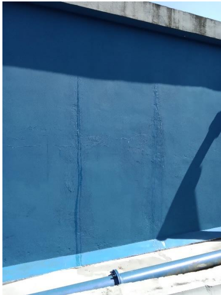
Foto 67 – Problemas impermeabilização RESENT Itapema
