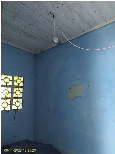
Foto 43 – Falta de tela abertura e iluminação UTA Itapema 2
