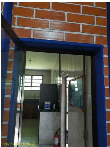
Foto 125 – Falta de identificação
