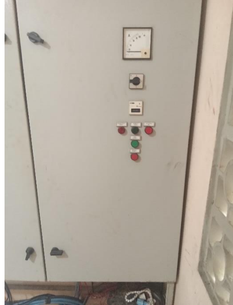
Foto 120 – Frente quadro de comando EEA 06 – lado direito
