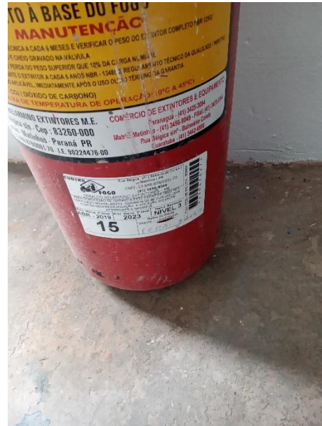
Foto 100 – Extintor EEA 04 (validade abril/2023 – vencido)
