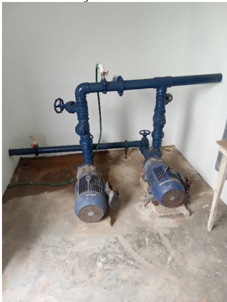
Foto 101 – Conjunto moto bomba EEA 04
