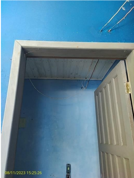
Foto 41 – Falta de identificação UTA Itapema 2
