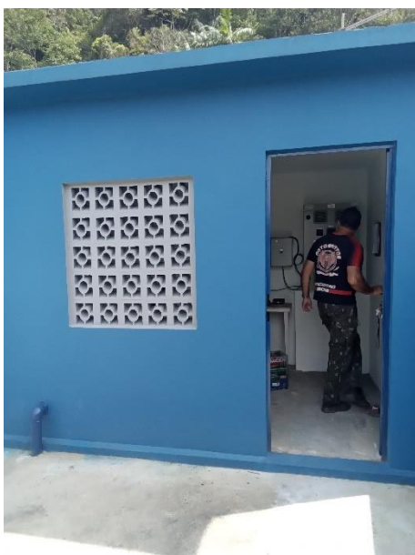
Foto 97 – EEA 04 – falta identificação
