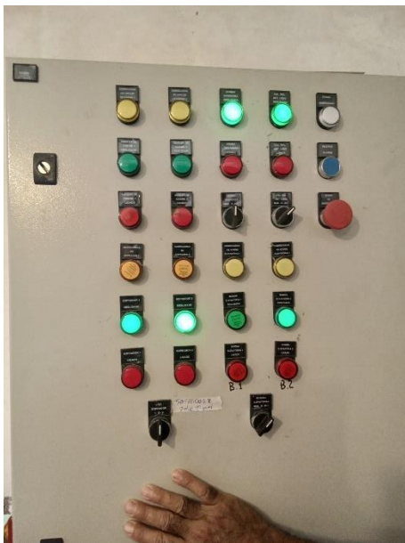
Foto 137 – Frente do quadro de comando
