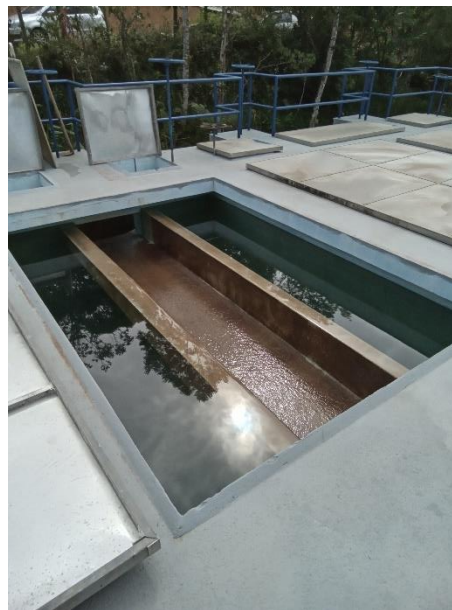
Foto 48 – Filtro de fluxo ascendente (ETA Itapema)
