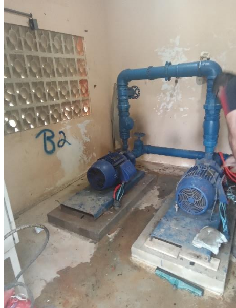
Foto 118 – Conjunto moto bomba EEA 06
