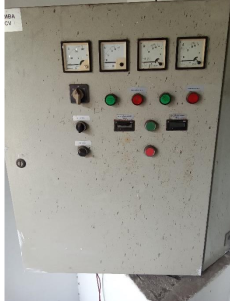
Foto 92 – Frente do quadro de comando EEA 03
