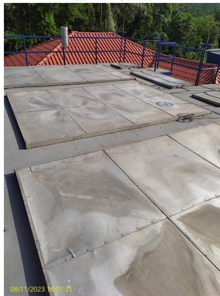
Foto 54 – Tampas filtros (cinco) do tipo ascendente da ETA Central
