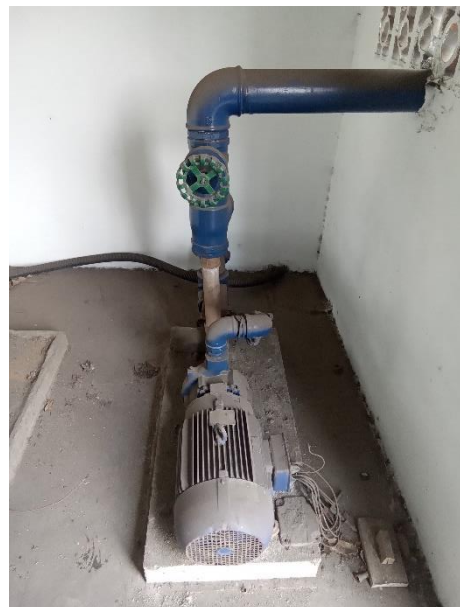
Foto 94 – Conjunto moto bomba EEA 03 – faltou bomba reserva. Falta de limpeza
