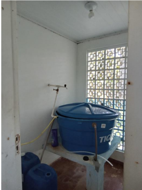
Foto 33 – UTA Bairro Alto (tanque de cloro)
