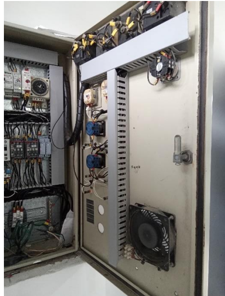
Foto 116 – Quadro de comando EEA 02 – foto 02
