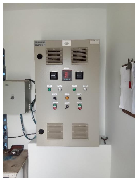
Foto 98 – Frente do quadro de comando EEA 04
