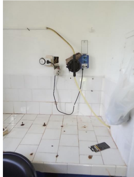
Foto 34 – Bomba dosadora UTA Bairro Alto
