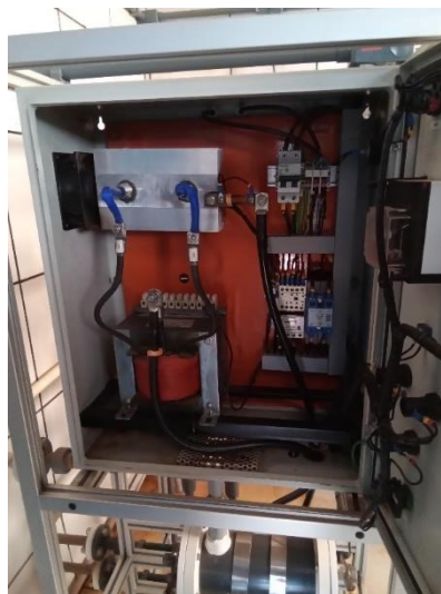
Foto 33 – Quadro de comando aberto
