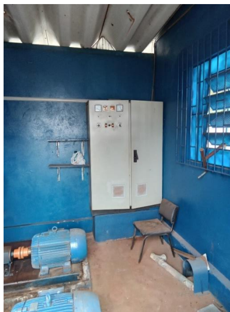
Foto 60 – Quadro de comando
