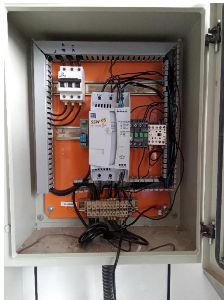
Foto 54 – Quadro de comando da autgomação
