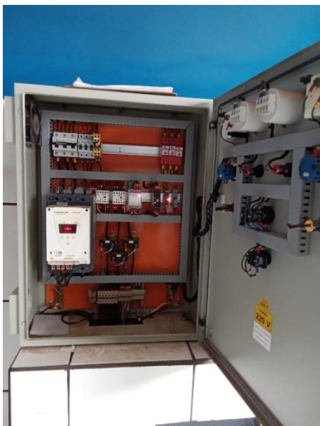
Foto 51 – Quadro de comando EEA
