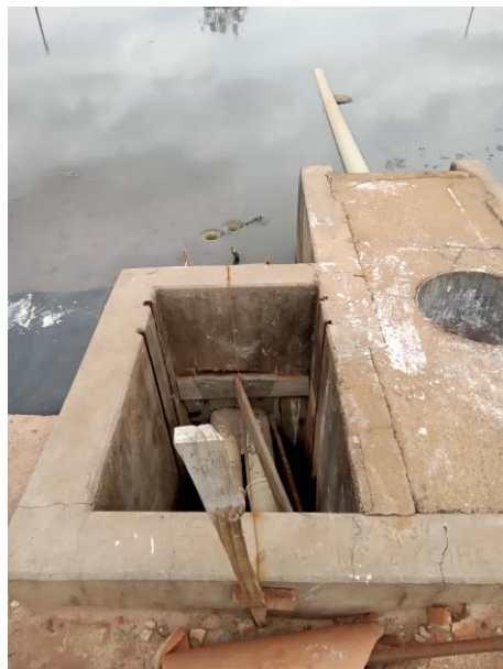
Foto 82 – Entrada lagoa anaeróbia 02
