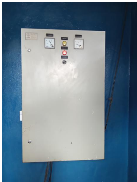
Foto 18 – Quadro de comando
