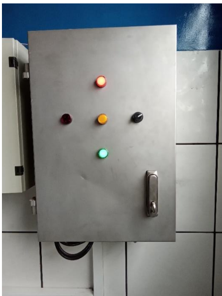
Foto 53 – Frente do quadro da automação
