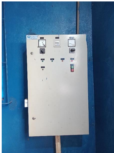
Foto 24 – Frente do quadro de comando poço 7
