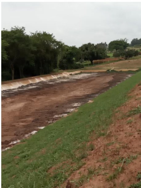
Foto 84 – Lagoa facultativa em manutenção
