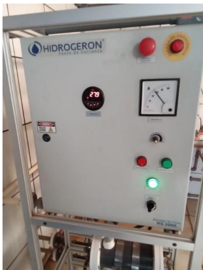
Foto 32 – Quadro de comando
