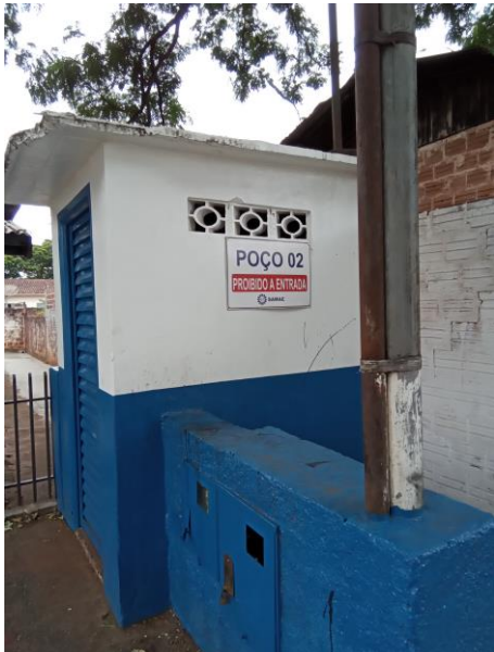
Foto 16 – Identificação do Poço/ casa de comando
