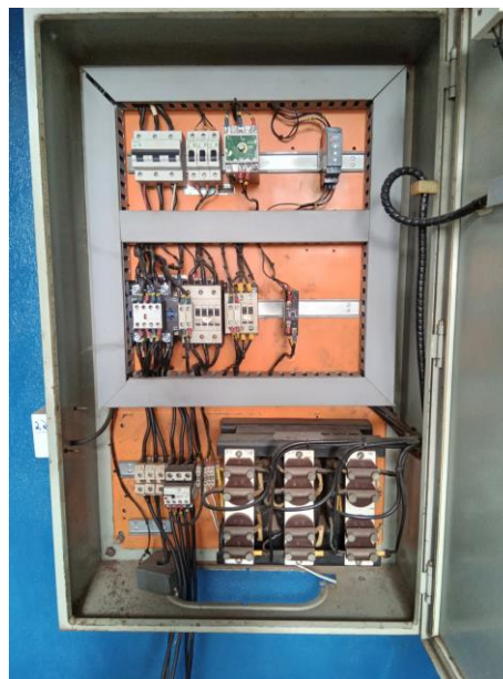
Foto 19 – Quadro de comando aberto
