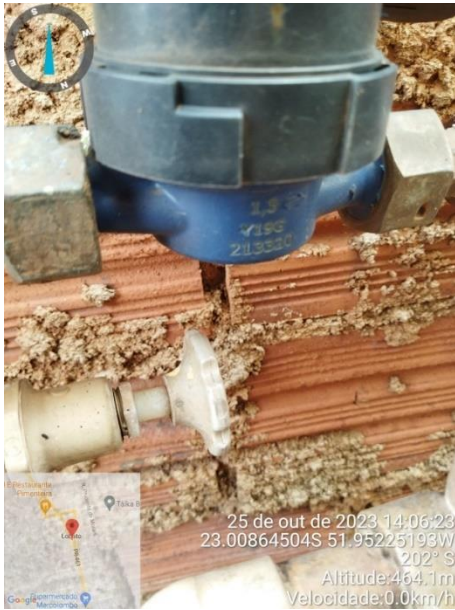
Foto 61 – Identificação hidrômetro P01
