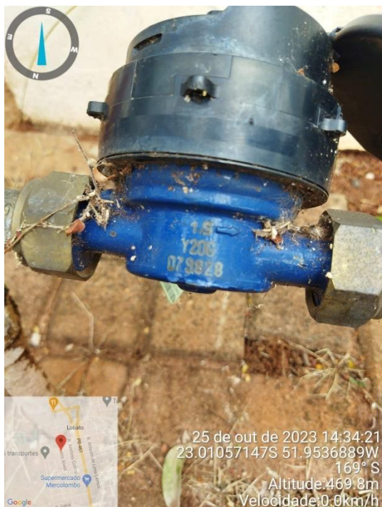
Foto 65 – Identificação hidrômetro P03
