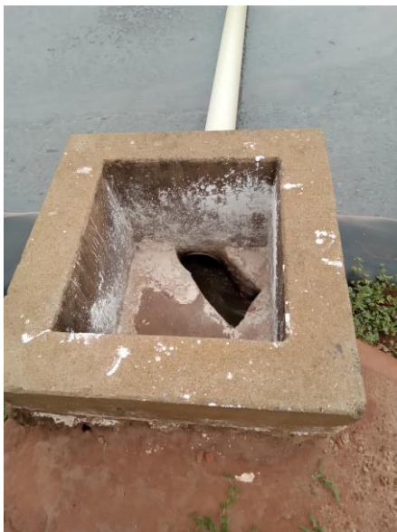
Foto 79 – Saída lagoa anaeróbia 01
