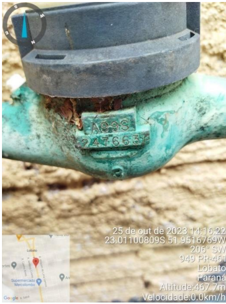
Foto 63 – Identificação hidrômetro P02 (2009)
