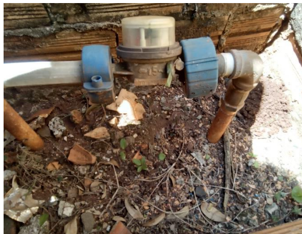
Foto 83 - Identificação hidrômetro P03
