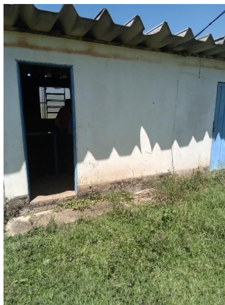
Foto 130 – Falta de identificação casa de comando EE esgoto distrito
