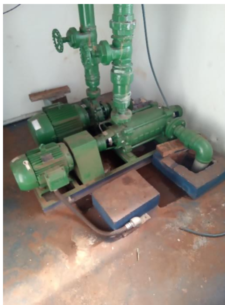
Foto 47 – Conjunto motobomba EAT 03
