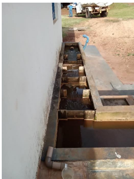
Foto 48 – Entrada de água bruta
