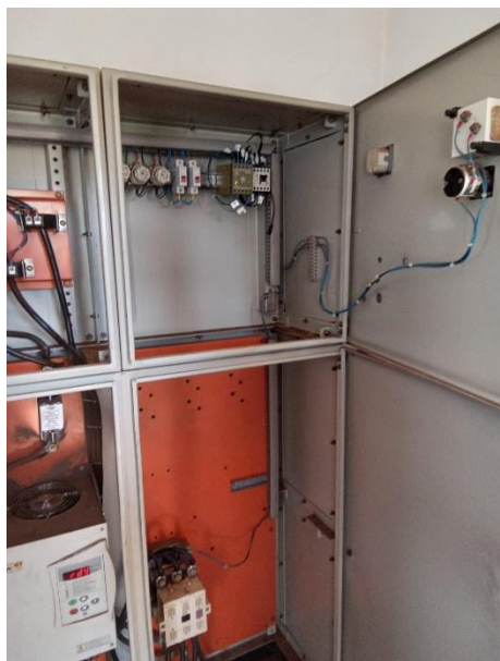
Foto 39 – Quadro de comando lado esquerdo EAB02
