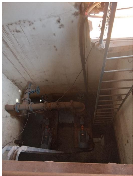
Foto 125 – Conjunto motobomba EE esgoto sede
