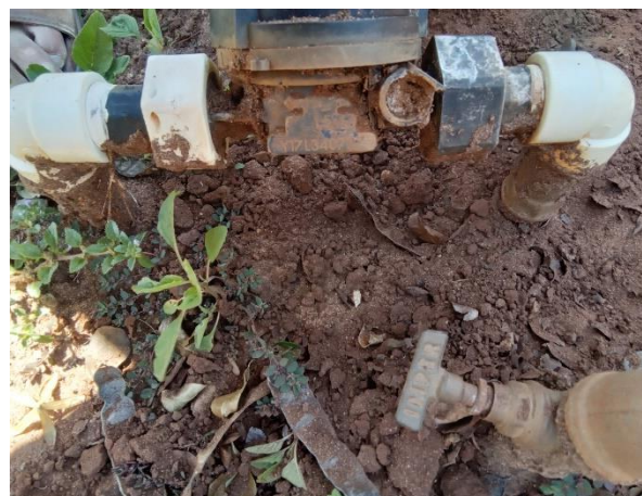
Foto 80 - Identificação hidrômetro P02
