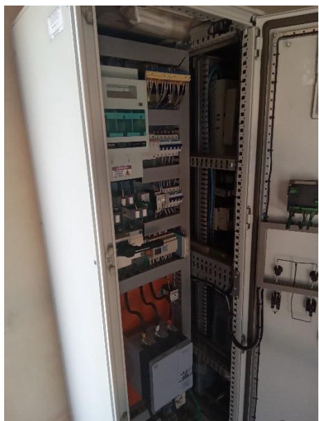
Foto 127 – Quadro de comando lado esquerdo EE esgoto sede
