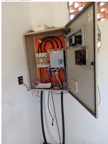
Foto 23 – Quadro de comando poço Araucária
