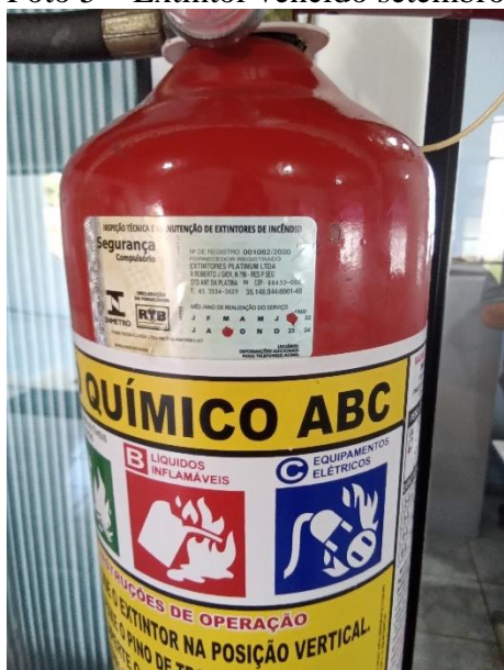
Foto 5 – Extintor vencido setembro/2022
