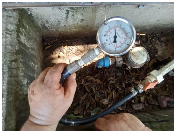
Foto 78 – P02 - Medição pressão na rede P01 = 46.00 mca
