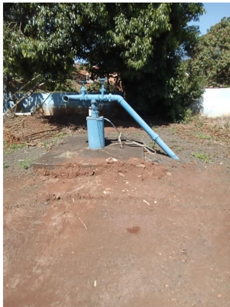
Foto 16 – Poço Garça 2 (poço 2)
