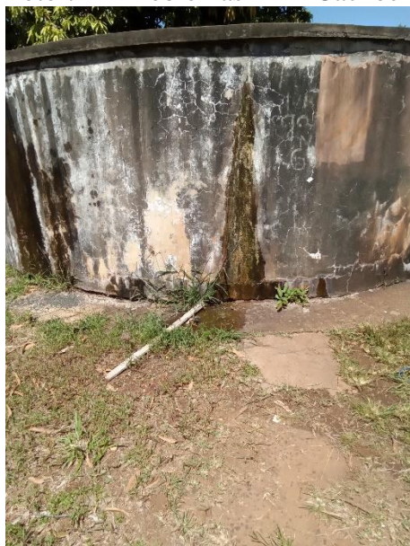
Foto 71 – Problemas RAP Cachoeira
