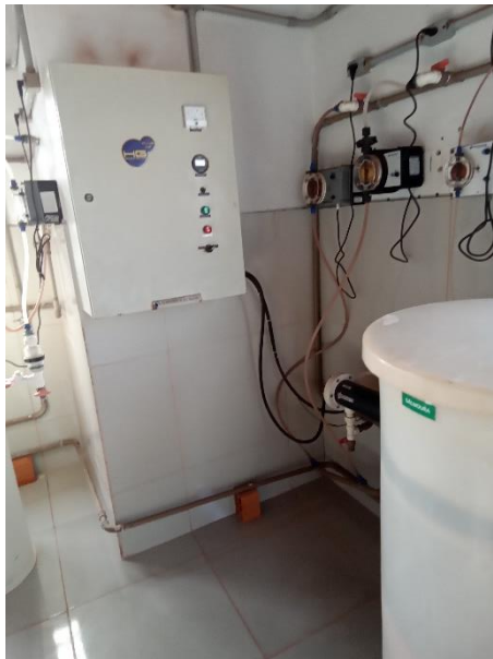
Foto 52 – Bombas dosadoras e reservatórios de cloro e flúor
