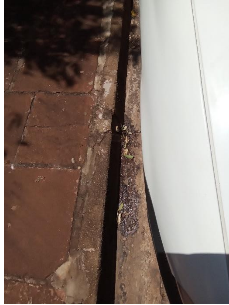
Foto 86 – Saída de água (descarga)
