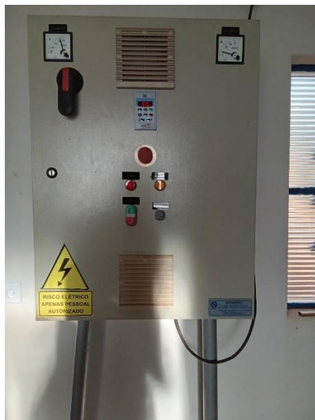
Foto 48 – Frente quadro de comando EAT03
