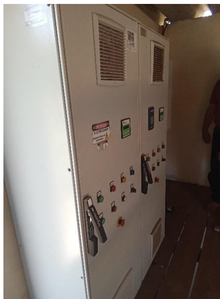
Foto 126 – Frente do quadro de comando EE esgoto sede
