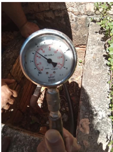
Foto 84 – Hidrômetro P03 – P = 48.00 mca
