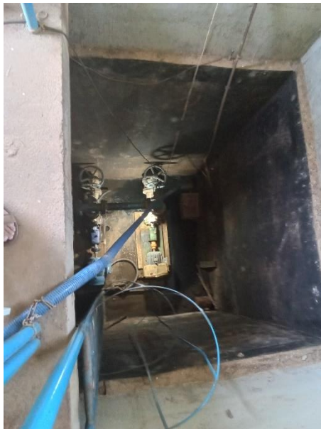
Foto 131 – Conjunto motobomba EE esgoto distrito Cachoeira
