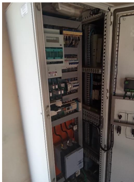
Foto 128 – Quadro de comando lado direito EE esgoto sede
