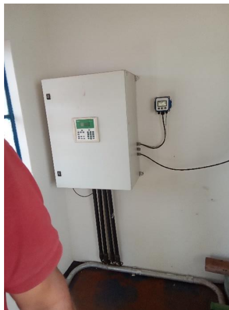
Foto 49 – Telemetria não está funcionando
