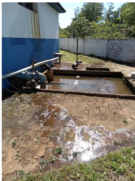
Foto 29 – Poço de sucção EAB01 e caixa de areia
