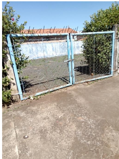
Foto 17 – Falta de identificação poço Garça 1
