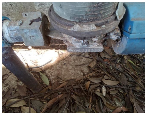
Foto 77 - Identificação hidrômetro P01
