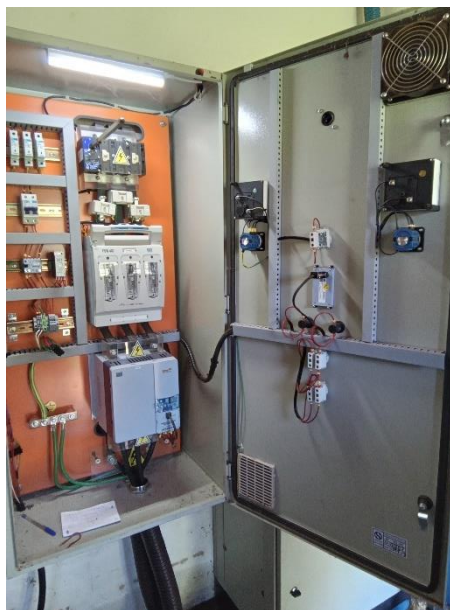
Foto 34 – Quadro de comando 02 EAB01
