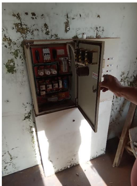
Foto 45 – Quadro de comando EAT 01 (lado esquerdo)
