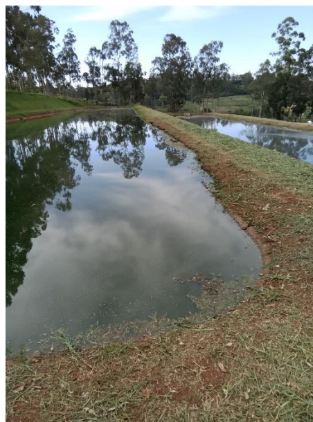
Foto 95 – Talude lagoa anaeróbia 01 danificada
