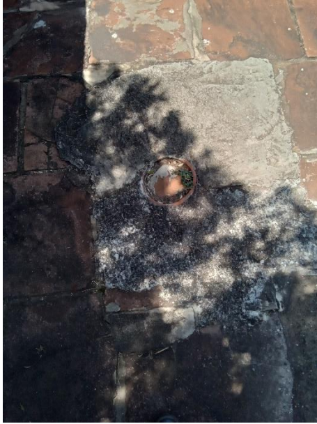
Foto 85 – Ponto de rede (descarga) -
