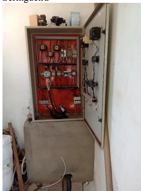
Foto 26 – Quadro de comando poço Seringueira
