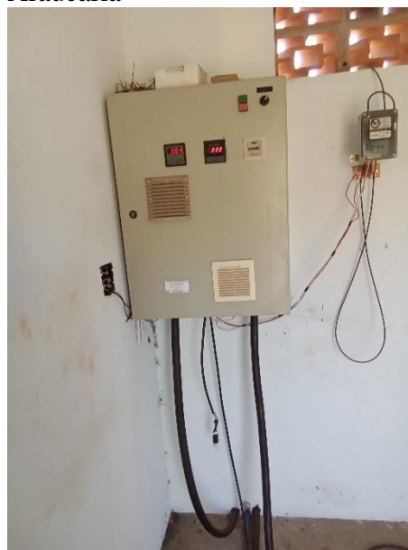
Foto 22 – Frente do quadro de comando poço Araucária
