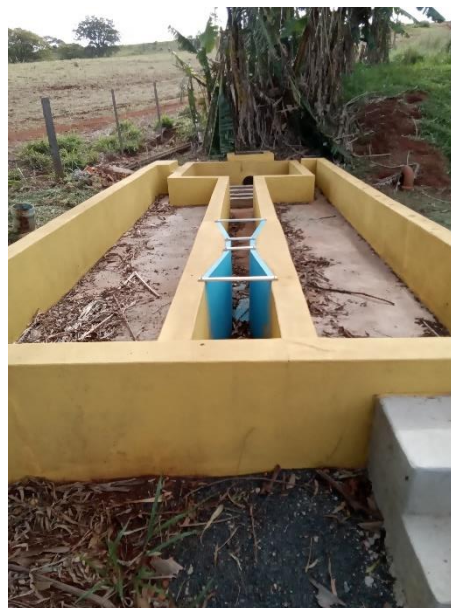
Foto 93 – Medidor de vazão e caixa de areia na entrada (ainda não operante)
