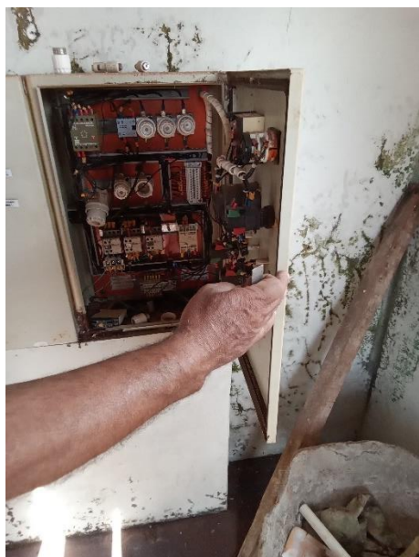
Foto 44 – Quadro de comando EAT01 (lado direito)
