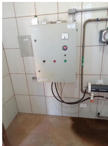
Foto 54 – Frente quadro de comando UTA Araucária
