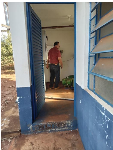
Foto 46 – Falta de identificação EAT03
