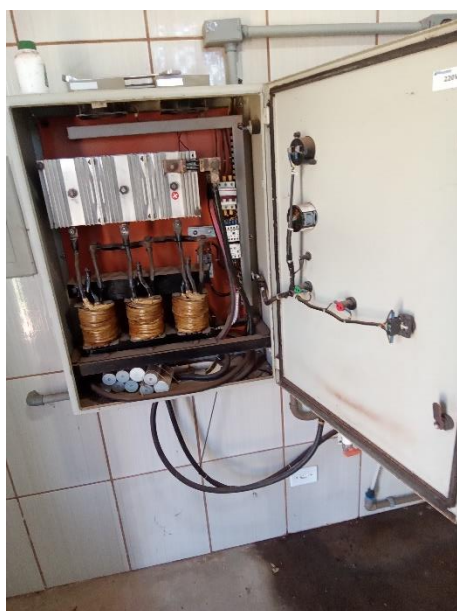
Foto 55 – Quadro de comando UTA Araucária
