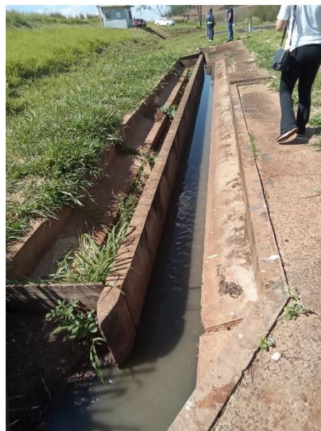
Foto 117 – Caixa de areia ETE Barreirão
