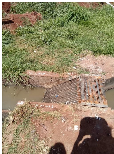
Foto 108 – Gradeamento ETE Antas
