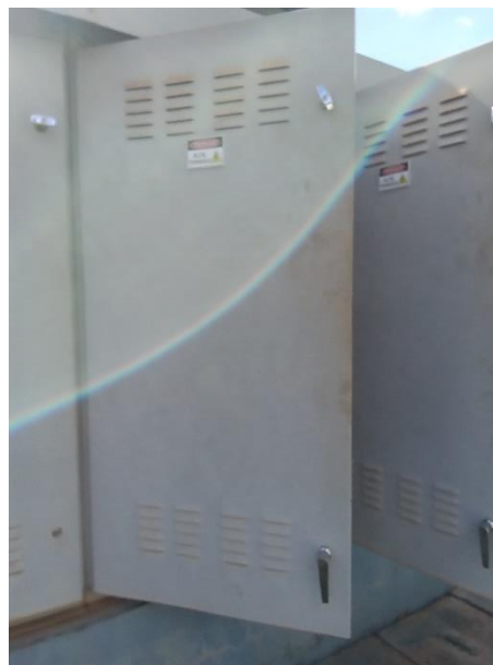
Foto 46 – Casa de comando EAB01
