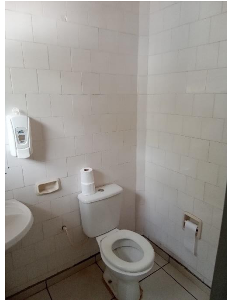
Foto 6 – Falta de acessibilidade bwc
