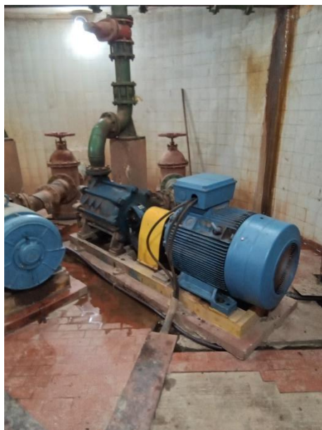
Foto 45 – Conjunto motobomba EAB01
