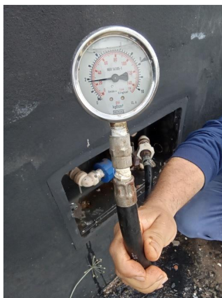
Foto 89 – P02 - Medição pressão na rede P01 = 26.00 mca
