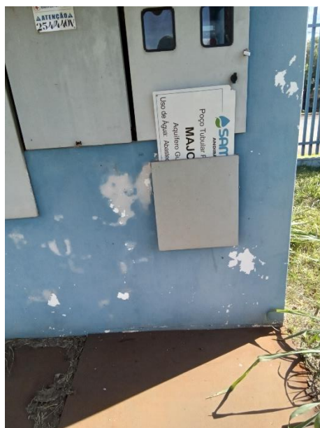
Foto 27 – Falta de identificação (placa não colocada no local devido)
