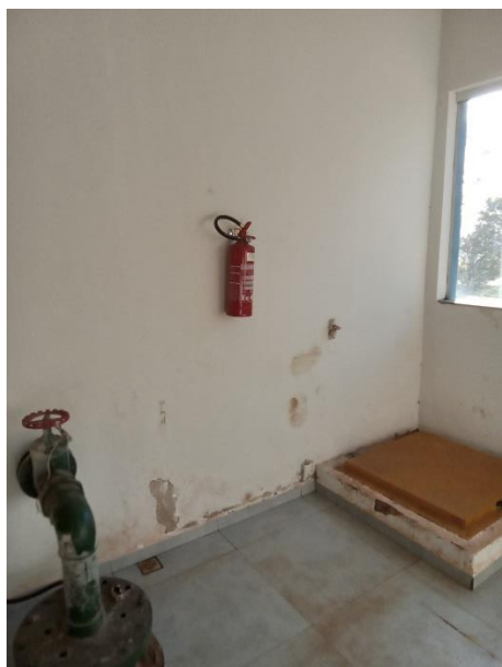
Foto 54 – Extintor casa de comando ETA
