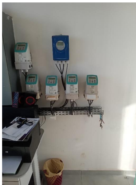
Foto 55 – Medidores de vazão
