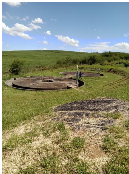
Foto 115 – Reatores anaeróbios ETE Barreirão
