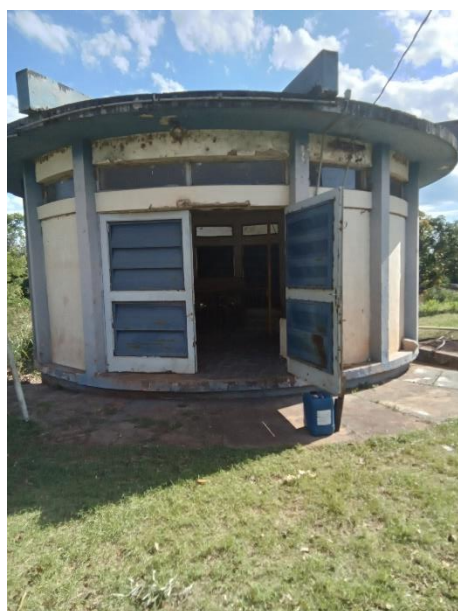
Foto 43 – Falta de identificação EAB01
