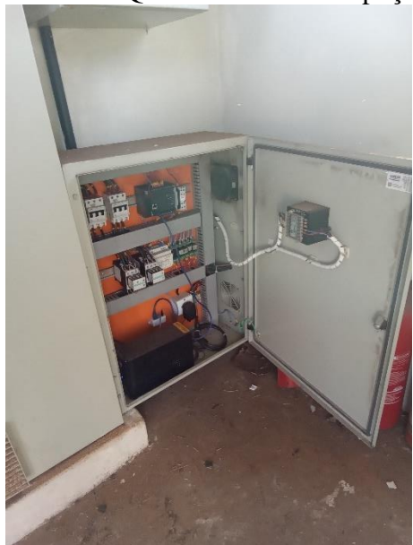
Foto 33 – Quadro de comando poço Major
