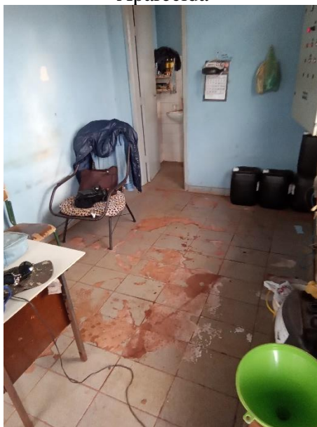
Foto 37 – Necessidade de reforma casa de comando poço Patrimonio Nossa Senhora de Aparecida
