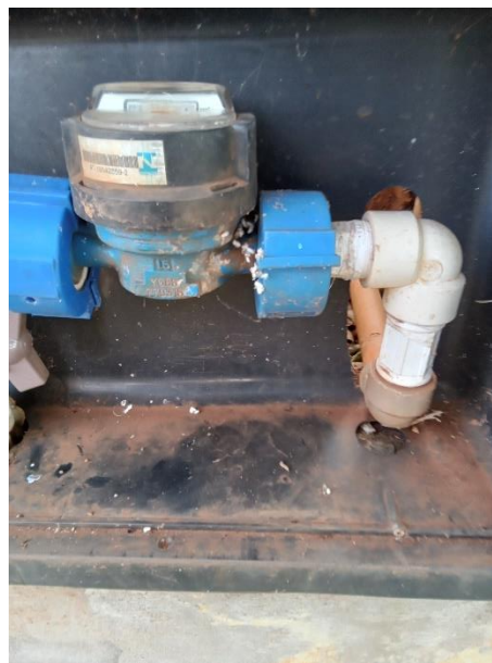
Foto 91 - Identificação hidrômetro P02
