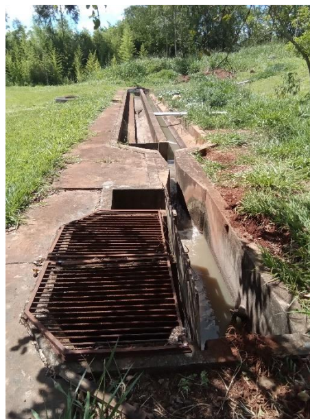
Foto 110 – Calha Parshall ETE Antas
