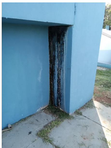
Foto 58 – Indício de vazamento flocladores
