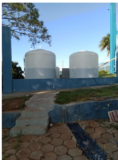
Foto 59 – Reservatório de flúor e cloro
