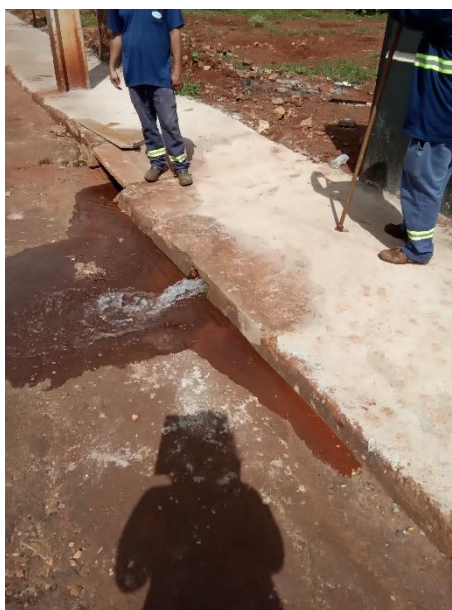
Foto 96 – Ponto de rede (descarga)
