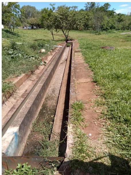
Foto 109 – Caixa de areia ETE Antas
