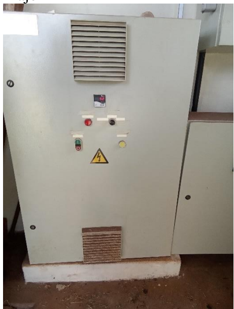
Foto 31 – Frente do quadro de comando poço Major
