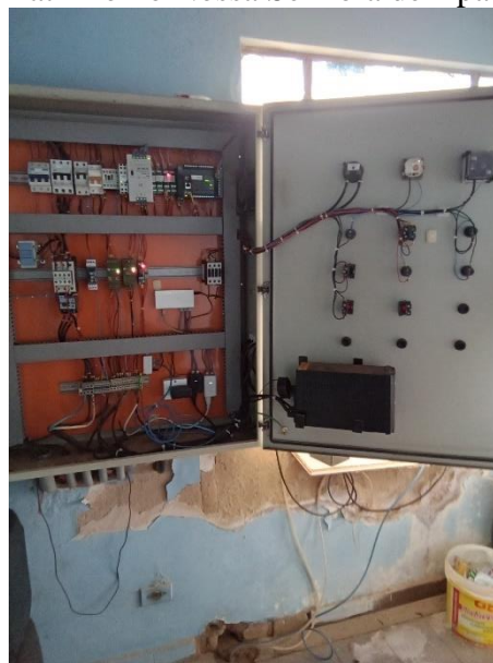
Foto 36 – Quadro de comando poço Patrimônio Nossa Senhora de Aparecida
