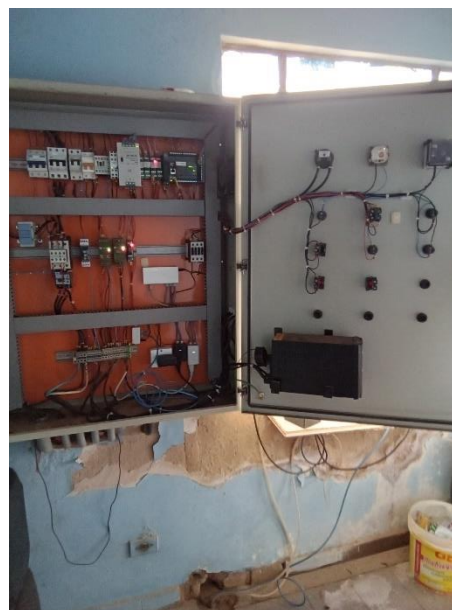
Foto 65 – Quadro de comando UTA Patrimonio Nossa Senhora de Aparecida
