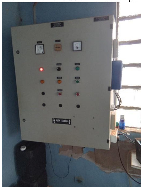
Foto 35 – Frente do quadro de comando poço Patrimônio Nossa Senhora de Aparecida
