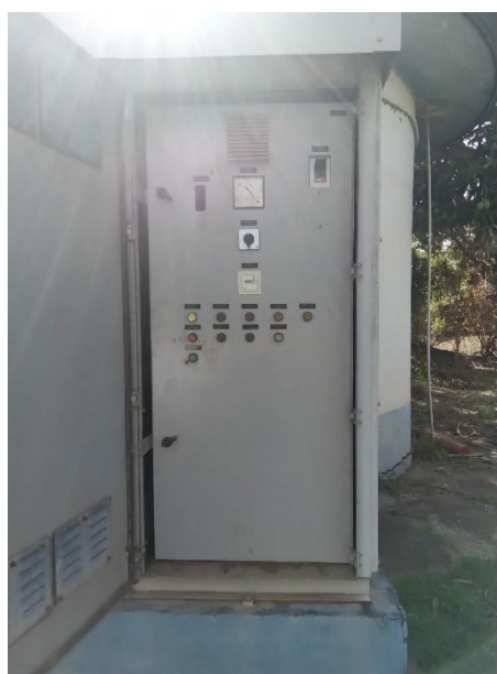
Foto 47 – Frente do quadro de comando EAB01
