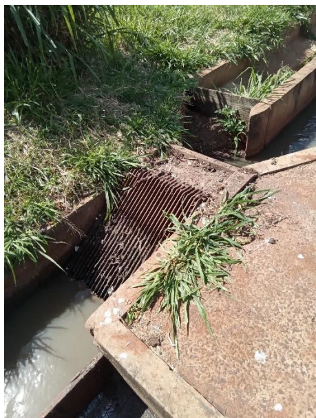
Foto 116 – Gradeamento ETE Barreirão
