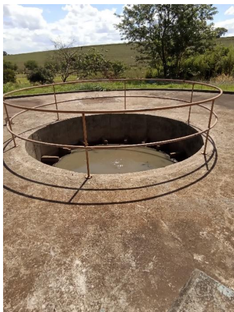
Foto 111 – Reator anaeróbio 01 ETE Anta
