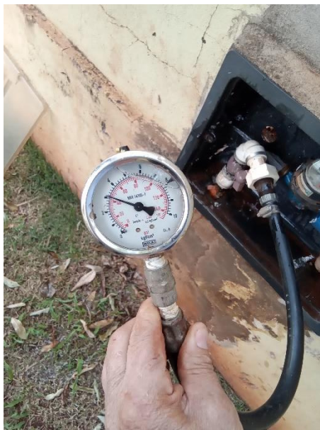
Foto 92 – Hidrômetro P02 – P = 44.00 mca
