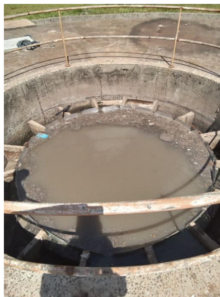
Foto 112 – Reator 02 anaeróbio ETE Antas
