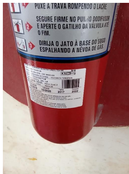
Foto 44 – Extintor vencido EAB01
