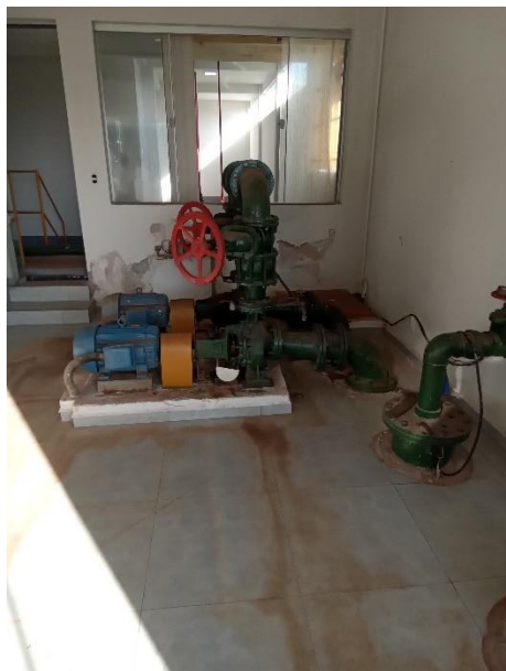
Foto 52 – Conjunto motobomba ETA
