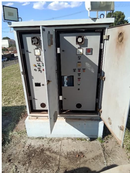
Foto 29 – Frente quadros de comando poço Ivai
