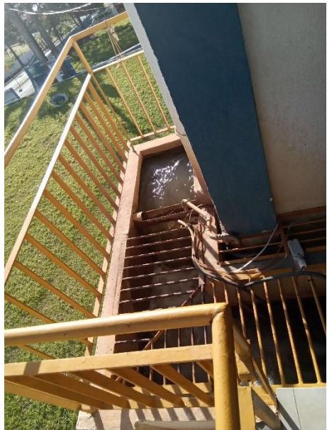
Foto 48 – Entrada de água bruta
