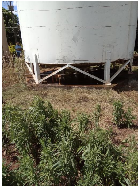
Foto 85 – Vazamento RAP Canoas
