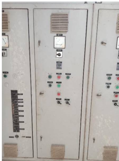
Foto 53 – Frente quadro de comando ETA
