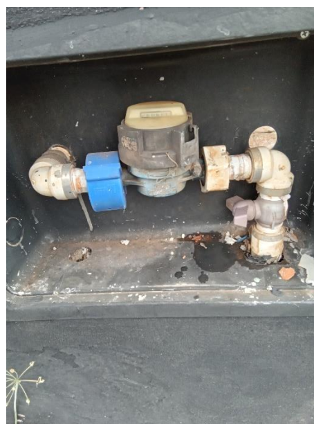
Foto 88 - Identificação hidrômetro P01
