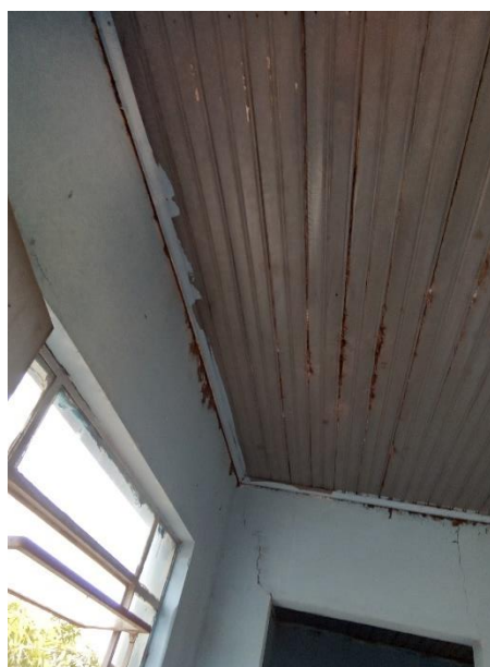
Foto 63 – Necessidade reparo UTA Patrimônio Nossa Senhora de Aparecida
