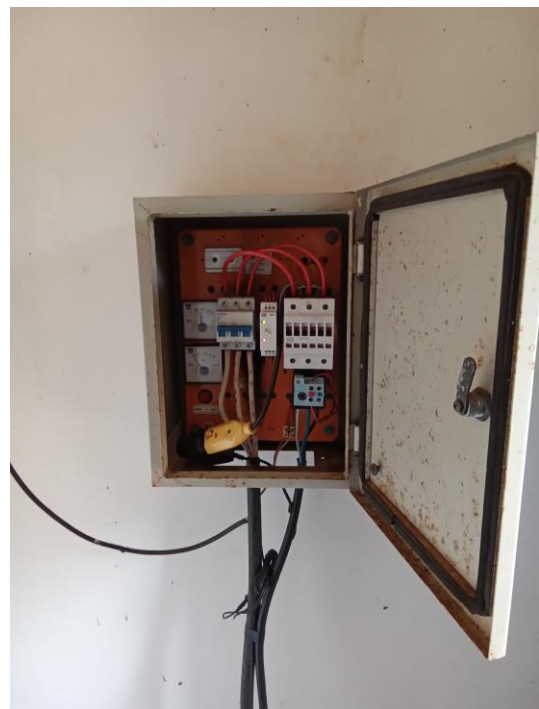
Foto 34 – Quadro de comando aberto
