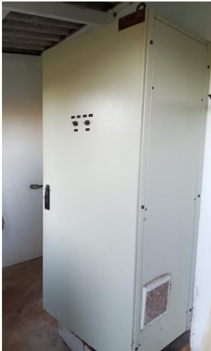
Foto 37 – Quadro de comando
