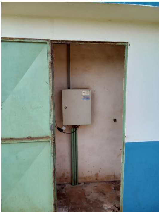
Foto 25 – Quadro de comando
