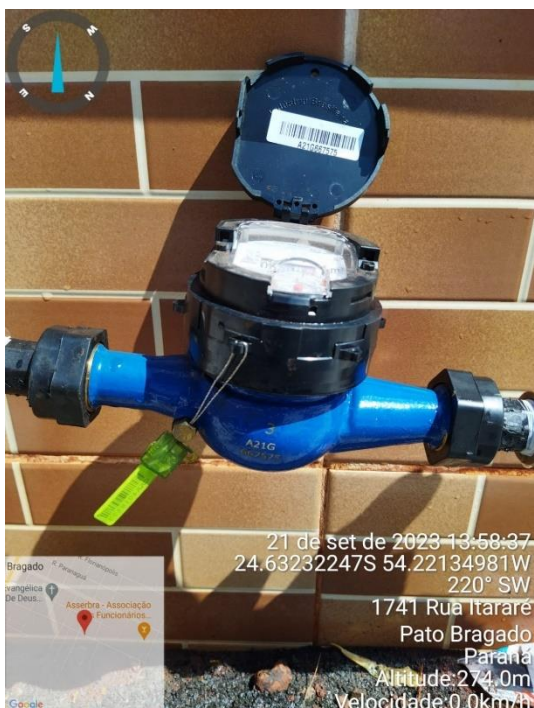
Foto 104 – Identificação hidrômetro P03 (2021)
