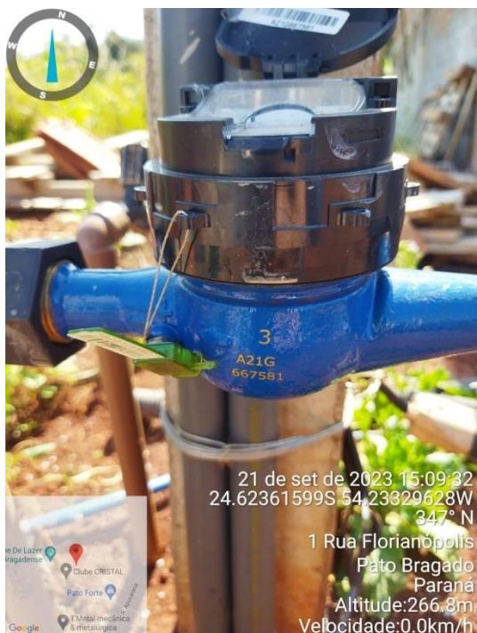
Foto 100 – Identificação hidrômetro P01 (2021)
