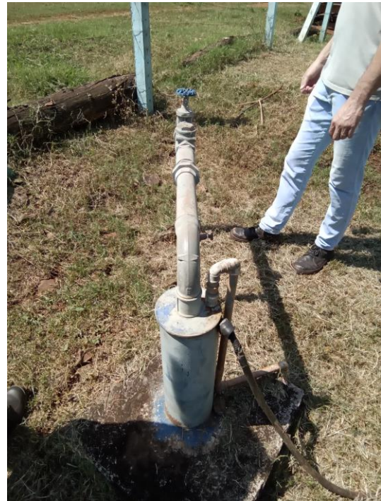
Foto 40 – Poço Linha São Francisco
