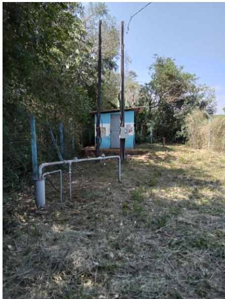
Foto 43 – Acesso Poço Flor do Sertão
