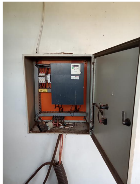
Foto 42 –Quadro de comando aberto
