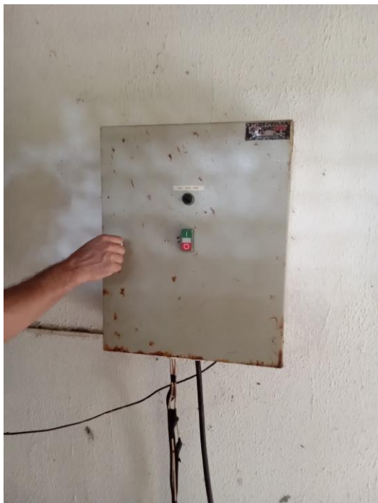
Foto 49 – Quadro de comando
