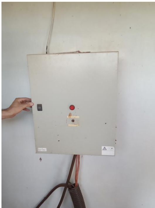
Foto 41 – Quadro de comando
