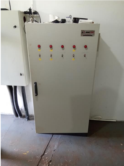
Foto 95 – Quadro de comando
