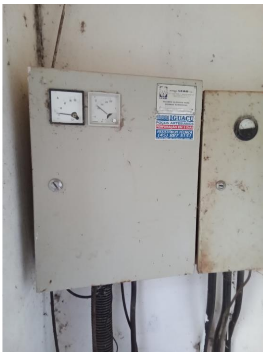
Foto 45 – Quadro de comando
