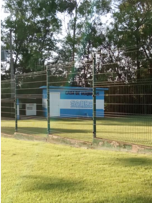
Foto 92 – Casa de máquinas elevatória
