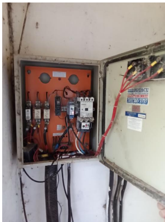
Foto 46 –Quadro de comando aberto
