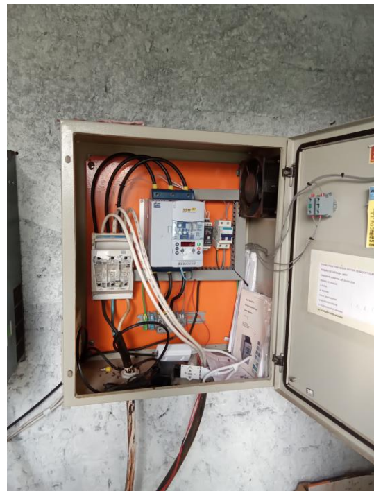
Foto 20 – Quadro de comando aberto
