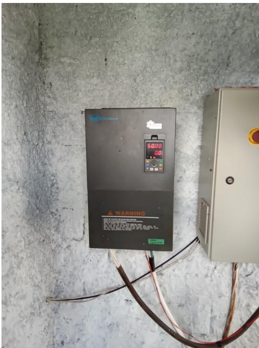
Foto 19 – Quadro de comando
