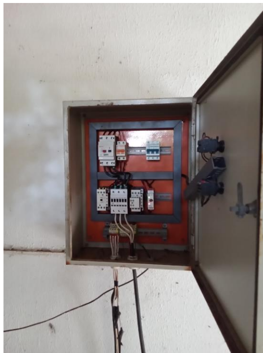
Foto 50 – Quadro de comando aberto
