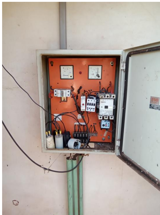
Foto 26 – Quadro de comando aberto
