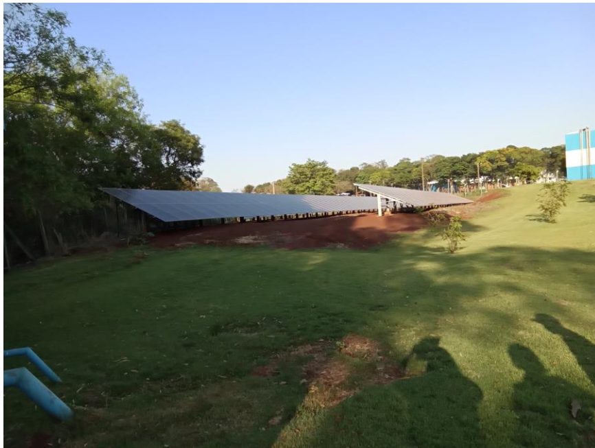
Foto 94 – Sistema de energia fotovoltaica
