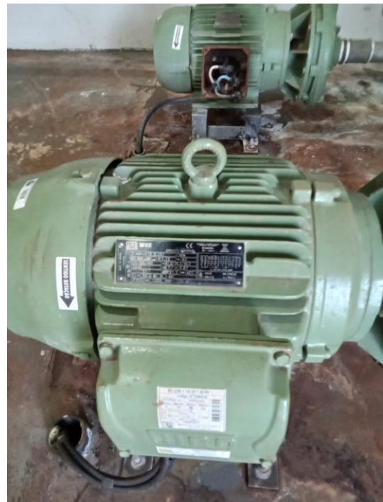
Foto 98 – Bomba estação elevatória de água
