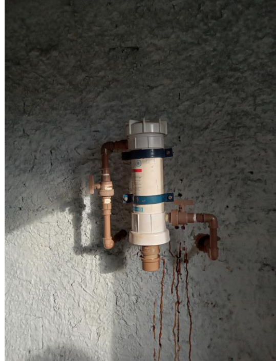
Foto 56 – UTA Poço Lago Municipal
