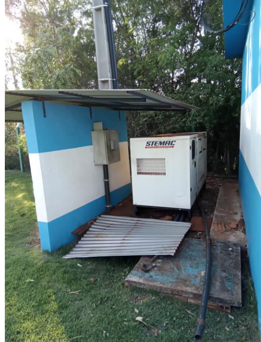
Foto 93 – Gerador de energia
