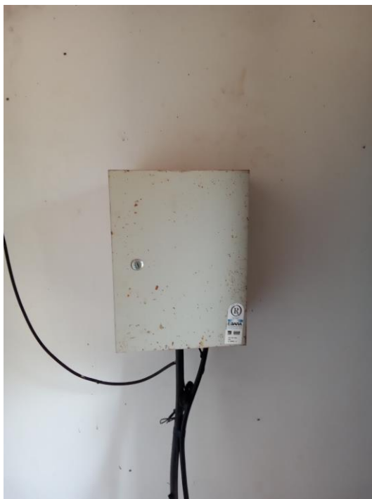
Foto 33 – Quadro de comando
