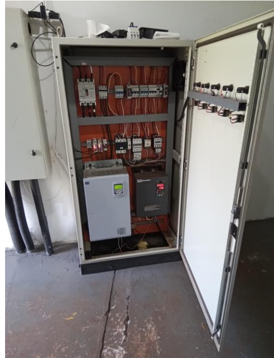
Foto 96 – Quadro de comando aberto
