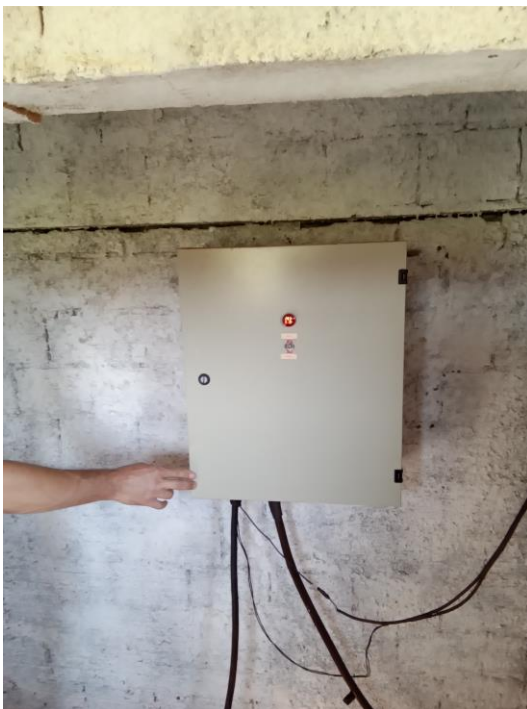
Foto 53 – Quadro de comando
