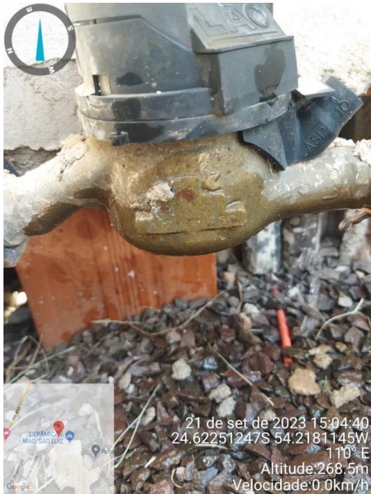
Foto 102 – Identificação hidrômetro P02 (2017)
