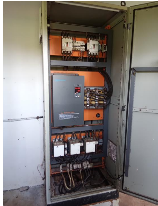
Foto 38 – Quadro de comando aberto
