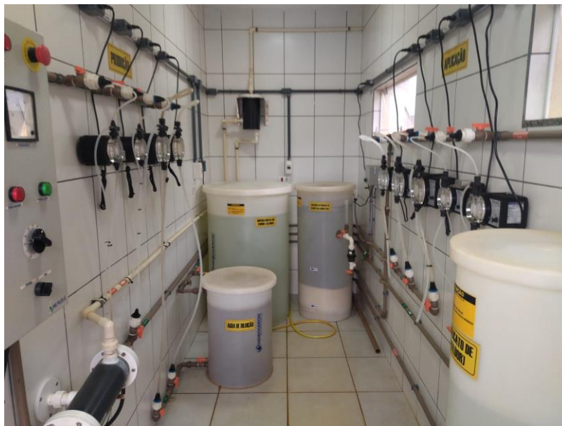
Foto 19: Unidade de tratamento, bombas dosadoras (gerador de cloro).
