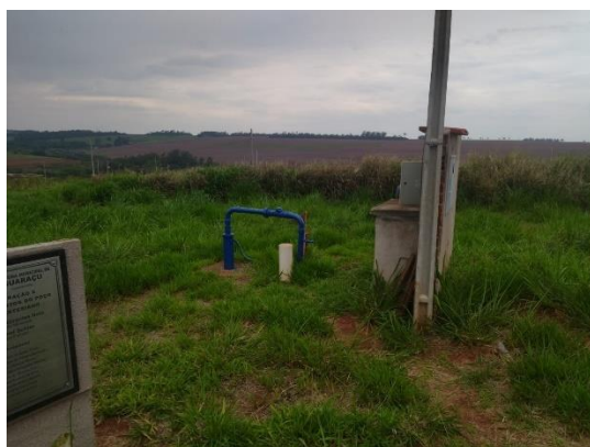
Foto 36: Ausência de abrigo para o quadro de comando.
