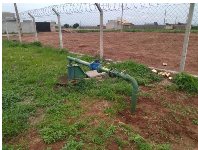
Foto 53: Instalações Poço 02 – Terra Bela.
