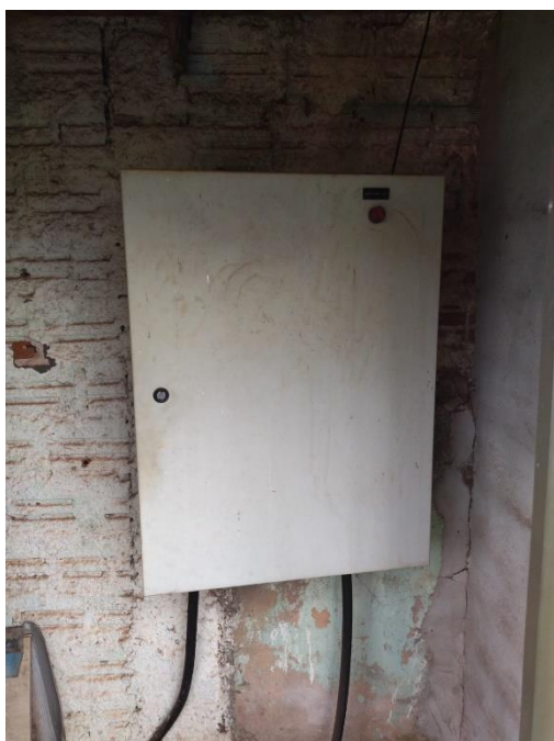
Foto 23: Quadro de comando poço 01.
