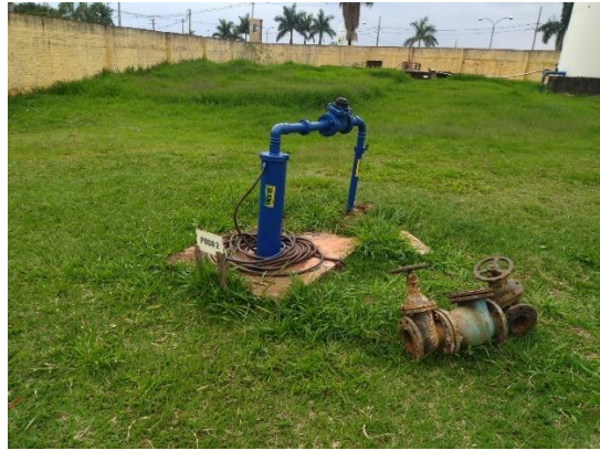
Foto 24: Ausência de proteção do poço.
