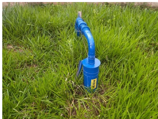
Foto 32: Instalações do poço.
