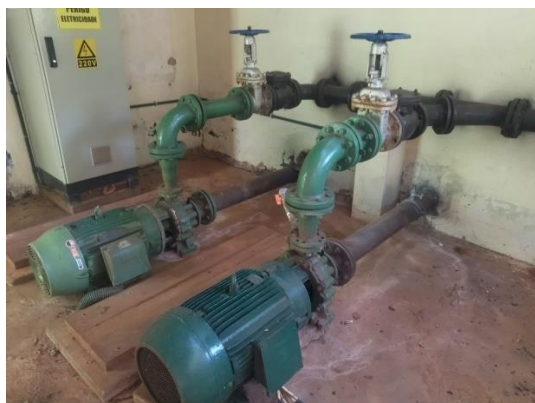
Foto 45: Conjunto moto bomba.
