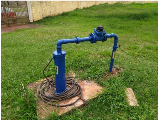
Foto 23: Falta de identificação apropriada.
