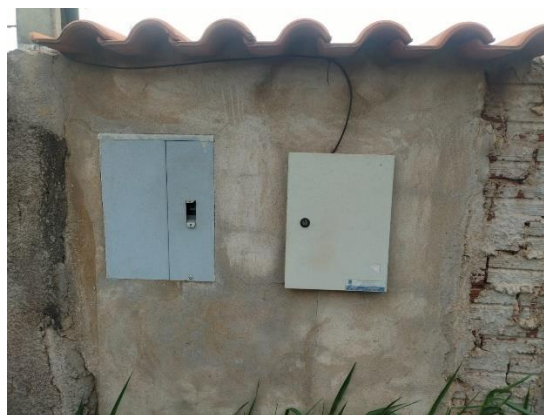
Foto 28: Falta de abrigo do quadro de comando.
