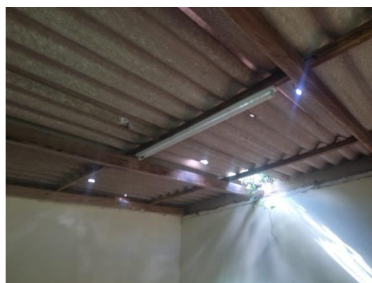
Foto 46: Necessidade de reparos estruturais.
