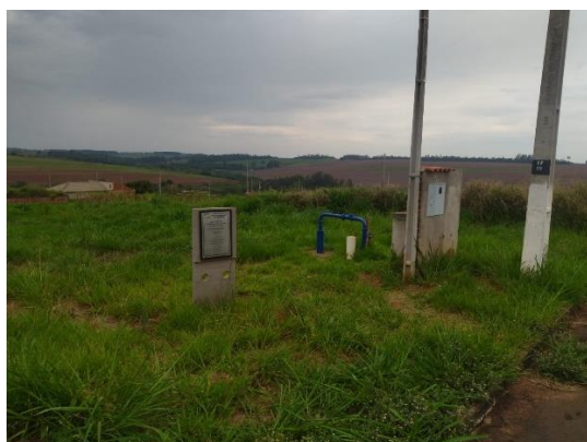
Foto 34: Falta de isolamento.
