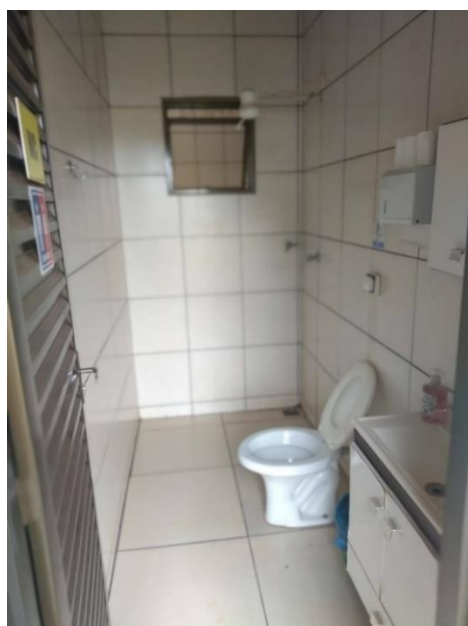
Foto 01: Banheiros para o público sem acessibilidade.
