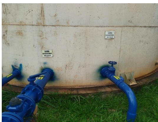
Foto 57: Medidor de vazão (saída).
