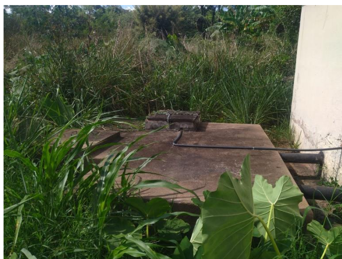
Foto 59: Reservatório (tampas necessitando de reparos).
