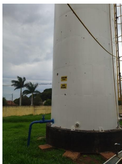
Foto 55: Ausencia de macromedidor na saída.
