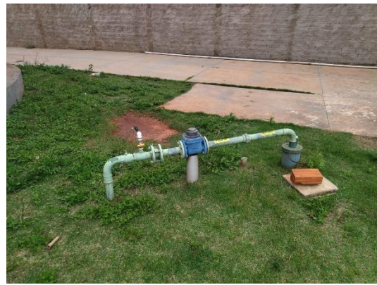
Foto 50: Instalações do poço.
