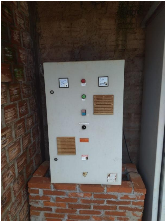
Foto 51: Quadro de comando.
