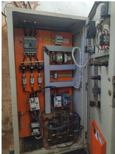
Foto 68: Quadro de comando.
