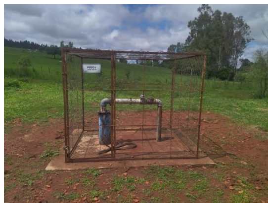
Foto 16: proteção e identificação poço 01.
