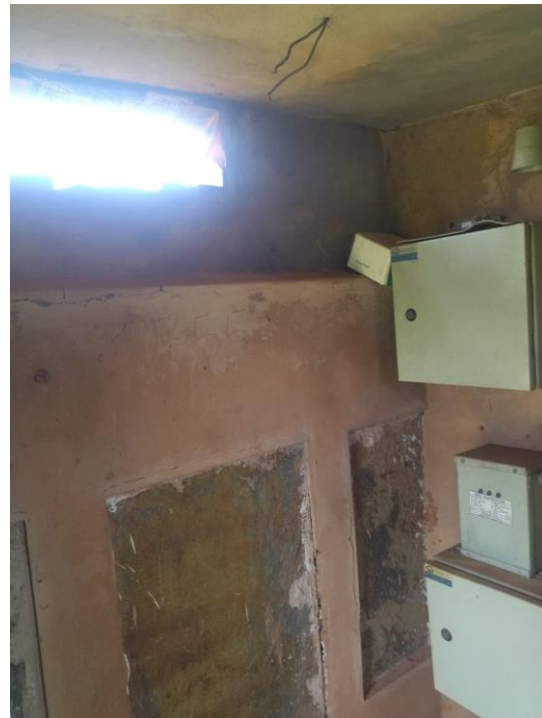
Foto 20: Necessidade de manutenção interna.
