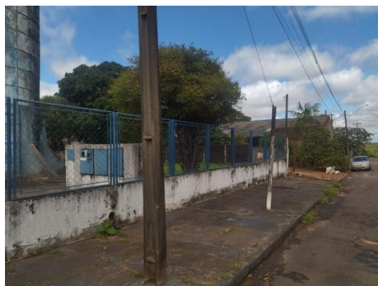
Foto 47: Área cercada, necessidade de pintura.
