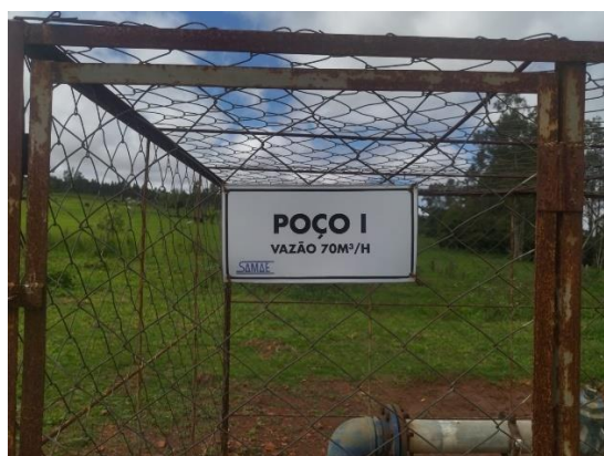
Foto 15: Identificação inadequada poço 01.
