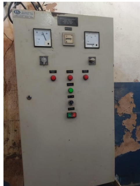
Foto 66: Quadro de comando.
