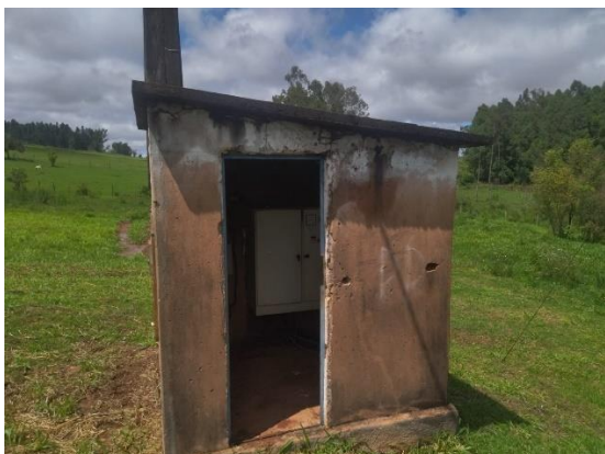
Foto 14: Ausência de iluminação externa e interna.
