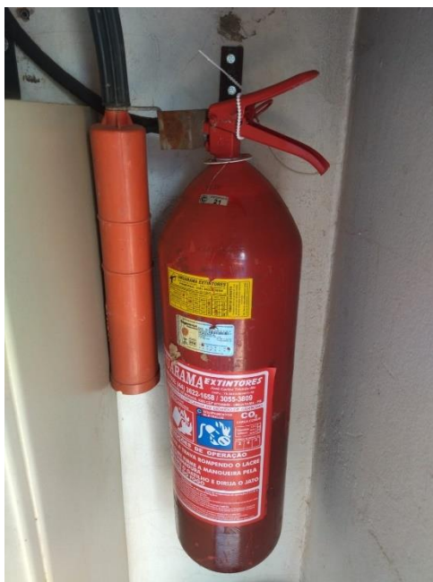
Foto 34: Extintor de incendio.
