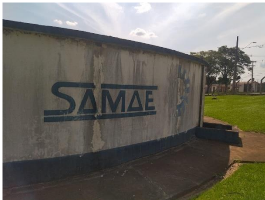
Foto 42: necessidade de pintura.
