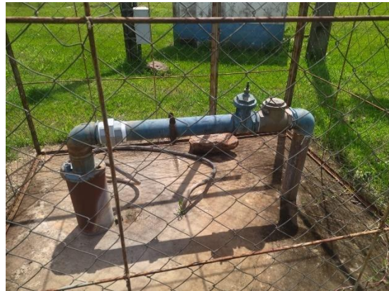
Foto 28: Falta de tomada de coleta.
