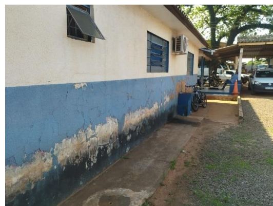
Foto 08: Falta de pintura externa.
