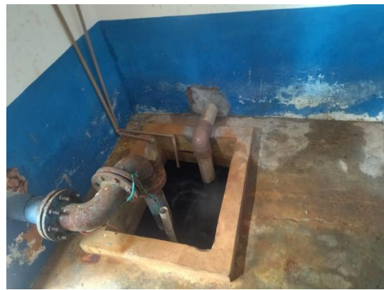
Foto 87: Ausencia de tampas.
