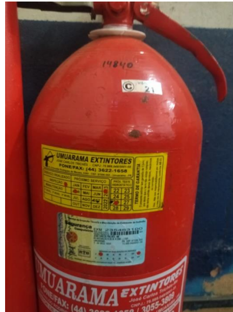
Foto 71: Extintores de incendio
