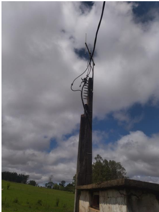
Foto 19: Sistema automatizado (via radio).
