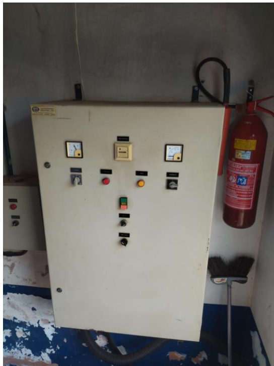
Foto 32: Quadro de comando.
