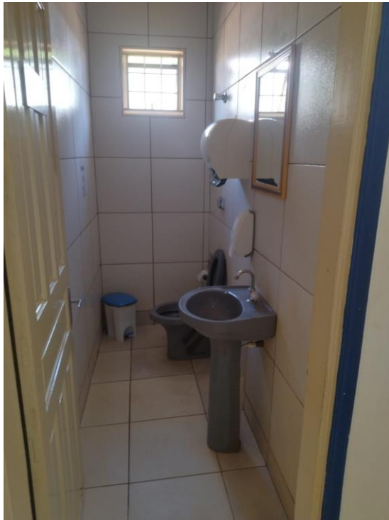
Foto 04: Banheiros sem acessibilidade.
