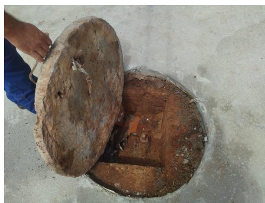
Foto 52: Interior caixas de manobra.
