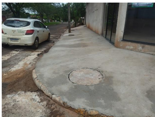
Foto 51: Caixas de manobra de rede.
