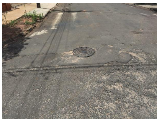
Foto 59: Ponto de verificação de esgoto
