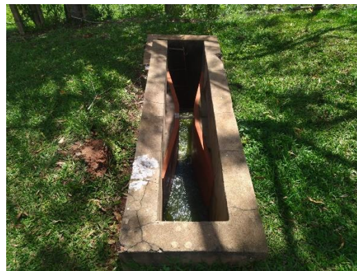
Foto 82: Calha parshell (saída).
