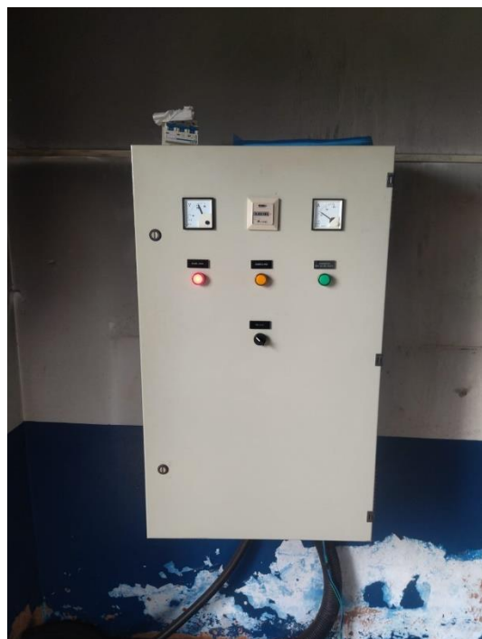
Foto 38: Quadro de comando.
