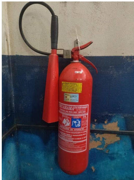
Foto 70: Extintores de incendio.
