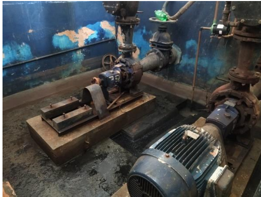
Foto 63: Ausencia de bombas reservas.
