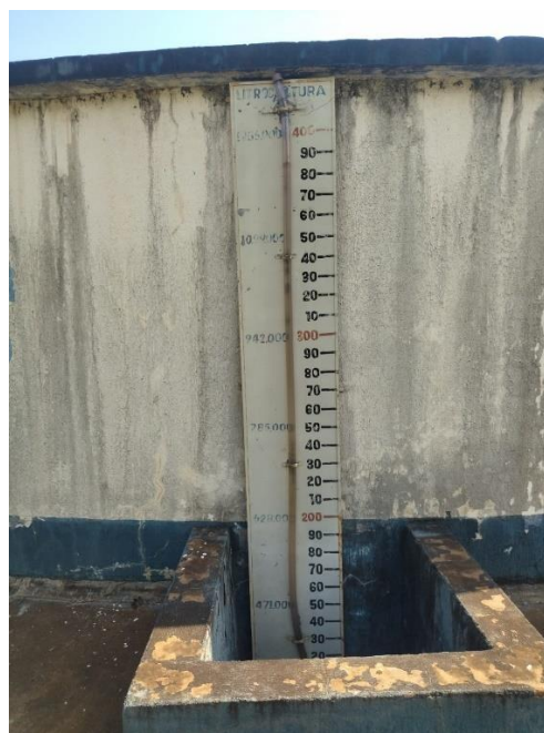
Foto 45: Medição de nível.
