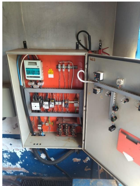
Foto 33: Quadro de comando.
