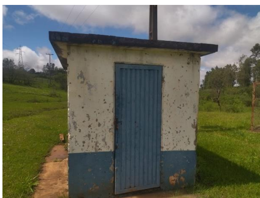
Foto 23: Falta de iluminação externa
