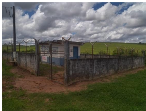
Foto 61: Ausência de iluminação externa.
