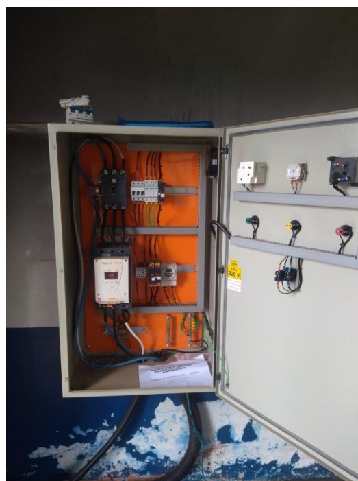
Foto 39: Quadro de comando.
