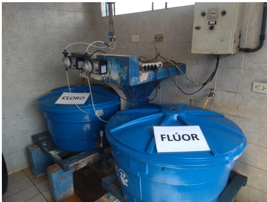
Foto 13: Unidade de tratamento de água.
