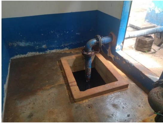
Foto 86: Ausencia de tampas.
