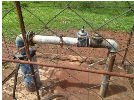
Foto 18: Ausencia de tomada de coleta.
