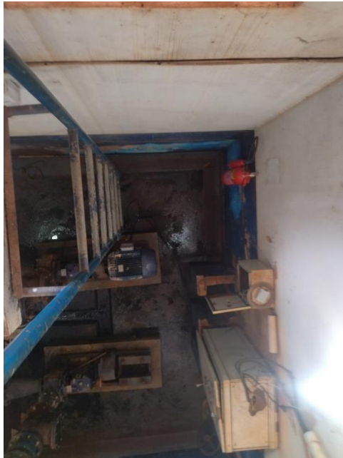
Foto 65: Escadas sem proteção.
