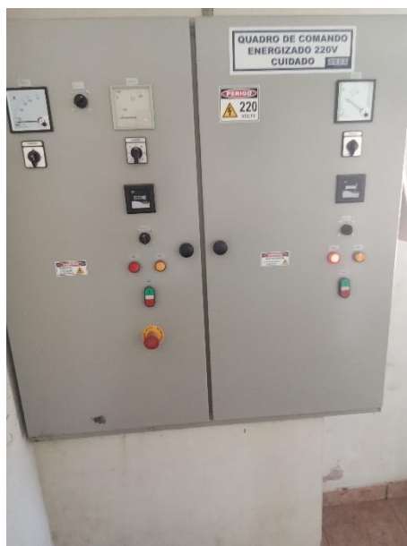
Foto 54 – Frente do quadro de energia elevatória sede
