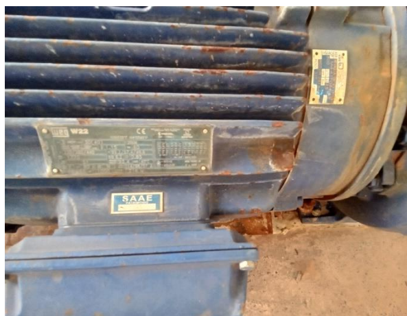
Foto 52 – Identificação bomba 1 elevatória sede
