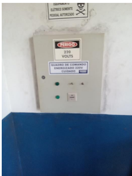
Foto 44 – Frente do quadro de comando booster 2
