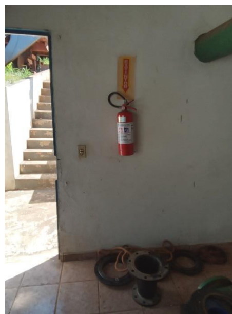
Foto 53 – Extintor elevatória sede (validade janeiro/2023)
