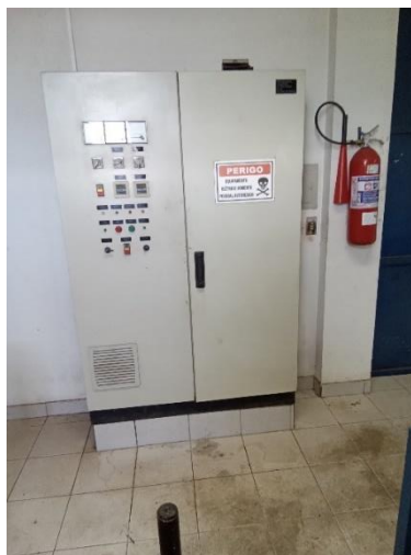
Foto 15 – Frente quadro de comando (captação - rio) e extintor
