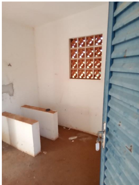
Foto 29 – Falta de tela mosquiteira poço Makuta
