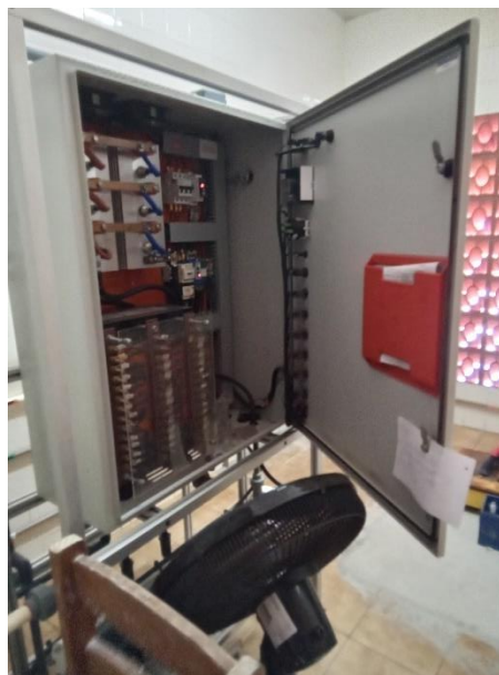
Foto 63 – Quadro de comando tratamento de água
