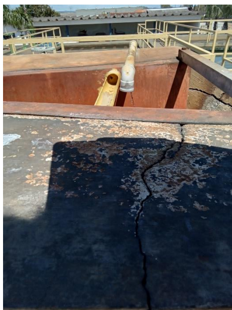
Foto 56 – Trincas na estrutura da ETA
