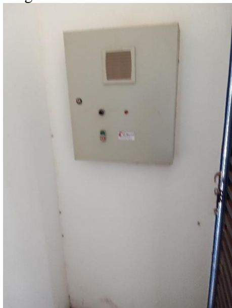
Foto 21 – Frente do quadro de comando poço Jangada
