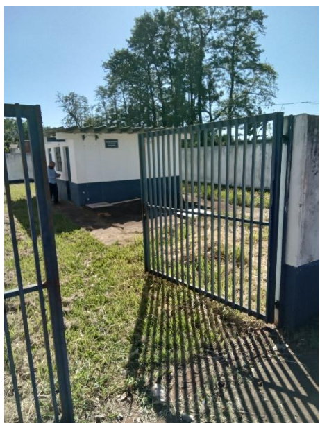
Foto 99 – Falta de identificação Elevatória do Badola (colocar conforme outorga do IAT)
