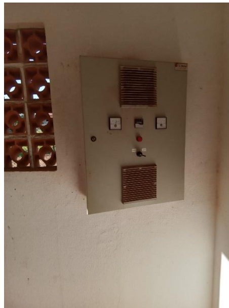
Foto 30 – Frente do quadro de comando poço Makuta
