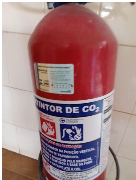
Foto 66 – Extintor validade janeiro/2023
