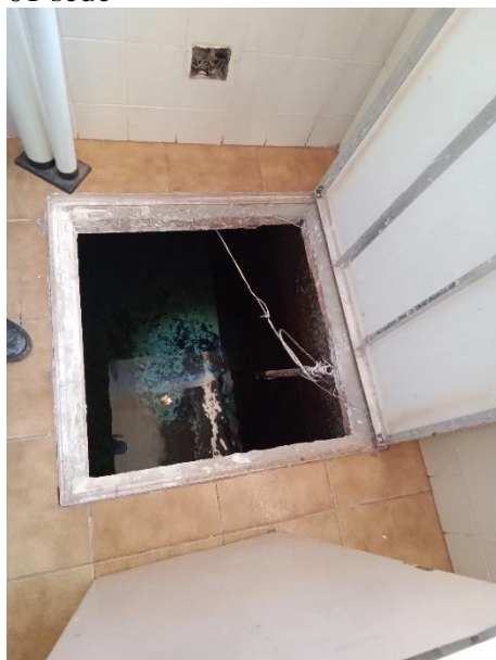
Foto 75 – Reservatório enterrado (REN01) 01 sede
