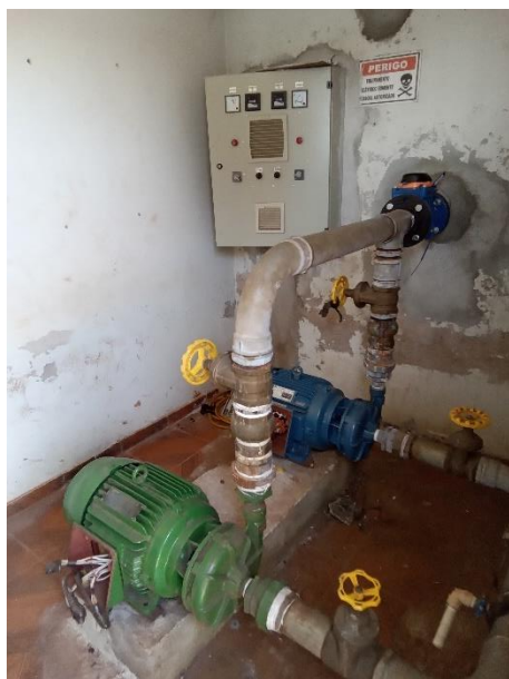
Foto 34 – Conjunto moto bomba do booster Foto 35 – Frente quadro booster 01 01
