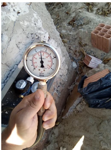
Foto 87 – Medição pressão na rede P01 P = 70 mca
