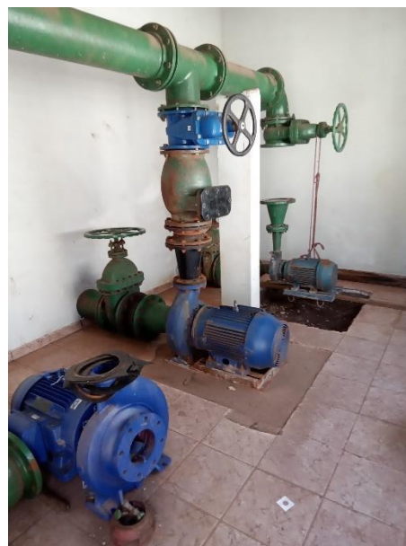
Foto 51 – Conjunto moto bomba elevatória sede
