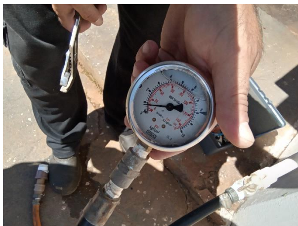
Foto 89 – Hidrômetro P03 (não foi tirada pressão no cavalete) – P = 10 mca
