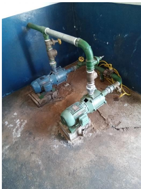
Foto 42 – Conjunto moto bomba booster 2
