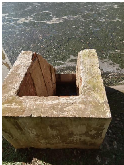
Foto 114 – Saída Lagoa Anaeróbia 02
