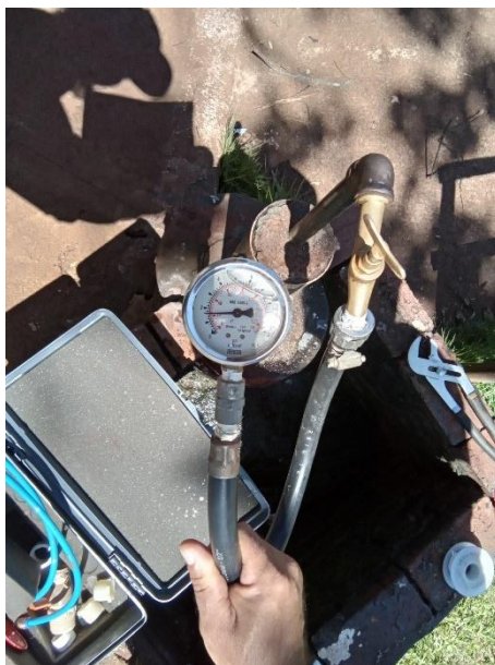
Foto 88 – P02 - Hidrômetro P02 (não foi tirada pressão no cavalete) – P = 23 mca
