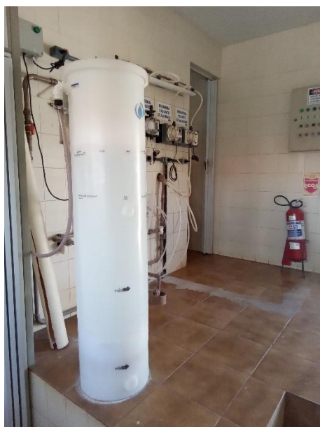
Foto 64 – Tanque de sulfato de alumínio (falta de guarda corpo)
