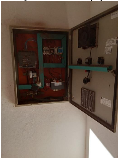
Foto 31 – Quadro de comando poço Makuta
