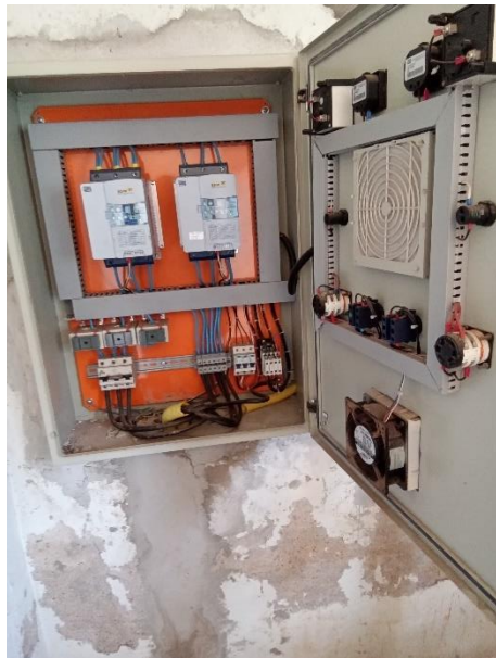
Foto 36 – Quadro de energia do booster 01
