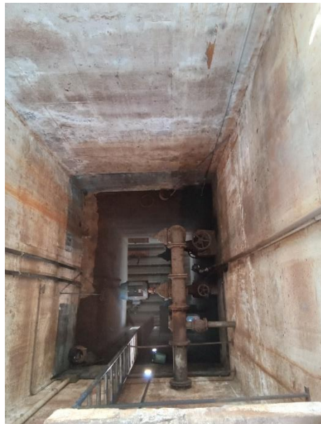
Foto 105 - Conjunto moto bomba EE Badola
