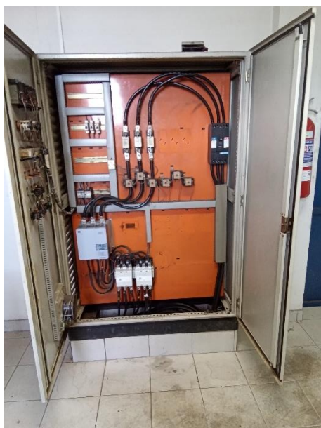
Foto 16 – Quadro de comando captação Foto 17 – Conjunto moto bomba captação rio rio
