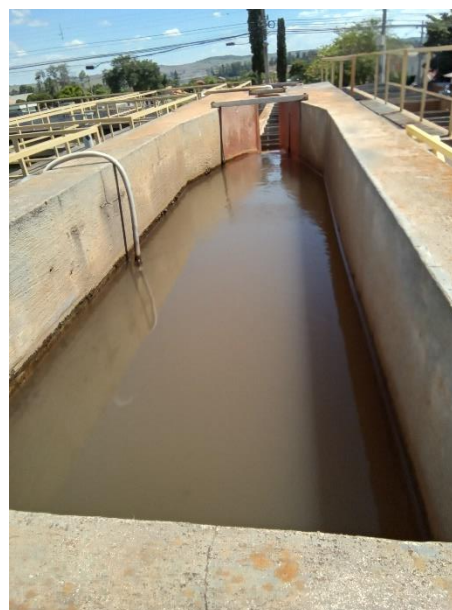
Foto 57 – Calha de entrada e Calha Parshall
