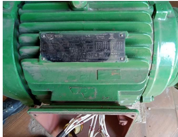
Foto 37 – Identificação bomba 01 booster 01
