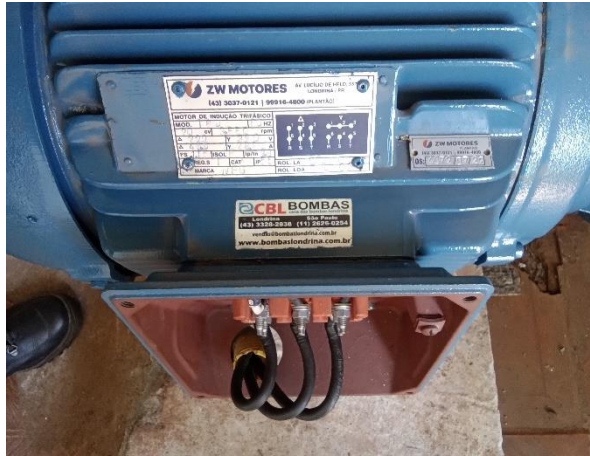
Foto 38 – Identificação bomba 02 booster 01
