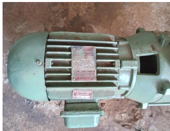
Foto 43 – Identificação motor 01 booster 2
