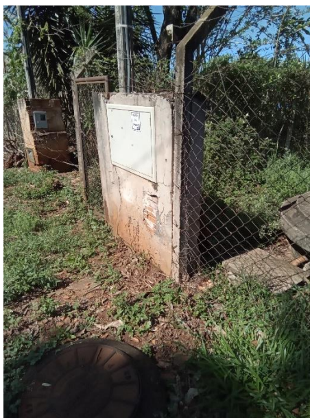
Foto 109 – Frente do quadro de comando EE Abulssef
