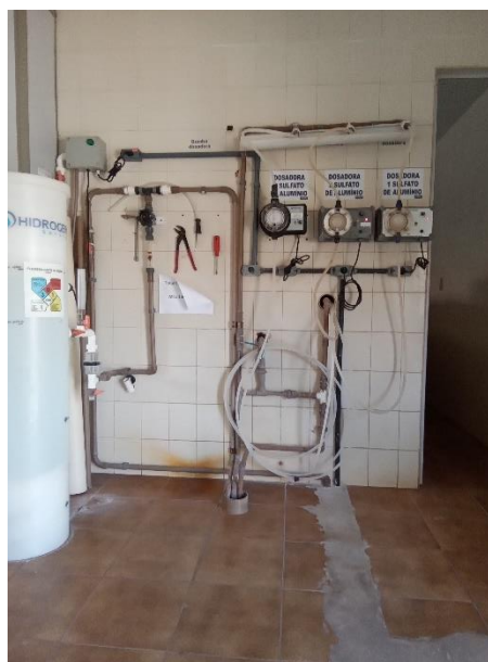
Foto 65 – Bombas dosadoras de sulfato de alumínio
