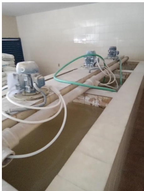
Foto 68 – Tanques de sulfato de alumínio, flúor e cal
