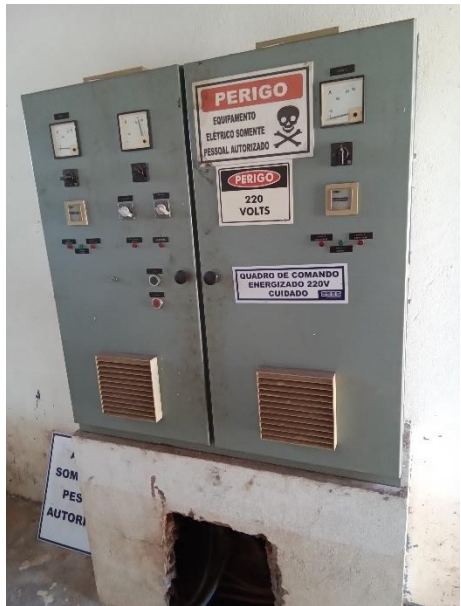
Foto 101 – Frente do quadro de comando EE do Badola
