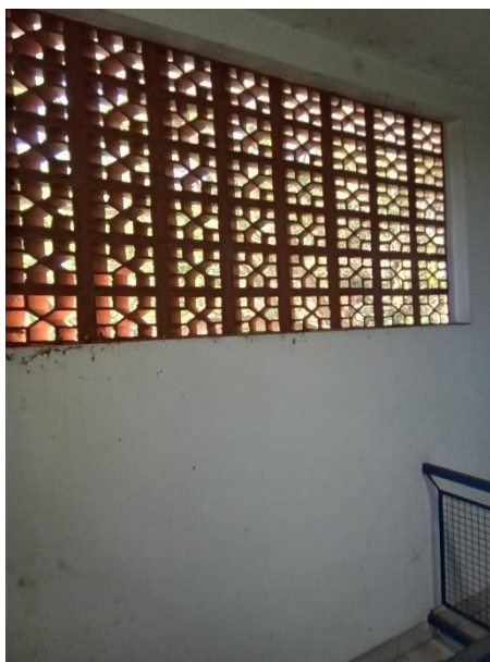
Foto 18 – Abertura sem tela mosquiteira
