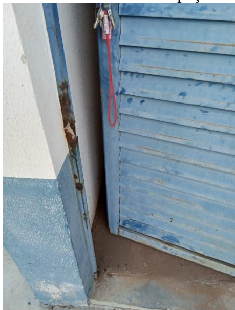
Foto 23 – Necessidade de reparos porta de acesso a casa de comando poço Jangada
