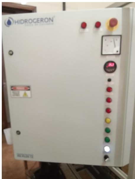
Foto 62 – Frente quadro de comando tratamento de água
