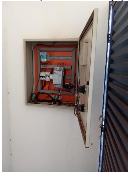
Foto 22- Quadro de comando poço Jangada
