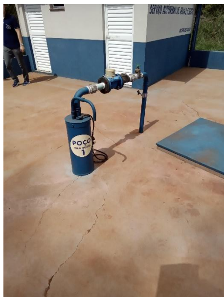
Foto 40 – Poço 1 (Vila Rural)
