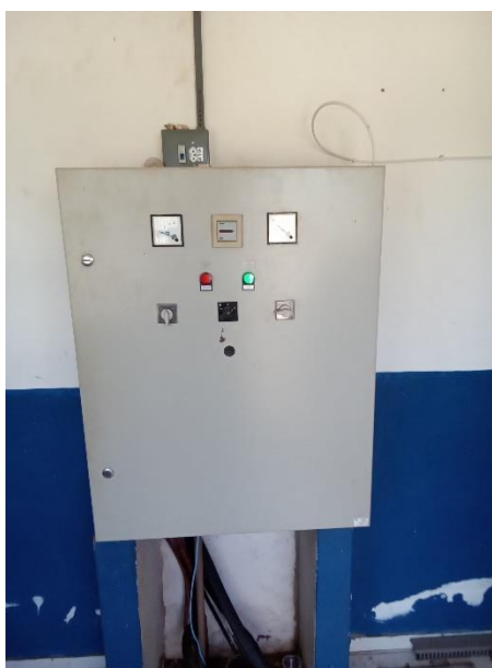
Foto 23 – Frente do quadro de comando poço 02 (Vila Operária)
