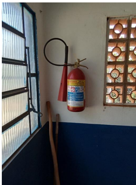
Foto 25 – Extintor e aberturas sem tela mosquiteira poço 2 (Vila Operária)
