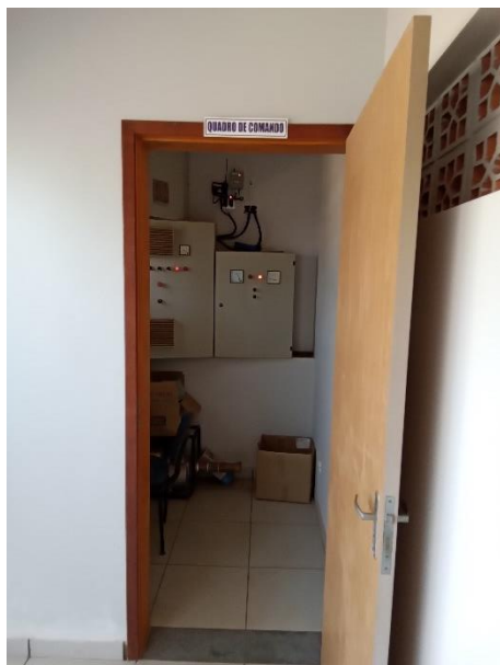
Foto 14 – Casa de comando poços 1, 4 e 7 (sede)
