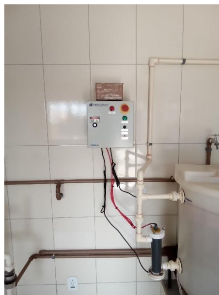
Foto 53 – Frente do quadro de comando UTA Distrito José São José do Ivaí
