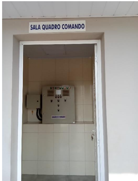
Foto 29 – Identificação casa de comando poço 3 (Distrito de São José do Ivaí)
