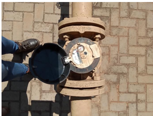
Foto 13 – Macromedidor poço 04 (sede)
