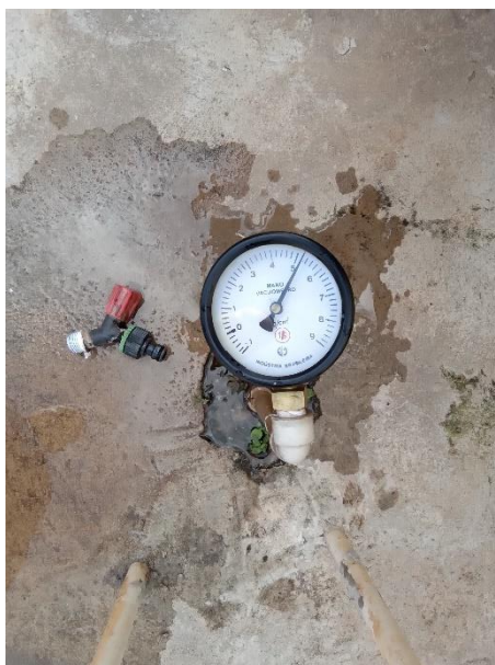
Foto 75 – Medição pressão na rede P02 P = 52.69 mca
