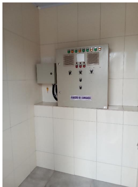
Foto 30 – Frente do quadro de comando poço 3 (Distrito de São José do Ivaí)
