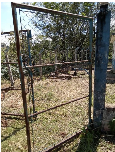
Foto 20 – Falta de identificação poço 02
