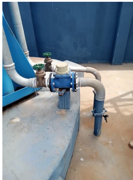
Foto 66 – Macromedidor e canalizações REL Distrito
