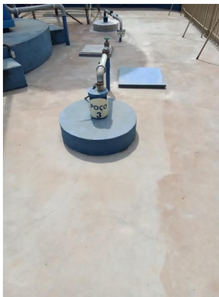
Foto 27 – Poço 03 (Distrito de São José do Ivaí)
