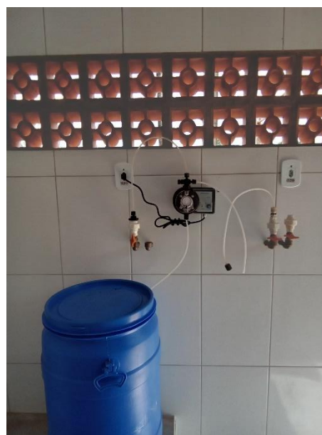
Foto 57 – Bomba dosadora UTA Vila Rural
