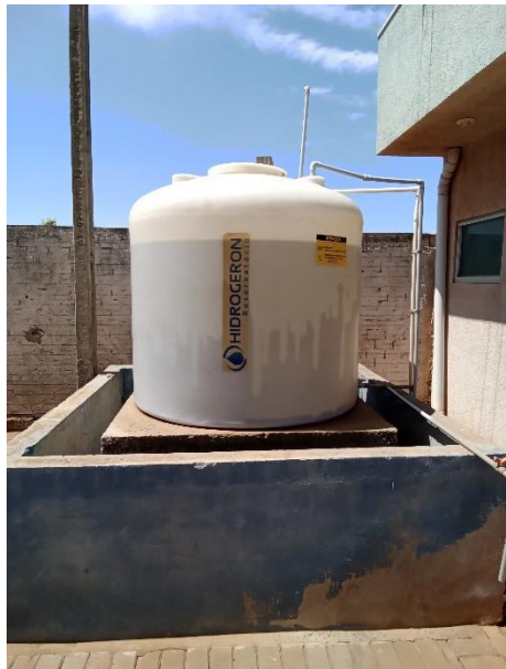
Foto 48 – Tanque de cloro (sede)
