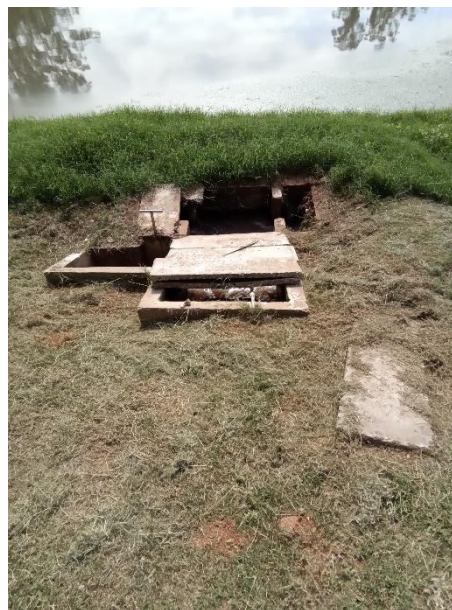
Foto 90 – Entrada lagoa anaeróbia 01
