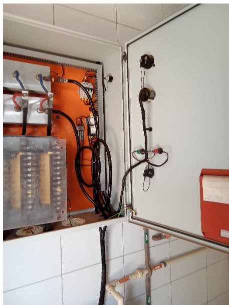
Foto 50 – Quadro de comando UTA sede
