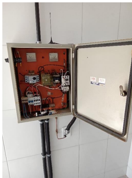
Foto 43 – Quadro de comando poço 1 (Vila Rural)
