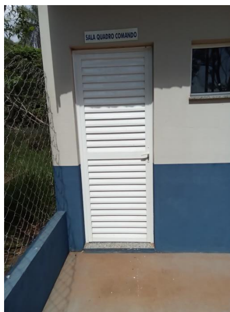
Foto 41 – Identificação da casa de comando poço 1 (Vila Rural)
