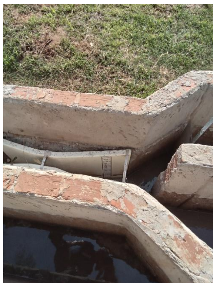
Foto 87 – Medidor de vazão (Parshall – entrada)
