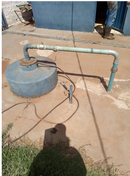
Foto 34 – Poço 1 – São José do Ivaí
