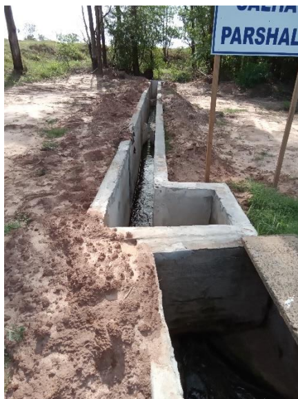
Foto 95 – Calha Parshall de saída
