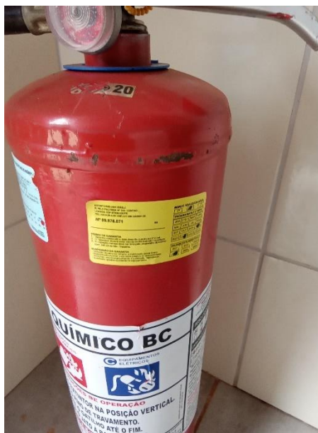
Foto 32 – Extintor casa de comando poços 3 e 5 (Distrito de São José do Ivaí)
