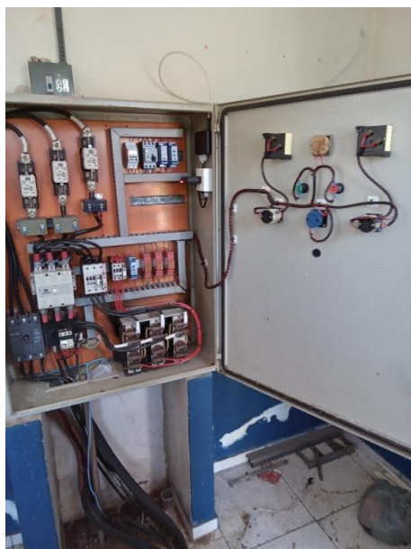
Foto 24 – Quadro de comando poço 02 (Vila Operária)
