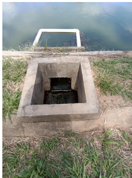
Foto 94 – Saída lagoa facultativa
