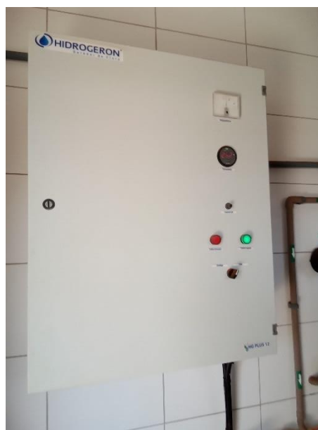
Foto 49 – Frente do quadro de comando UTA sede
