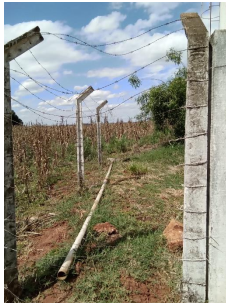
Foto 68 – Isolamento danificado REL Vila Rural
