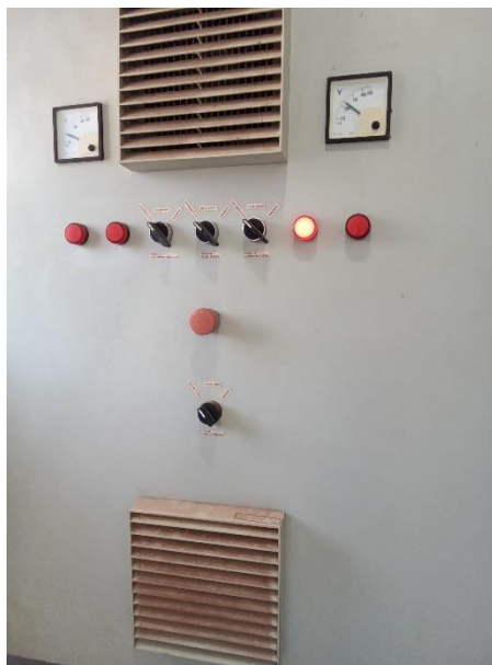
Foto 15 – Frente quadro de comando poços 1, 4 e 7 (sede)
