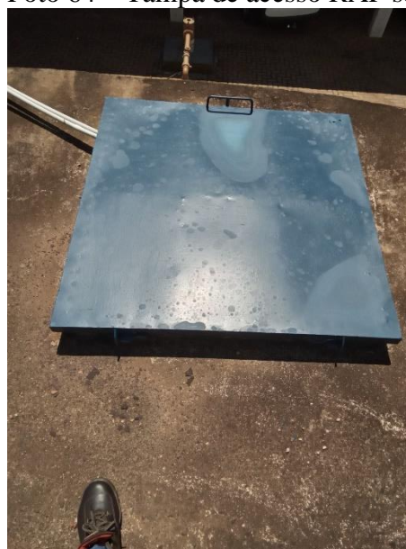
Foto 64 – Tampa de acesso RAP sede
