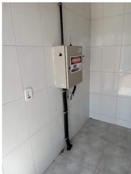
Foto 42 – Frente quadro de comando poço 1 (Vila Rural)
