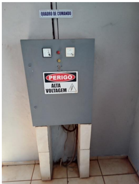
Foto 37 – Frente do quadro de comando poço 1 – São José do Ivaí
