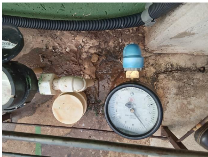
Foto 78 – Medição pressão na rede P01 P = 24.79 mca
