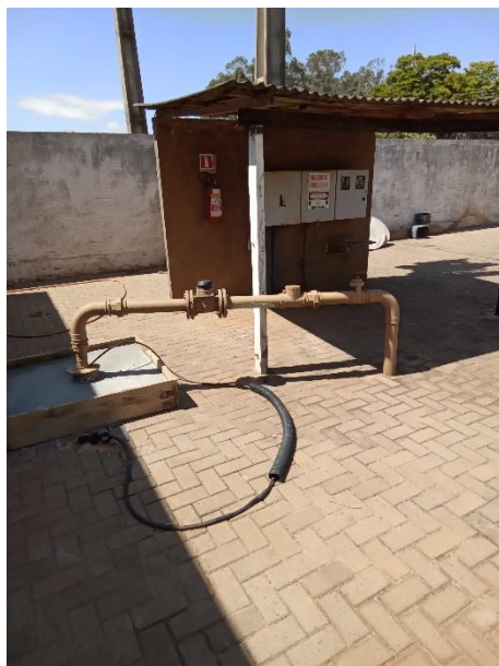
Foto 12 – Identificação poço 04 (sede)
