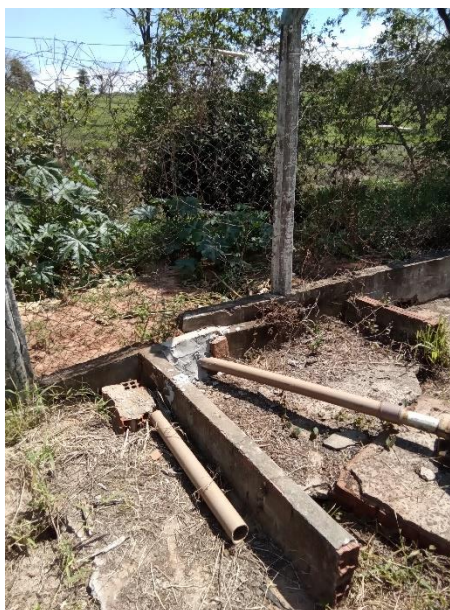
Foto 21 – Problema cercamento poço 2
