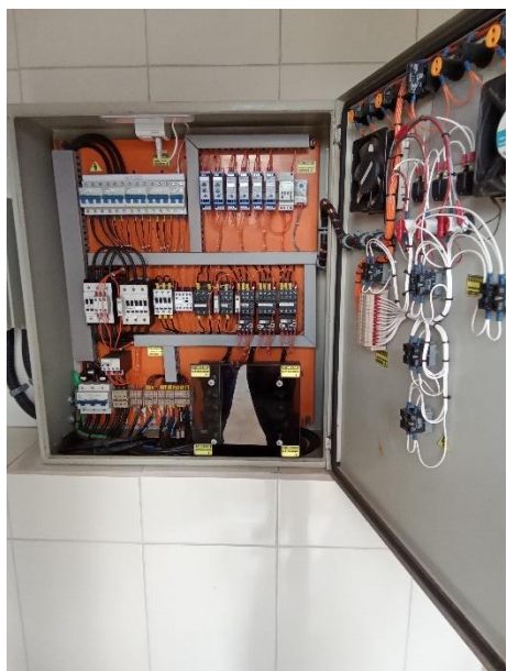
Foto 31 – Frente do quadro de comando poços 3 e 5 (Distrito de São José do Ivaí)
