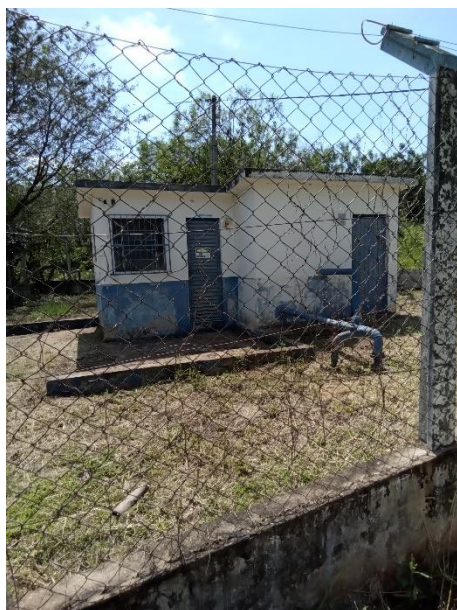
Foto 26 – Necessidade de manutenção parte externa casa de comando poço 2 (Vila Operária)
