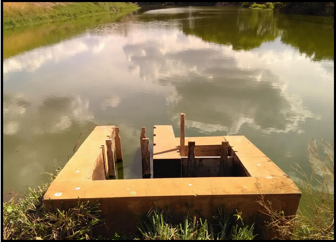
Imagem 39: Dispositivo de saída da lagoa facultativa
