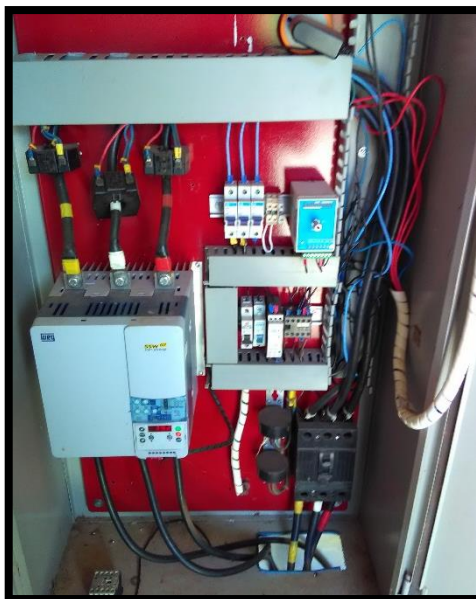
Imagem 08: Quadro de comando do poço 04
