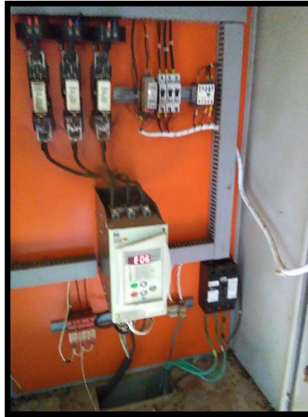
Imagem 02: Quadro de comando do poço 01
