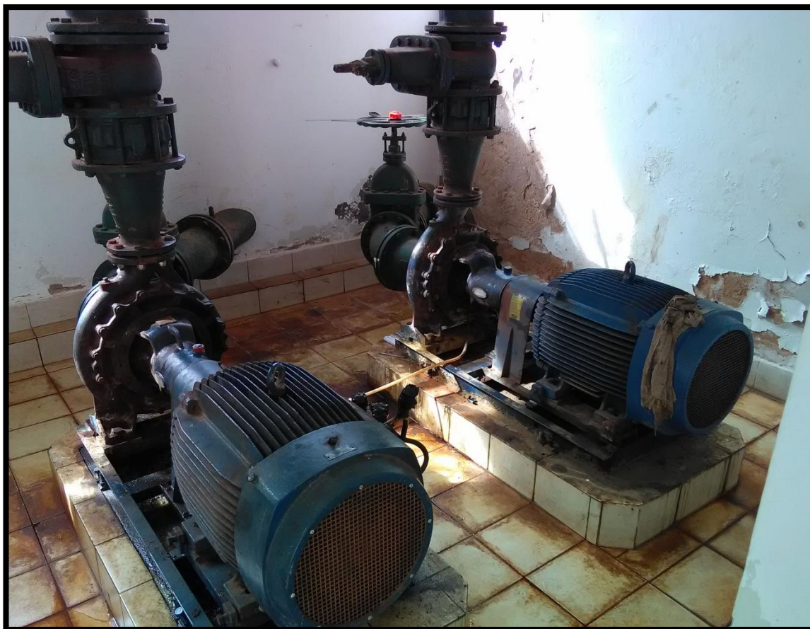
Imagem 26: Conjunto moto-bomba da elevatória 01
