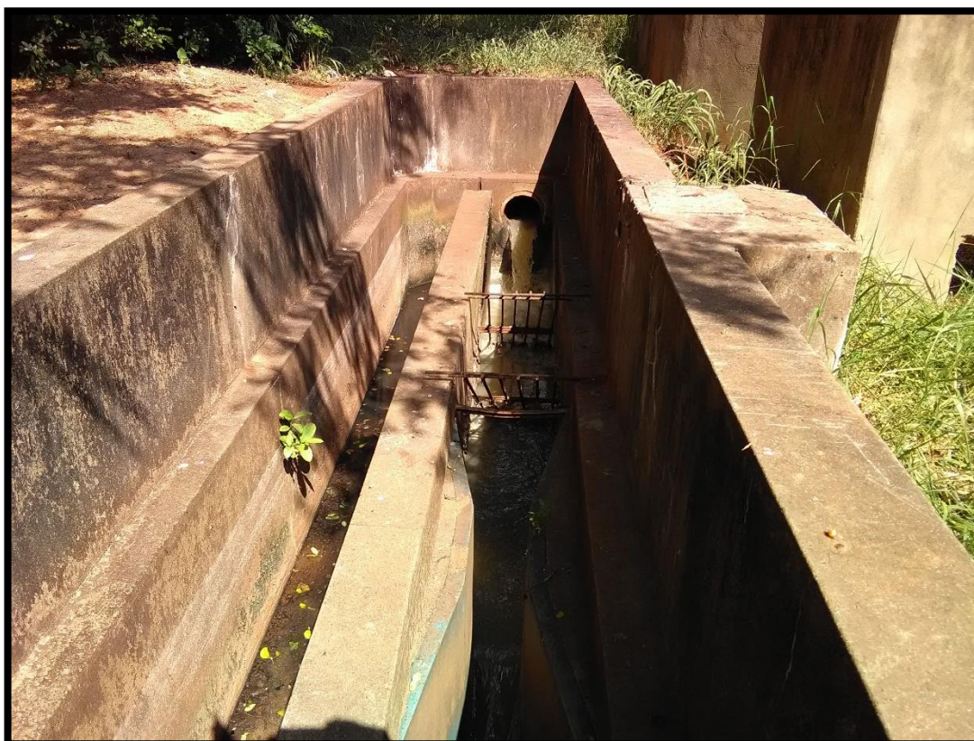
Imagem 36: Gradeamento, caixa de areia e medidor de vazão
