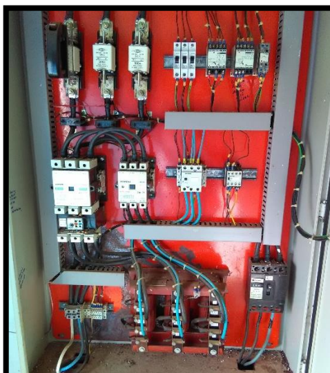
Imagem 06: Quadro de comando do poço 03
