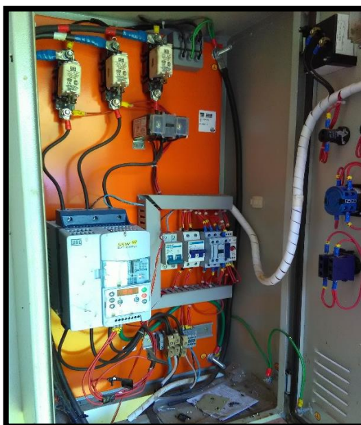
Imagem 12: Quadro de comando do poço 07
