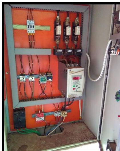
Imagem 04: Quadro de comando do poço 02
