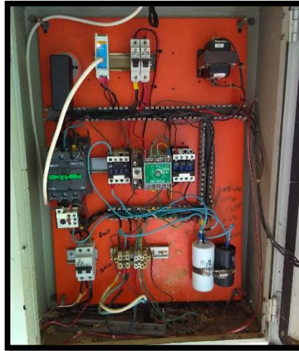
Imagem 14: Quadro de comando do poço 08
