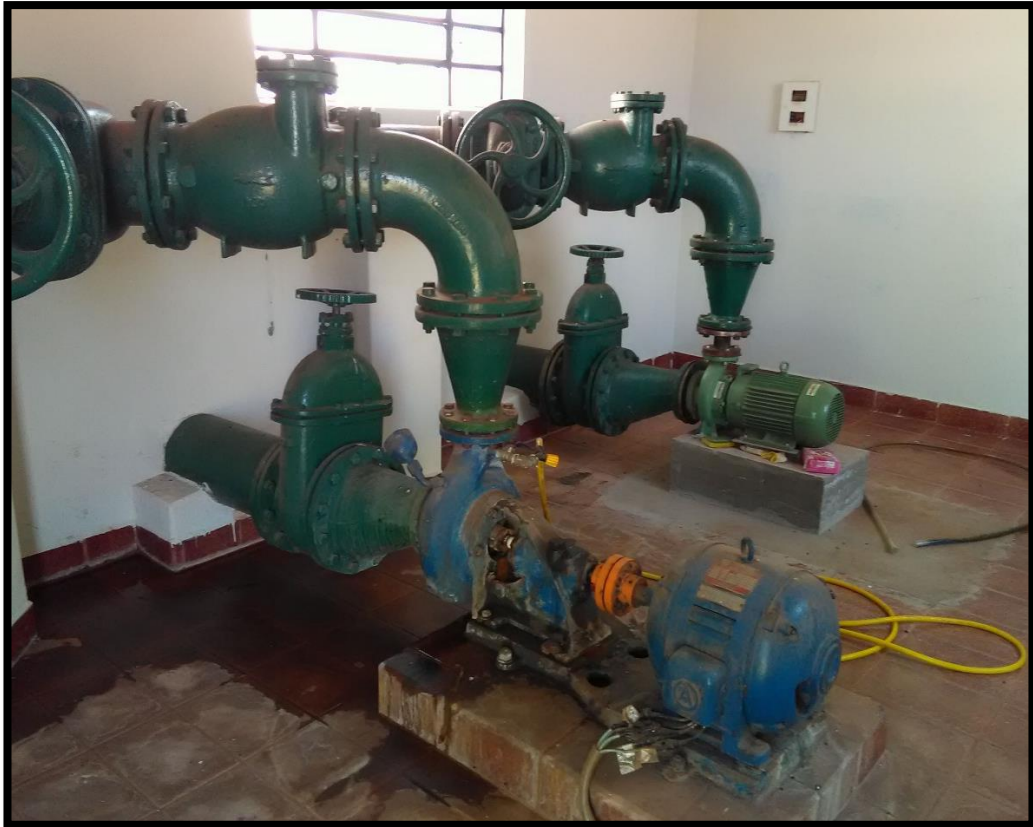
Imagem 28: Conjunto moto-bomba da elevatória 02
