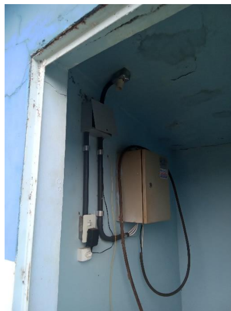
Foto 13 – Frente quadro de comando e estrutura laje poço Munback
