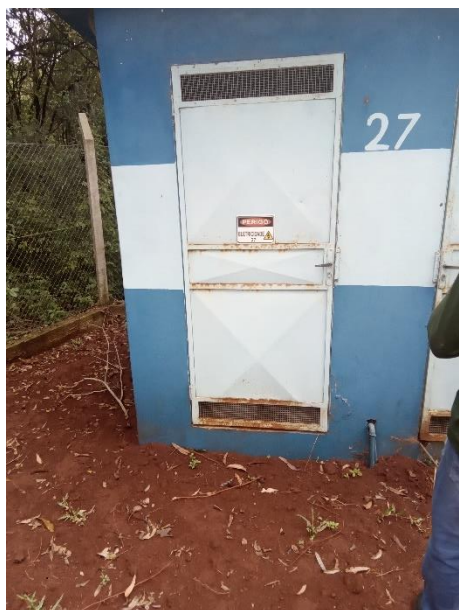
Foto 28 – Porta de acesso quadro de energia poço João Brixner
