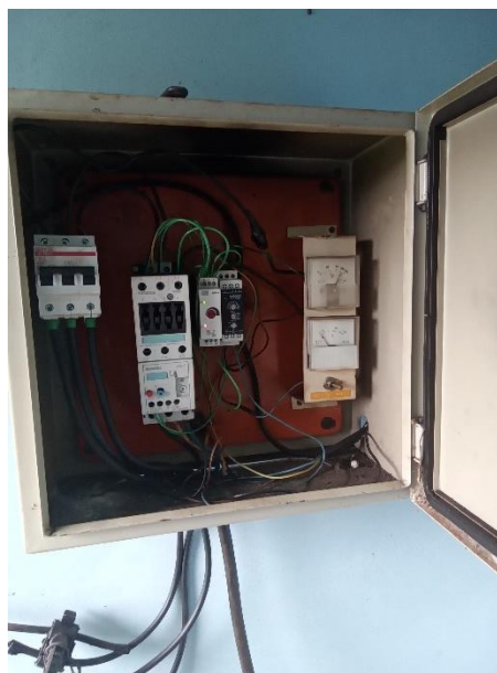
Foto 25 – Quadro de energia poço Oldemar Winter
