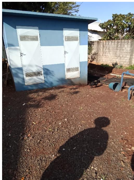
Foto 73 – Isolamento, presença de animais e casa de comando poço Asseper
