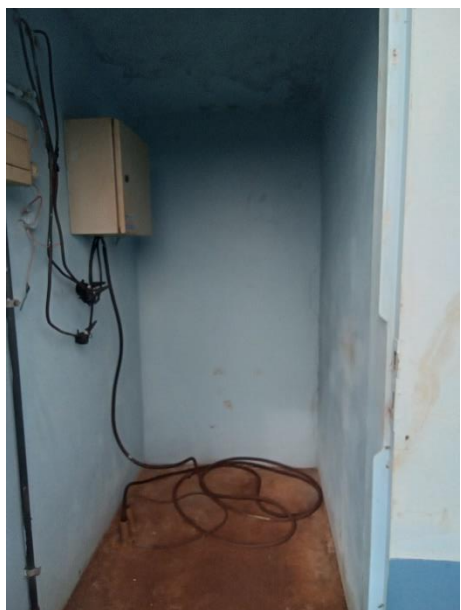
Foto 24 – Frente quadro de energia poço Oldemar Winter
