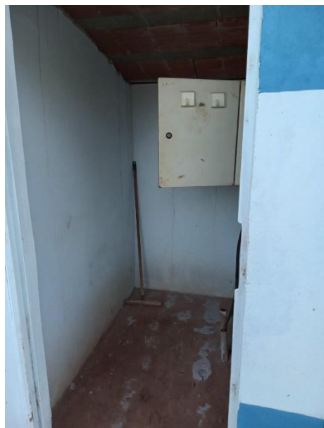
Foto 78 – Casa de comando poço Boa Esperança
