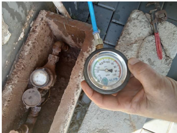
Foto 155 – Medição pressão na rede P03 P = 24 mca
