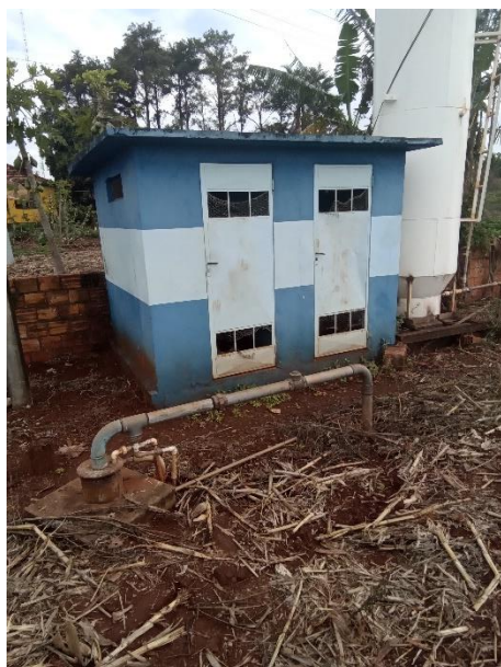
Foto 46 – Falta de isolamento e identificação poço Edezio
