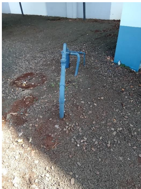
Foto 84 – Poço Centro de Eventos
