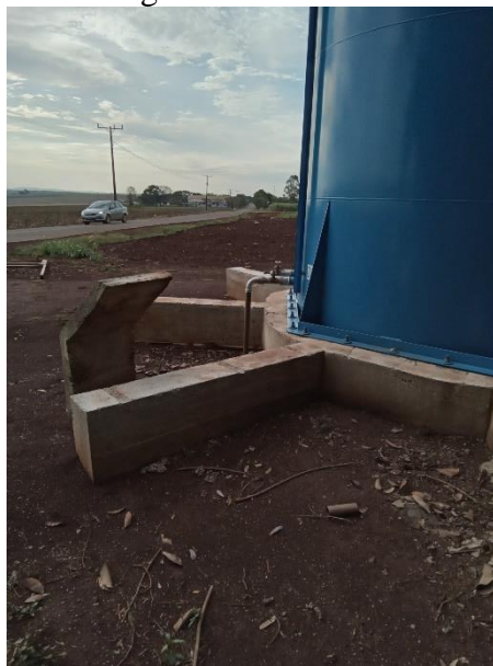
Foto 137 – Isolamento e identificação REL Vista Alegre
