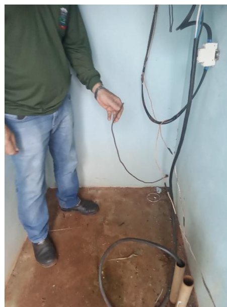
Foto 17 – Fiação solta e falta de limpeza poço Adelar Barques
