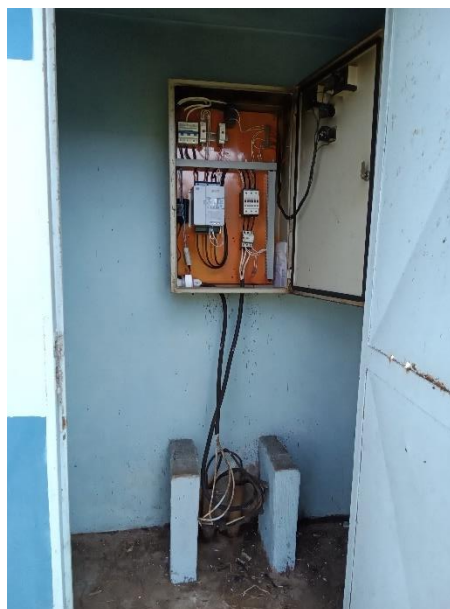
Foto 83 – Quadro de energia poço Rodenkol
