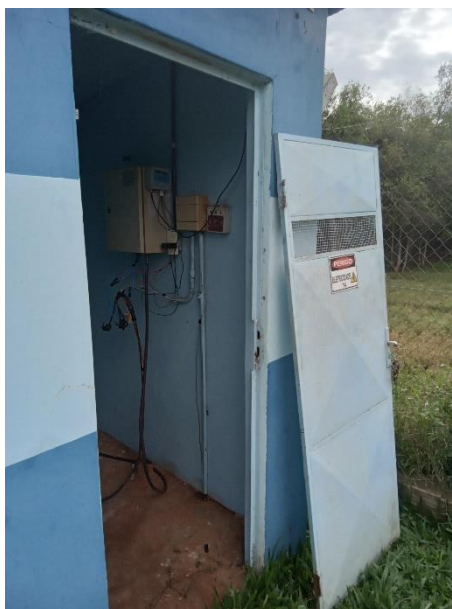
Foto 34 – Porta de acesso a casa de comando poço Paulo Khun danificada
