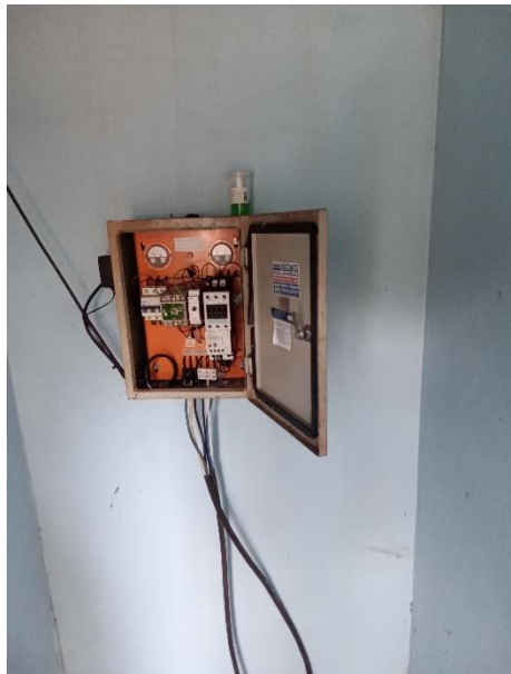
Foto 30 – Quadro de energia João Brixner
