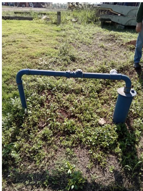
Foto 88 – Poço Parque Industrial 2
