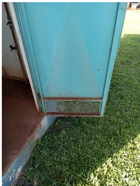
Foto 70 – Detalhe da porta de acesso ao quadro de energia poço Rambo
