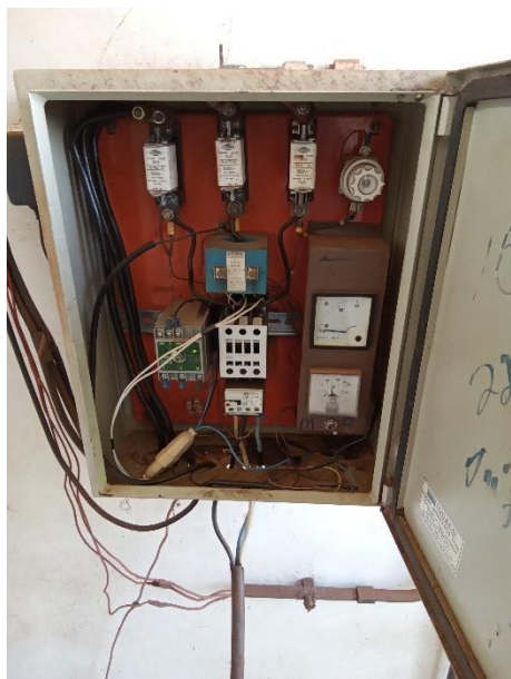
Foto 72 – Quadro de energia poço Rambo
