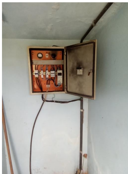
Foto 21 – Quadro energia poço Daniel
