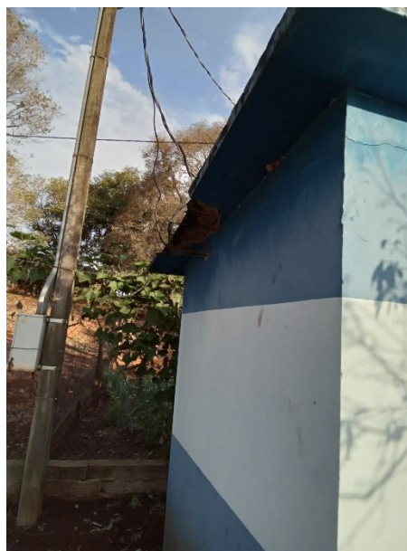
Foto 67 – Beiral danificado poço Elpídeo
