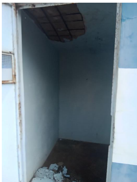
Foto 16 – Problemas manutenção casa de comando poço Adelar Barques
