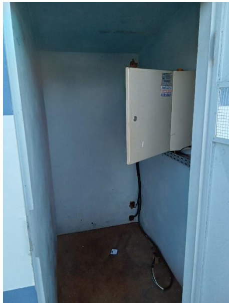
Foto 86 – Casa de comando poço Centro de Eventos
