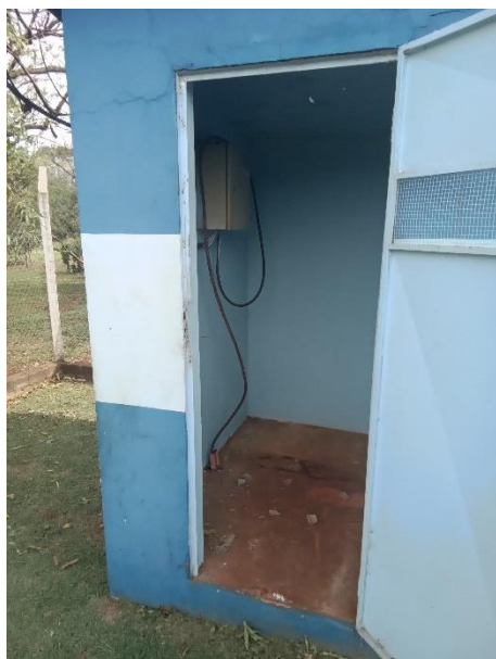
Foto 12 – Falta de identificação casa de comando poço Mumback
