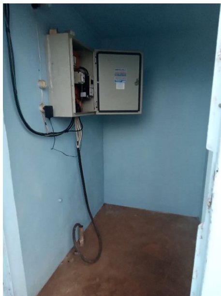
Foto 44 – Casa de comando poço Luis Roir
