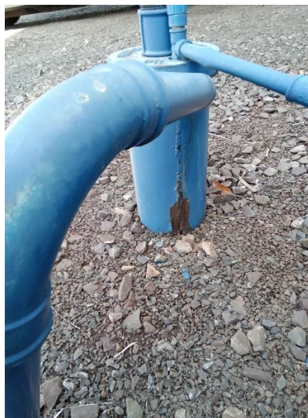
Foto 85 – Detalhe poço Centro de Eventos
