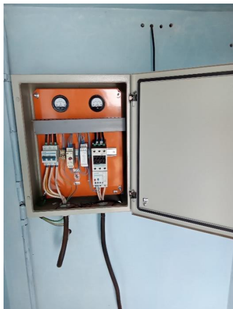
Foto 76 – Quadro de energia poço Asseper
