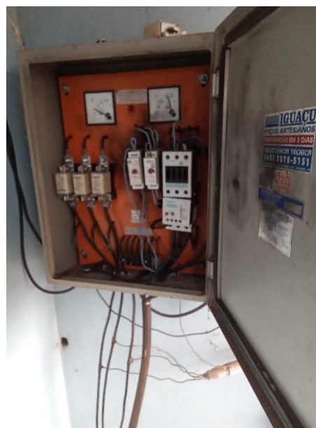
Foto 51 – Quadro de comando poço Edézio
