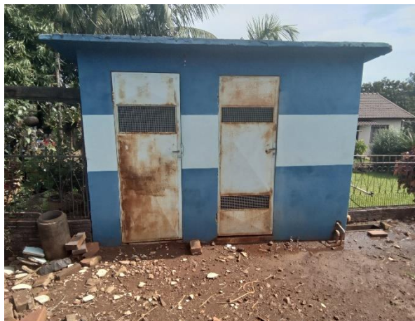
Foto 14 – Sem isolamento, sem identificação e falta de manutenção casa de comando e tratamento poço Adelar Barques
