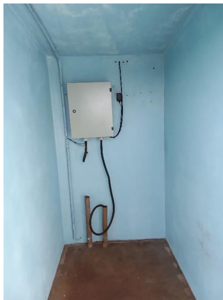
Foto 75 – Frente do quadro de energia poço Asseper
