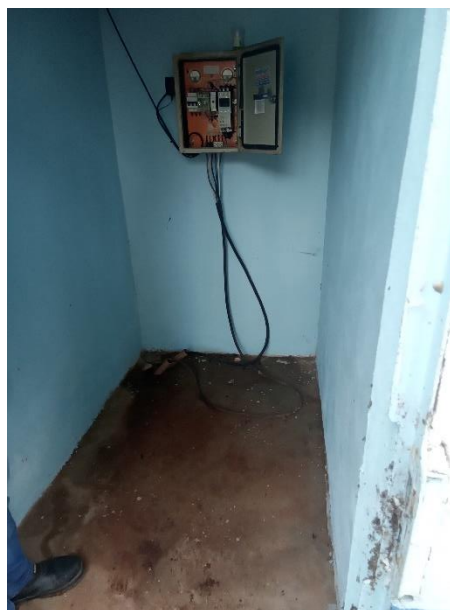
Foto 29 – Problemas de infiltração na laje poço João Brixner
