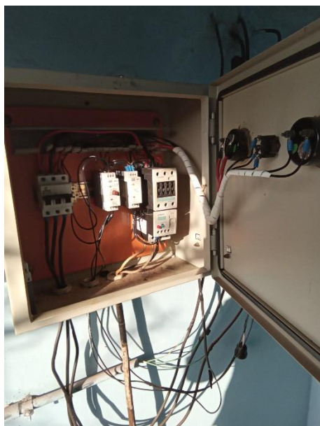
Foto 66 – Quadro de energia poço Elpídeo
