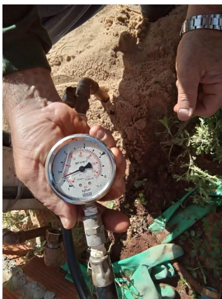
Foto 150 – Medição pressão na rede P01 – P = 19 mca
