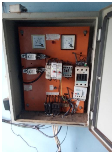
Foto 45 – Quadro de energia poço Luis Roir
