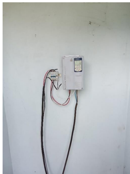
Foto 89 – Quadro de energia poço Parque Industrial 2
