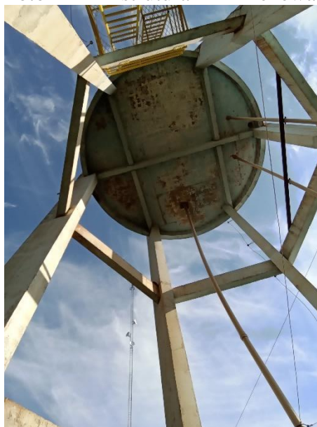
Foto 141 – Estrutura REL Rekewalt
