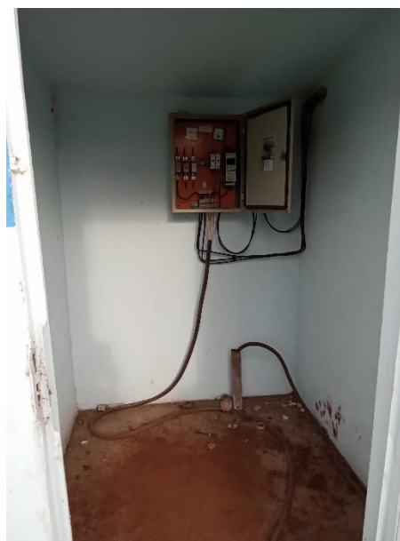
Foto 59 – Casa de comando poço Hélio Bren
