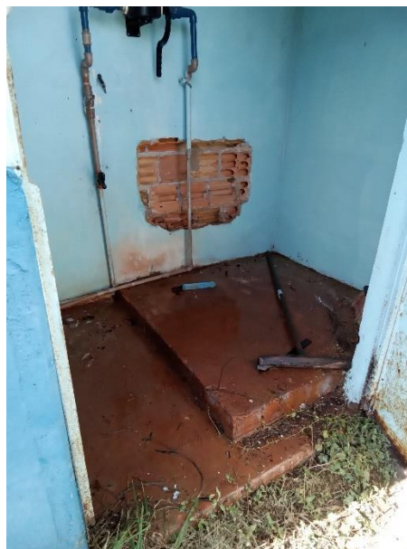
Foto 125 – Vazamento UTA Rodenkol
