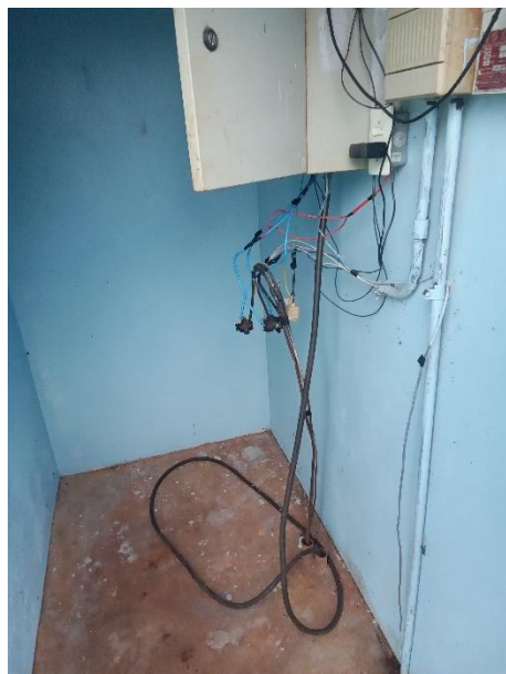
Foto 35 – Fiação exposta poço Paulo Khun
