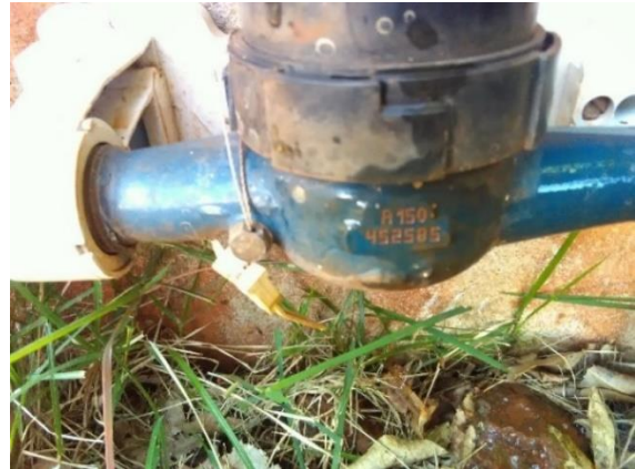
Foto 146 – Identificação hidrômetro P03
