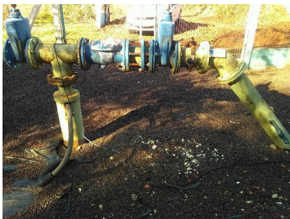
Foto 46 – Poço tubular profundo 14
