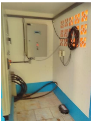
Foto 20 – Frente do quadro de comando PT008
