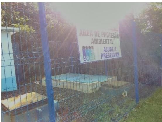
Foto 173 – Isomamento elevatória EEE 001
