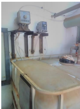
Foto 69 – Bombas dosadoras UTA 04
