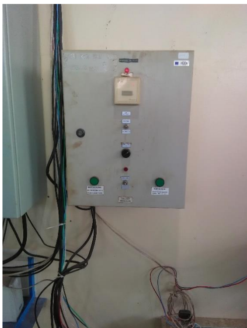
Foto 58 – Frente do quadro de comando da unidade de tratamento UTA 01
