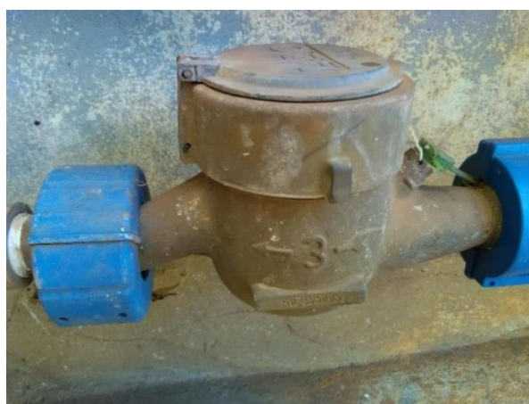
Foto 152 – Identificação hidrômetro P05
