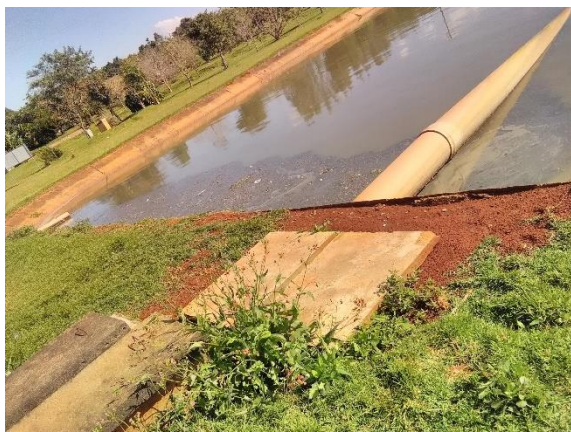
Foto 166 – Entrada lagoa anaeróbia 01
