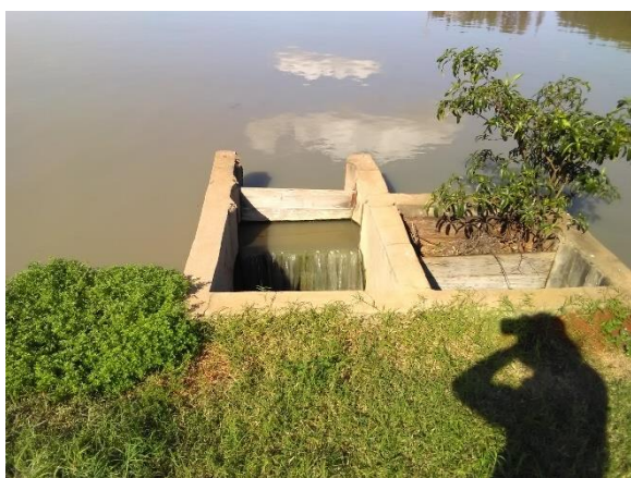
Foto 169 – Saída da lagoa anaeróbia 02
