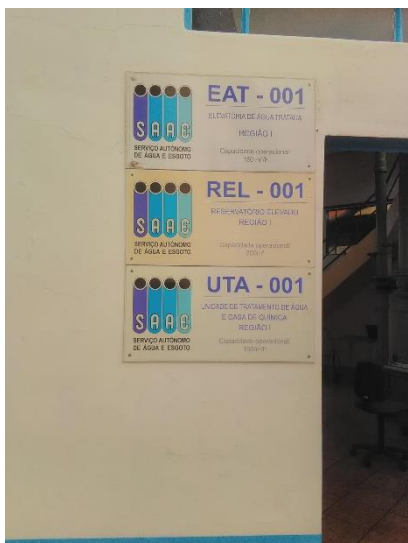
Foto 112 – Identificação elevatória EAT 01
