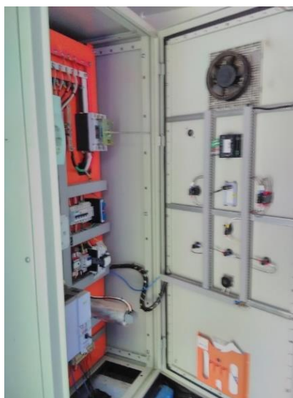
Foto 21 – Quadro de comando PT008
