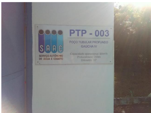
Foto 54 – Identificação poço tubular profundo 03
