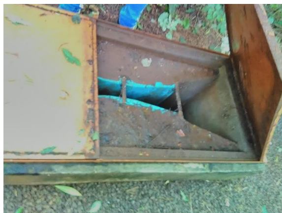
Foto 180 – Calha Parshaal da EEE 001
