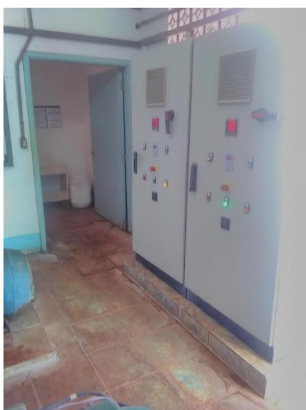
Foto 132 – Frente quadro de energia EAT 03
