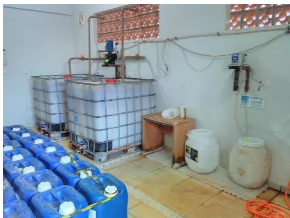
Foto 62 – Bombas dosadoras UTA 02
