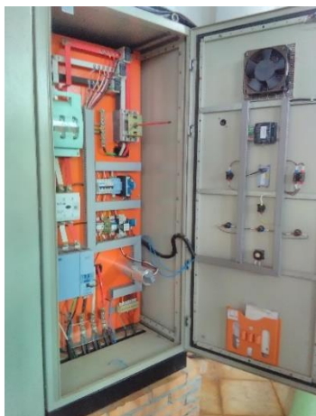
Foto 116 – Quadro de comando da EAT 01
