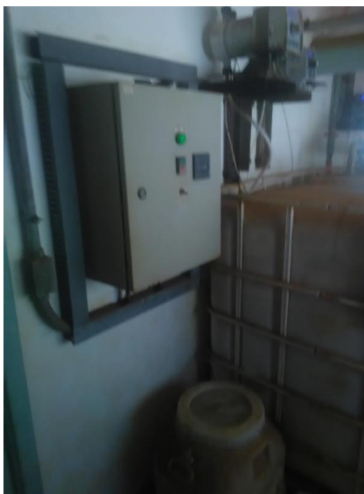
Foto 71 – Frente do quadro de comando UTA 04
