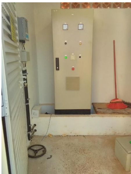
Foto 82 – Frente do quadro de comando 01 ETA
