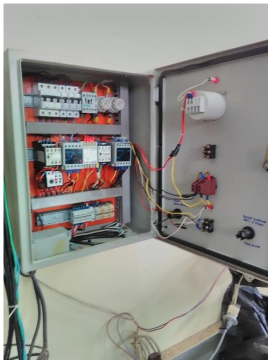
Foto 59 – Quadro de comando da UTA 01
