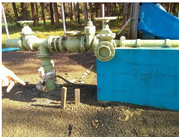
Foto 55 – Poço tubular profundo 03
