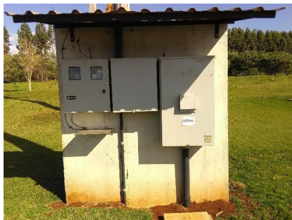
Foto 172 – Quadro de energia ETE
