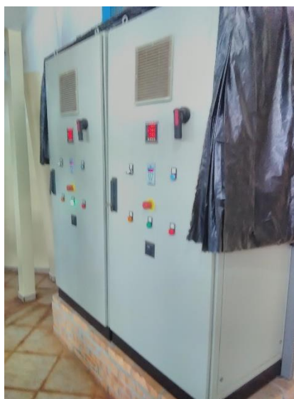
Foto 115 – Frente do quadro de comando elevatória 01
