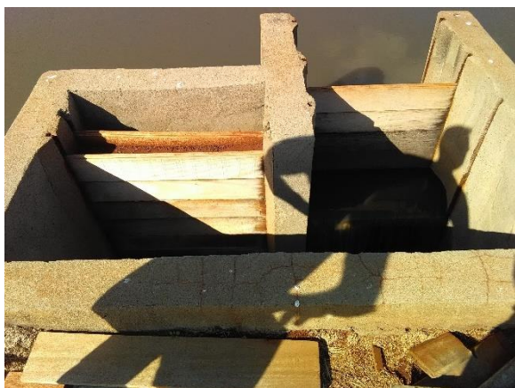
Foto 167 – Saída lagoa anaeróbia 01
