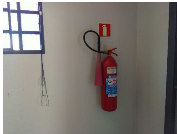
Foto 42 – Extintor de incêndio na elevatória
