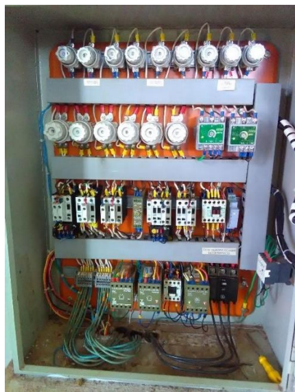
Foto 41 – Quadro de comando da elevatória
