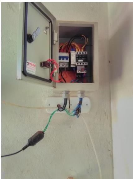
Foto 22 – Quadro de comando poço Fernão Dias
