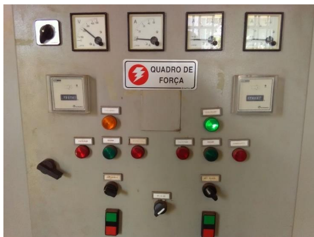
Foto 40 – Frente do quadro de comando da elevatória
