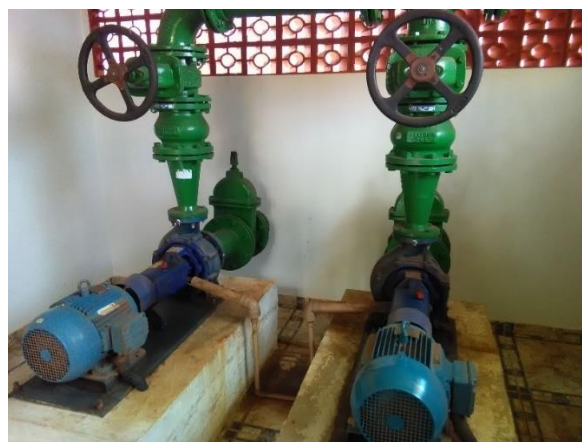
Foto 38 – Conjunto moto bomba da elevatória
