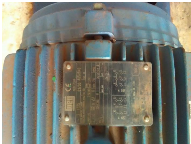
Foto 39 – Identificação bomba elevatória
