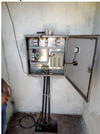
Foto 42 – Quadro de comando Silvio Faccin
