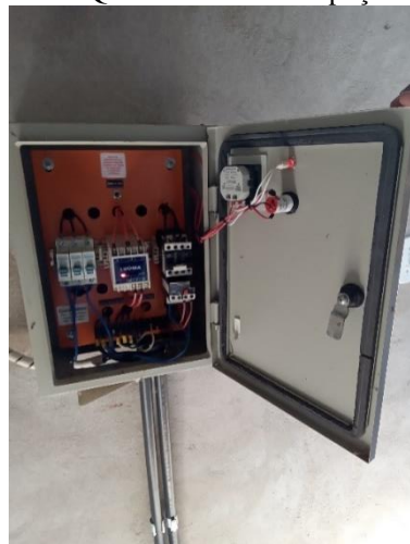
Foto 47 – Quadro de comando poço Braga
