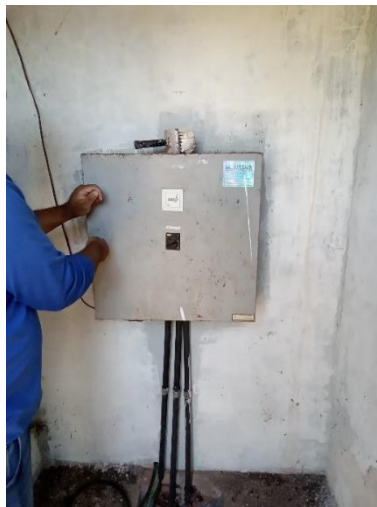
Foto 41 – Frente quadro de comando poço poço Silvio Faccin
