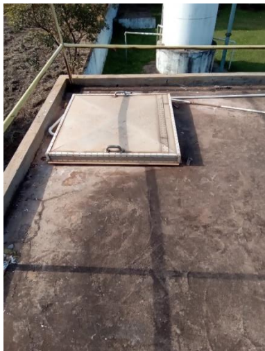
Foto 71 – Abertura RAP sede sem cadeado
