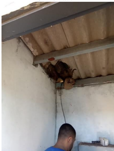
Foto 40 – Necessidade de impedir aberturas (abertura viga de respaldo) para restringir acesso de insetos poço Silvio Faccin
