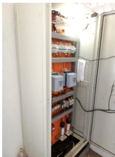
Foto 105 – Quadro de comando elevatória Jardim Europa
