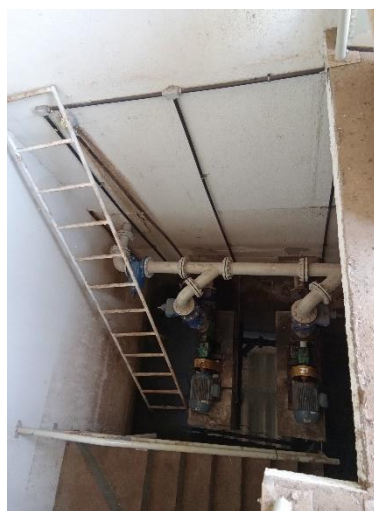
Foto 103 – Vazamento J. Europa
