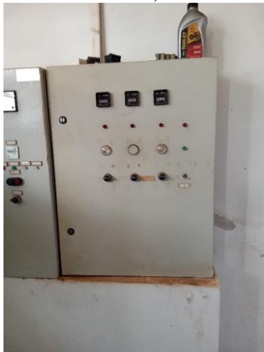
Foto 53 – Frente do quadro de comando elevatória
