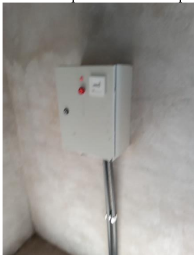
Foto 46 – Frente do quadro de comando poço Braga
