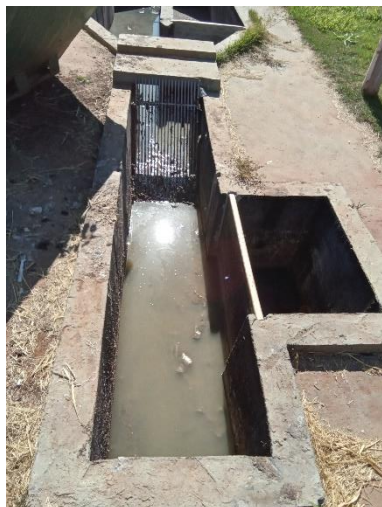
Foto 106 – Gradeamento elevatória J. Europa
