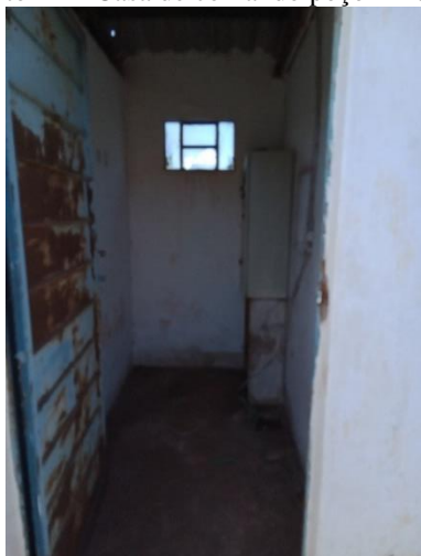
Foto 26 – Quadro de comando poço Milton
