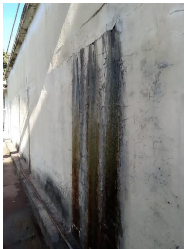
Foto 70 – Indícios de vazamentos RAP sede
