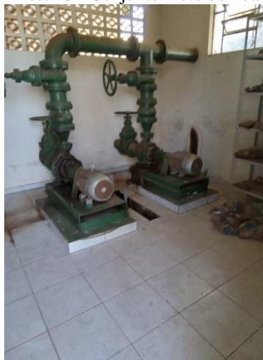
Foto 49 – Conjunto moto bomba
