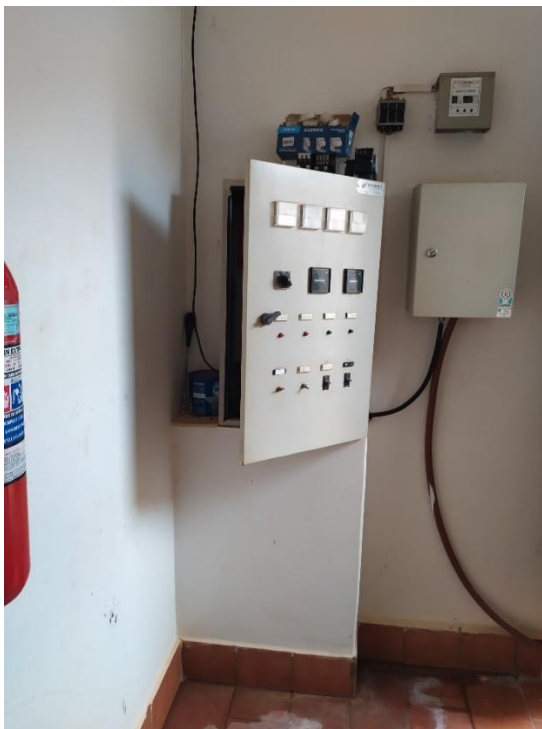
Foto 32 - Frente do quadro de comando da elevatória
