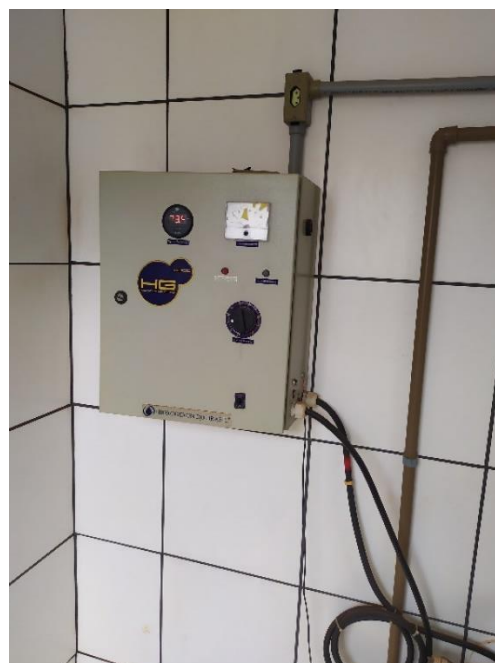
Foto 20 – Frente quadro de comando dosadora
