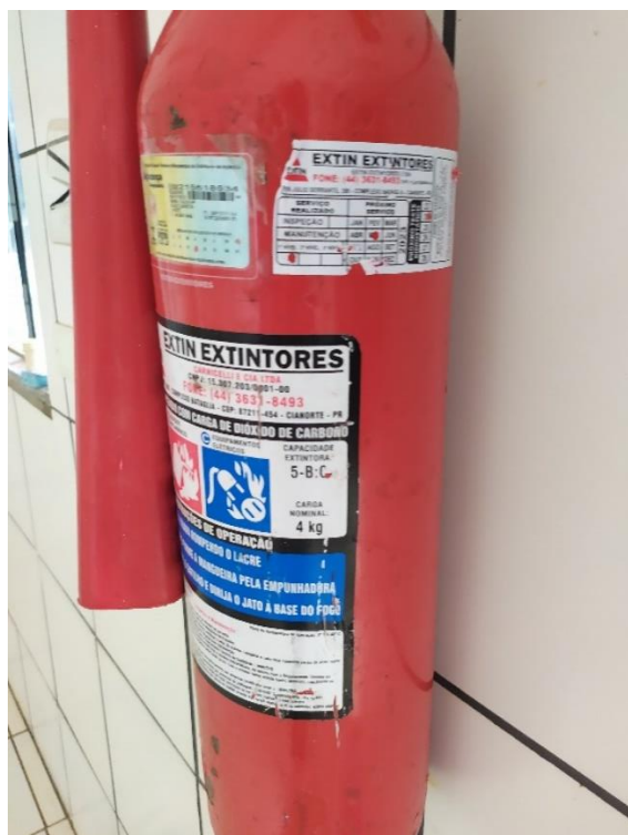
Foto 19 – Extintor na unidade de tratamento
