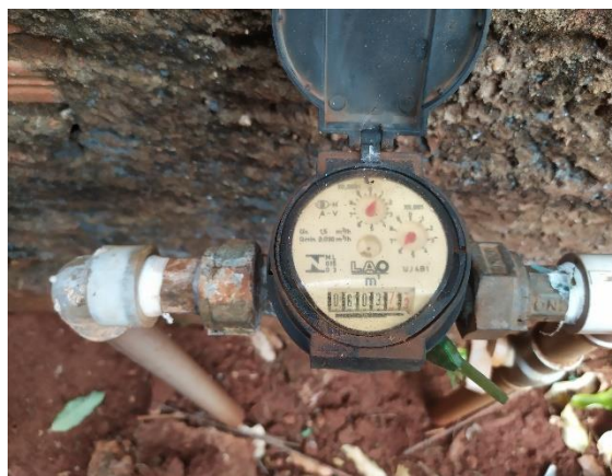
Foto 35 – Hidrômetro Avenida Tiradentes, nº. 16
