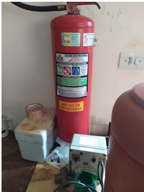
Foto 07 – Extintor área almoxarifado
