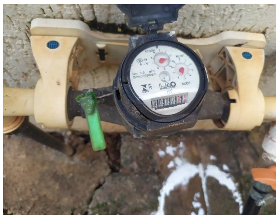
Foto 38 – Hidrômetro Av Tiradentes, nº. 126 Foto 39 – Identificação hidrômetro Av Tiradentes, nº. 126
