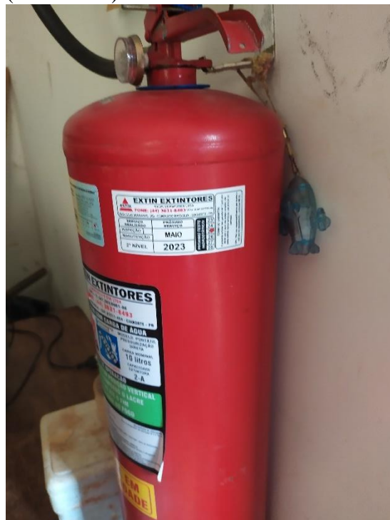
Foto 08 – Validade extintor do almoxarifado (maio/2023)
