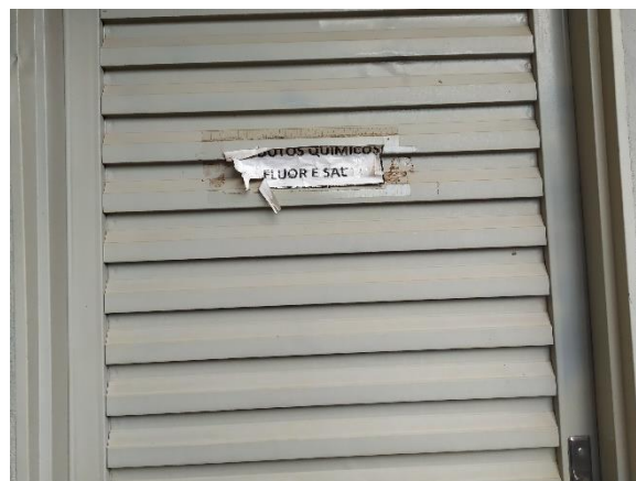
Foto 22 – Identificação estoque de produtos químicos da unidade de tratamento
