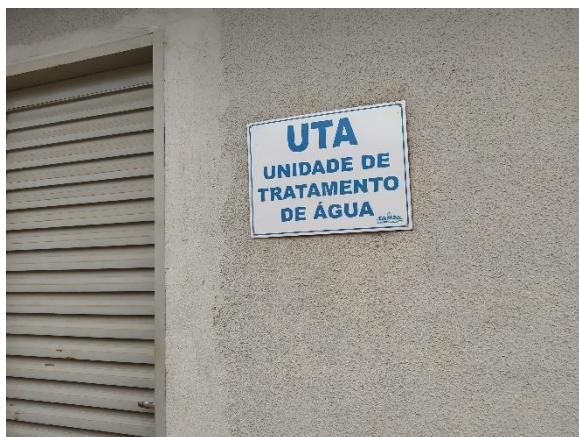
Foto 17 – Identificação unidade de tratamento
