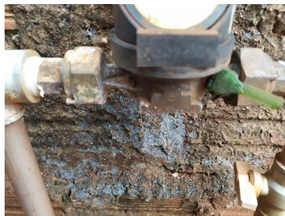
Foto 36 – Identificação do hidrômetro Av. Tiradentes, nº. 16
