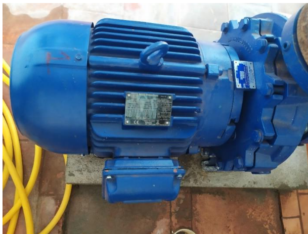
Foto 31 – Bomba da elevatória
