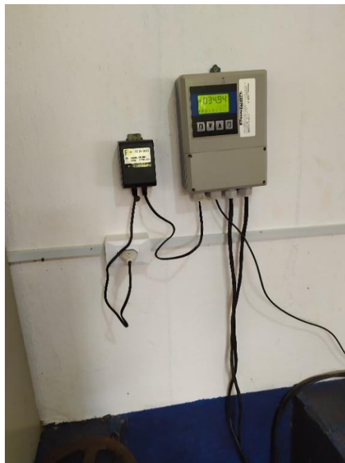
Foto 34 – Medidor de vazão poço 03
