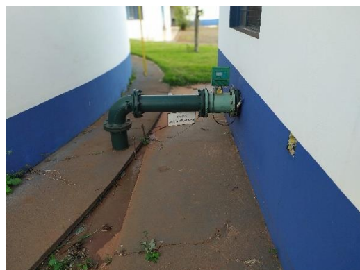
Foto 69 – Medidor de vazão saída do tratamento
