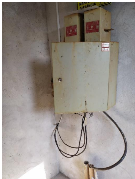
Foto 23 – Frente do quadro de comando poço 02
