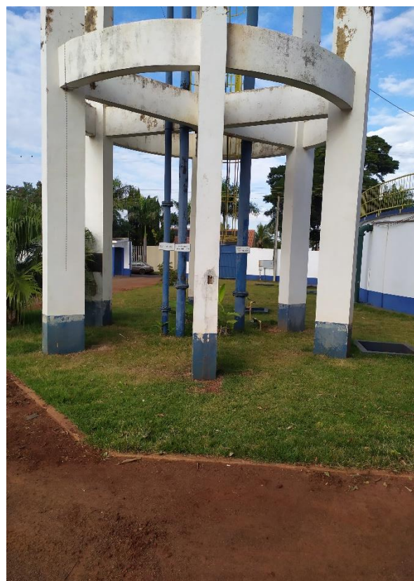
Foto 67 – Detalhe entrada, saída e extravasador do REL sede
