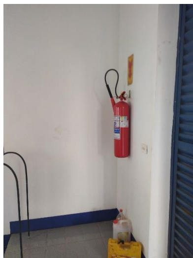
Foto 12 – Extintor na casa de máquinas (poço 01)
