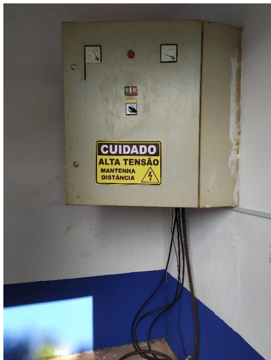
Foto 27 – Frente quadro de comando poço 02
