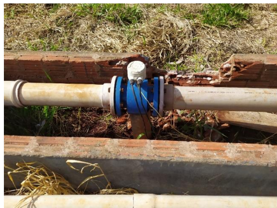
Foto 71 – Medidor de vazão sistema 02
