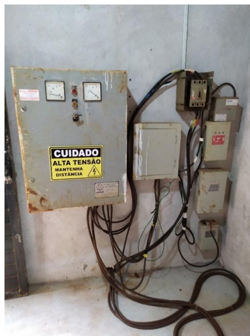
Foto 38 – Frente do quadro poço 04
