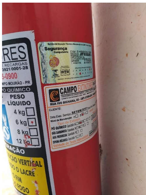
Foto 07 – Extintor área almoxarifado
