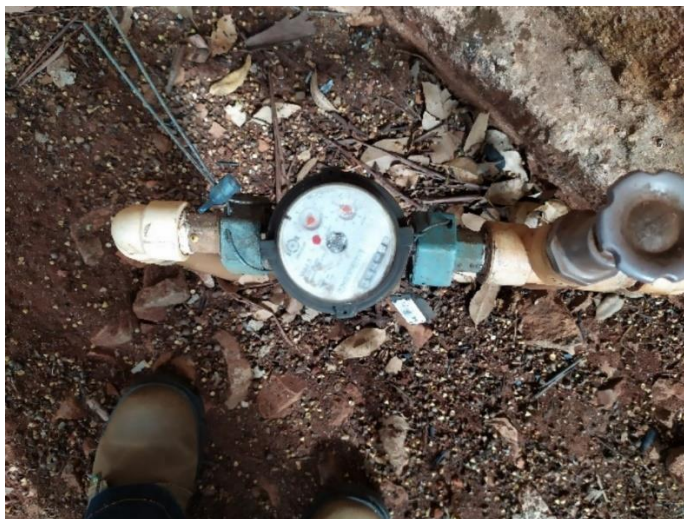
Foto 84 - Hidrômetro Ginásio Municipal de Peabiru (Latitude: -23.919232°, -Longitude: -- 52.336543°)
