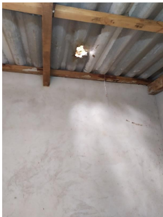
Foto 37 – Telha quebrada abrigo poço 04
