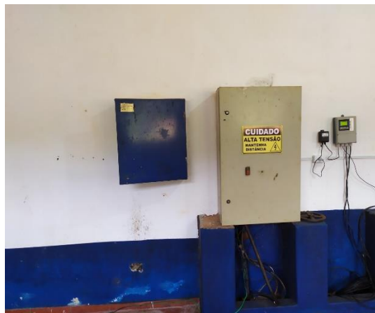
Foto 32 – Frente quadro de comando poço 05
