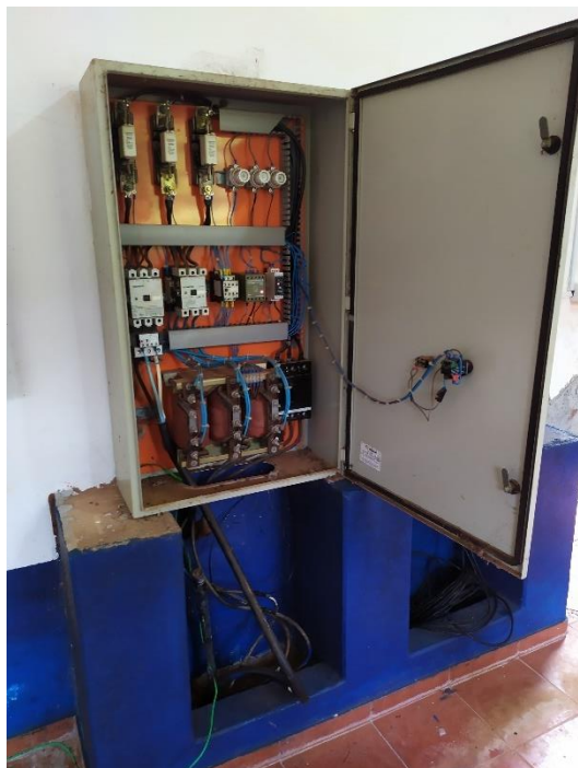
Foto 33 – Quadro de comando poço 03
