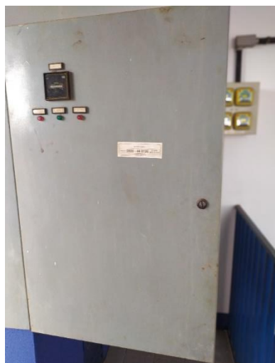
Foto 10 – Frente do quadro de comando poço 06
