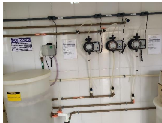
Foto 52 – Bombas dosadoras de cloro e flúor (unidade 01 – sede)
