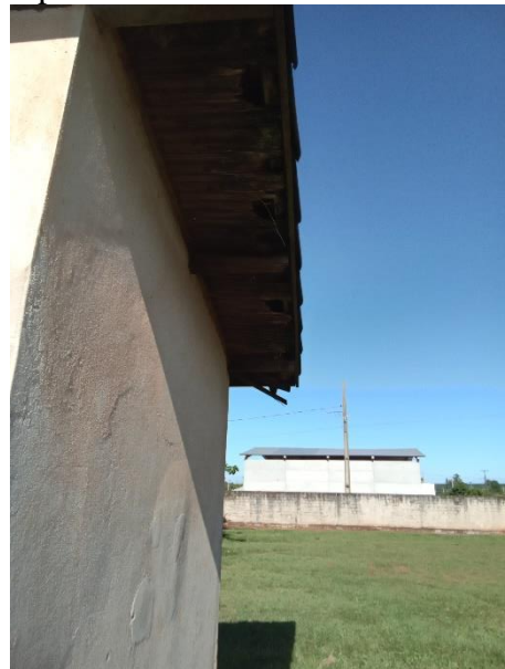
Foto 18 – Casa de comando necessitando reparos casa de comando distrito
