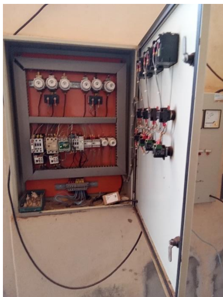
Foto 30 – Quadro de comando elevatória distrito
