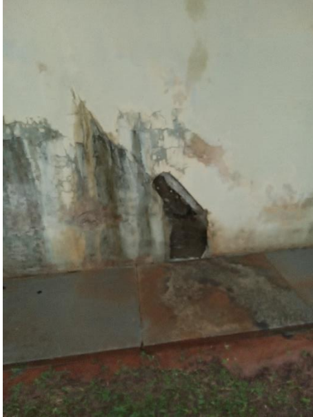
Foto 36 – Armadura exposta RAP sede
