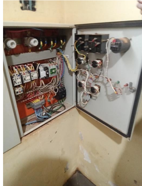
Foto 27 – Quadro de comando elevatória sede
