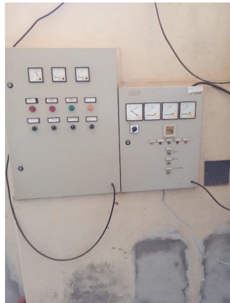
Foto 29 – Frente do quadro de comando elevatória distrito
