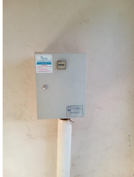
Foto 16 – Frente do quadro de comando poço distrito
