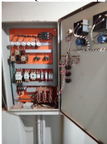
Foto 23 – Quadro de comando poço sede
