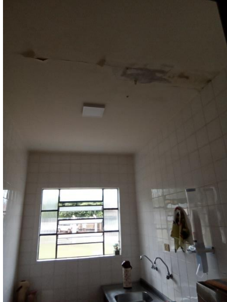
Foto 7 – Problemas na cobertura
