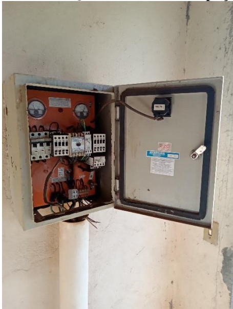
Foto 17 – Quadro de comando poço distrito
