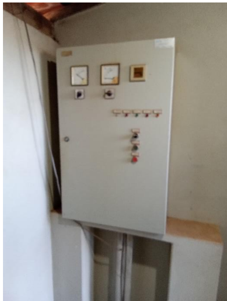
Foto 22 – Frente do quadro de comando poço sede
