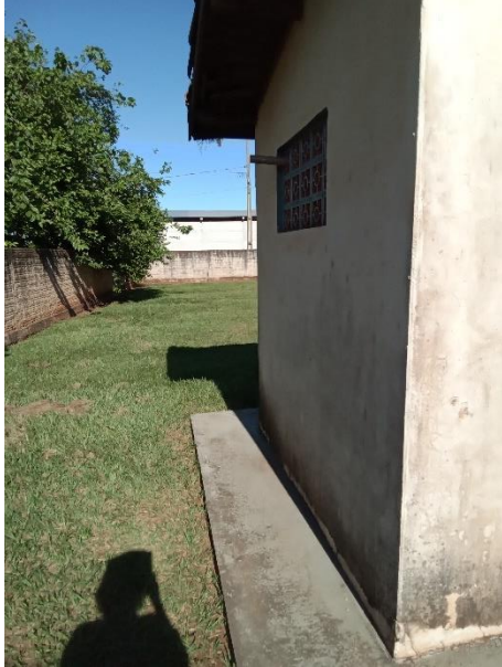
Foto 19 – Falta de tela mosquiteira casa de comando distrito
