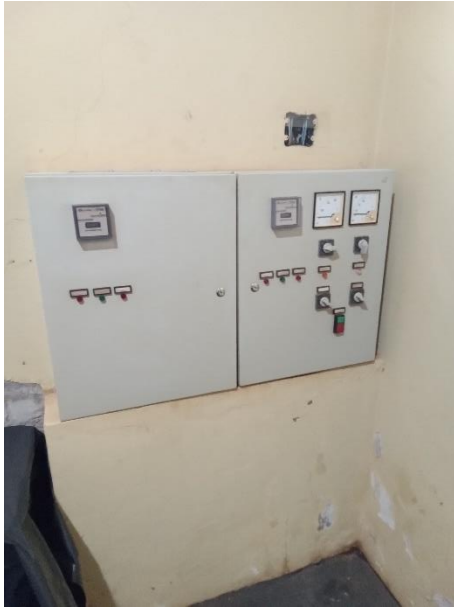
Foto 26 – Frente do quadro de comando elevatória
