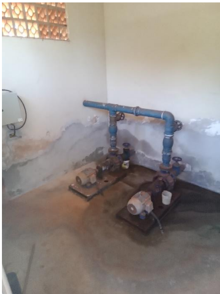
Foto 28 – Conjunto moto bomba elevatória distrito
