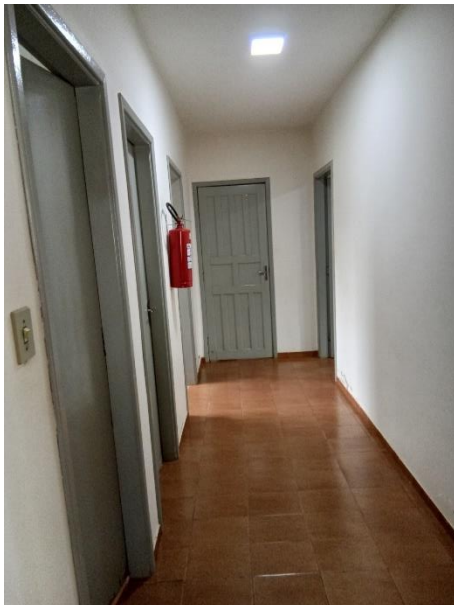
Foto 5 – Falta de identificação ambientes
