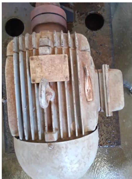
Foto 31 – Identificação bomba elevatória sede
