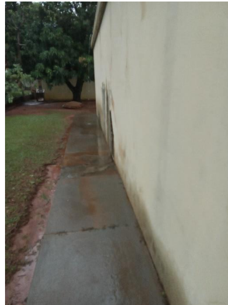
Foto 35 – Indícios de vazamento RAP sede
