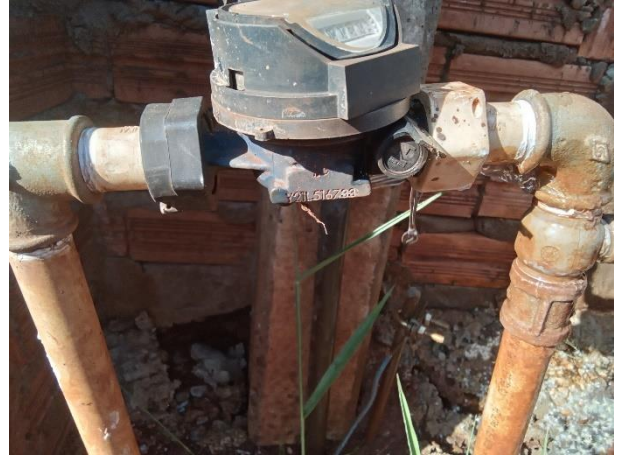
Foto 87 - Identificação hidrômetro P03 (2010)
