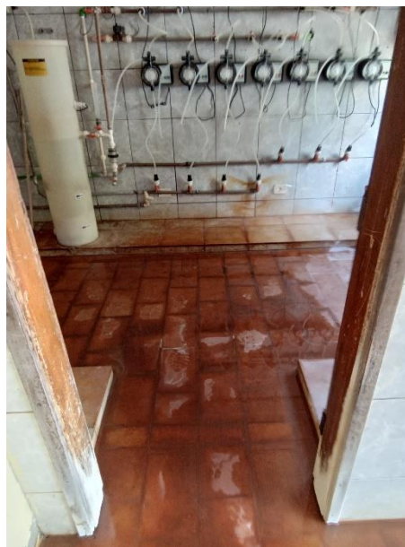
Foto 60 – Problema de vazamento
