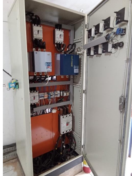
Foto 45 – Quadro de comando elevatória leste
