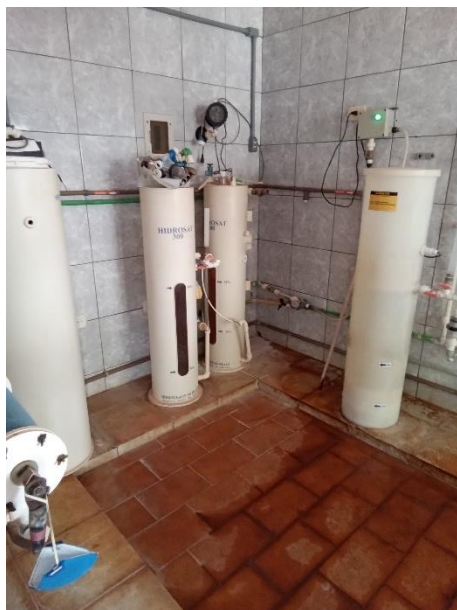
Foto 59 – Tanque de flúor
