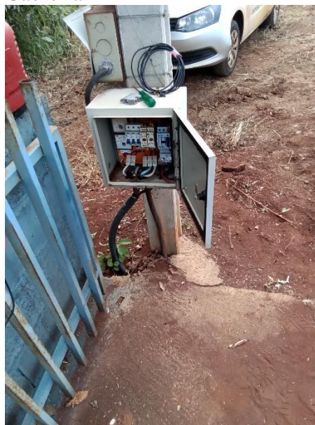
Foto 29 – Quadro de comando poço Cabreira
