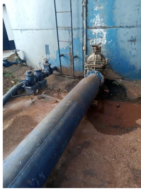
Foto 76 – Registros Reservatório sede
