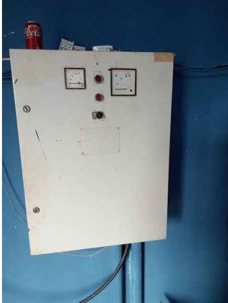
Foto 22 – Frente do quadro de comando poço Pátio 1
