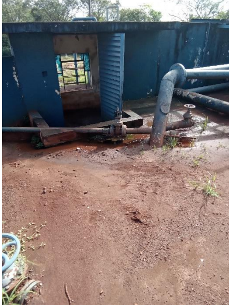
Foto 63 – Instalações hidráulicas RSENT zona norte
