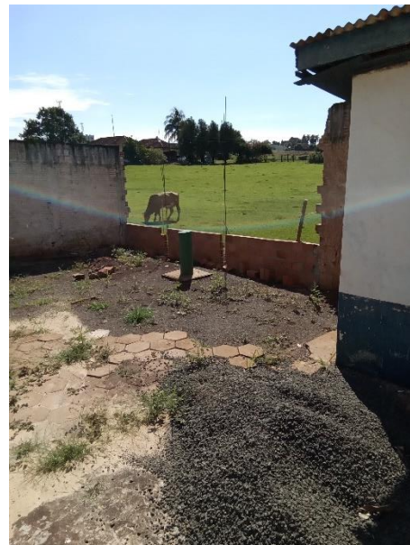
Foto 47 – Isolamento recalque setor sul danificado
