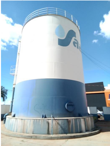
Foto 69 – Reservatório zona leste (água tratada)
