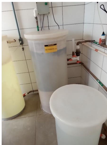
Foto 54 – Tanque de cloro UTA leste
