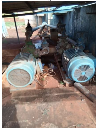
Foto 37 – Conjunto moto bomba
