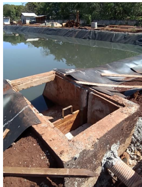
Foto 109 – Saída lagoa anaeróbia
