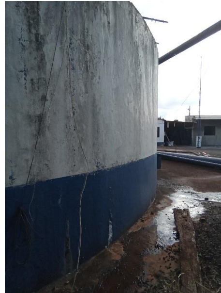
Foto 74 – Vazamento Reservatório sede
