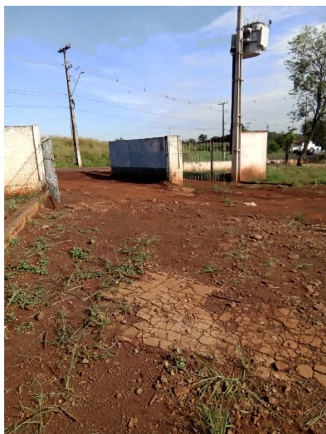
Foto 18 – Acesso poços captação norte (poços: Piscina e Pátio 1
