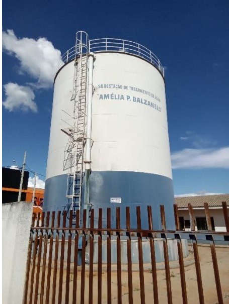
Foto 71 – Escala Reservatório zona leste (água tratada)
