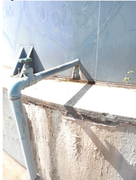
Foto 70 – Vazamento Reservatório zona leste (água tratada)
