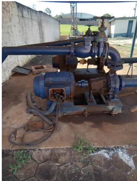
Foto 46 – Elevatória setor sul
