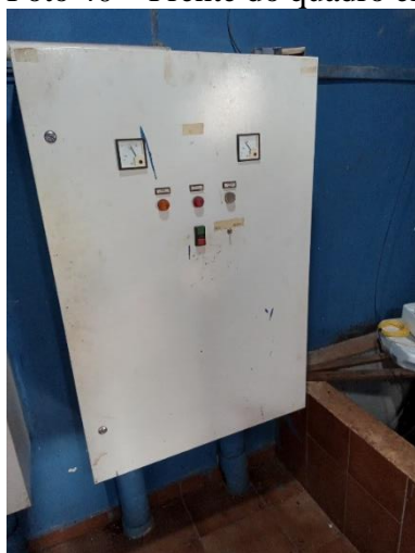
Foto 40 – Frente do quadro elevatória norte
