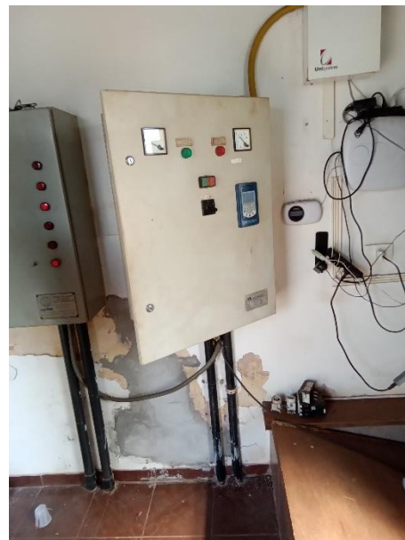
Foto 51 – Frente do quadro de comando elevatória setor sul
