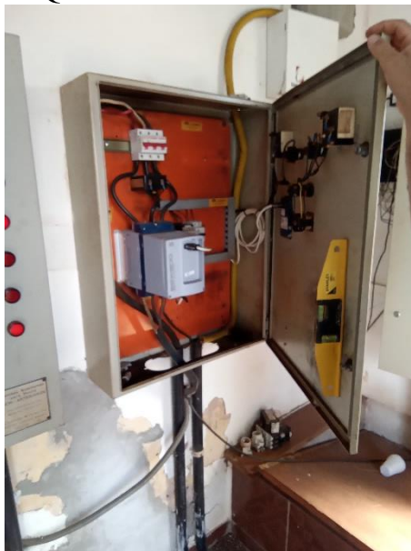
Foto 52 – Quadro de comando elevatória setor sul
