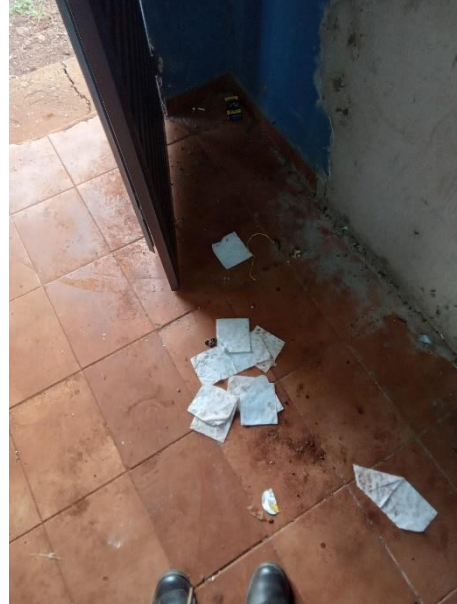
Foto 23 – Falta de limpeza e manutenção Casa de Comando poços Pátio 1 e Piscina
