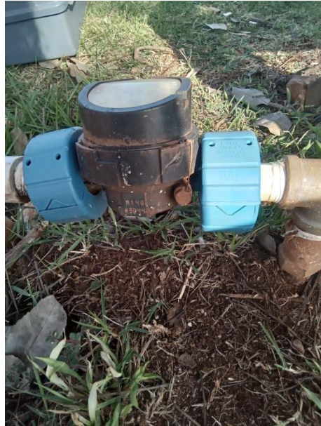
Foto 81 - Identificação hidrômetro P01 (2014)
