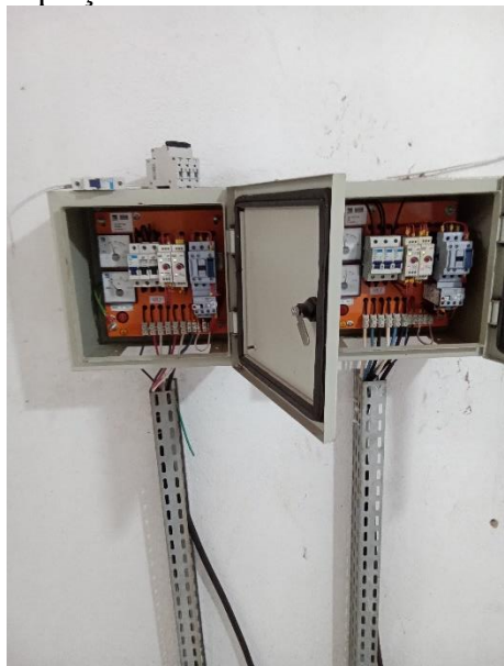
Foto 26 – Quadros de comando poços captação leste
