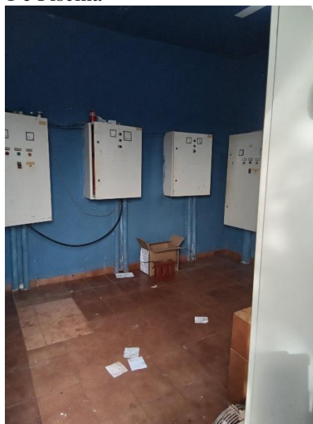
Foto 21 – Casa de comando poços Pátio 1 e Piscina
