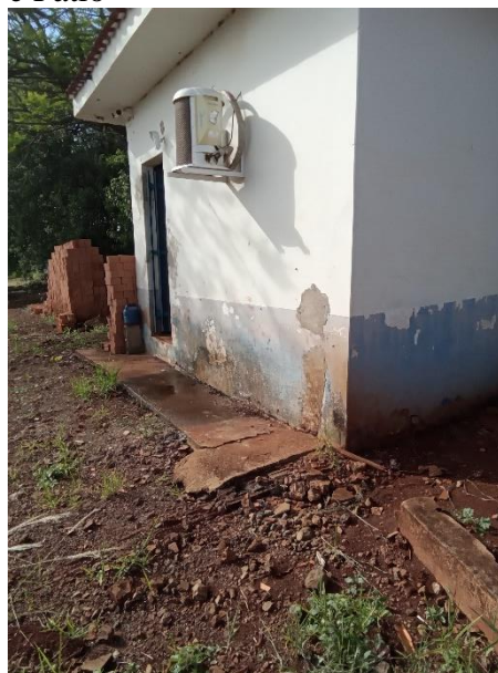
Foto 19 – Casa de comando poços Piscina e Pátio
