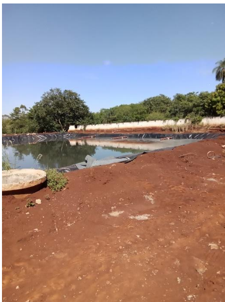
Foto 108 – Entrada lagoa anaeróbia
