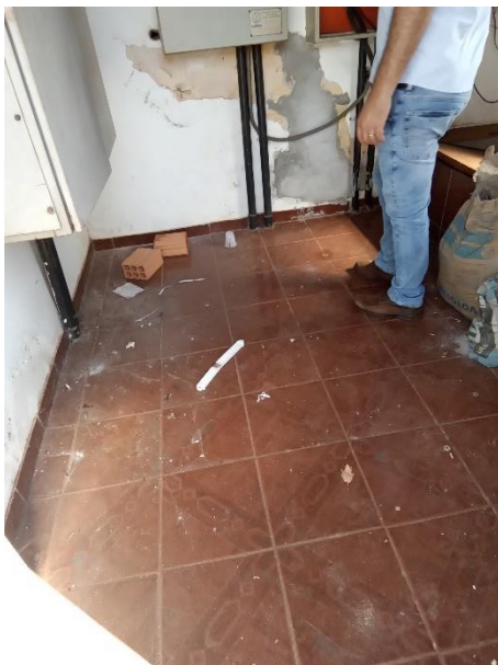
Foto 50 – Falta de limpeza casa de comando elevatória setor sul
