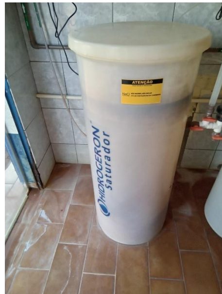
Foto 58 – Tanque de cloro
