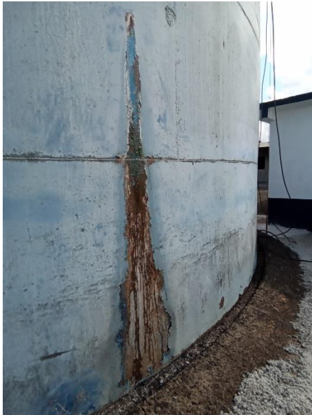
Foto 77 – Vazamento Reservatório sede
