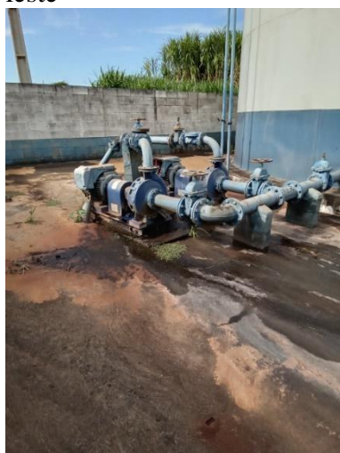
Foto 42 – Conjunto moto bomba elevatória leste
