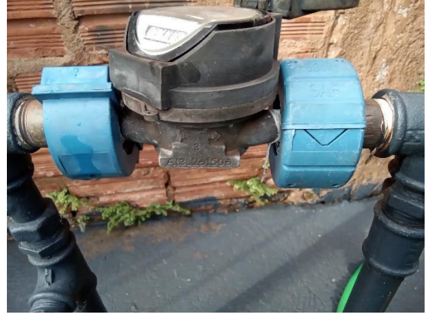
Foto 84 - Identificação hidrômetro P02 (2011)
