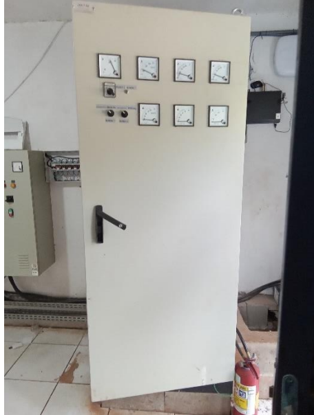
Foto 44 – Frente do quadro de comando elevatória leste
