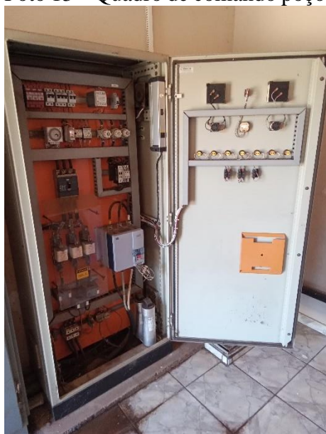
Foto 13 – Quadro de comando poço Barro Preto
