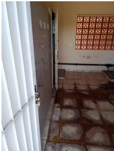
Foto 11 – Casa de comando poço Barro Preto
