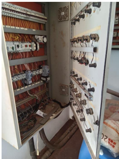
Foto 82 – Quadro de comando principal
