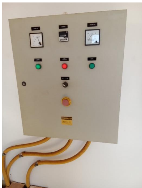
Foto 29 – Frente do quadro de comando elevatória
