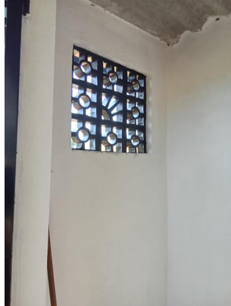
Foto 23 – Sem tela mosquiteira casa de comando Vila Rural
