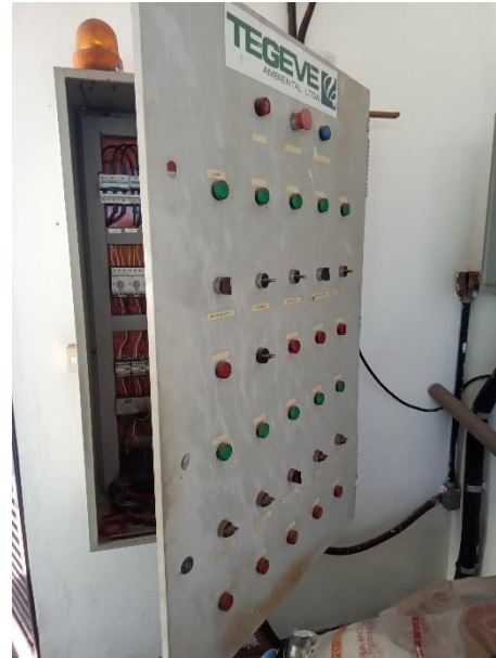
Foto 81 – Frente do quadro de comando principal
