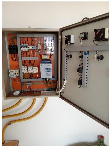
Foto 30 – Quadro de comando elevatória
