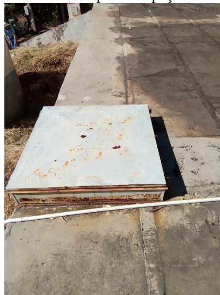
Foto 39 – Tampa de inspeção 01 RSENT
