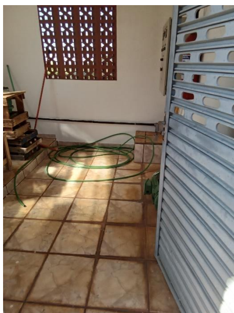
Foto 27 – Casa de máquinas (elevatória)
