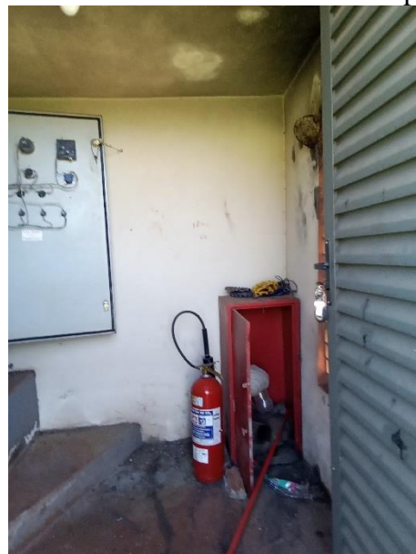
Foto 18 – Casa de comando captação Matida com abelhas e falta de limpeza
