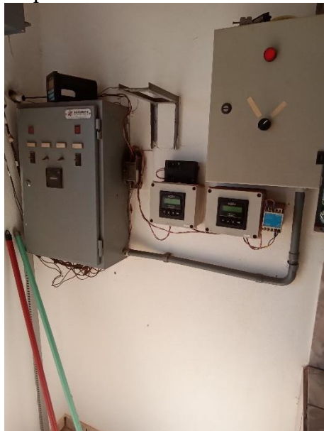
Foto 42 – Macromedidores RSENT inoperantes
