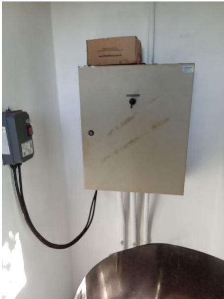
Foto 24 – Frente do quadro de comando poço Vila Rural
