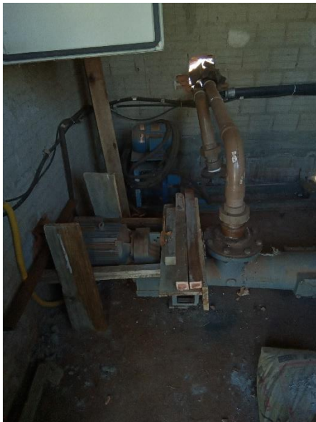
Foto 73 – Conjunto moto bomba elevatória esgoto
