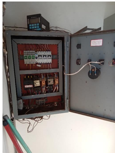
Foto 37 – Quadro de comando 01 UTA
