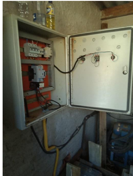
Foto 74 – Quadro 01 elevatória esgoto
