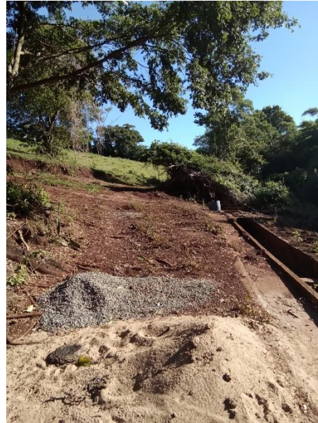
Foto 68 – Sem isolamento elevatória de esgoto
