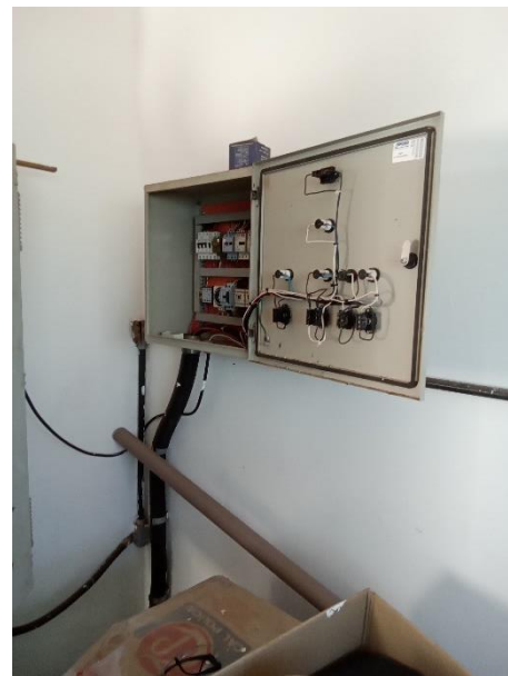
Foto 83 – Quadro de comando secundário
