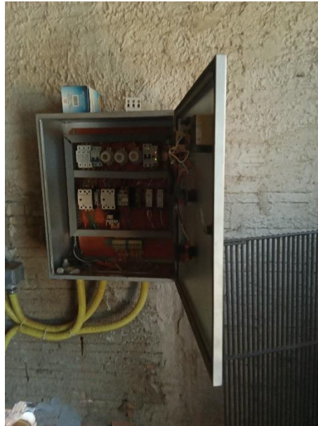
Foto 75 – Quadro de comando 02 elevatória esgoto
