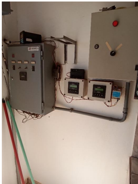
Foto 36 – Frente do quadro de comando bombas dosadoras
