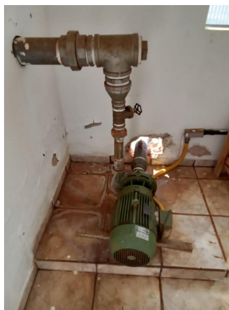
Foto 28 – Conjunto moto bomba
