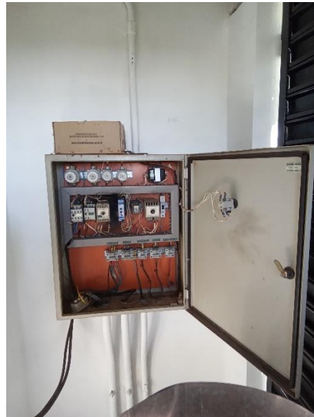
Foto 25 – Quadro de comando poço Vila Rural
