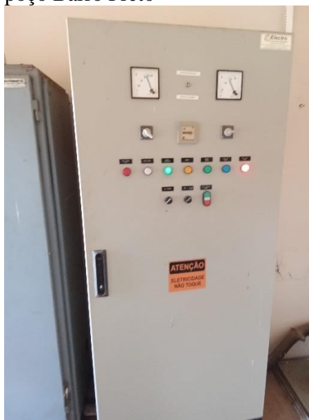
Foto 12 – Frente do quadro de comando poço Barro Preto
