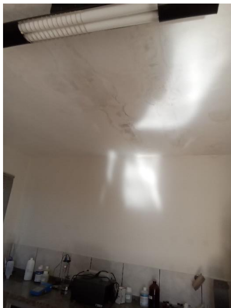
Foto 64 – Problemas na laje
