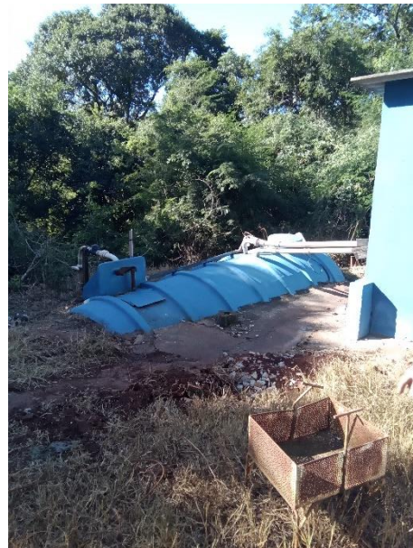
Foto 70 – Elevatória de esgoto
