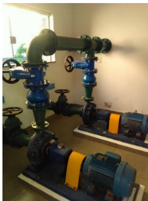
Foto 44 – Conjunto moto bomba elevatória
