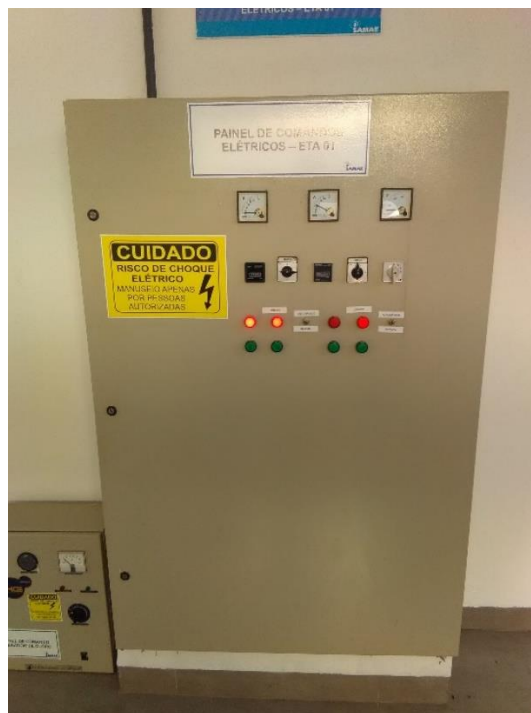
Foto 46 – Frente do quadro de comando elevatória
