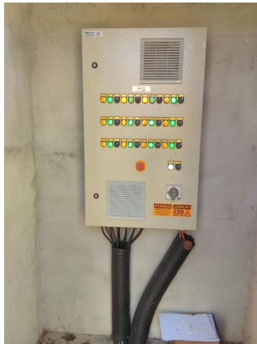
Foto 75 – Frente quadro ETE
