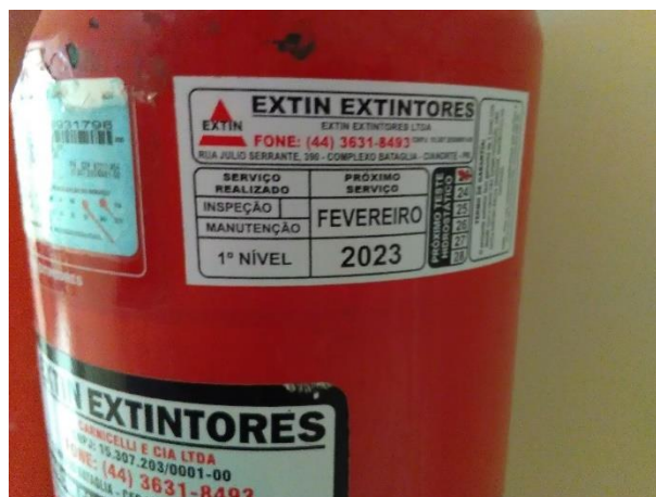
Foto 13 – Extintor no pátio de manutenção
