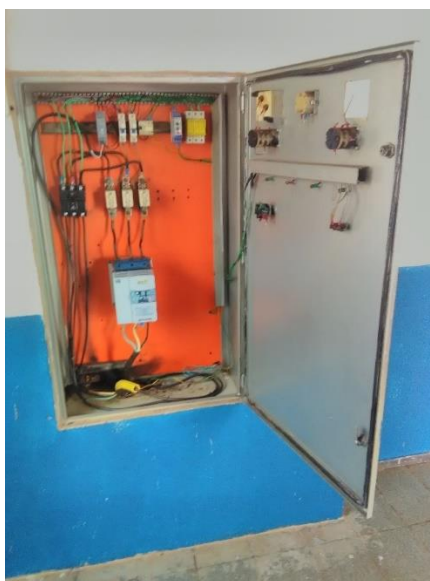
Foto 21 – Quadro de comando poço 01
