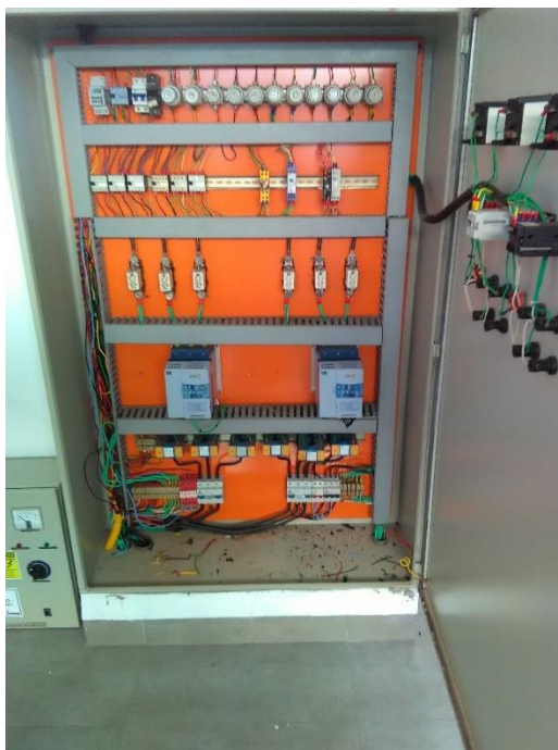
Foto 47 – Quadro de comando elevatória
