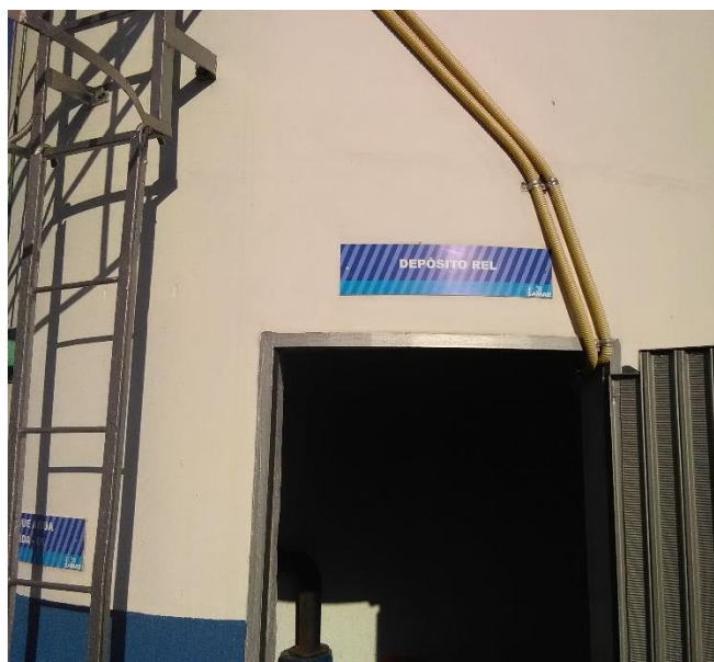
Foto 31 – Depósito do reservatório elevado
