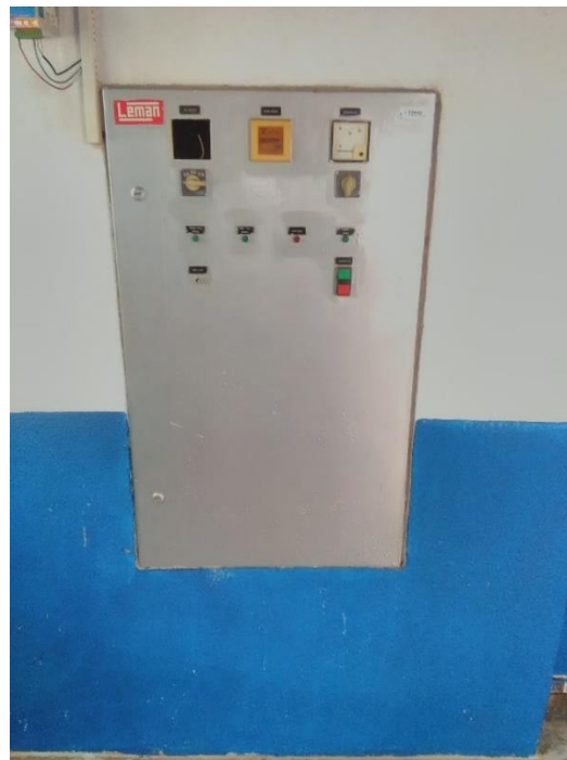
Foto 20 – Frente do quadro de comando poço 01
