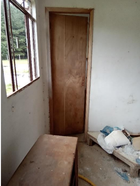
Foto 47 – Falta de manutenção, limpeza e segurança na casa de comando ETE
