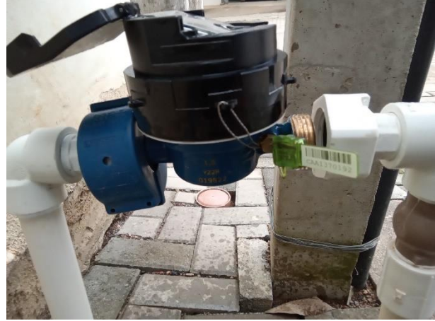
Foto 33 - Identificação hidrômetro P02 (2022)
