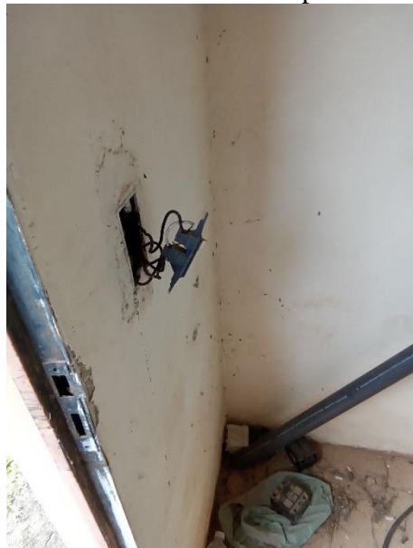
Foto 17 – Falta de interruptor
