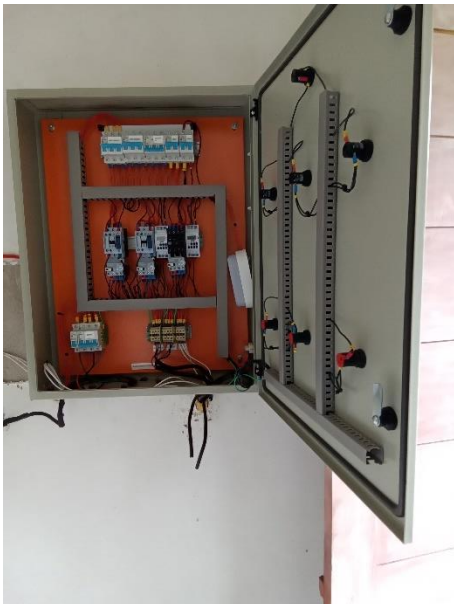
Foto 49 – Quadro de comando ETE
