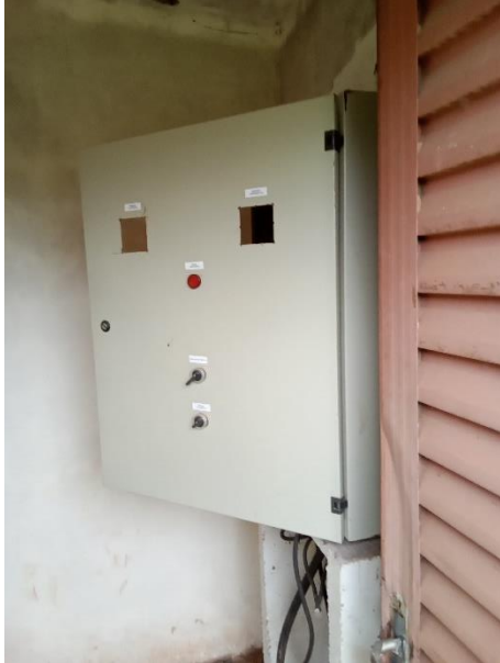
Foto 18 – Frente do quadro de comando
