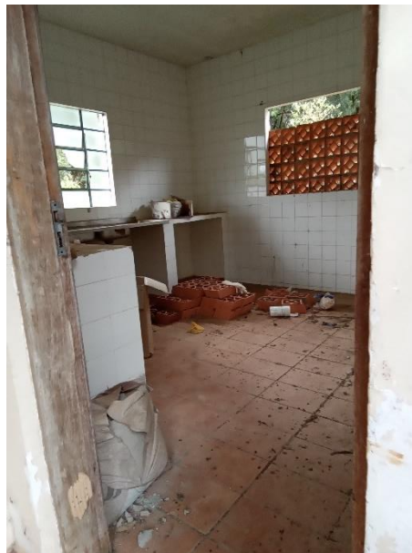
Foto 36 – Local onde deveria estar funcionando laboratório
