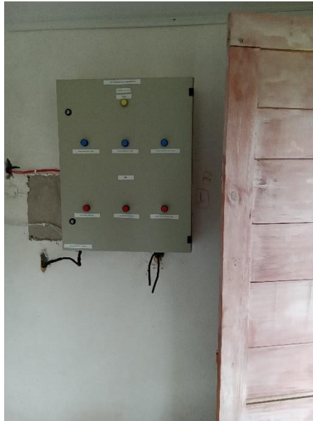
Foto 48 – Frente do quadro de comando ETE
