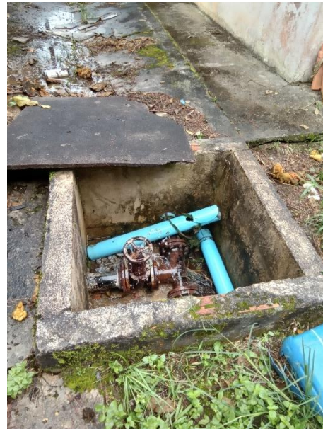
Foto 28 – Problemas com instalação hidráulica RAP
