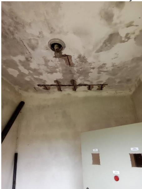
Foto 16 – Ausência de manutenção laje
