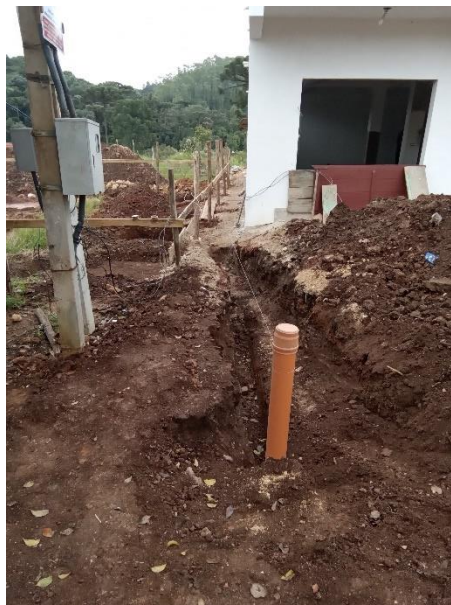
Foto 50 - Residência sendo construída sob servidão de passagem de emissário de esgoto
