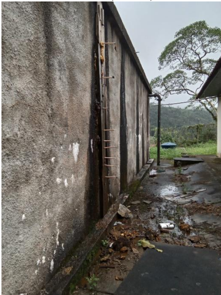
Foto 27 – Vazamentos e problemas estruturais RAP (fundo)
