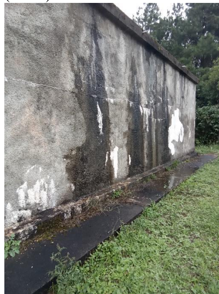
Foto 24 – Indícios de vazamentos RAP (frente)
