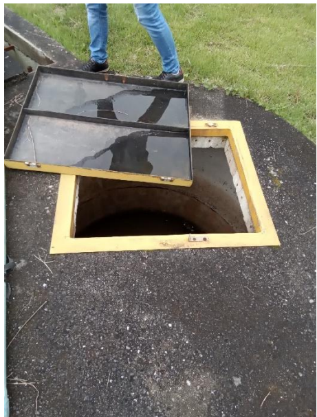
Foto 43 – Tampa de acesso ao reator anaeróbio com problemas no fechamento
