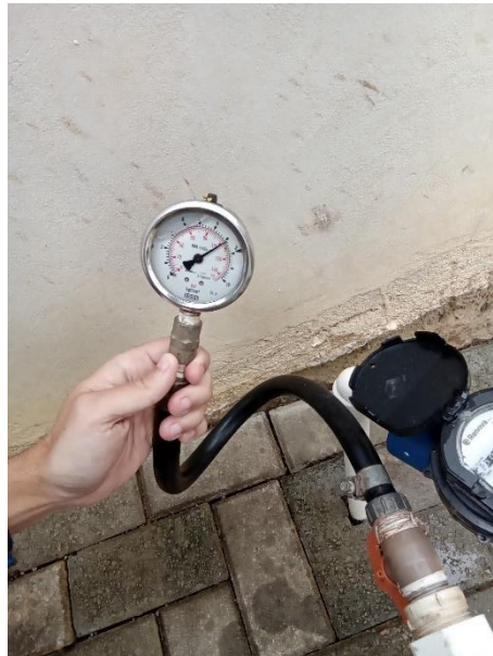
Foto 34 – Hidrômetro P02 – P = 71.40 mca (102 psi)
