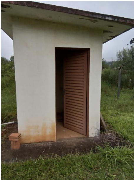
Foto 14 – Casa de comando poço sede (sem identificação e fechadura porta)
