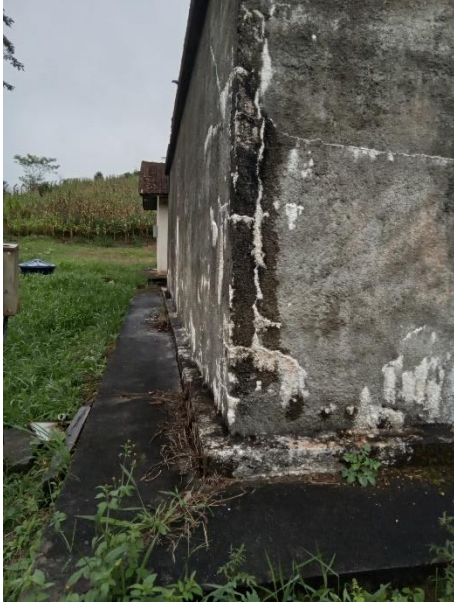
Foto 25 – Indícios de eflorescências (lado direito)
