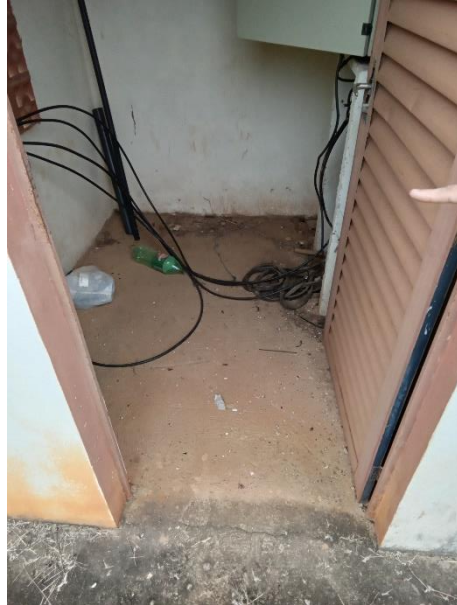
Foto 15 – Ausência de limpeza casa de comando
