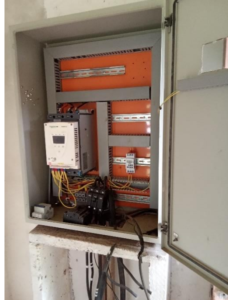
Foto 19 – Quadro de comando (soft starter não estava operando)
