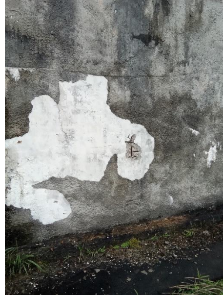
Foto 26 – Armadura exposta RAP (frente)
