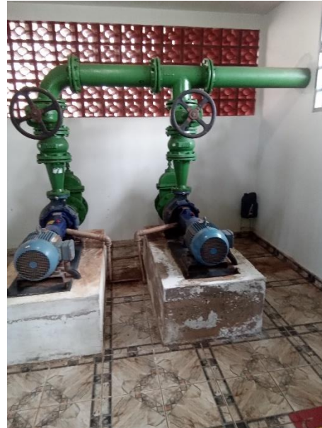
Foto 23 – Conjunto motobomba elevatória
