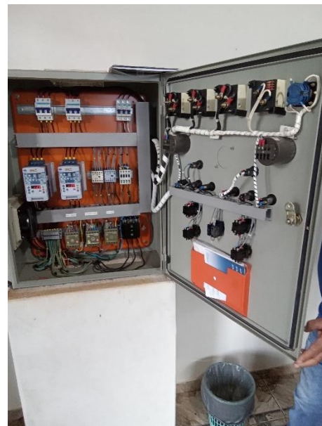
Foto 25 – Quadro de comando elevatória sede
