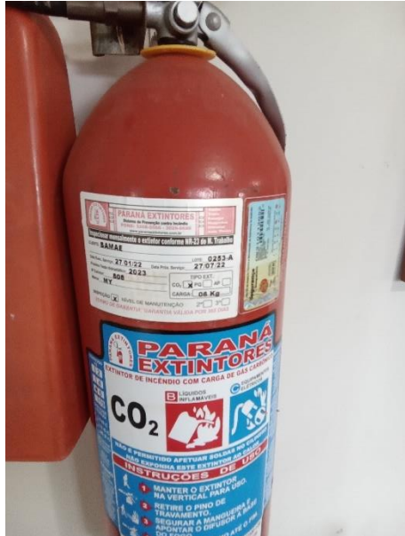
Foto 5 – Extintor vencido atendimento (27/07/2022)
