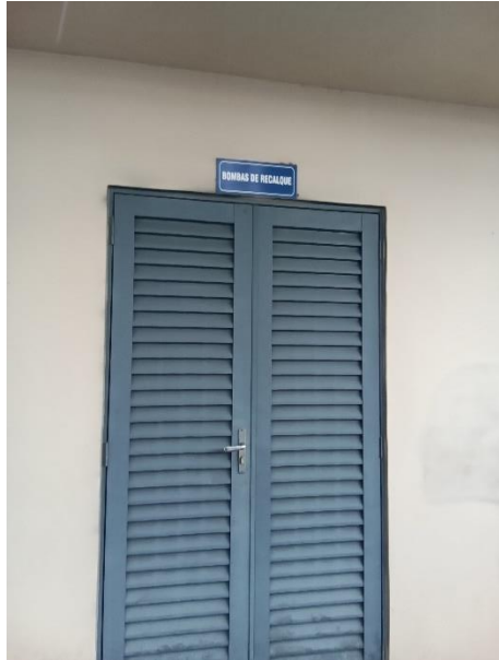
Foto 22 – identificação elevatória sede
