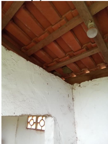
Foto 18 – Presença de marimbondos casa de comando poço 2
