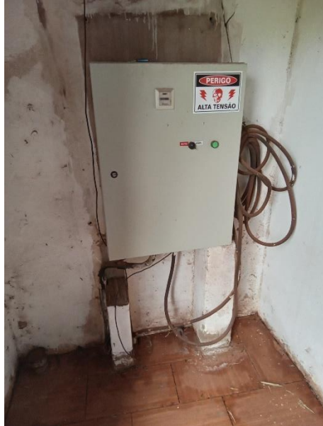
Foto 16 – Frente do quadro de comando poço 2
