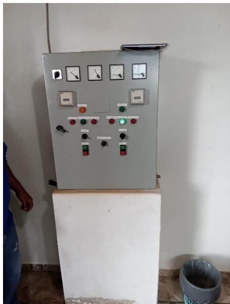
Foto 24 – Frente do quadro de comando elevatória sede
