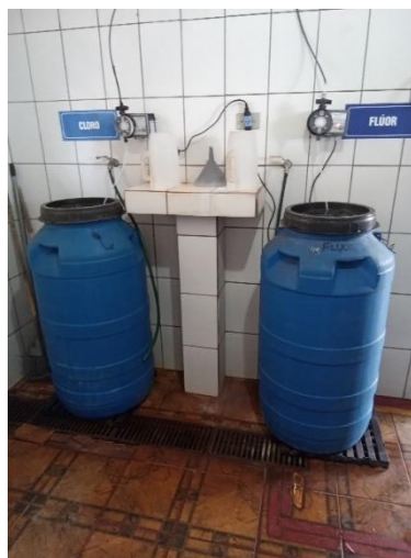
Foto 27 – Bombas dosadoras de cloro e flúor
