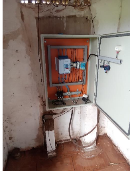
Foto 17 – Quadro de comando poço 2
