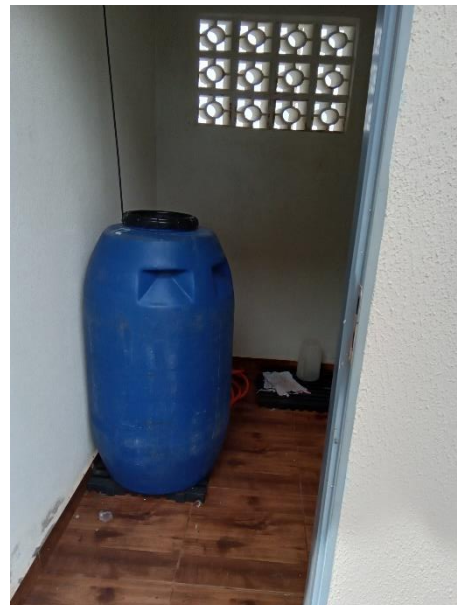
Foto 31 – Reservatório de cloro UTA distrito
