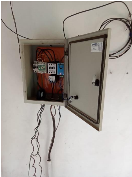
Foto 12 – Quadro de comando poço 1
