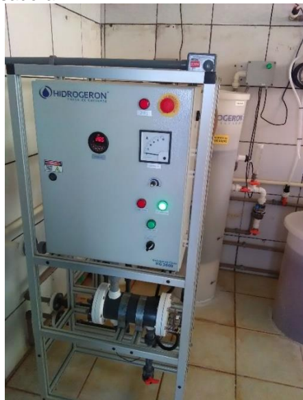
Foto 20 – Quadro de comando bomba dosadora
