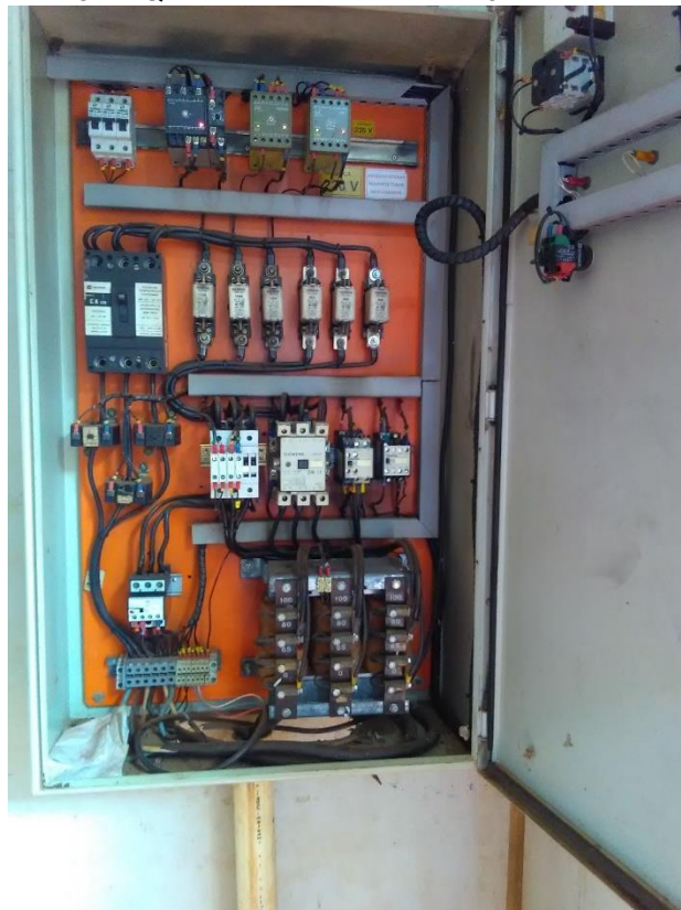
Foto 51 – Quadro de comando EAB 01
