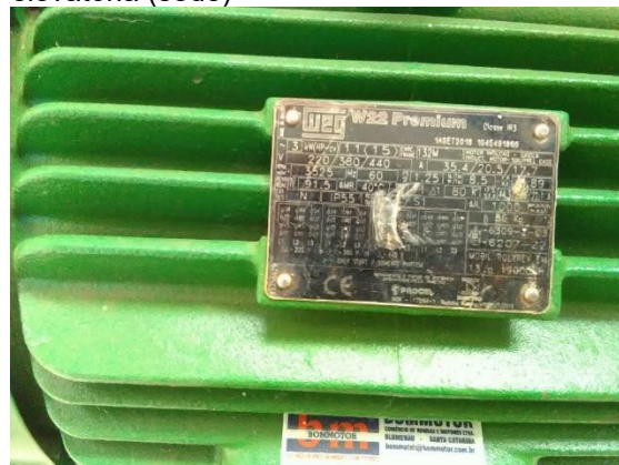
Foto 39 – Placa identificação da bomba da elevatória (sede)
