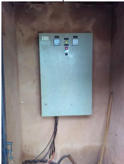
Foto 10 – Frente quadro de comando poço 02
