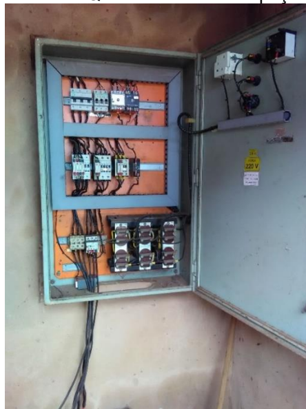
Foto 11 – Quadro de comando poço 02
