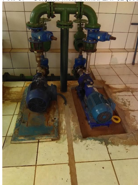
Foto 37 – Conjunto moto-bomba EAT 02 (sede)
