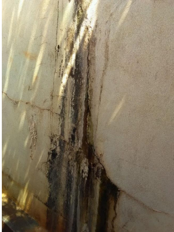
Foto 29 – Detalhe trinca no reservatório apoiado 01
