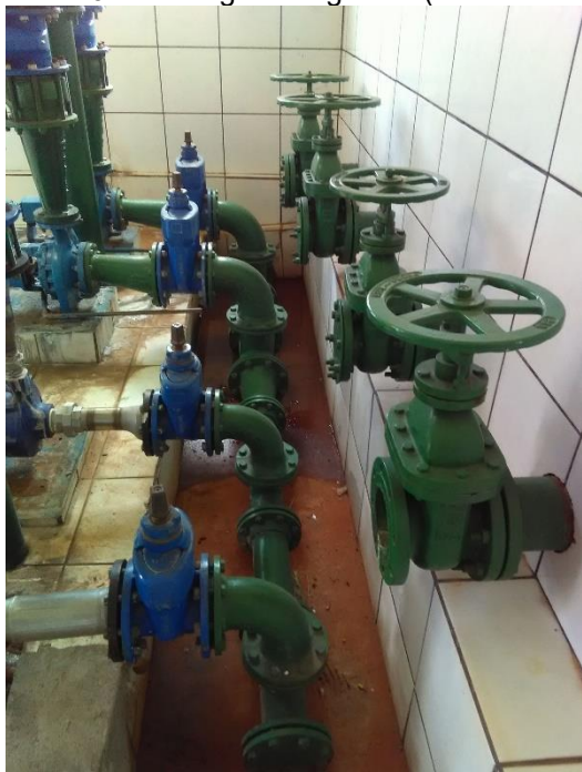
Foto 40 – Drenagem da gaxeta (sde
