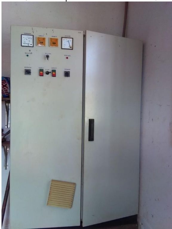
Foto 48 – Frente quadro de comando EAB 01
