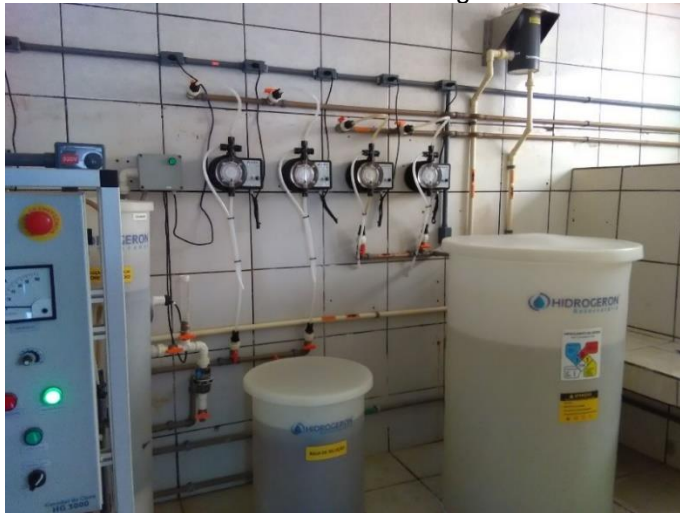
Foto 19 – Unidade de tratamento de água
