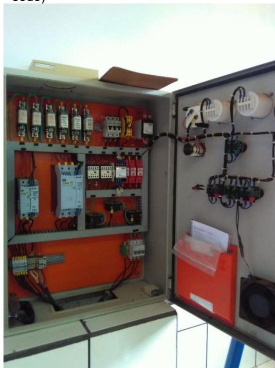
Foto 43 – Quadro de comando da elevatória (direita - sede)
