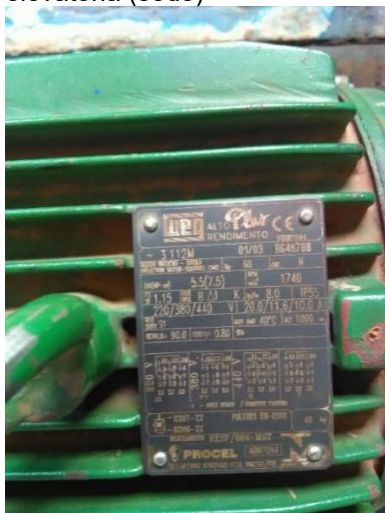
Foto 38 – Placa de identificação de bomba da elevatória (sede)
