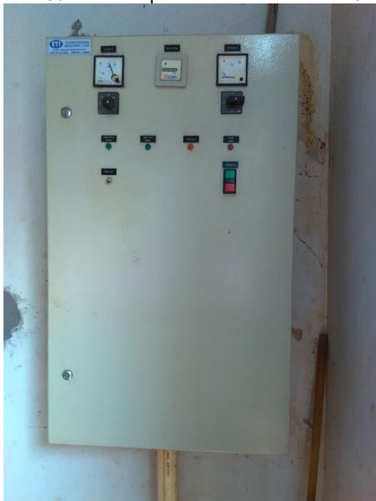
Foto 50 – Frente quadro de comando EAB 01
