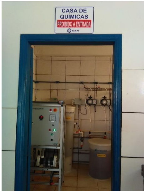
Foto 18 – Identificação da unidade de tratamento
