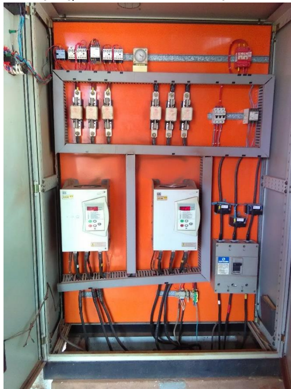
Foto 49 – Quadro de comando EAB 01
