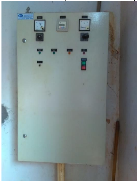
Foto 16 – Frente quadro de comando poço 07
