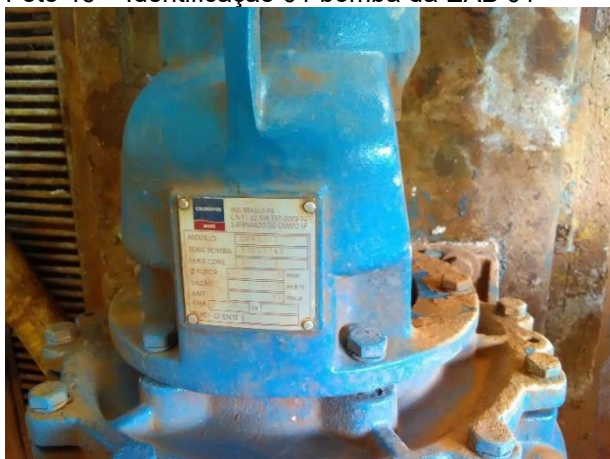
Foto 46 – Identificação 01 bomba da EAB 01
