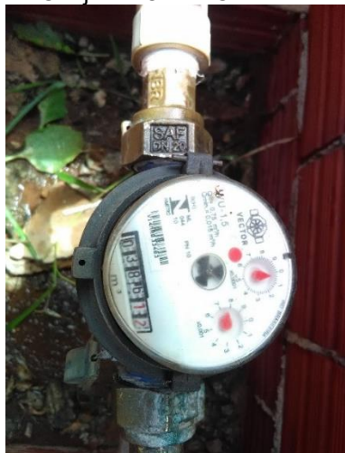
Foto 54 – Hidrômetro campo de futebol suíço no Conjunto Oscar Cotrin
