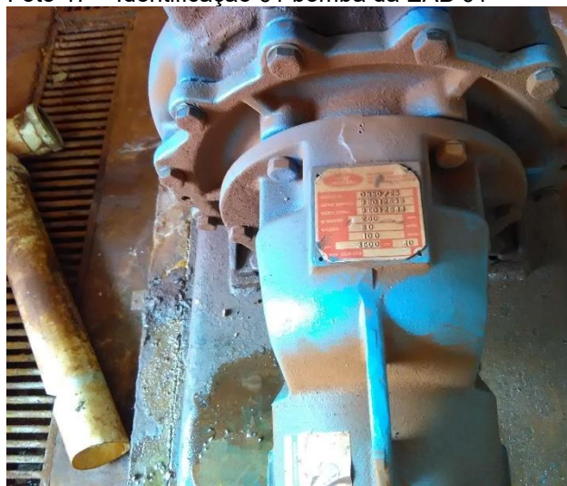
Foto 47 – Identificação 01 bomba da EAB 01
