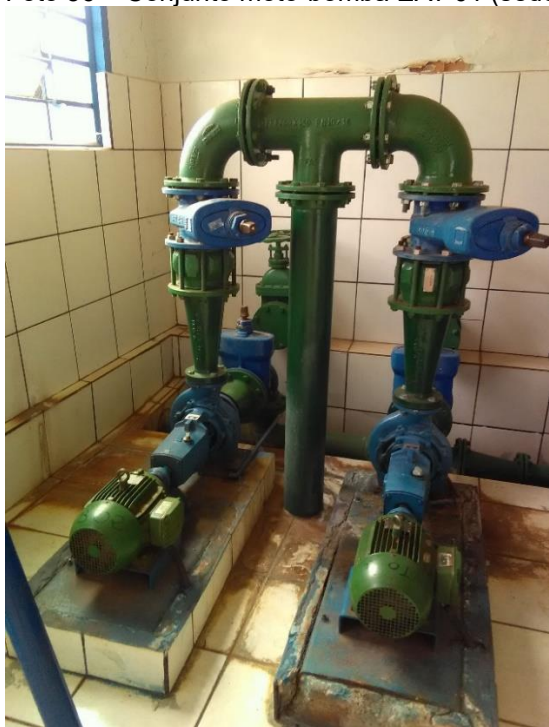
Foto 36 – Conjunto moto-bomba EAT 01 (sede)
