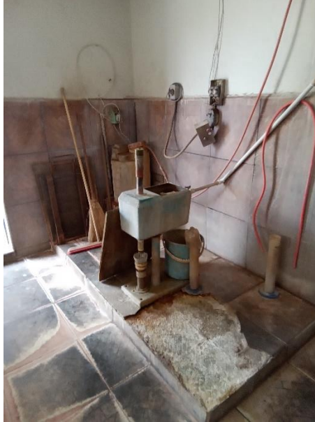
Foto 95 – Dosadora de sulfato de alumínio
