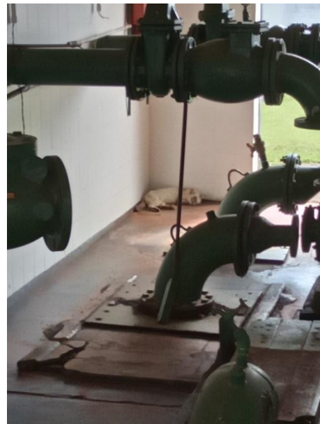
Foto 97 – Presença de animais na unidade da ETA
