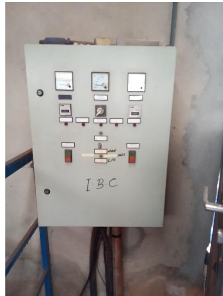
Foto 56 – Frete do quadro de comando elevatória poço 2
