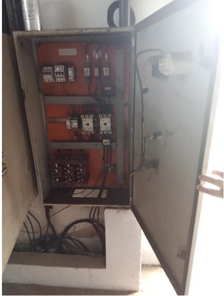
Foto 61 – Quadro de comando elevatória Bela Vista (bomba 2)
