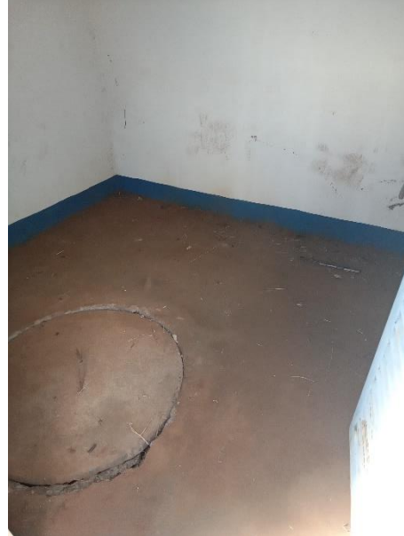
Foto 33 – Falta de limpeza casa de comando poço 3
