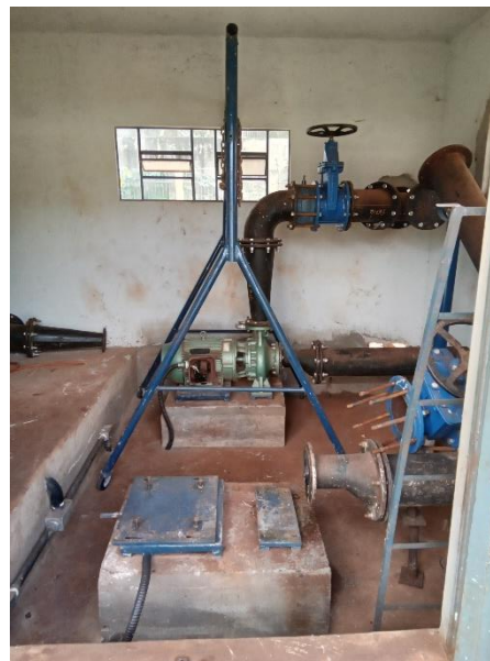
Foto 50 – Conjunto motobomba elevatória poço 4
