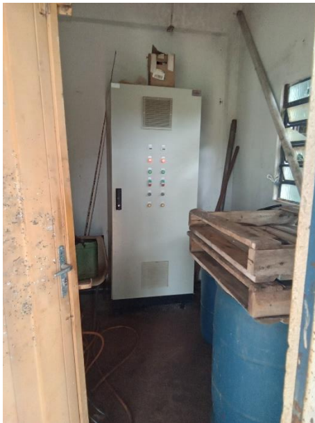
Foto 153 – Frente do quadro de comando ETE sede
