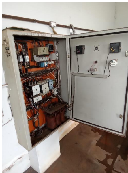
Foto 81 – Quadro de comando elevatória sede
