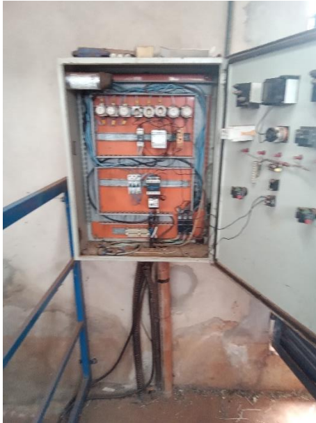
Foto 57 – Quadro de comando Elevatória poço 2
