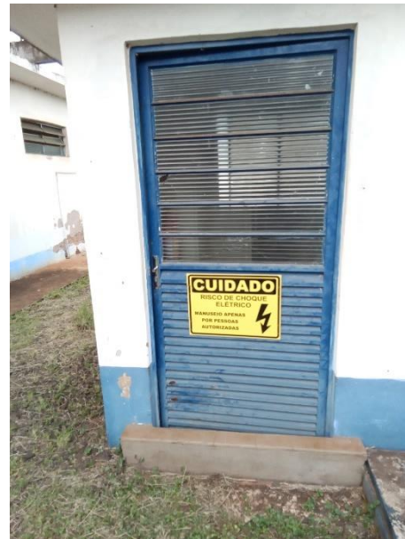
Foto 54 – Acesso elevatória poço 2
