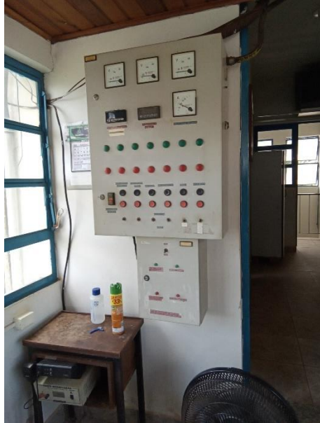
Foto 92 – Frente do quadro de comando
