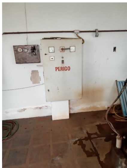
Foto 80 – Frente do quadro de comando elevatória sede
