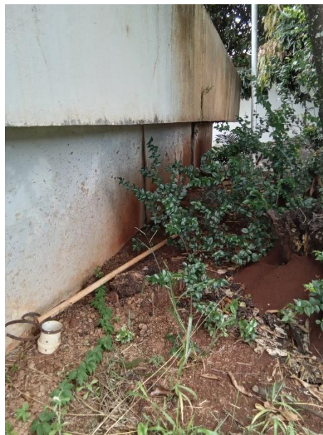
Foto 94 – Indícios de necessidade de reparos na ETA
