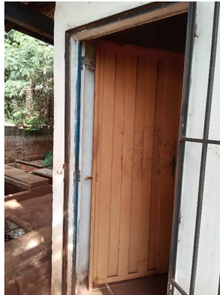
Foto 156 – Porta danificada da casa de comando ETE sede
