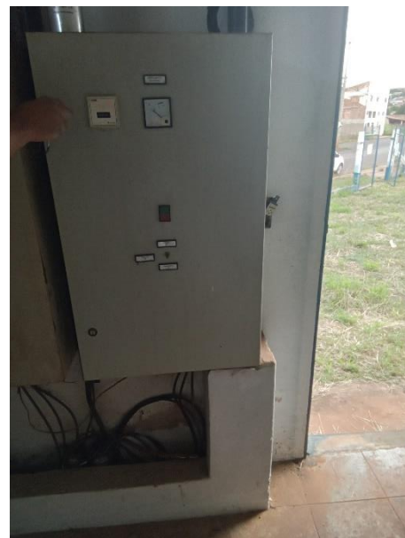
Foto 60 – Frente do quadro de comando elevatória Bela Vista
