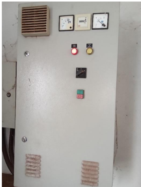
Foto 14 – Frente do quadro de comando poço 4 Foto 15 – Quadro de comando poço 4
