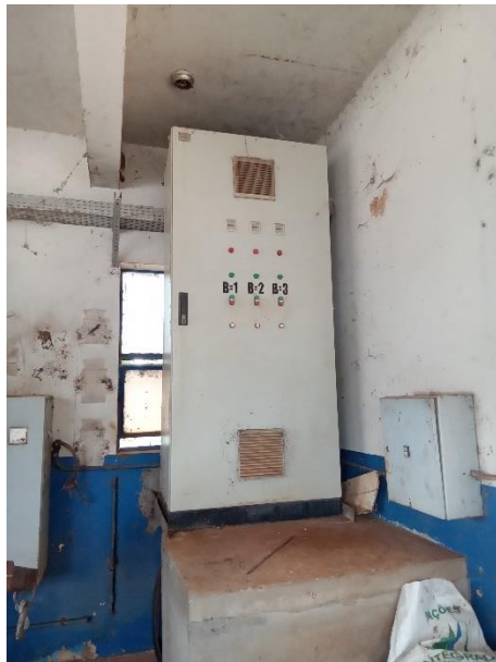
Foto 43 – Frente do quadro de comando captação superficial
