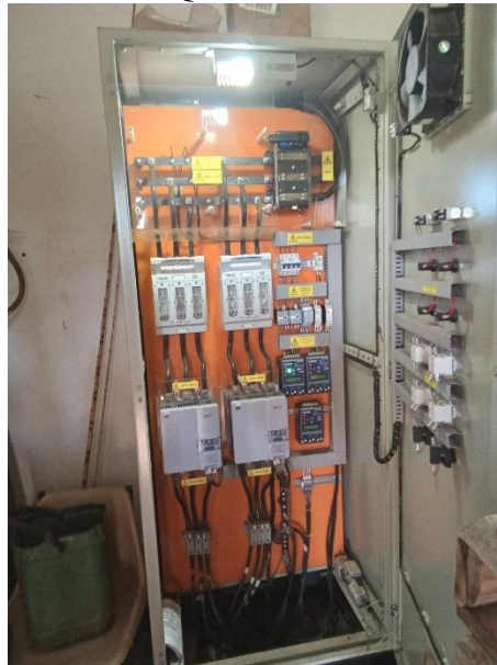
Foto 154 – Quadro de comando ETE sede
