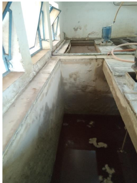
Foto 87 – Tanque de sulfato (Casa de Química)
