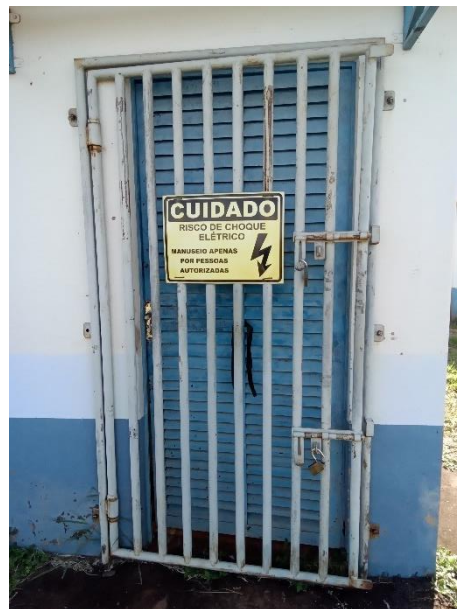
Foto 71 – Acesso elevatória Crispi
