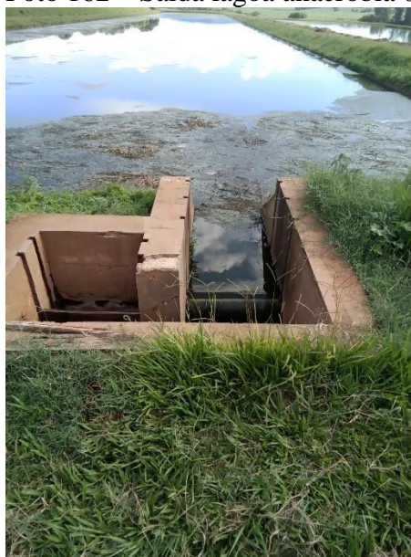
Foto 162 – Saída lagoa anaeróbia 02
