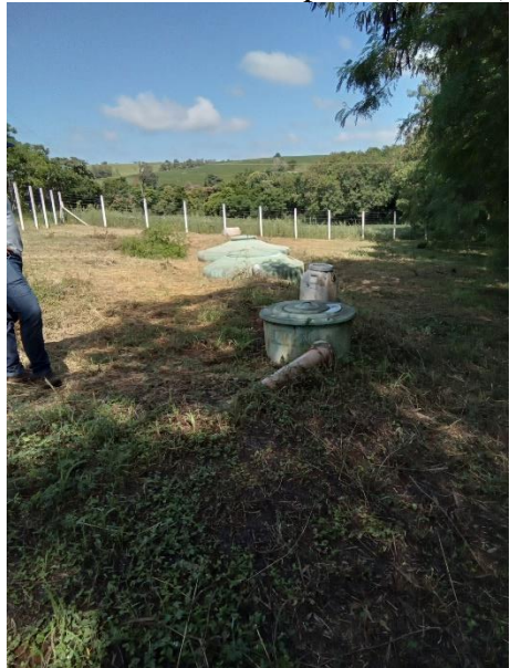
Foto 169 – ETE compacta (distrito)
