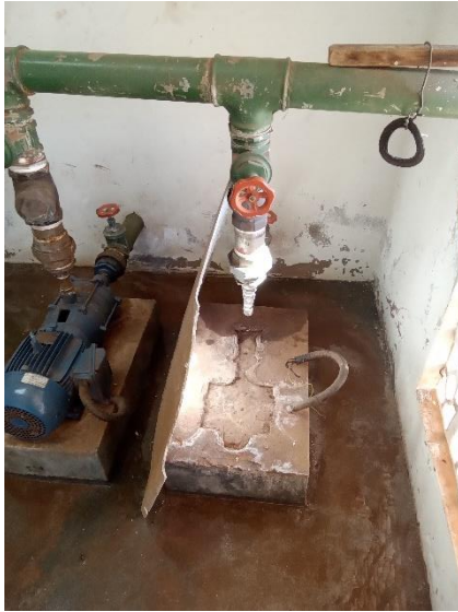
Foto 76 – Conjunto motobomba elevatória distrito
