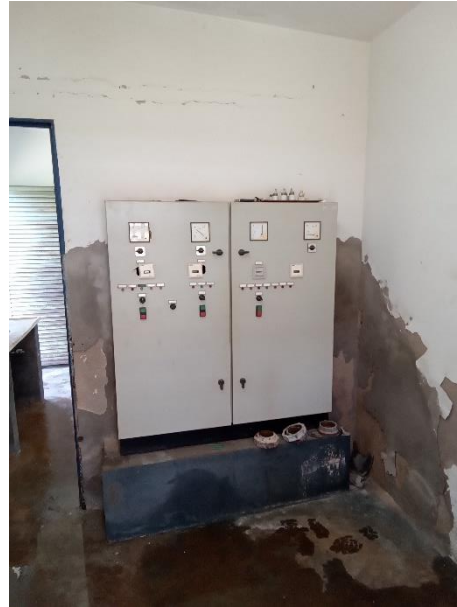
Foto 77 – Frente do quadro de comando elevatória distrito
