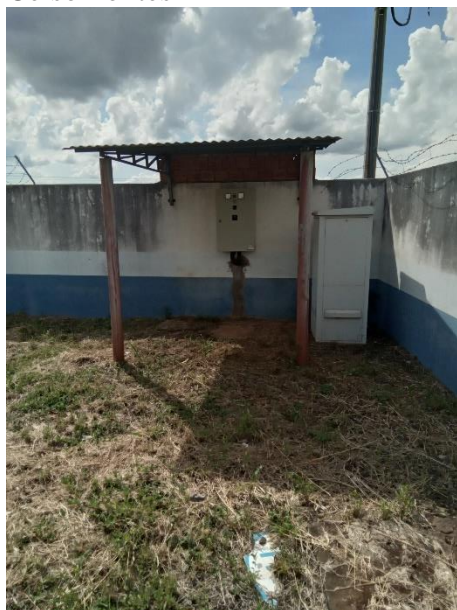
Foto 37 – Frente do quadro de comando poço Celso Fontes
