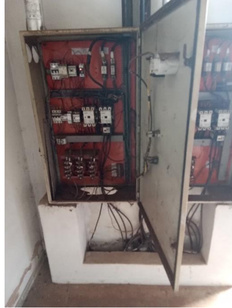
Foto 62 – Quadro de comando elevatória Bela Vista (bomba 1)
