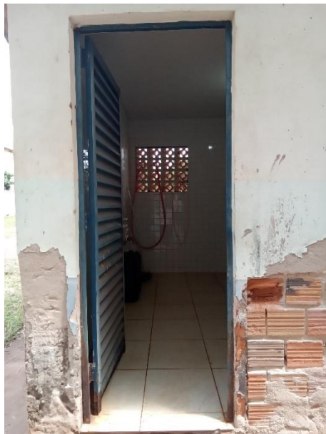
Foto 99 – Falta de identificação UTA Poço 4
