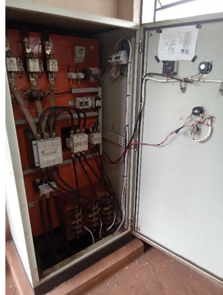
Foto 21 – Quadro de comando poço 2
