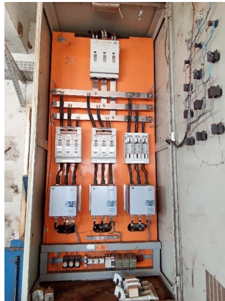
Foto 44 – Quadro de comando captação superficial
