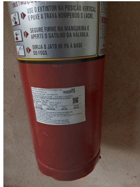
Foto 58 – Extintor vencido elevatória poço 2 (06/2022)
