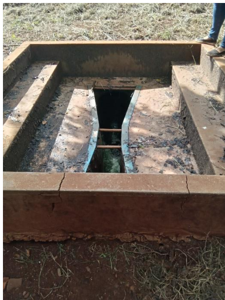
Foto 157 – Calha Parshall (entrada) ETE sede
