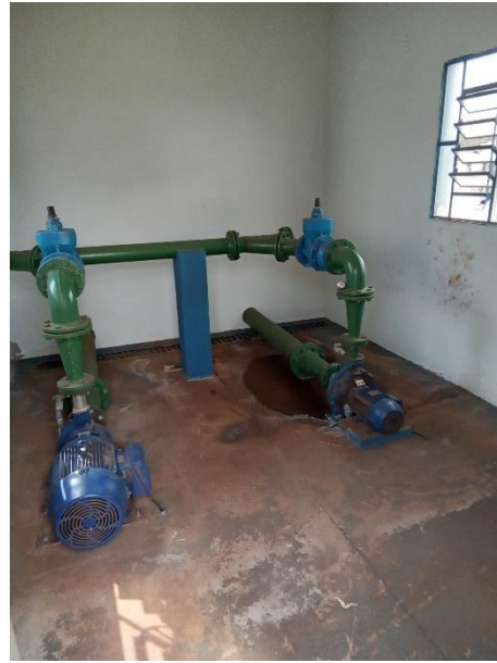
Foto 65 – Conjunto motobomba poço 3
