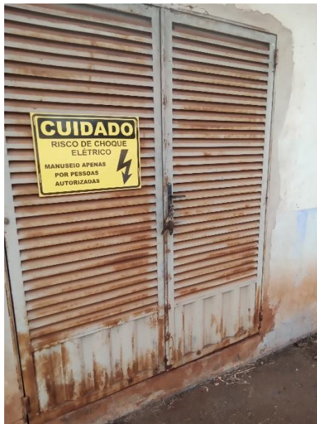
Foto 49 – Falta de elevatória captação poço 4
