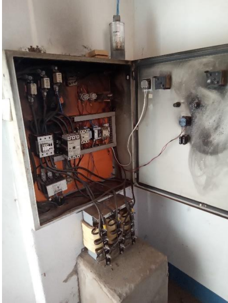
Foto 32 – Quadro de comando poço 3
