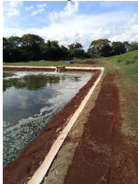
Foto 166 – Problemas de desmoronamento nos taludes da lagoa facultativa 2
