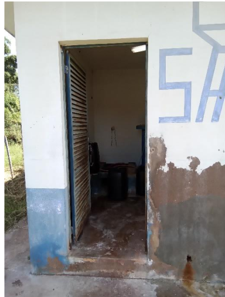
Foto 75 – Acesso elevatória distrito
