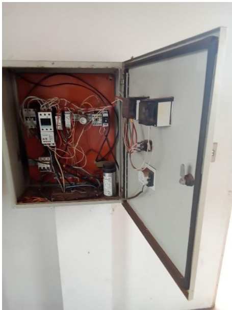
Foto 68 – Quadro de comando elevatória poço 3 (bomba 1- poço 3)
