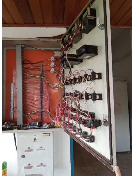
Foto 93 – Quadro de comando ETA
