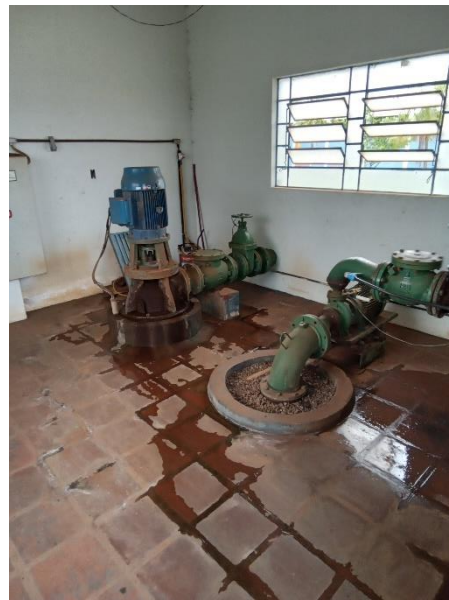
Foto 79 – Conjunto motobomba elevatória sede
