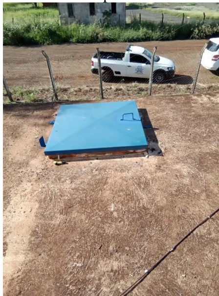
Foto 124 – Tampa sem cadeado RAP Crispi
