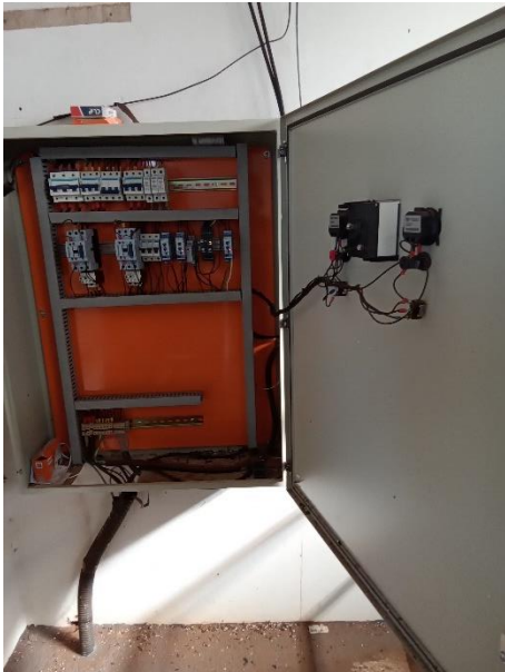
Foto 74 – Quadro de comando elevatória Crispi
