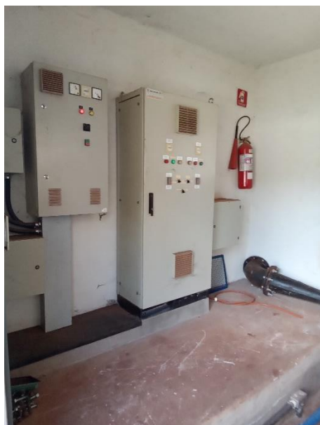
Foto 51 – Frente do quadro de comando elevatória poço 4
