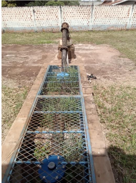
Foto 13 – Cavalete do poço 4
