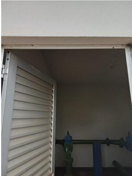
Foto 64 – Falta de identificação elevatória poço 3
