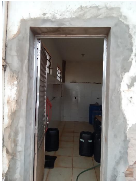
Foto 101 – Falta de identificação UTA poço 2
