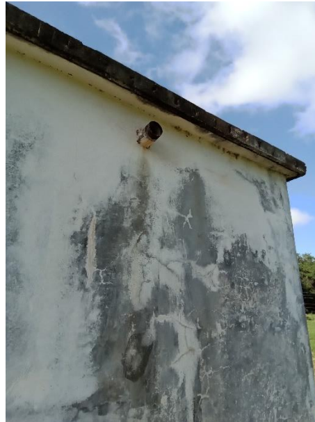
Foto 126 – Sem tela no ladrão do reservatório
