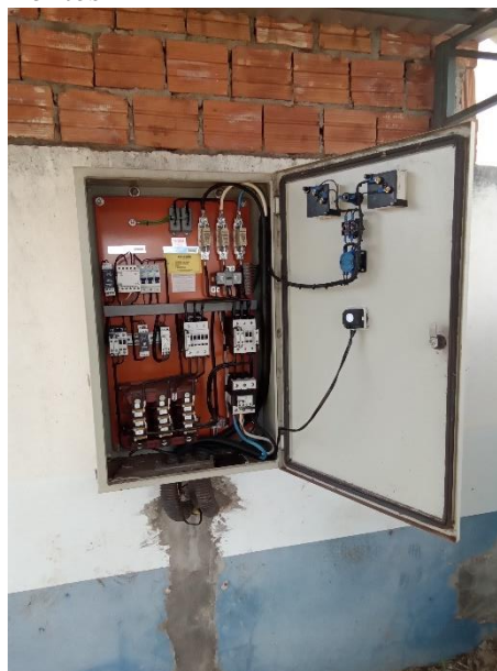
Foto 38 – Quadro de comando poço Celso Fontes
