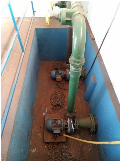
Foto 72 – Conjunto motobomba elevatória Crispi
