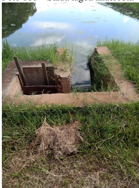
Foto 160 – Saída lagoa anaeróbia
