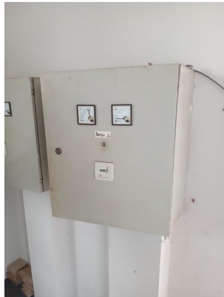
Foto 67 – Frente do quadro bomba 1 (poço 3)
