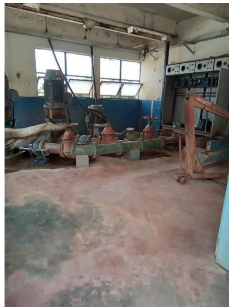
Foto 42 – Conjunto motobomba captação
