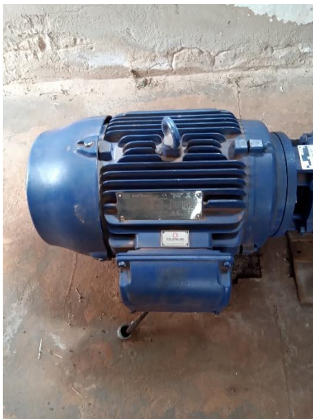
Foto 66 – Identificação bomba elevatória poço 3
