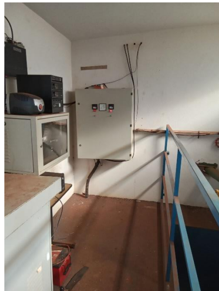
Foto 73 – Frente do quadro de comando elevatória Crispi
