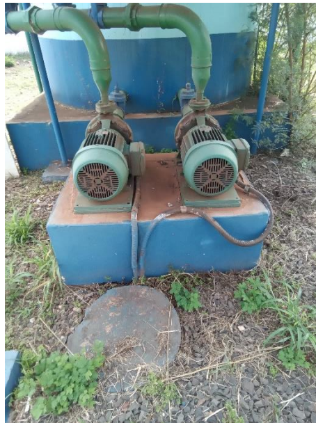
Foto 63 – Conjunto motobomba elevatória Bela Vista
