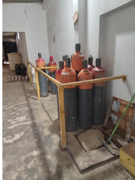
Foto 89 – Estoque de cilindros de gás cloro
