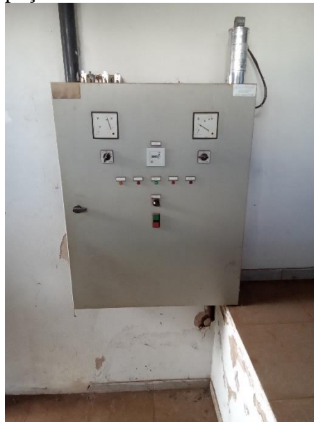
Foto 25 – Frente do quadro de comando poço Bela Vista
