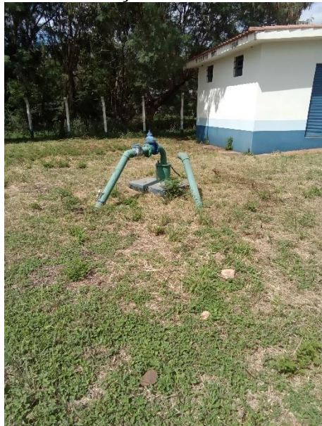
Foto 24 – Poço Bela Vista
