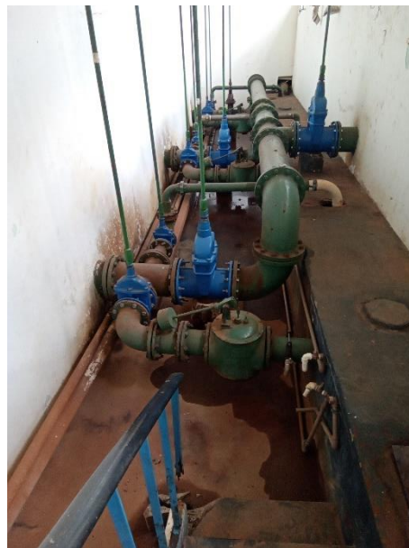
Foto 91 – Bombas da ETA
