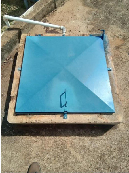
Foto 117 – Tampa de abertura para inspeção poço 3 sem cadeado
