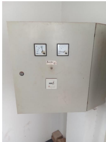
Foto 69 – Frente de comando elevatória poço 3 (bomba2)
