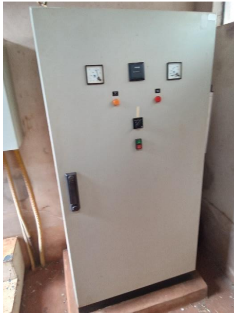
Foto 20 – Frente do quadro de comando poço 2
