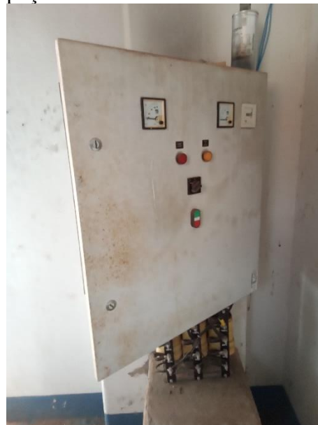
Foto 31 – Frente do quadro de comando poço 3
