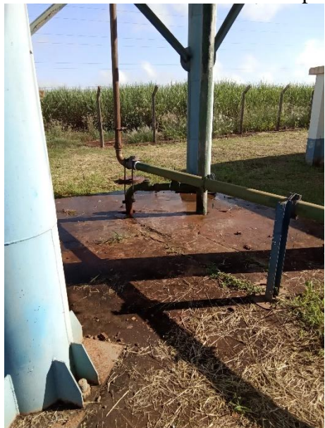
Foto 121 – Vazamento REL Crispi
