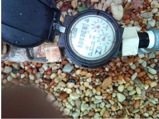
Foto 51 – Hidrômetro Rua Pernambuco, nº. 51 (Latitude: 23° 3'28.14"S e Longitude 51° 2'37.85"O, nº. 150)
