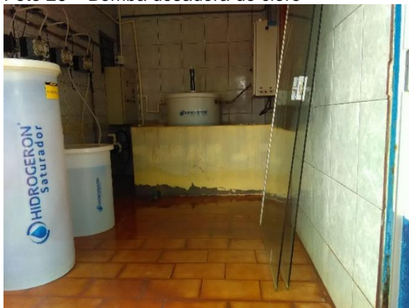
Foto 26 – Bomba dosadora de cloro
