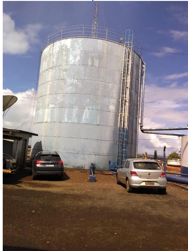
Foto 32 – Reservatório apoiado 1200 m 3
