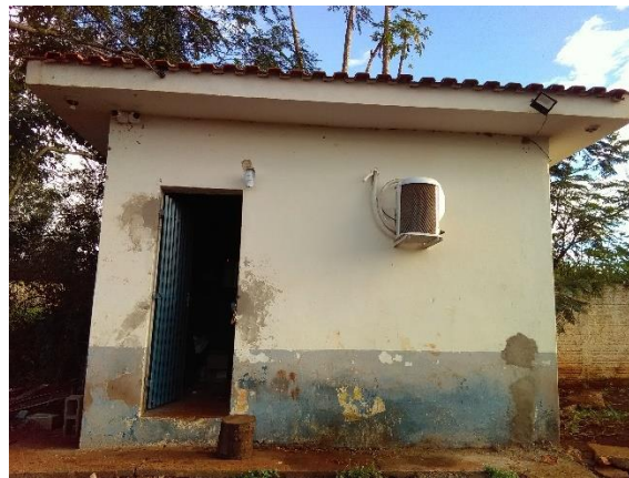
Foto 46 – Abrigo quadro de comando elevatória zona norte
