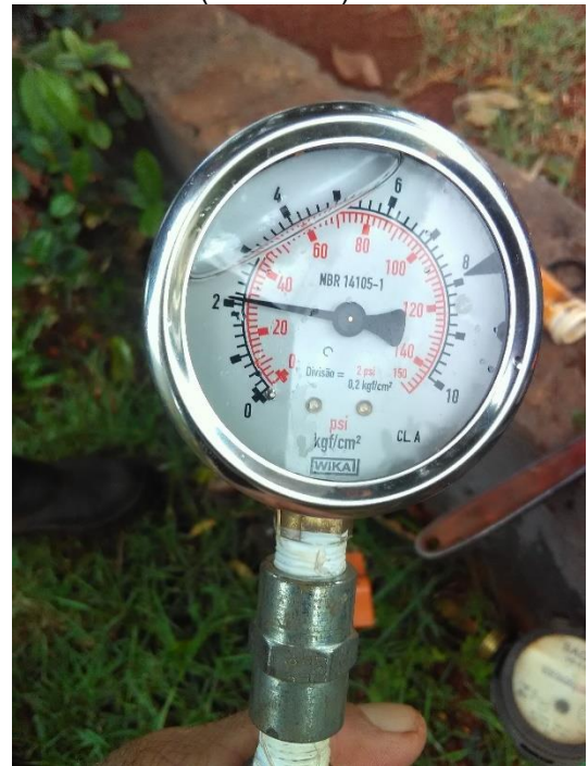
Foto 54 – Medição de pressão na rede: Hidrômetro Posto de Saúde Roberto Martins (Latitude: 23° 3'29.92"S e Longitude 51° 2'13.52"O (P=30 mca)
