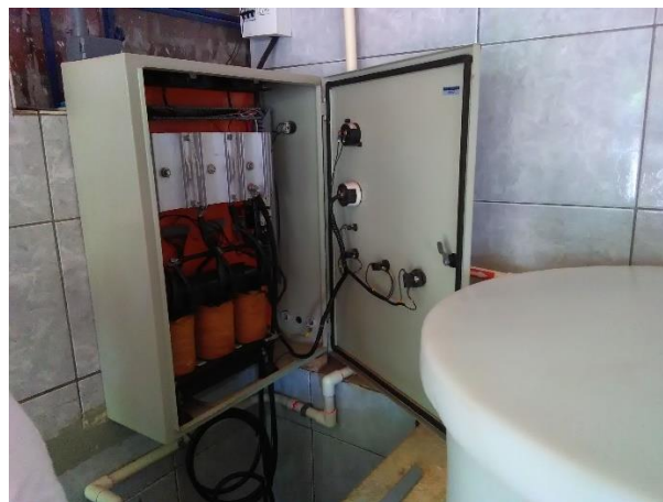
Foto 29 – Quadro de comando da dosadora
