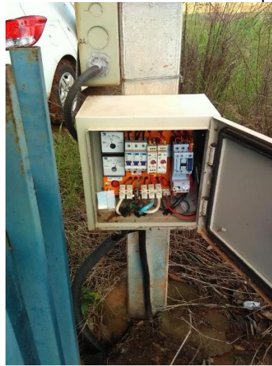
Foto 22 – Quadro de comando poço Cabreira
