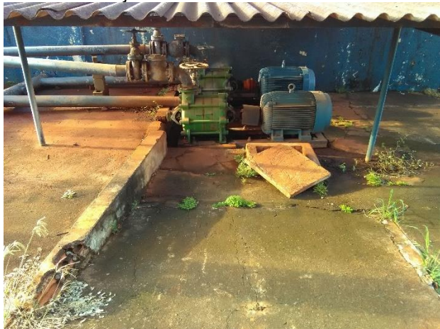
Foto 45 – Conjunto moto bomba elevatória norte
