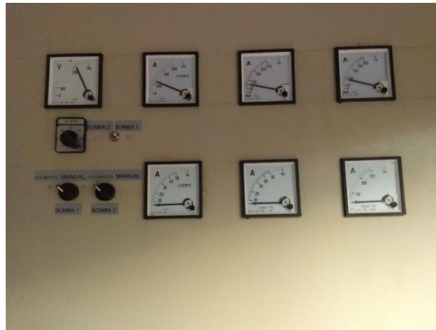
Foto 48 – Frente Quadro de comando elevatória zona leste
