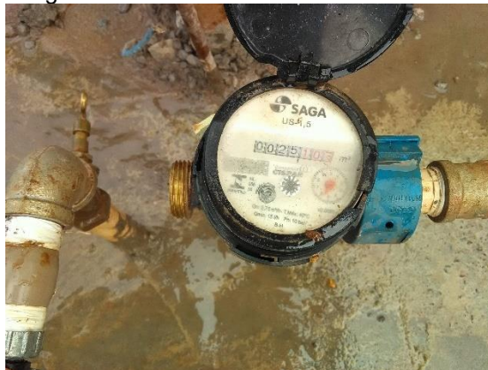
Foto 57 – Hidrômetro Rua Distrito Federal x Av. Natal Bersanete (Latitude: 23° 3'17.64"S Longitude 51° 1'35.94"O
