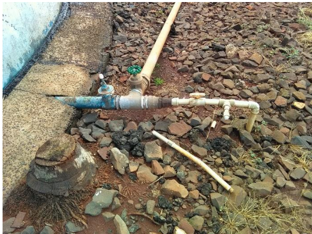
Foto 33 – Tomada de água Reservatório sede 1200 m 3
