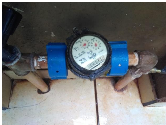
Foto 55 – Hidrômetro Rua Dr. Gervázio, nº. 860 (Latitude: 23° 3'29.88"Se Longitude 51° 1'59.50"O
