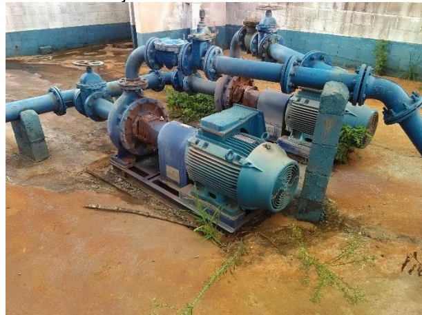
Foto 50 – Conjunto moto bomba elevatória leste
