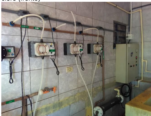
Foto 28 – Quadro de comando da dosadora de cloro (frente)
