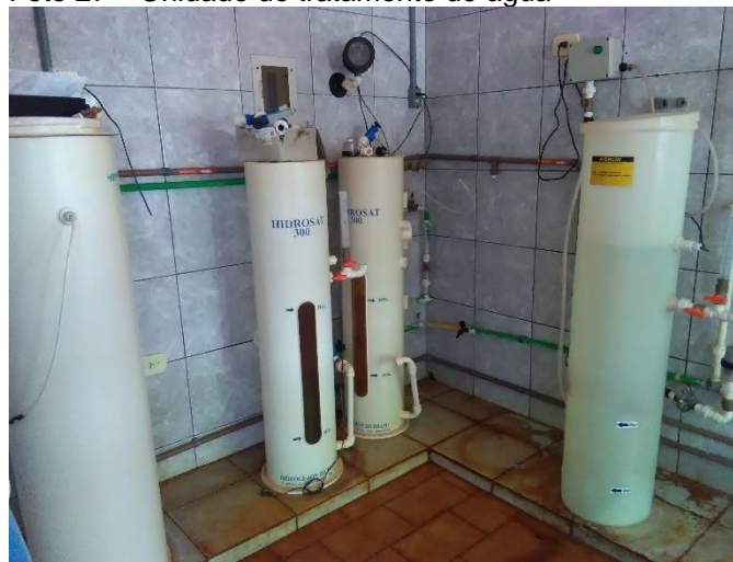
Foto 27 – Unidade de tratamento de água
