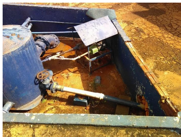
Foto 34 – Bomba reservatório apoiado sede 600 m 3
