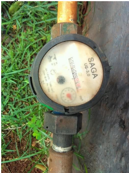
Foto 53 – Hidrômetro Posto de Saúde Roberto Martins (Latitude: 23° 3'29.92"S e Longitude 51° 2'13.52"O)
