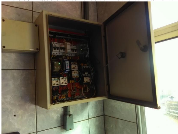
Foto 30 – Quadro de comando da unidade de tratamento
