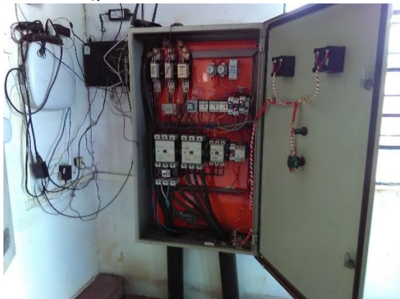
Foto 41 – Quadro de comando elevatória zona sul
