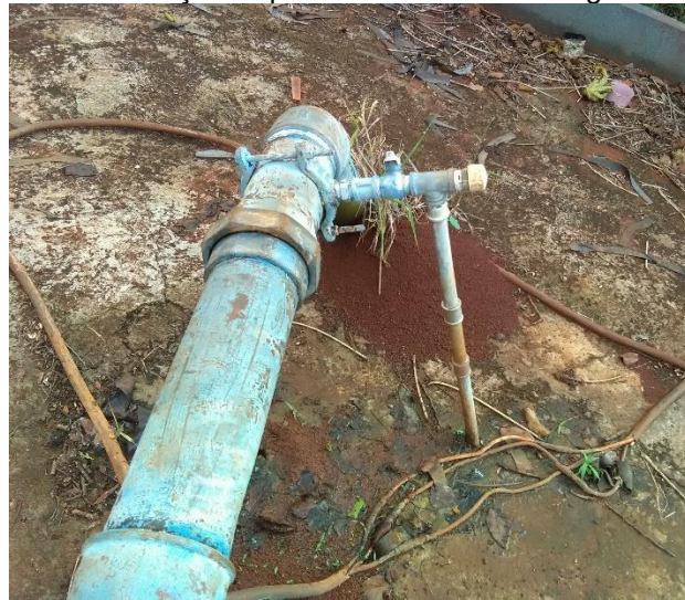
Foto 18 – Poço Turquinho 01 – tomada de água
