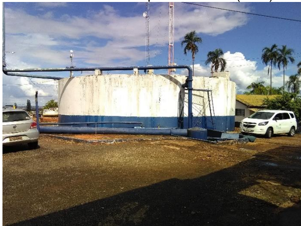
Foto 31 – Reservatório apoiado 600 m 3 (sede)
