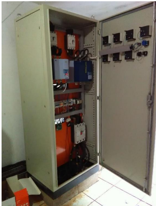
Foto 49 – Quadro de comando elevatória zona leste
