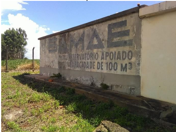
Foto 27 – Reservatório apoiado 100 m 3
