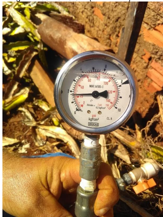
Foto 37 – Medição pressão na rede: Rua Zacarias (Latitude: 23°18'23.25"S e Longitude 50°18'49.3W (P=24 mca)
