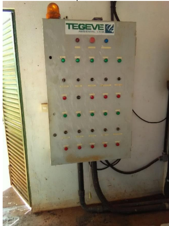
Foto 53 – Frente do quadro de comando da ETE
