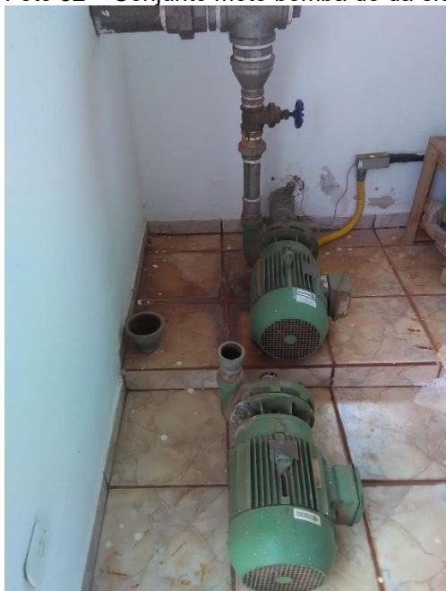
Foto 32 – Conjunto moto bomba do da elevatória
