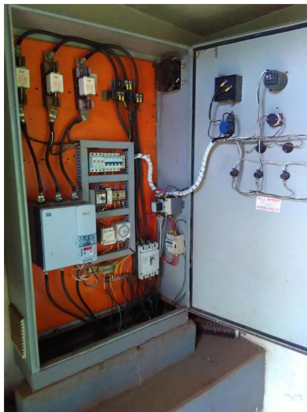
Foto 13 – Quadro de comando poços da Matilda
