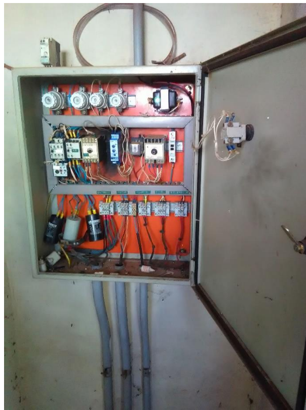
Foto 17 – Quadro de comando do poço da Vila Rural
