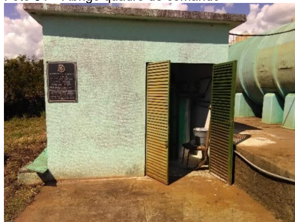
Foto 51 – Abrigo quadro de comando
