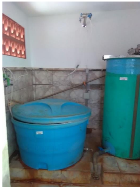
Foto 19 – Unidade de tratamento de água
