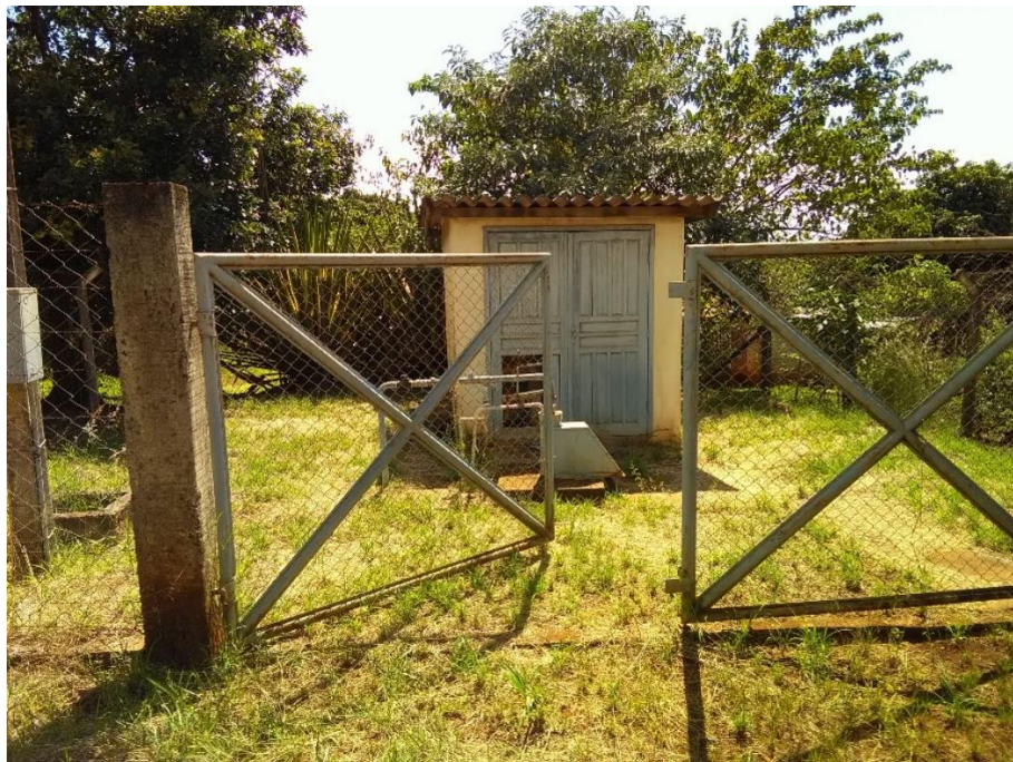
Foto 14 – Abrigo quadro de comando poço da Vila Rural
