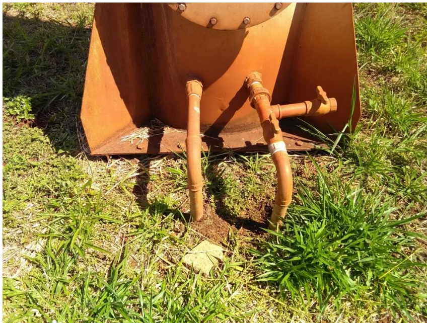
Foto 31 – Tomada de água poço Vila Rural
