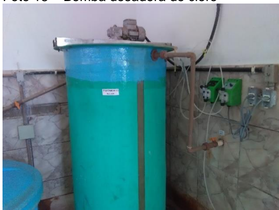
Foto 18 – Bomba dosadora de cloro
