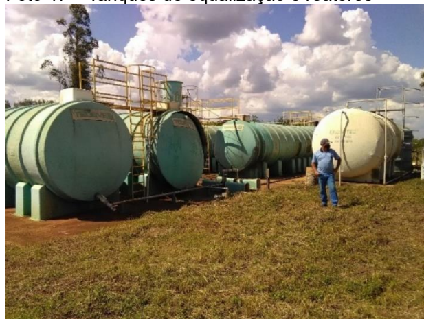
Foto 47 – Tanques de equalização e reatores
