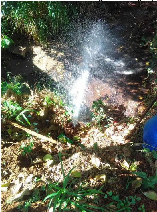
Foto 38 – Válvula de descarga na Rua Iguazu
