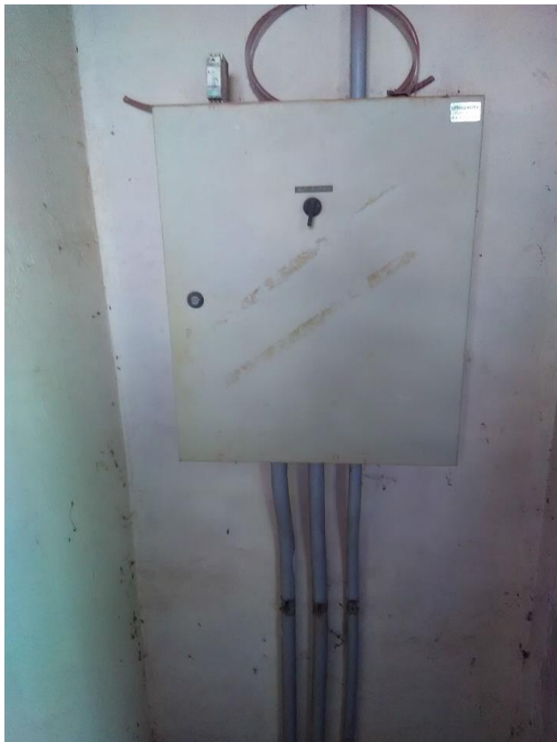
Foto 16 – Frente do quadro do poço da Vila Rural
