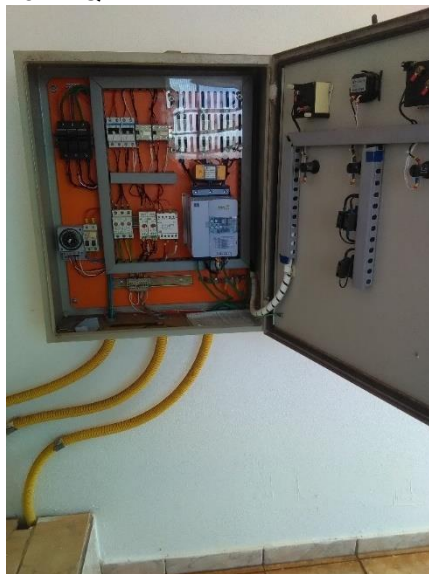
Foto 34 – Quadro de comando da elevatória
