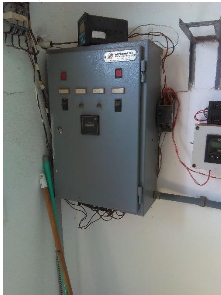
Foto 22 – Quadro de comando bomba dosadora
