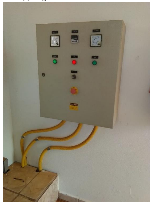
Foto 33 – Quadro de comando da elevatória
