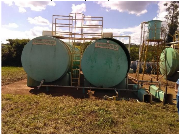
Foto 48 – Tanques de equalização
