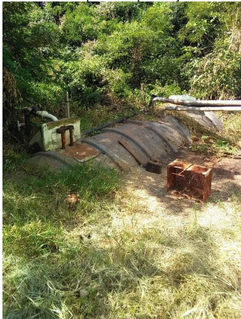
Foto 56 – Tanque de equalização e elevatória
