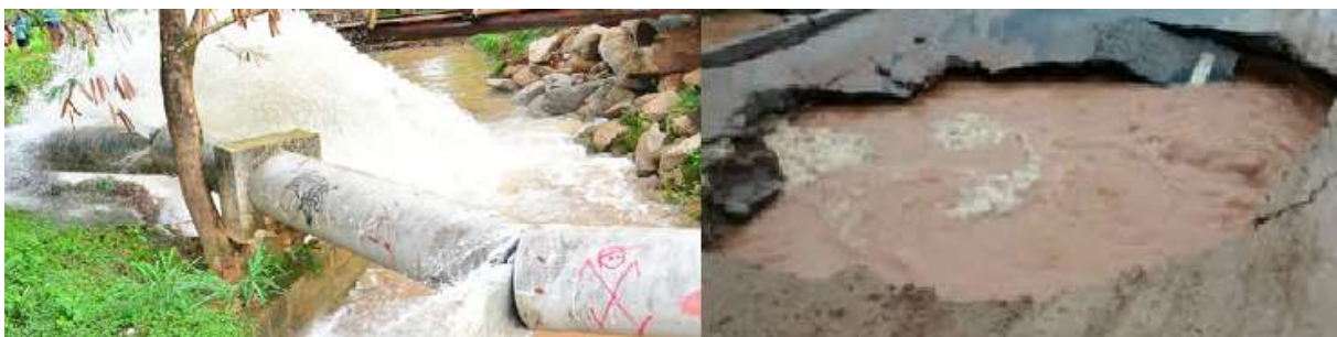
Figura 12 – Trecho de adutora rompida em travessia suspensa sobre curso d'água à esquerda e pavimento cedido após rompimento de adutora à direita.
