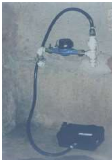
Figura 13 – Conjunto de medição contínua formado por manômetro digital e data logger.
