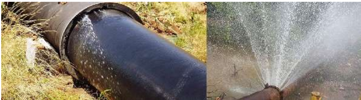
Figura 11 – Adutoras de água com vazamento
