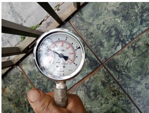
Foto 55 – Hidrômetro P02 – P = 40.00 mca
