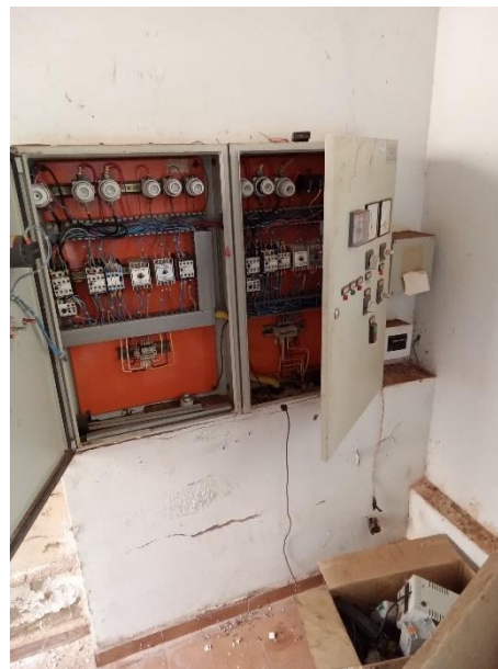
Foto 27 – Quadro de comando EEAB02
