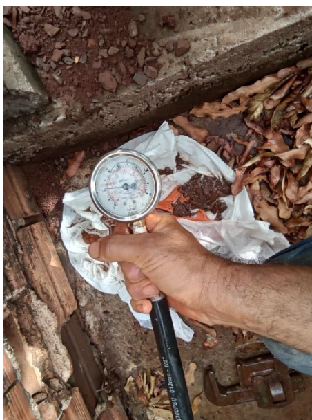
Foto 58 – Hidrômetro P03 – P = 31.00 mca
