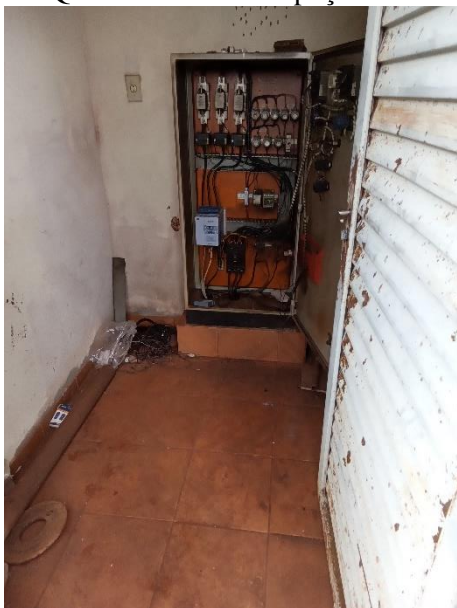
Foto 20 – Quadro de comando poço Tarumã
