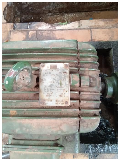
Foto 25 – Identificação bomba EEAB02
