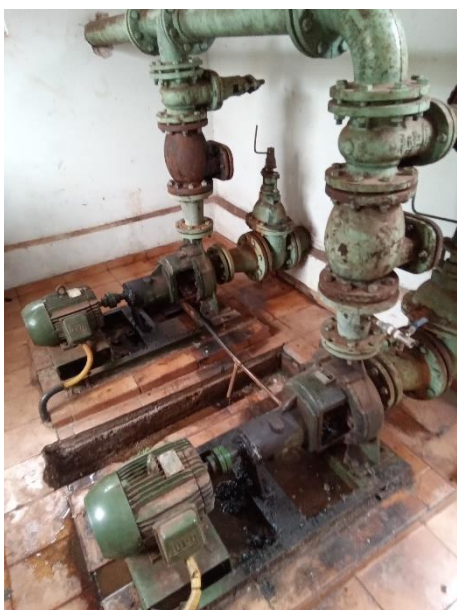
Foto 24 – Conjunto moto bomba EEAB02
