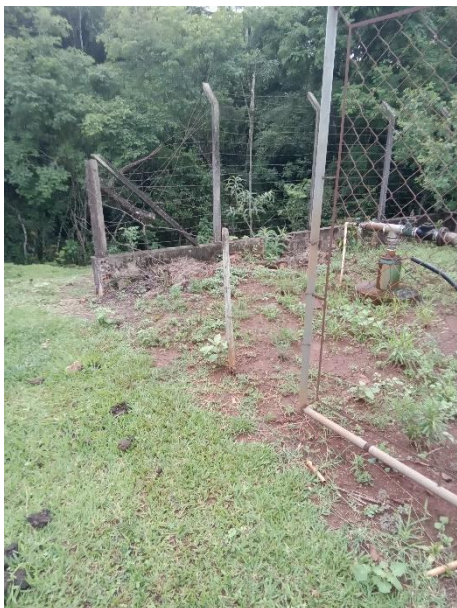
Foto 16 – Isolamento danificado captação Sítio Tarumã Foto 17 – Poço Tarumã
