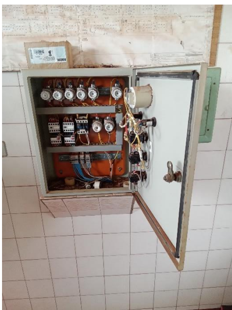
Foto 37 – Quadro de comando bombas dosadoras
