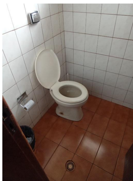
Foto 8 – BWC sem acessibilidade
