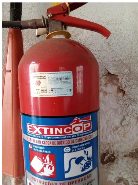
Foto 28 – Extintor vencido fev/2020
