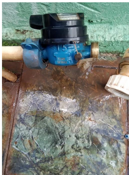
Foto 54 - Identificação hidrômetro P02
