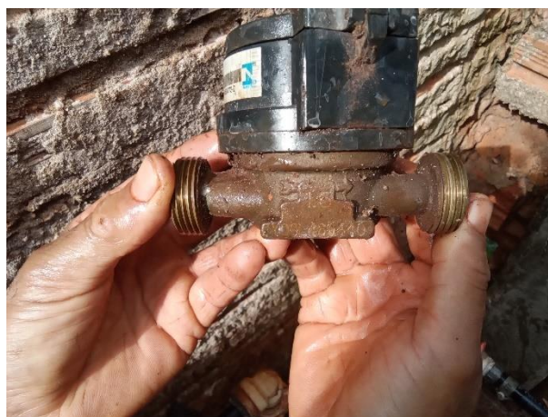
Foto 57 - Identificação hidrômetro P03
