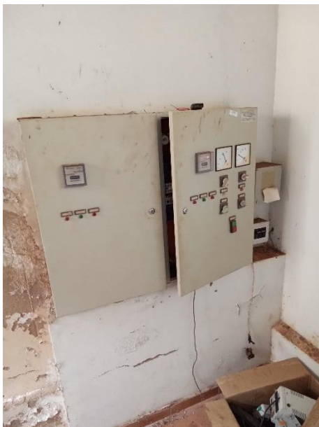
Foto 26 – Frente do quadro EEAB02
