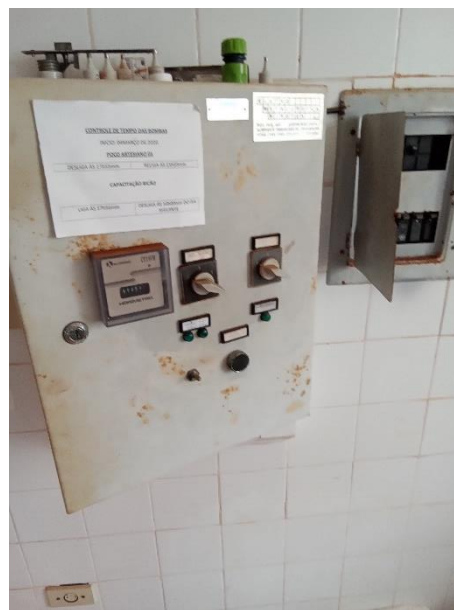
Foto 30 – Frente quadro de comando UTA sede
