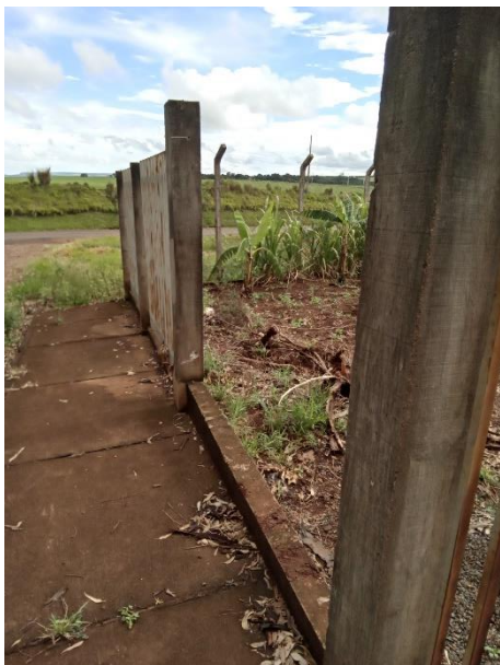
Foto 48 – Isolamento danificado RAP 02
