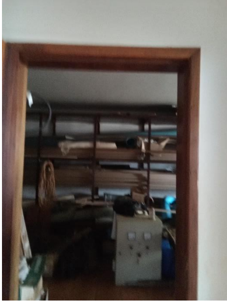
Foto 12 – Falta de identificação nas unidades
