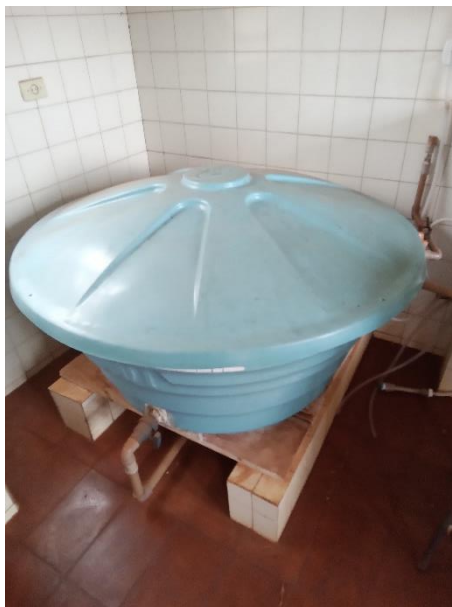
Foto 39 – Tanque de cloro
