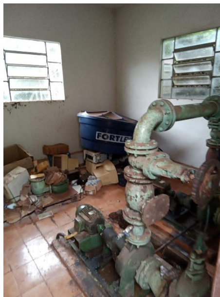
Foto 23 – Casa de máquinas AAB02
