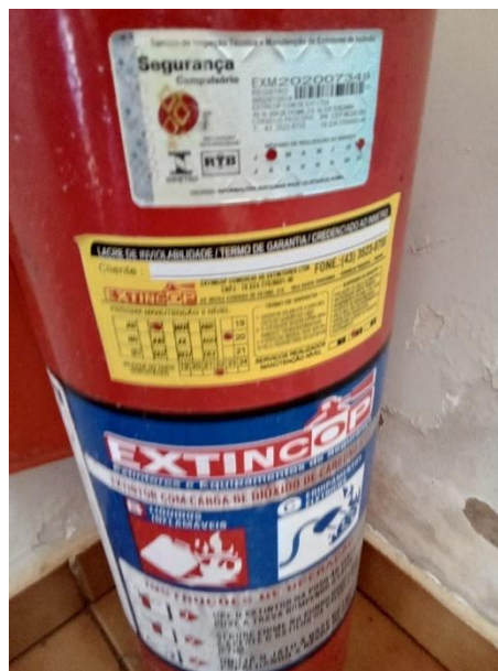
Foto 6 – Extintor vencido agosto/2022
