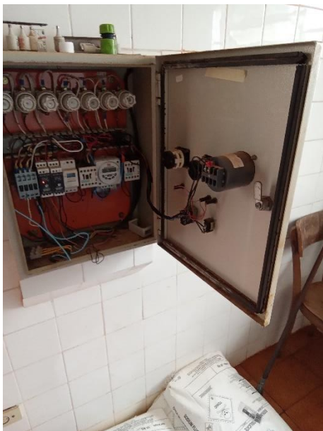
Foto 31 – Quadro de comando UTA sede
