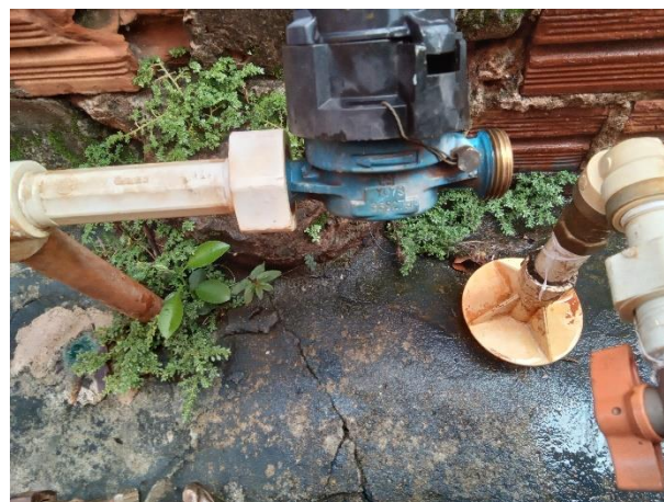
Foto 51 - Identificação hidrômetro P01
