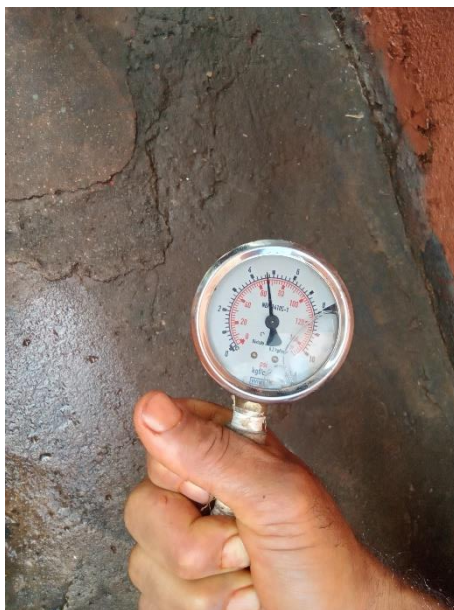
Foto 52 – P02 - Medição pressão na rede P01 = 67.00 mca
