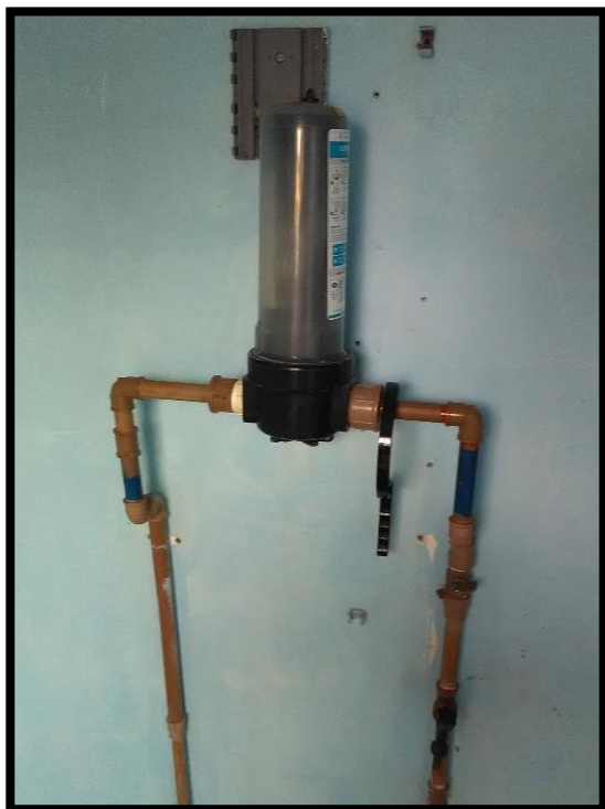
Imagem 17: Unidade de tratamento do poço 5
