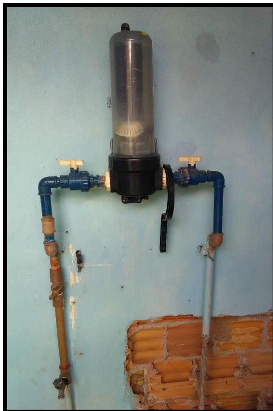
Imagem 16: Unidade de tratamento do poço 4
