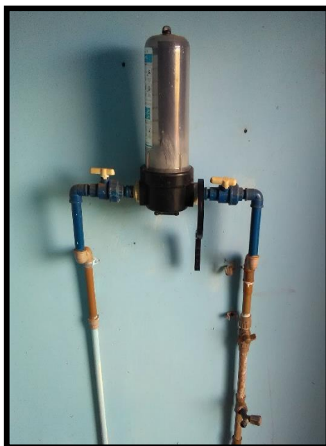
Imagem 19: Unidade de tratamento do poço 7
