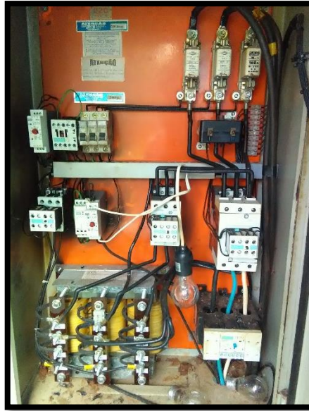
Imagem 02: Quadro de comando do poço 1
