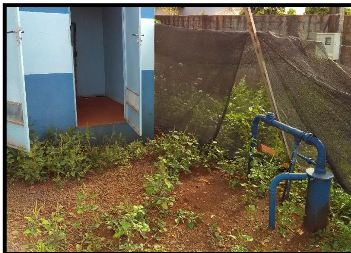
Imagem 09: Barrilete do poço 5
