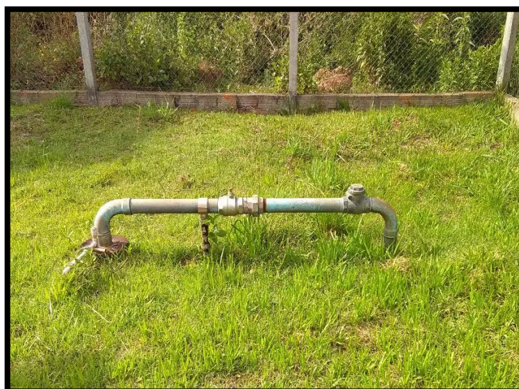
Imagem 07: Barrilete do poço 4
