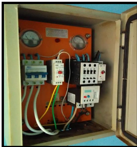
Imagem 14: Quadro de comando do poço 7
