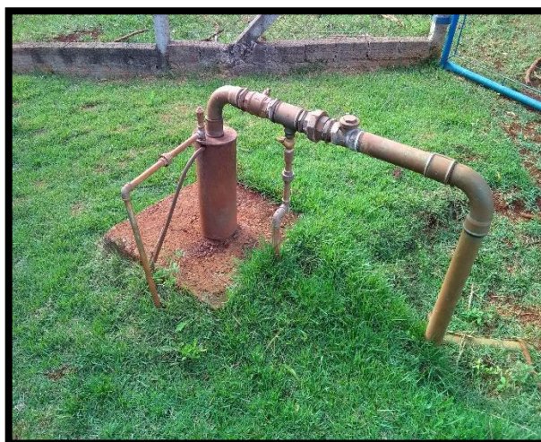
Imagem 13: Barrilete do poço 7
