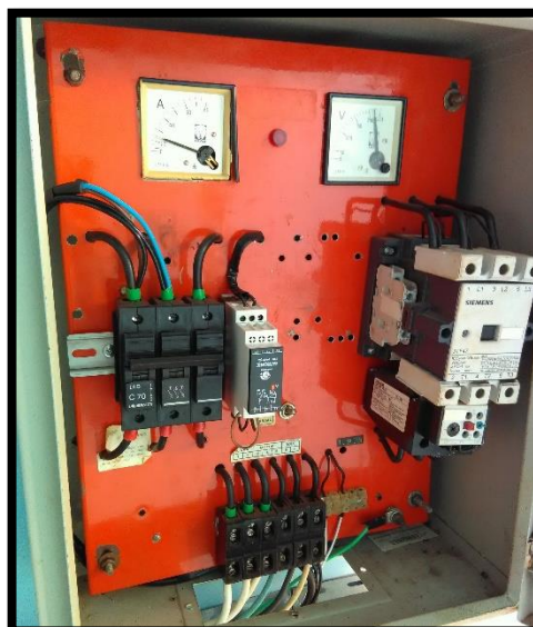
Imagem 06: Quadro de comando do poço 3
