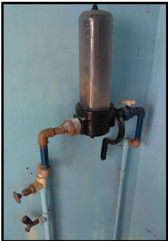
Imagem 15: Unidade de tratamento do poço 3
