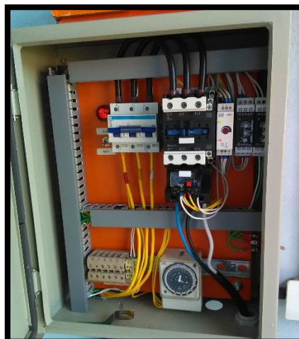
Imagem 04: Quadro de comando do poço 2
