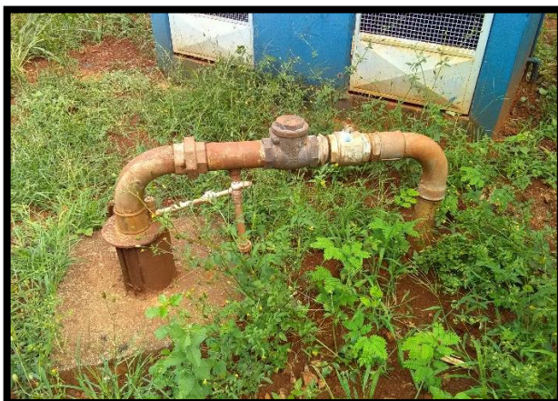
Imagem 01: Barrilete do poço 1
