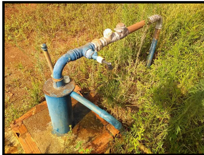
Imagem 03: Barrilete do poço 2
