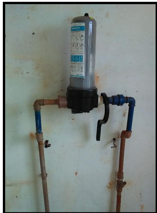
Imagem 18: Unidade de tratamento do poço 6
