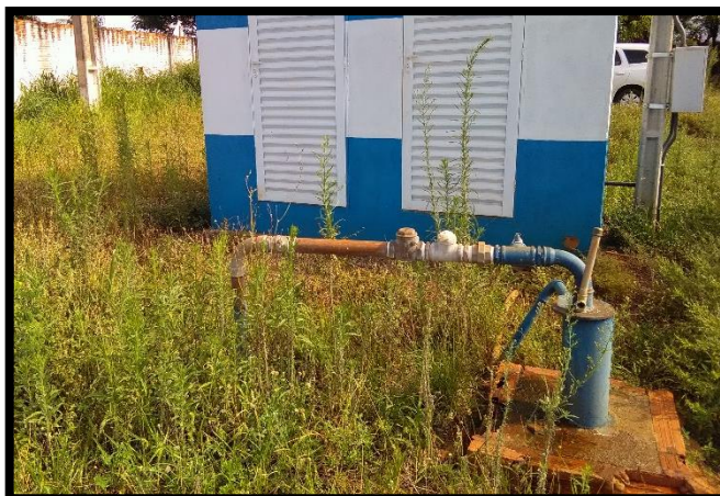
Imagem 05: Barrilete do poço 3
