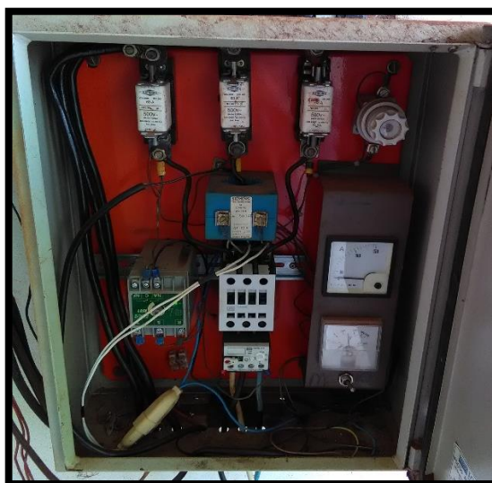
Imagem 12: Quadro de comando do poço 6
