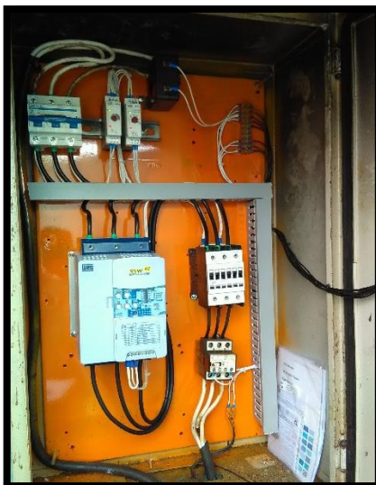
Imagem 08: Quadro de comando do poço 4
