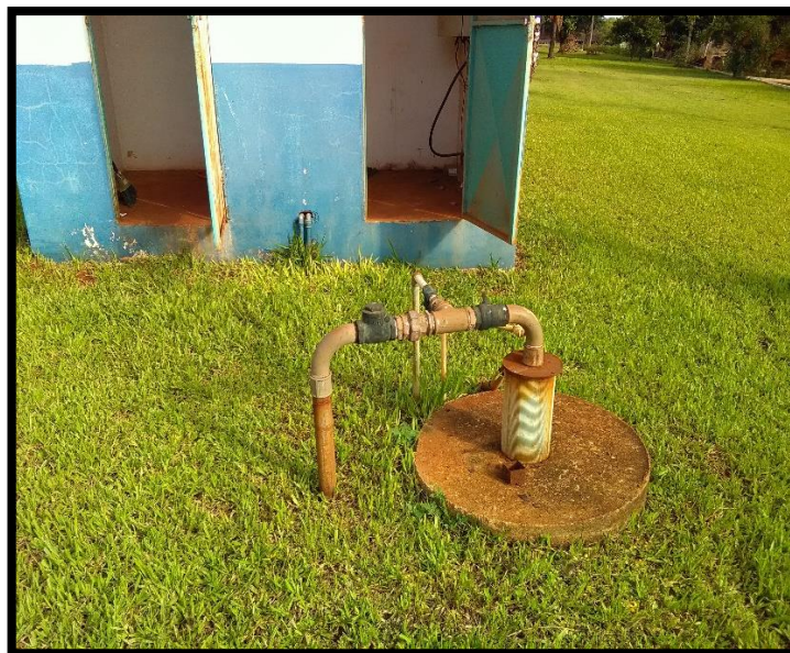
Imagem 11: Barrilete do poço 6
