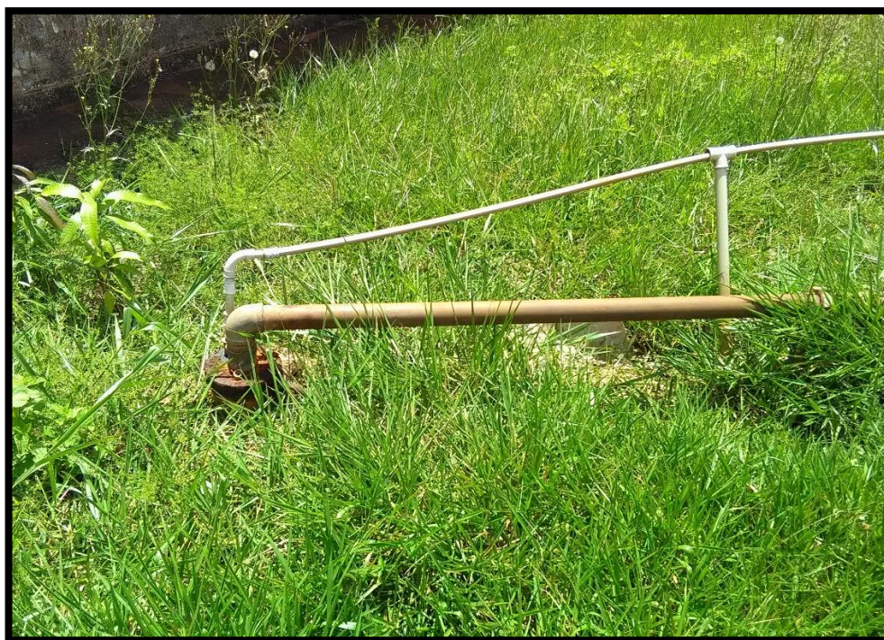
Imagem 01: Barrilete do poço 1
