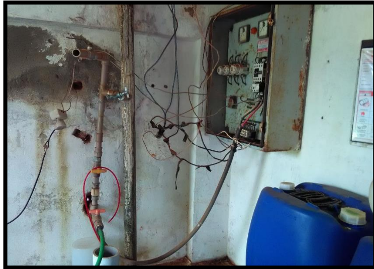
Imagem 02: Quadro de comando do poço 1
