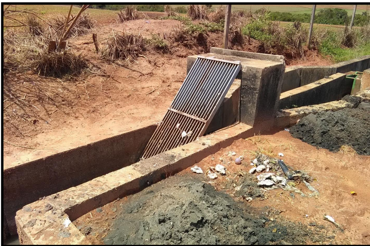
Imagem 23: Gradeamento, caixa de areia e medidor de vazão
