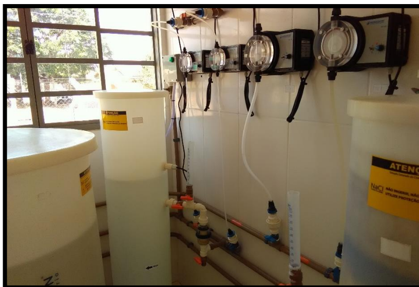
Imagem 08: Unidade de tratamento do reservatório
