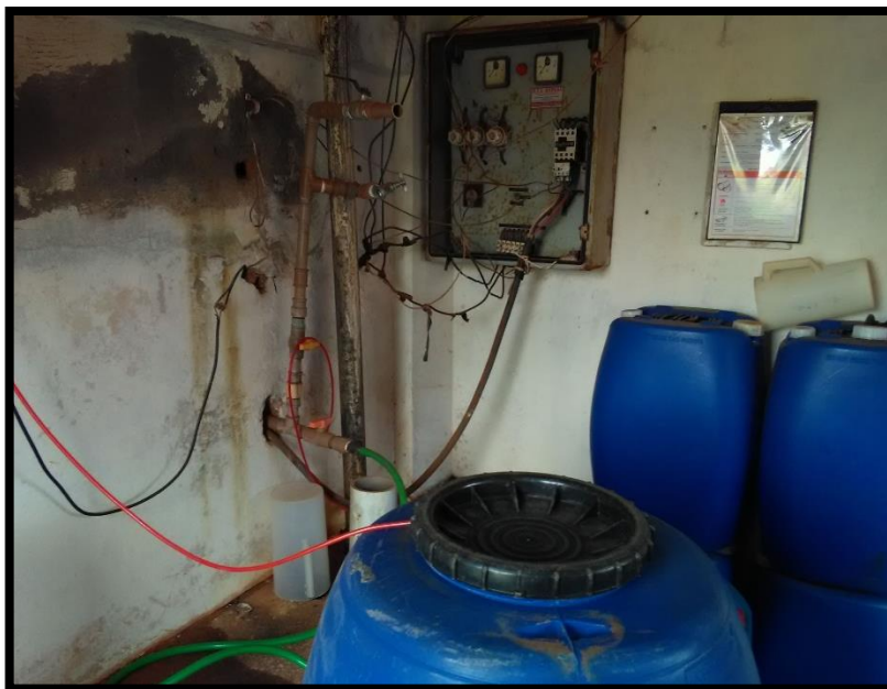
Imagem 10: Unidade de tratamento do poço 1
