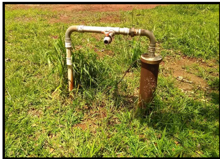
Imagem 03: Barrilete do poço 2
