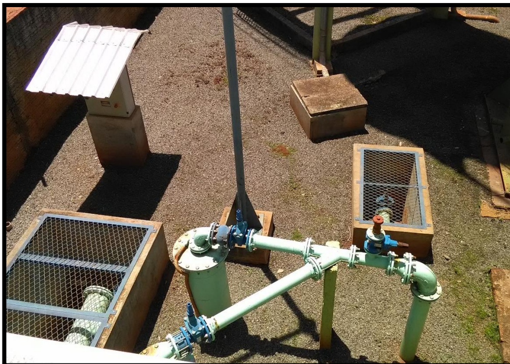
Imagem 16: Conjunto moto bombas e quadro de comando
