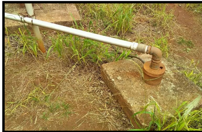
Imagem 06: Barrilete do poço 4
