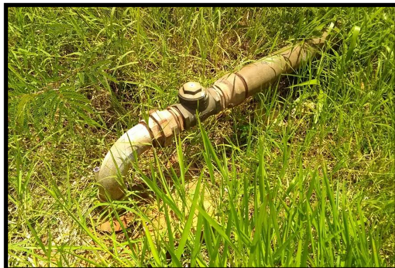
Imagem 04: Barrilete do poço 3
