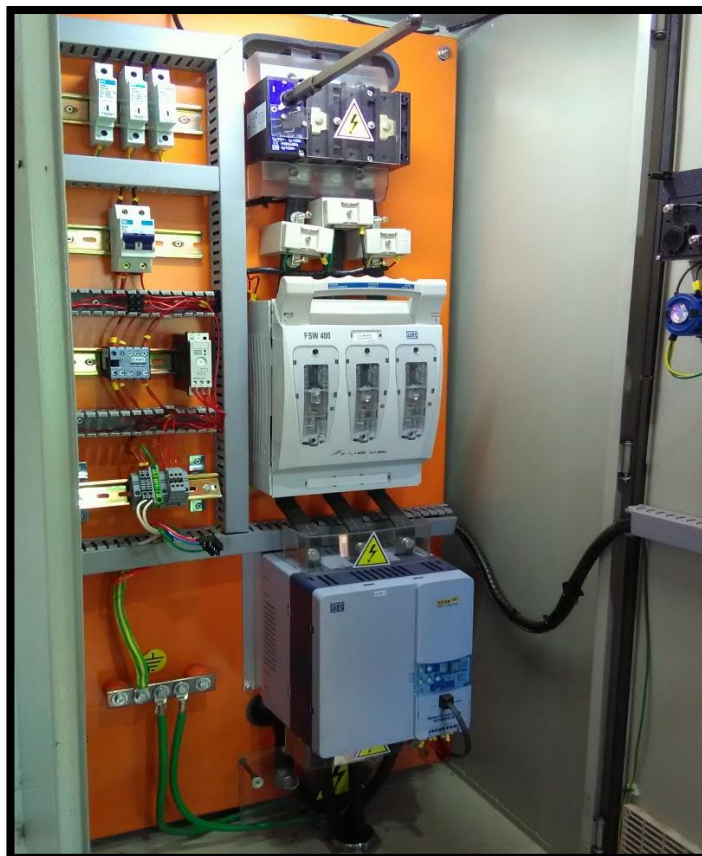
Imagem 18: Quadro de comando da EAB 01
