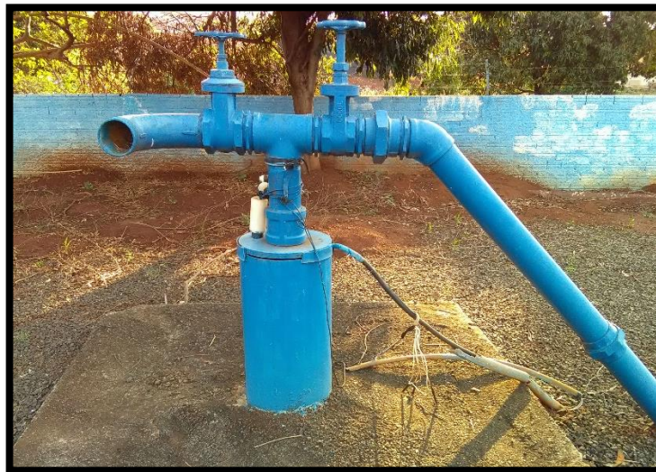
Imagem 02: Barrilete do poço 2
