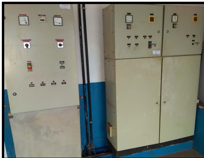
Imagem 20: Quadro de comando da EAB 02
