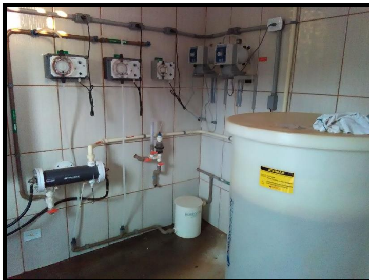
Imagem 08: Unidade de tratamento simplificado do poço 04
