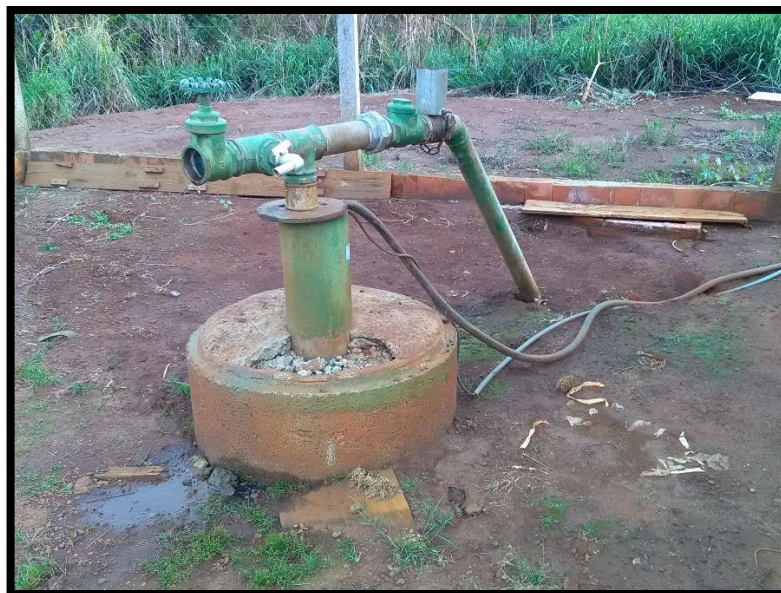
Imagem 04: Barrilete do poço 4
