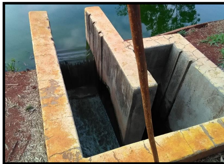
Imagem 37: Dispositivo de saída da lagoa facultativa
