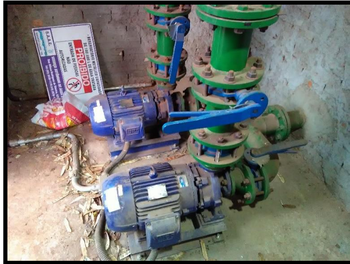
Imagem 23: Conjuntos moto-bombas da EAT 02
