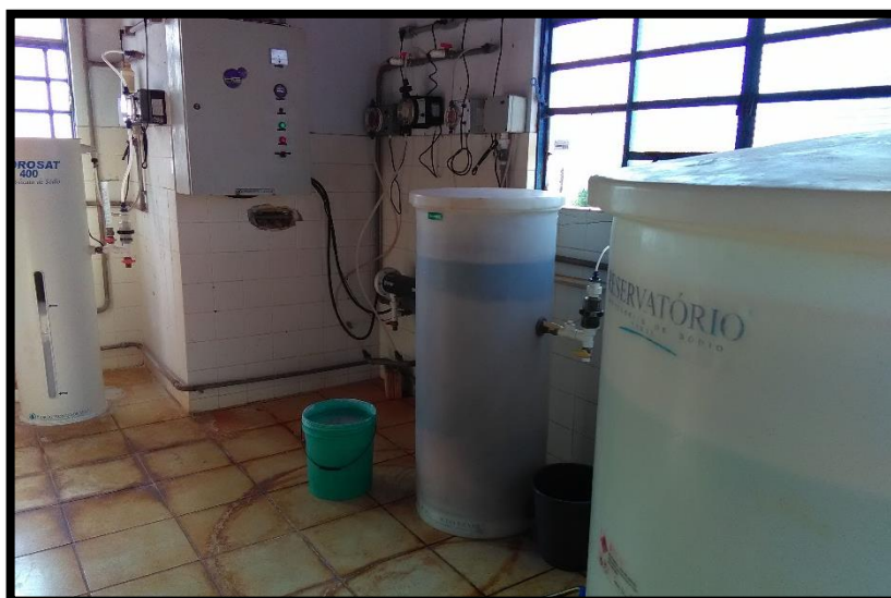
Imagem 07: ETA – Bombas dosadoras e reservatórios de cloro e flúor
