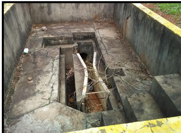
Imagem 38: Calha parshall de saída
