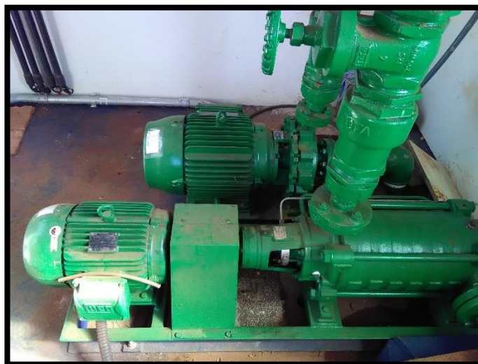
Imagem 25: Conjuntos moto-bombas da EAT 03
