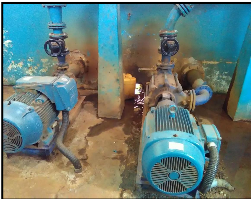
Imagem 17: Conjunto moto-bombas da EAB 01
