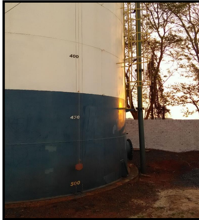
Imagem 14: Reservatório apoiado (RAP 01)
