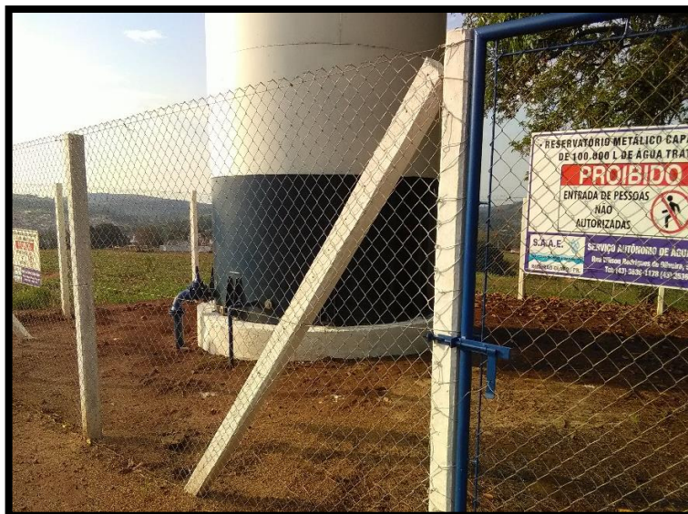
Imagem 11: Reservatório apoiado (RAP 04)
