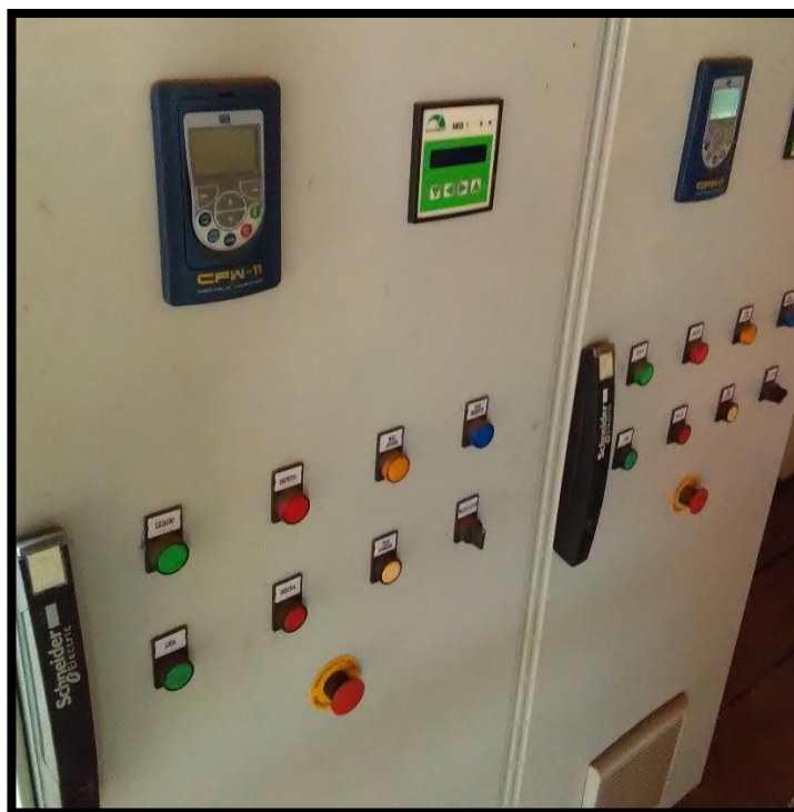
Imagem 34: Quadro de comando da estação elevatória de esgoto
