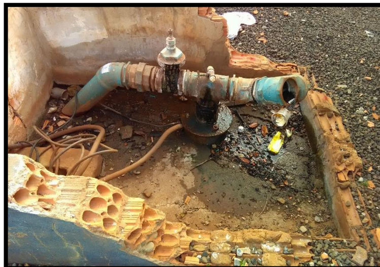
Imagem 03: Barrilete do poço 3
