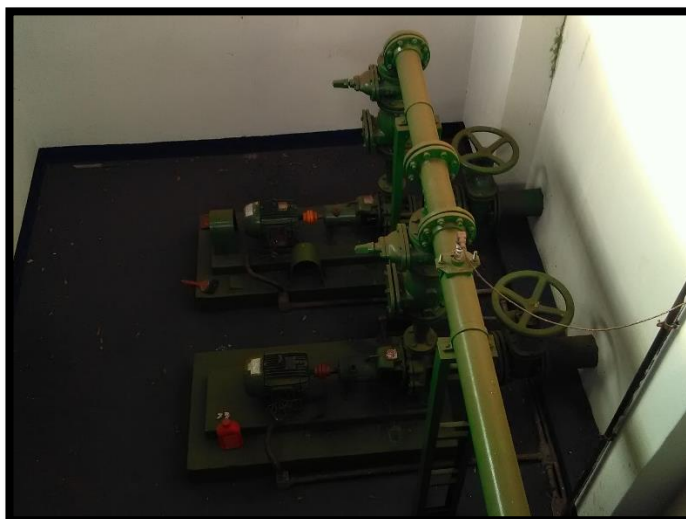
Imagem 21: Conjuntos moto-bombas da EAT 01
