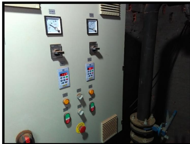
Imagem 24: Quadro de comando da EAT 02
