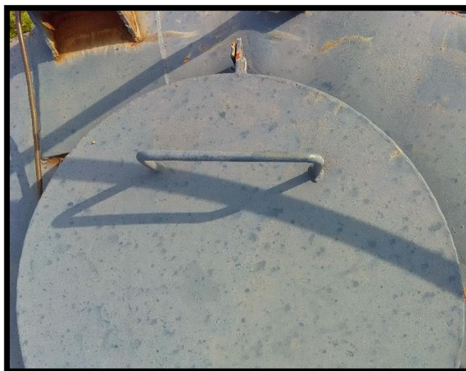
Imagem 12: Abertura de inspeção do RAP 04
