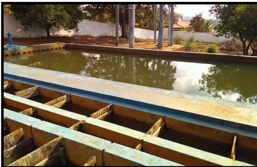
Imagem 05: ETA – Flocculador e tanque decantador
