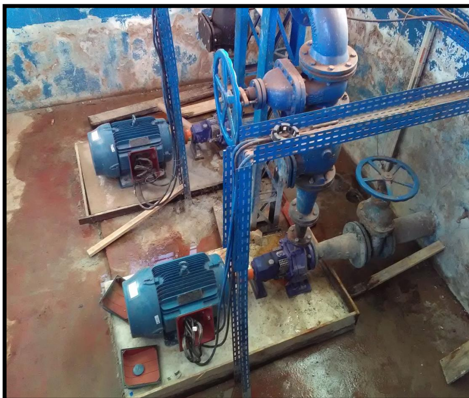
Imagem 19: Conjunto moto-bombas da EAB 02
