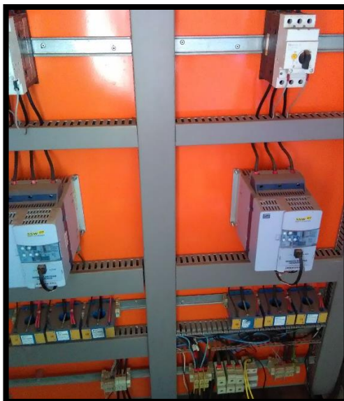
Imagem 26: Quadro de comando da EAT 03
