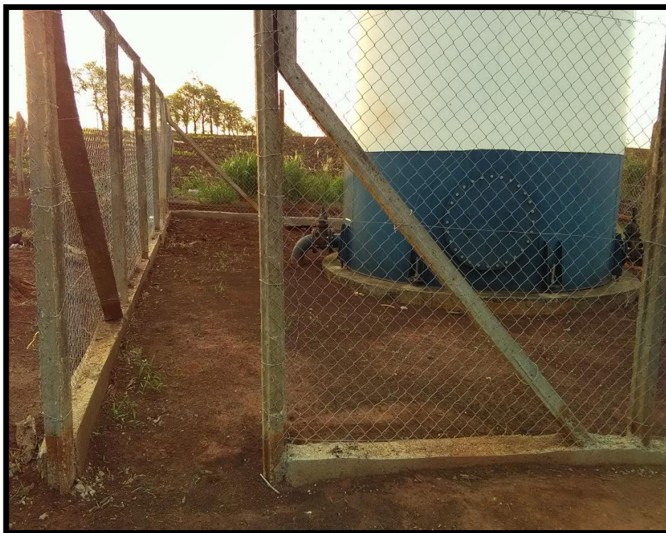
Imagem 16: Reservatório apoiado (RAP Bechara)
