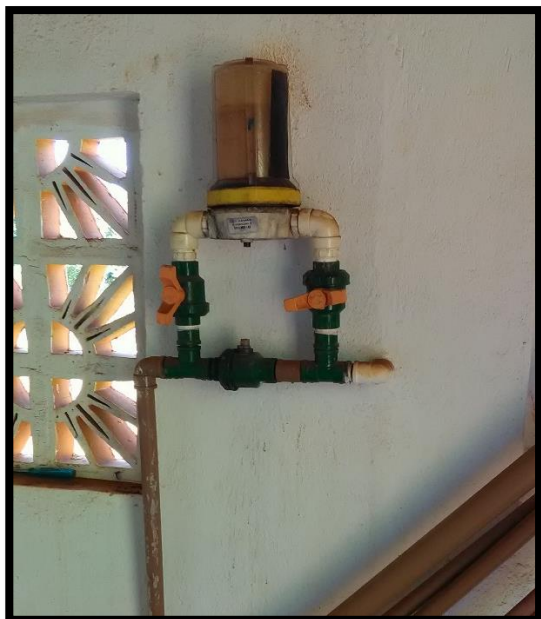
Imagem 18: Unidade de tratamento do sistema Vila Rural
