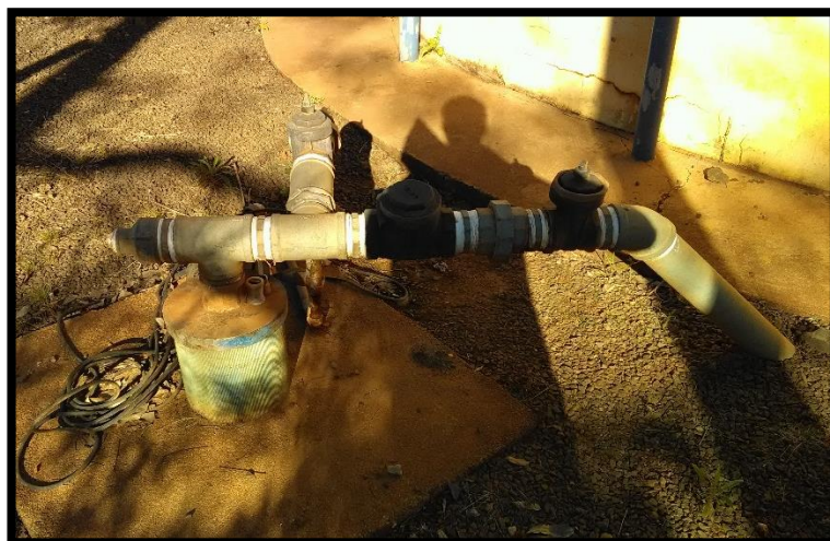
Imagem 07: Poço do distrito Terre Nova
