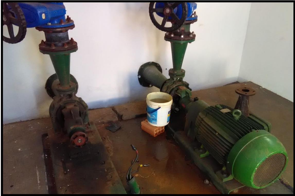
Imagem 32: Conjunto moto-bombas da sede
