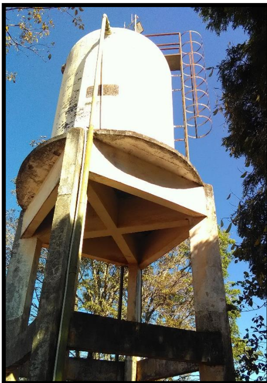
Imagem 29: Reservatórios da Vila Nova
