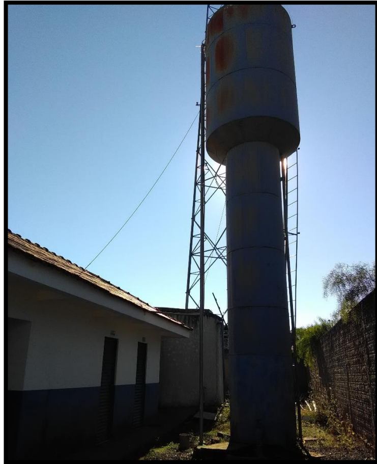
Imagem 27: Reservatórios de água tratada do distrito Terra Nova
