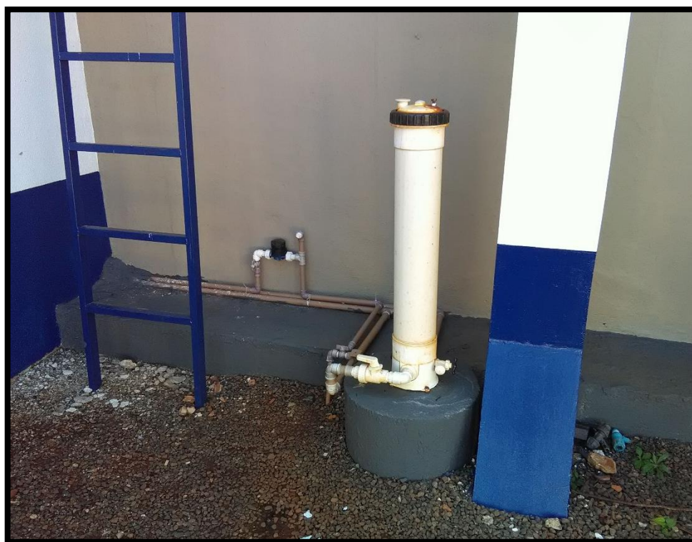
Imagem 13: Unidade de tratamento da sede
