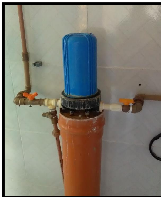
Imagem 17: Unidade de tratamento do sistema Terra Nova
