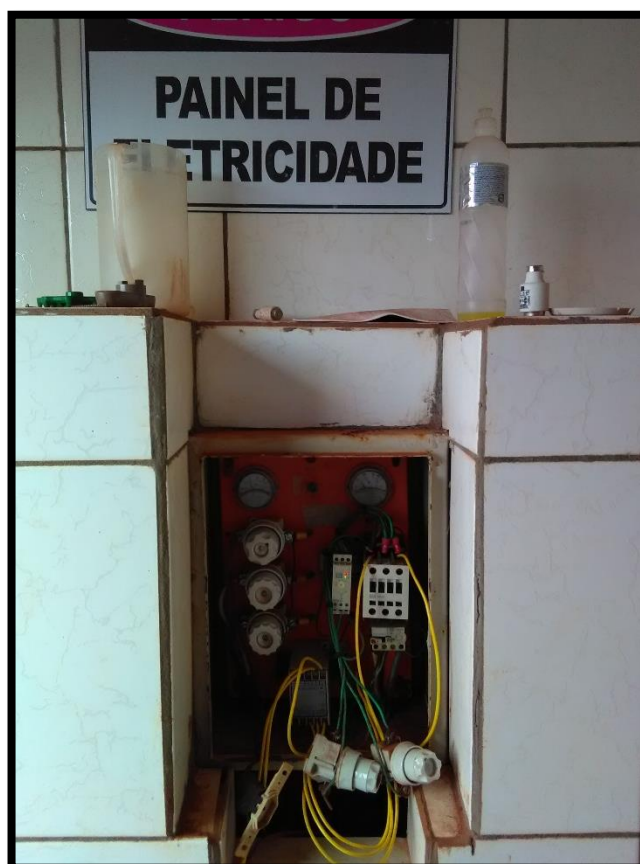
Imagem 04: Quadro de comando do Poço do distrito
