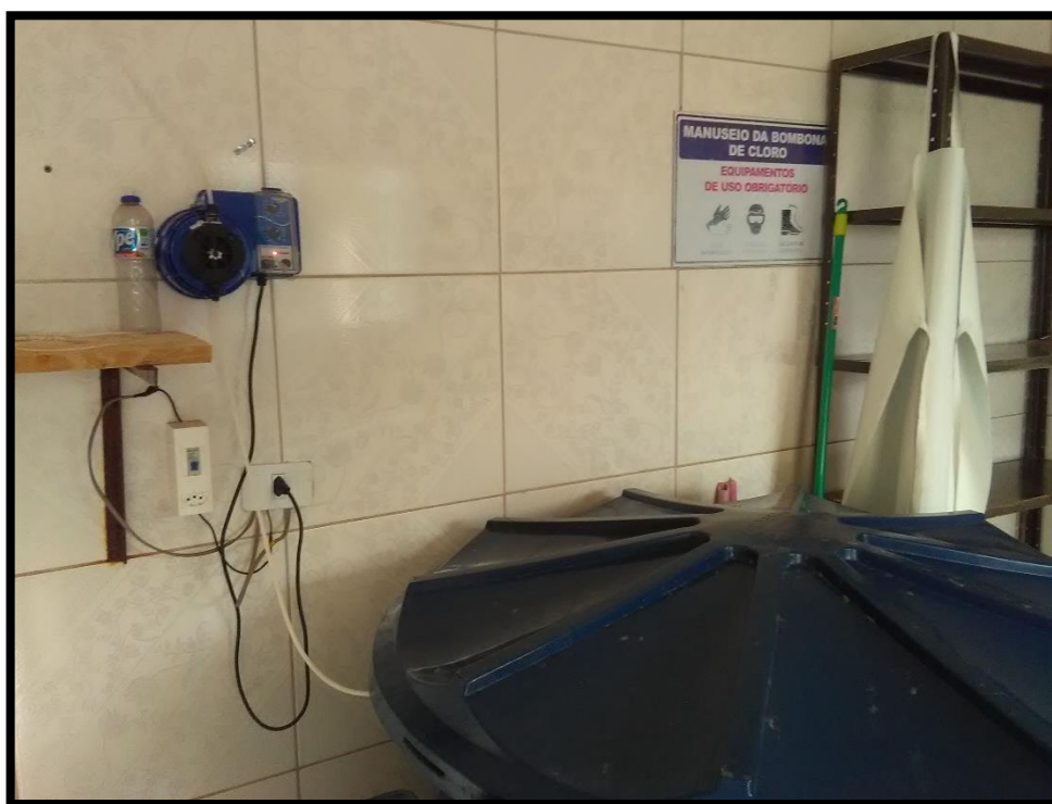
Imagem 05: Unidade de tratamento da sede
