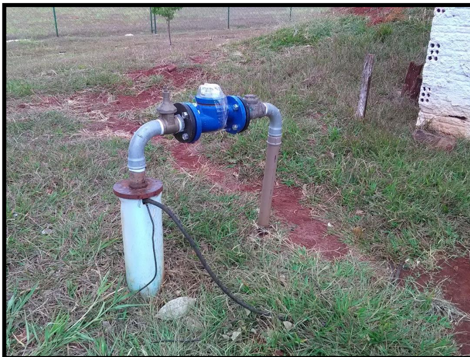
Imagem 03: Poço do distrito
