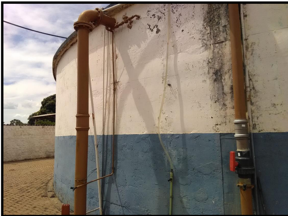
Imagem 18: Reservatório apoiado do sistema Sede
