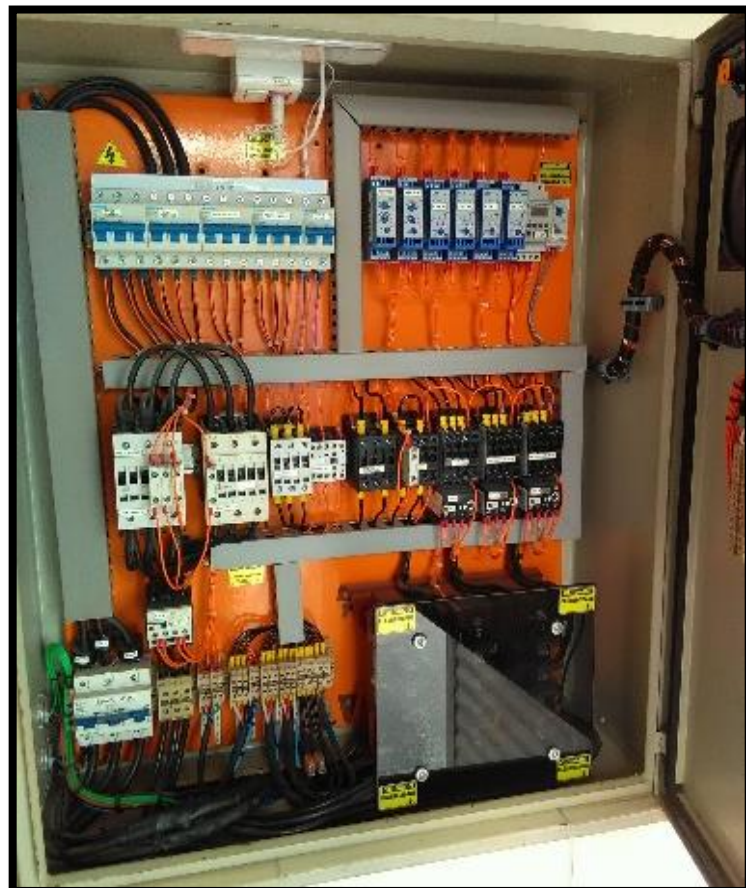
Imagem 13: Quadro de comando dos poços 5 e reserva, e também das bombas dosadoras do tratamento
