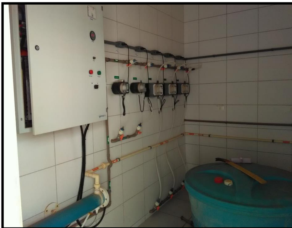
Imagem 15: Unidade de tratamento da Sede
