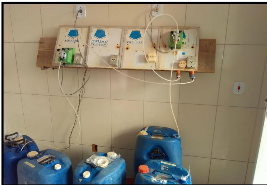
Imagem 16: Unidade de tratamento do dist. São José do Ivai
