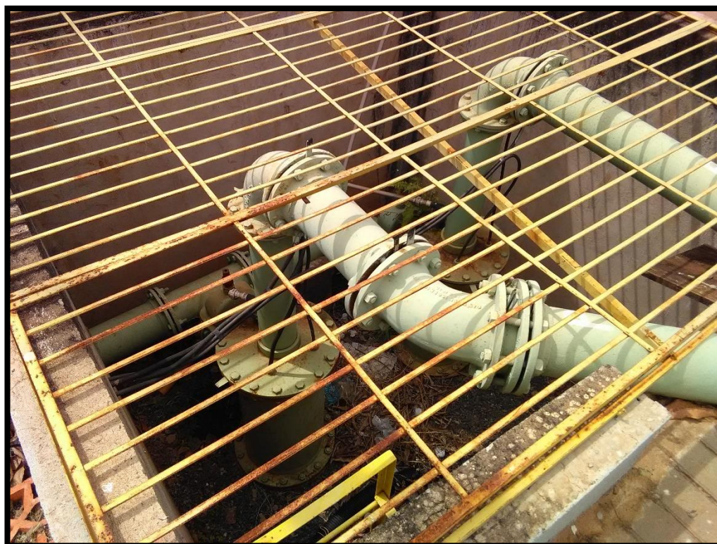
Imagem 24: Conjunto moto bombas do poço falso
