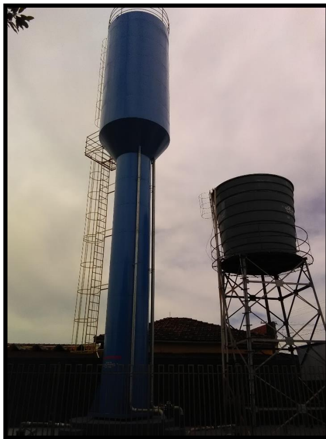
Imagem 22: Reservatórios do sistema do distrito São José do Ivaí
