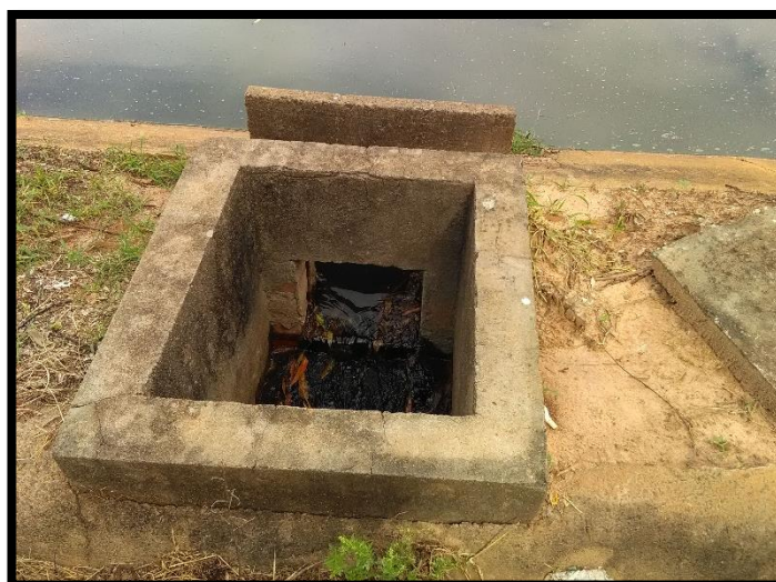
Imagem 43: Dispositivo de saída da lagoa facultativa
