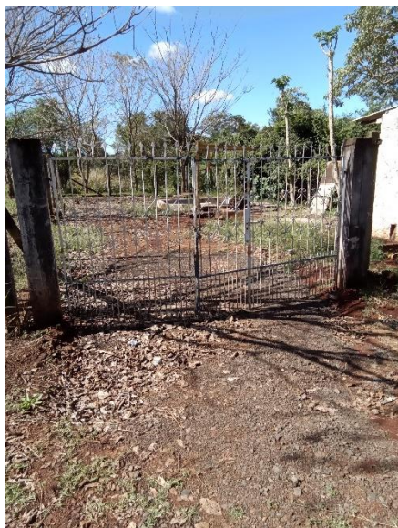
Foto 200 – Entrada elevatória Jardim Itália
