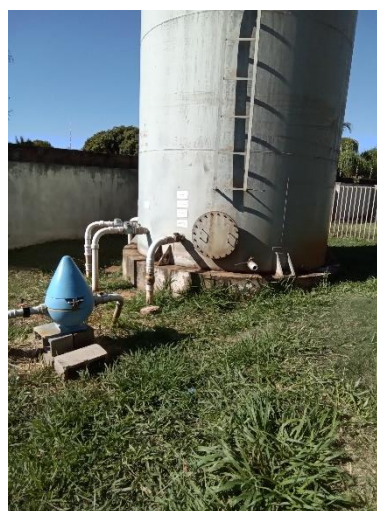
Foto 101 – Isolamento inadequado UTA Planalto Escola
