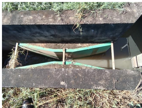
Foto 163 – Calha Parshall (entrada) ETE Aquidaban
