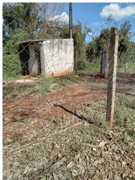
Foto 201 – Cerca danificada elevatória Jardim Itália
