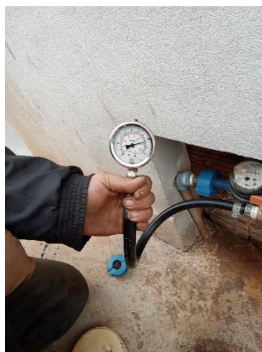
Foto 147 – Medição pressão na rede P03 – P = 114 mca
