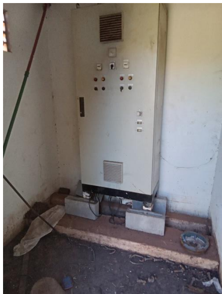
Foto 198 – Quadro de comando elevatória Parque Industrial (não está devidamente chumbado o quadro)
