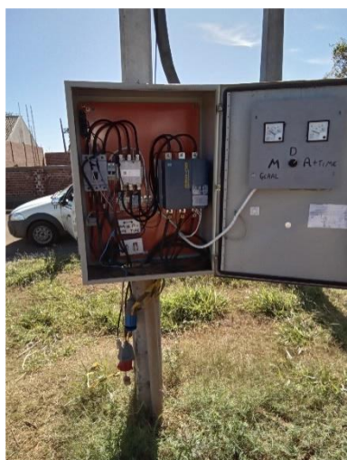
Foto 24 – Quadro de comando poço Yamanhaka
