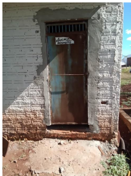
Foto 203 – Entrada casa de comando elevatória Jardim Itália (sem cadeado)
