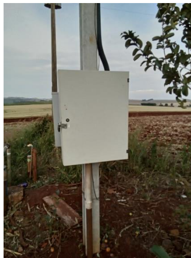
Foto 92 – Frente do quadro poço Aquidaban
