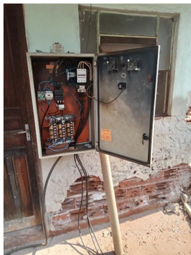
Foto 99 – Quadro de comando poço Cambuí
