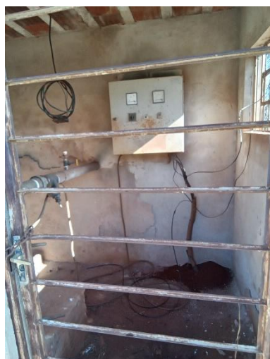
Foto 85 – Frente quadro de comando poço do Polaco
