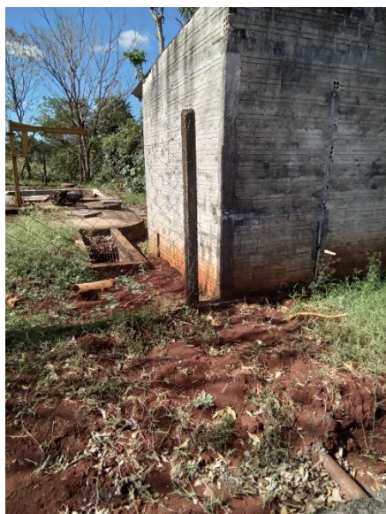
Foto 202 – Entrada danificada elevatória Jaridim Itália
