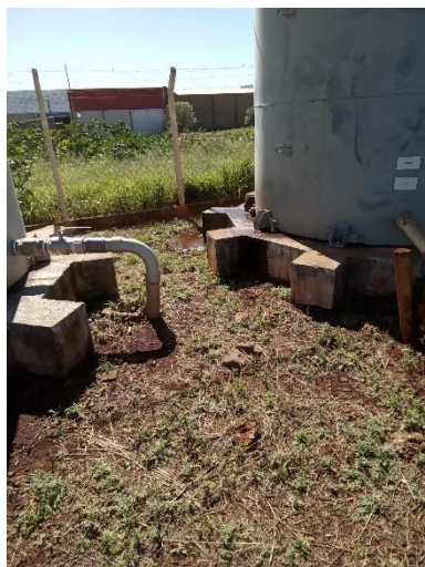
Foto 132 – Vazamento REL Polesi
