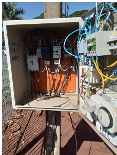
Foto 57 – Quadro poço IBC
