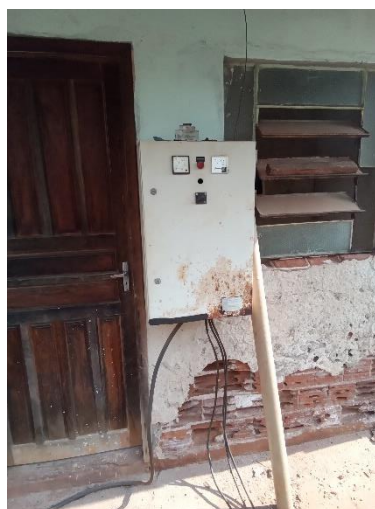
Foto 98 – Frente do quadro de comando poço Cambui
