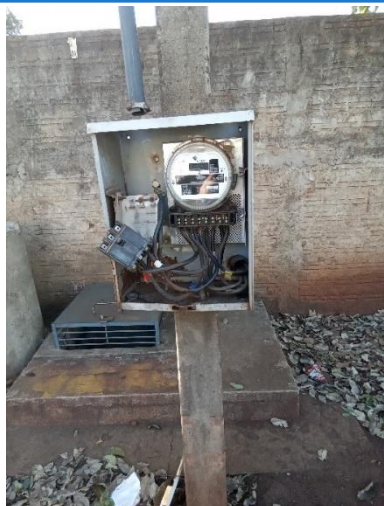
Foto 16 – Quadro de energia Poço Planalto Escola
