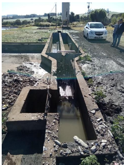
Foto 162 – Gradeamento e caixa de areia ETE Aquidaban
