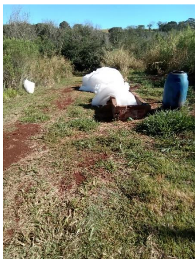
Foto 168 – Caixa de saída lagoa facultativa ETE Aquidaban (excesso espuma)
