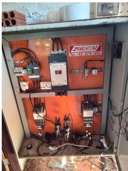
Foto 206 – Quadro de comando EE Jardim Itália Foto 207 – Gradeamento EE Jardim Itália
