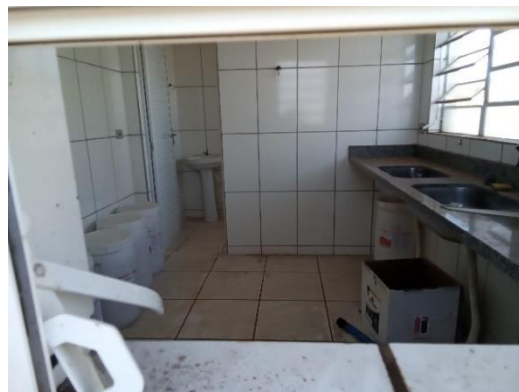
Foto 171 – BWC para operador ETE Aquidaban
