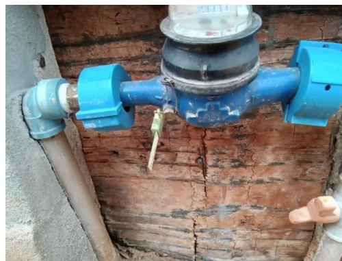
Foto 146 – Identificação hidrômetro P03
