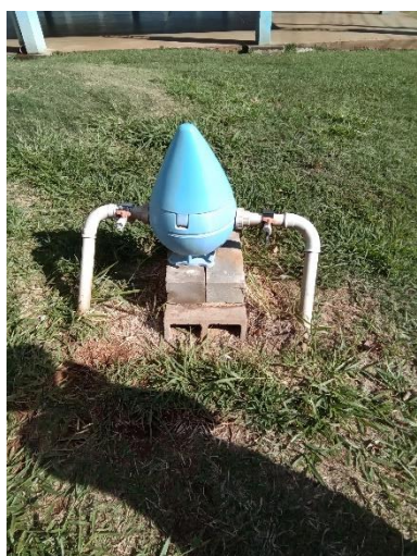
Foto 100 – Unidade de tratamento (UTA) Planalto Escola
