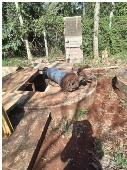
Foto 208 – Sem tampa poço de acesso as bombas
