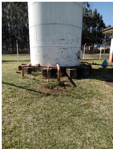
Foto 141 – Base e tubulações REL Zambaldi
